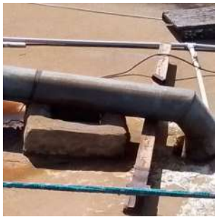
Foto 1 - Abertura na estrutura do reservatório sem telas de proteção no Reservatório da ETA João de Souza em São José do Rio Pardo
