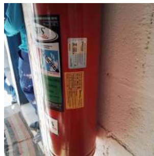
Foto 11 - Extintor de incêndio na ETA Sylos em São José do Rio Pardo
