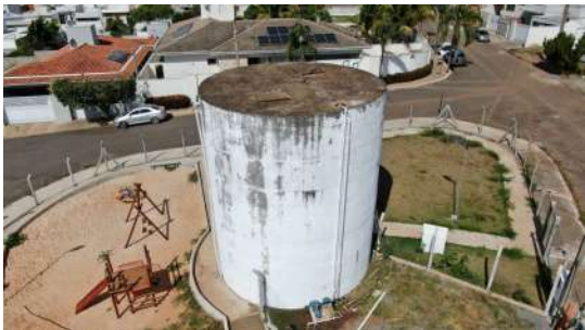
Foto 1 - Ausência de tubulação de ventilação no Reservatório Margarida em São José do Rio Pardo
