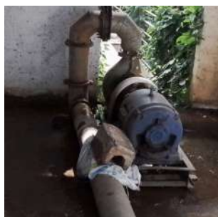
Foto 1 - Vazamento na bomba de água bruta da Captação Santo Antônio em São José do Rio Pardo
