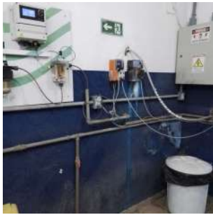
Foto 4 - Controle de parâmetros da ETA Central em São José do Rio Pardo
