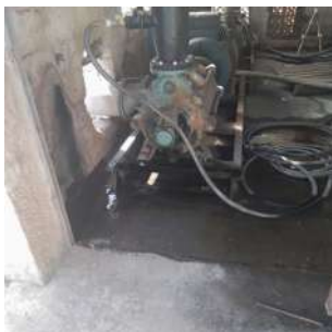
Foto 5 - Vazamento na bomba da Captação represa em São José do Rio Pardo
