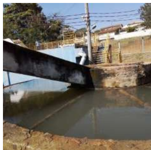
Foto 7 - ETA João de Souza em São José do Rio Pardo
