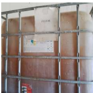
Foto 12 - Dosagem de produtos químicos na ETA Sylos em São José do Rio Pardo
