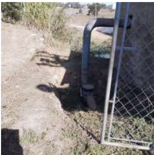
Foto 3 - Tubulação de captação de água bruta na Captação Sylos em São José do Rio Pardo
