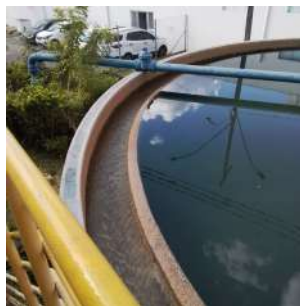
Foto 15 - ETA Central em São José do Rio Pardo
