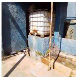
Foto 10 - ETA João de Souza em São José do Rio Pardo
