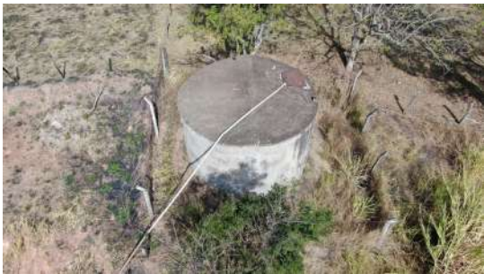
Foto 1 - Reservatório sem tubulação de ventilação no Reservatório Boa Vista do Leste em São José do Rio Pardo
