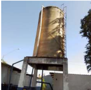
Foto 1 - Guarda-corpo inadequado no Reservatório da ETA Domingos de Syllos em São José do Rio Pardo
