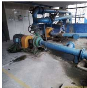
Foto 21 - Bombas da ETA Central em São José do Rio Pardo
