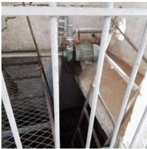
Foto 4 - Vazamento na bomba de água tratada do Reservatório Cassucci II em São José do Rio Pardo
