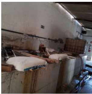
Foto 6 - Dosagem de produtos químicos na ETA Sylos em São José do Rio Pardo
