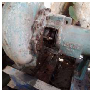
Foto 11 - Vazamento na bomba na ETA João de Souza em São José do Rio Pardo
