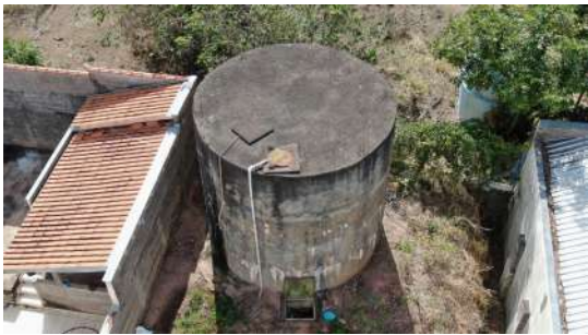
Foto 1 - Guarda-corpos inadequados do Reservatório São Domingos 1 em São José do Rio Pardo
