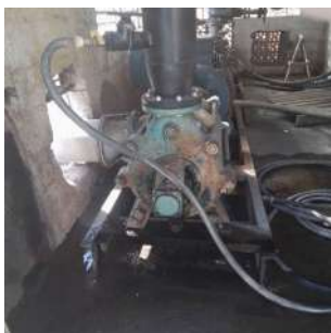
Foto 3 - Vazamento na bomba da Captação represa em São José do Rio Pardo
