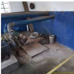
Foto 4 - Materiais estranhos a operação da ETA Central em São José do Rio Pardo
