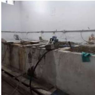
Foto 18 - Tanques de preparo de produtos químicos na ETA Santo Antônio em São José do Rio Pardo
