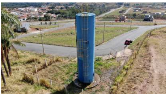
Foto 1 - Guarda-corpos no Reservatório Mano Merli em São José do Rio Pardo
