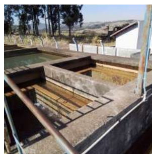
Foto 2 - Filtros e decantadores na ETA Sylos em São José do Rio Pardo
