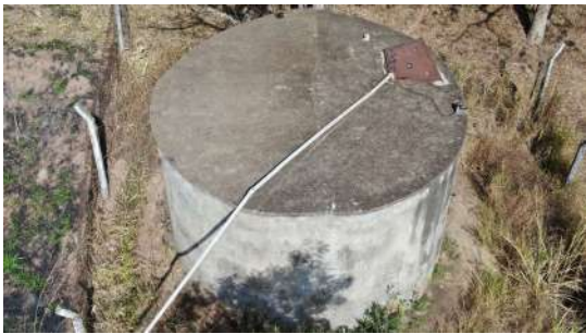
Foto 1 - Reservatório sem tubo extravasor no Reservatório Boa Vista do Leste em São José do Rio Pardo
