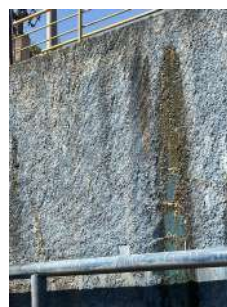
Foto 4 - Vazamentos na parede dos tanques na ETA Santo Antônio em São José do Rio Pardo
