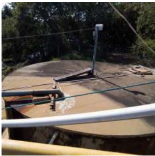
Foto 2 - Tampas de inspeção em más condições no Reservatório da ETA João de Souza em São José do Rio Pardo
