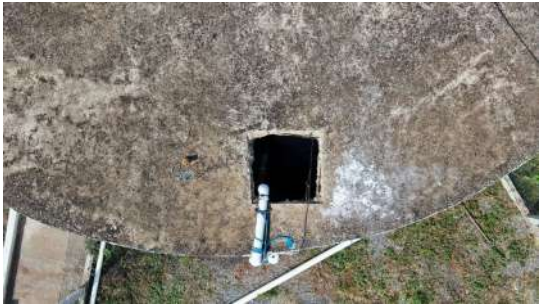
Foto 1 - Ausência de tampa de inspeção no Reservatório Margarida em São José do Rio Pardo
