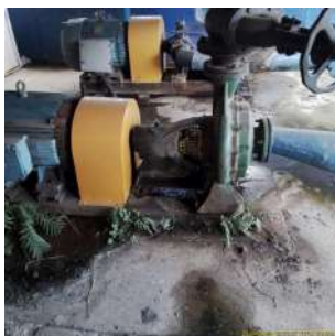
Foto 3 - Vazamentos nas bombas da ETA Central em São José do Rio Pardo
