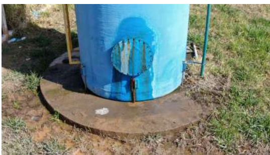
Foto 1 - Vazamentos na estrutura do Reservatório Mano Merli em São José do Rio Pardo
