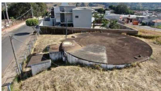
Foto 1 - Ausência de tubulação de ventilação no Reservatório Vila Formoso 2 em São José do Rio Pardo
