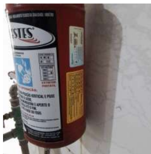
Foto 10 - Extintor de incêndio da ETA Central em São José do Rio Pardo
