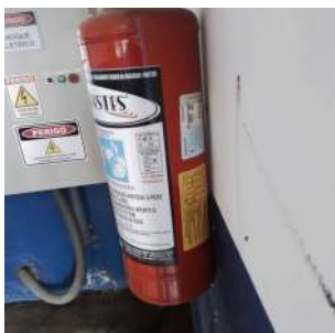
Foto 1 - Extintor de incêndio com validade expirada da ETA Central em São José do Rio Pardo
