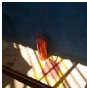
Foto 5 - Extintor de incêndio da ETA Santo Antônio em São José do Rio Pardo
