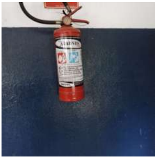
Foto 2 - Extintor de incêndio na Captação Central em São José do Rio Pardo
