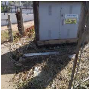
Foto 4 - Painel de energia na Captação Sylos em São José do Rio Pardo
