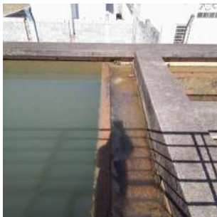
Foto 18 - Filtros e decantadores na ETA Sylos em São José do Rio Pardo
