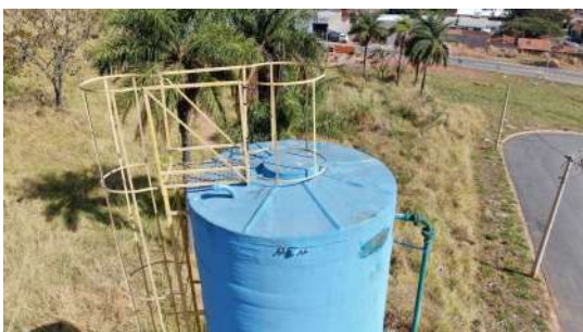
Foto 1 - Inexistência de para-raios no Reservatório Mano Merli em São José do Rio Pardo
