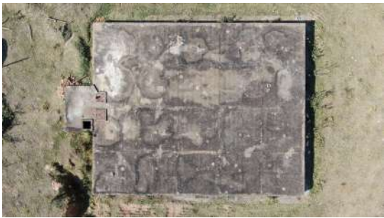
Foto 1 - Ausencia de telas de proteção nas aberturas na estrutura do Reservatório Maria Boaro em São José do Rio Pardo
