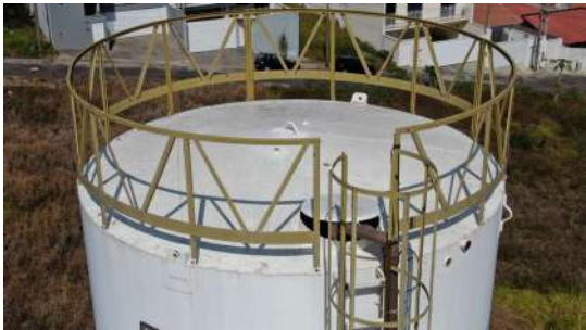
Foto 1 - Tampa de inspeção inadequada no Reservatório São Roque 1 em São José do Rio Pardo
