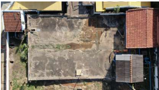
Foto 1 - Chapa metálica solta no Reservatório da ETA Central 2 em São José do Rio Pardo
