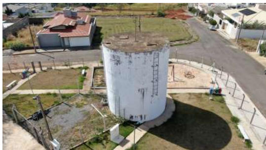
Foto 1 - Vazamentos na estrutura do Reservatório Margarida em São José do Rio Pardo
