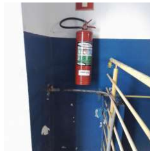
Foto 19 - Extintor de incêndio da ETA Central em São José do Rio Pardo
