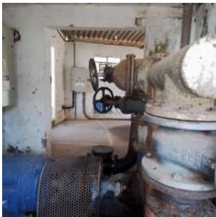
Foto 2 - Bombas na ETA Santo Antônio em São José do Rio Pardo
