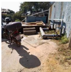
Foto 1 - Vazamento no registro e na estrutura dos tanques na ETA João de Souza em São José do Rio Pardo
