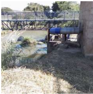
Foto 8 - Captação Sylos em São José do Rio Pardo
