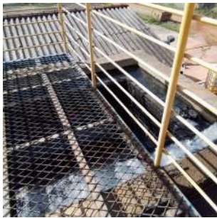
Foto 13 - ETA Cassucci em São José do Rio Pardo
