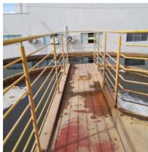
Foto 13 - ETA Central em São José do Rio Pardo
