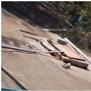
Foto 1 - Tampas de inspeção em más condições no Reservatório da ETA João de Souza em São José do Rio Pardo
