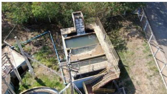
Foto 21 - ETA João de Souza em São José do Rio Pardo
