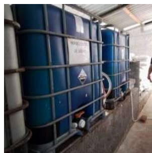
Foto 13 - Dosagem de produtos químicos na ETA Sylos em São José do Rio Pardo
