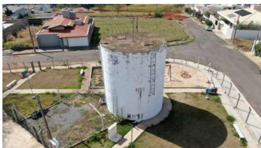
Foto 1 - Guarda-corpos inadequadas no Reservatório Margarida em São José do Rio Pardo
