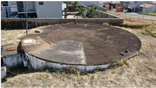
Foto 1 - Rachaduras na estrutura do Reservatório Vila Formoso 2 em São José do Rio Pardo
