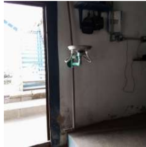
Foto 6 - Lava-olhos de emergência na ETA Cassucci em São José do Rio Pardo
