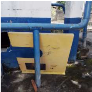
Foto 1 - Materiais estranhos à operação no Reservatório da ETA Domingos de Syllos em São José do Rio Pardo
