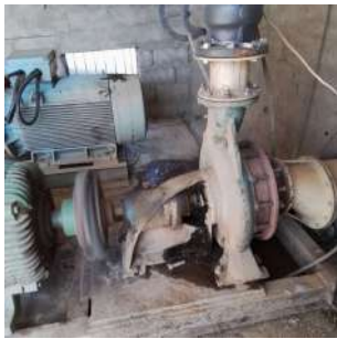
Foto 7 - Drenagem inadequada da água de lubrificação de gaxetas na Captação Sylos em São José do Rio Pardo
