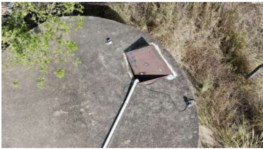
Foto 1 - Tampa de inspeção em más condições e aberta no Reservatório Boa Vista do Leste em São José do Rio Pardo
