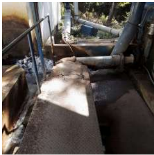
Foto 1 - Condição insegura pela chapa de metal deteriorada na ETA Santo Antônio em São José do Rio Pardo
