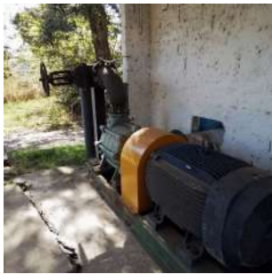
Foto 5 - Bomba de água tratada do Reservatório da ETA Domingos de Syllos em São José do Rio Pardo
