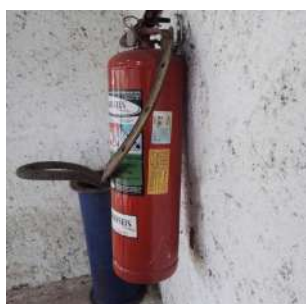
Foto 1 - Extintor com validade expirada na Captação Santo Antônio em São José do Rio Pardo
