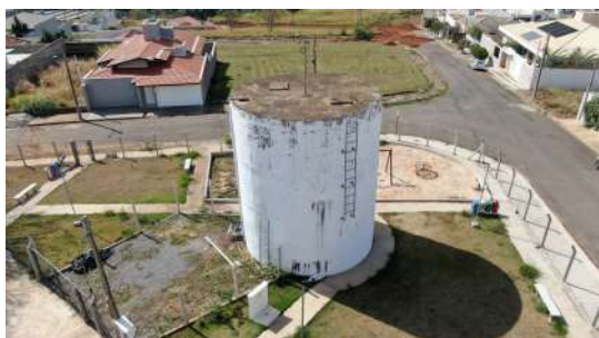
Foto 1 - Ausência de Para-raios no Reservatório Margarida em São José do Rio Pardo
