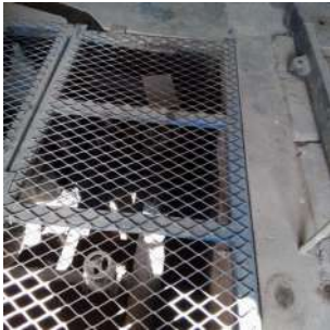
Foto 4 - Vazamento no registro da Captação Central em São José do Rio Pardo
