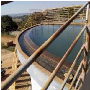
Foto 15 - ETA Cassucci em São José do Rio Pardo
