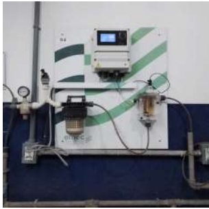
Foto 5 - Controle de parâmetros da ETA Central em São José do Rio Pardo
