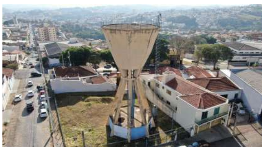
Foto 1 - Ausência de identificação no Reservatório Chuveirão em São José do Rio Pardo
