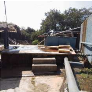
Foto 2 - ETA João de Souza em São José do Rio Pardo
