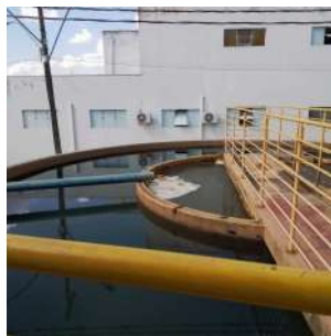
Foto 12 - ETA Central em São José do Rio Pardo
