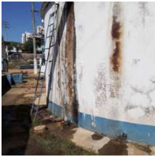
Foto 2 - Vazamentos na estrutura do Reservatório ETA Santo Antônio em São José do Rio Pardo
