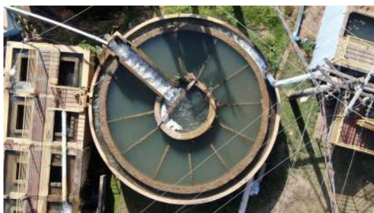
Foto 19 - ETA João de Souza em São José do Rio Pardo
