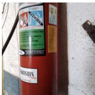
Foto 1 - Extintor de incêndio com prazo vencido na ETA Cassucci em São José do Rio Pardo
