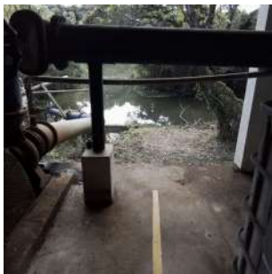
Foto 1 - Captação Santo Antônio em São José do Rio Pardo
