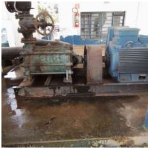
Foto 4 - Bombas na ETA Santo Antônio em São José do Rio Pardo
