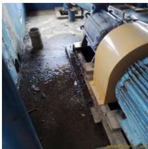
Foto 1 - Vazamentos nas bombas da ETA Central em São José do Rio Pardo
