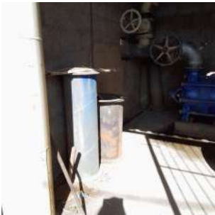
Foto 1 - Materiais estranhos à operação na Captação Sylos em São José do Rio Pardo
