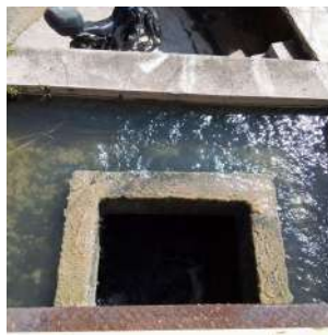
Foto 4 - ETA João de Souza em São José do Rio Pardo
