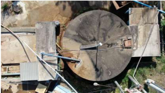
Foto 3 - Tampas de inspeção em más condições no Reservatório da ETA João de Souza em São José do Rio Pardo
