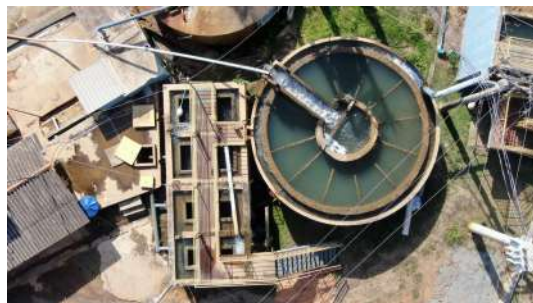
Foto 18 - ETA João de Souza em São José do Rio Pardo
