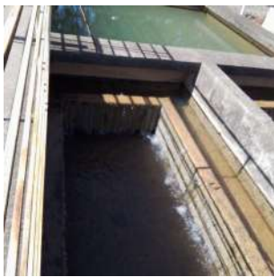
Foto 16 - Filtros e decantadores na ETA Sylos em São José do Rio Pardo
