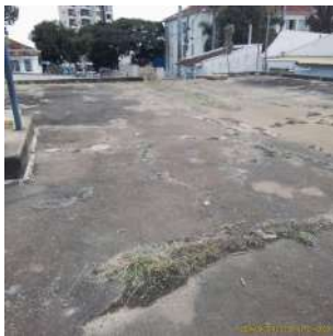
Foto 2 - Trincas na estrutura do Reservatório da ETA Central 2 em São José do Rio Pardo
