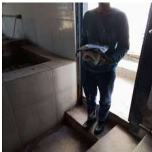
Foto 9 - EPIs utilizadas pela operação da ETA Cassucci em São José do Rio Pardo
