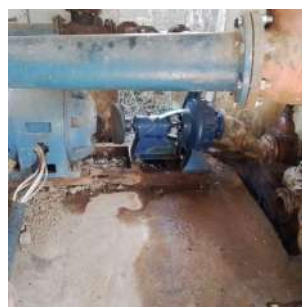
Foto 3 - Vazamento na bomba na ETA João de Souza em São José do Rio Pardo
