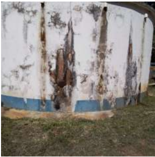
Foto 1 - Vazamentos na estrutura do Reservatório ETA Santo Antônio em São José do Rio Pardo
