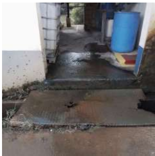
Foto 1 - Condição insegura pela placa de metal deteriorada e solta na Captação Santo Antônio em São José do Rio Pardo
