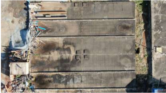
Foto 1 - Materiais estranhos a operação no Reservatório da ETA Central I em São José do Rio Pardo
