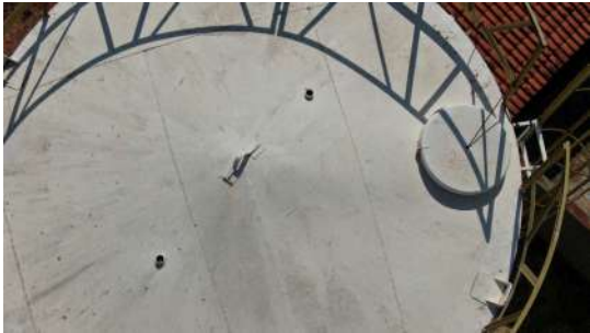
Foto 1 - Inexistência de telas de proteção no Reservatório Vila Formosa 1 em São José do Rio Pardo
