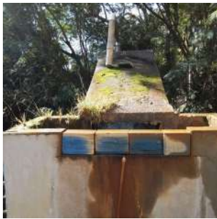
Foto 2 - Ausência de limpeza e conservação na ETA Santo Antônio em São José do Rio Pardo
