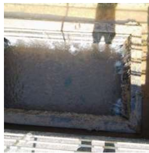
Foto 17 - Filtros e decantadores na ETA Sylos em São José do Rio Pardo
