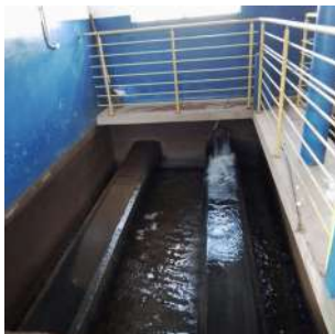
Foto 18 - ETA Central em São José do Rio Pardo
