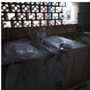
Foto 9 - Produtos químicos utilizados na ETA Central em São José do Rio Pardo
