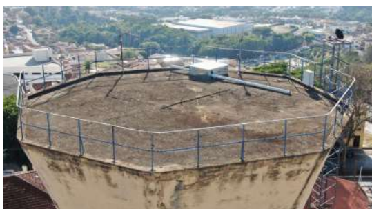
Foto 1 - Ausência de Para-raios no Reservatório Chuveirão em São José do Rio Pardo
