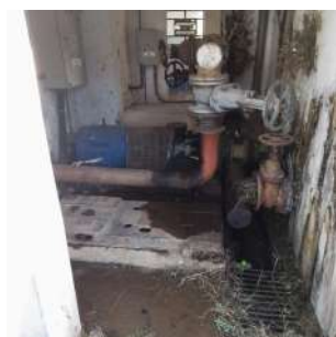
Foto 3 - Vazamentos e drenagem da lubrificação nas gaxetas inadequadas na ETA Santo Antônio em São José do Rio Pardo
