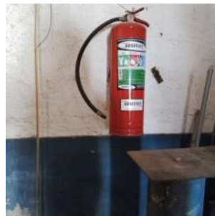
Foto 10 - Extintor de incêndio na ETA Cassucci em São José do Rio Pardo
