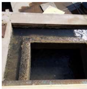
Foto 6 - ETA João de Souza em São José do Rio Pardo
