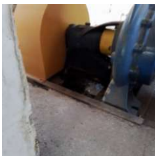
Foto 1 - Vazamento na bomba na ETA Sylos em São José do Rio Pardo
