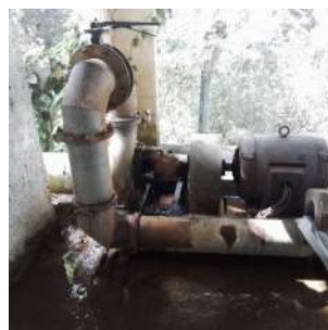
Foto 2 - Vazamento na bomba de água bruta da Captação Santo Antônio em São José do Rio Pardo
