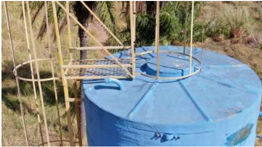
Foto 1 - Tubulação de ventilação no Reservatório Mano Merli em São José do Rio Pardo
