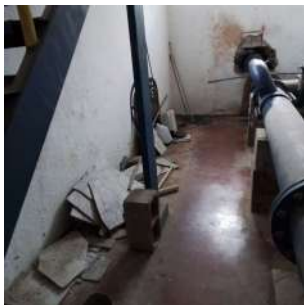
Foto 2 - Materiais estranhos a operação da ETA Central em São José do Rio Pardo
