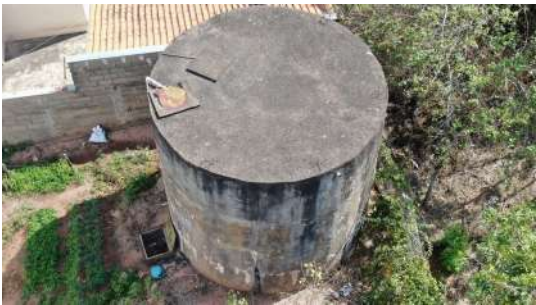
Foto 2 - Reservatório São Domingos 1 em São José do Rio Pardo
