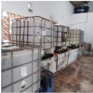
Foto 19 - Produtos químicos utilizados na ETA Santo Antônio em São José do Rio Pardo
