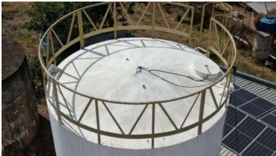
Foto 1 - Inexistência de telas de proteção nas aberturas do Reservatório São domingos 2 em São José do Rio Pardo
