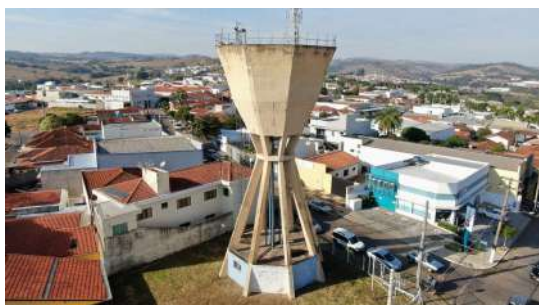
Foto 1 - Vazamentos na parte inferior do Reservatório Chuveirão em São José do Rio Pardo
