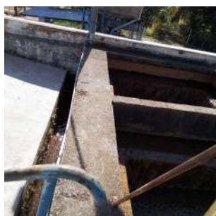
Foto 1 - Filtros e decantadores na ETA Sylos em São José do Rio Pardo
