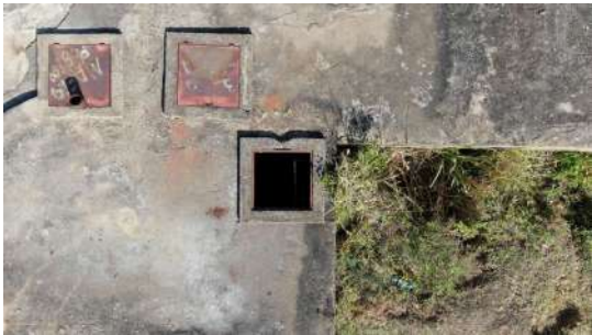
Foto 1 - Ausência de tampa de inspeção no Reservatório Maria Boaro em São José do Rio Pardo
