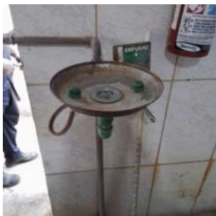
Foto 11 - Lava-olhos da ETA Central em São José do Rio Pardo
