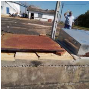
Foto 1 - Tampa de inspeção inadequada no Reservatório Cassucci II em São José do Rio Pardo
