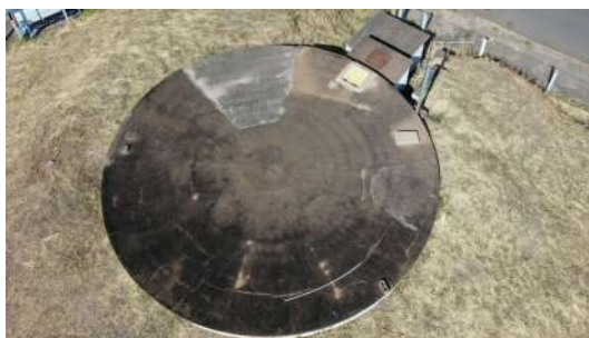
Foto 2 - Ausência de tubulação de ventilação no Reservatório Vila Formoso 2 em São José do Rio Pardo
