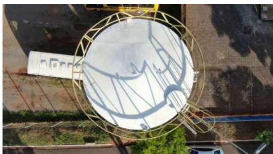
Foto 1 - Inexistência de telas de proteção nas aberturas superiores do Reservatório da ETEC em São José do Rio Pardo
