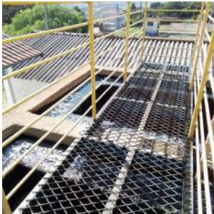
Foto 16 - ETA Cassucci em São José do Rio Pardo
