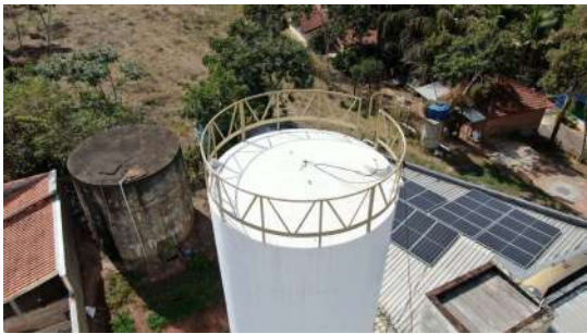
Foto 1 - Inexistência de para-raios no Reservatório São domingos 2 em São José do Rio Pardo
