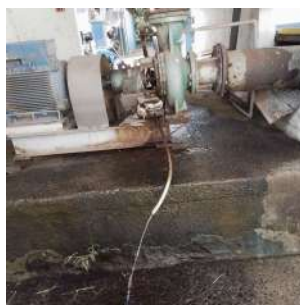
Foto 5 - Vazamentos e drenagem da lubrificação nas gaxetas inadequadas na ETA Santo Antônio em São José do Rio Pardo
