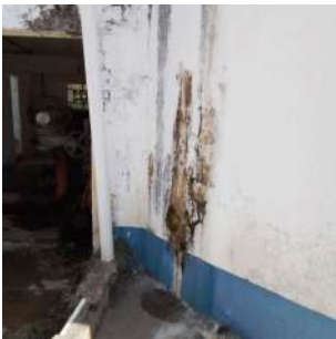
Foto 3 - Vazamentos na estrutura do Reservatório ETA Santo Antônio em São José do Rio Pardo
