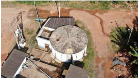
Foto 1 - Tampa de inspeção em condição inadequada no Reservatório ETA Santo Antônio em São José do Rio Pardo
