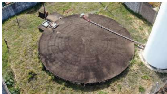
Foto 1 - Rachaduras na estrutura do Reservatório São Roque 2 em São José do Rio Pardo
