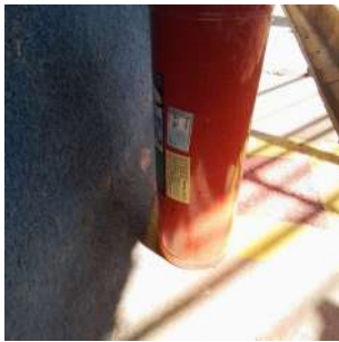
Foto 1 - Extintor de incêndio com validade expirada na ETA Santo Antônio em São José do Rio Pardo
