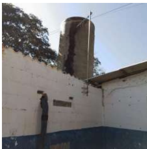
Foto 1 - Ausência de para-raios do Reservatório da ETA Domingos de Syllos em São José do Rio Pardo
