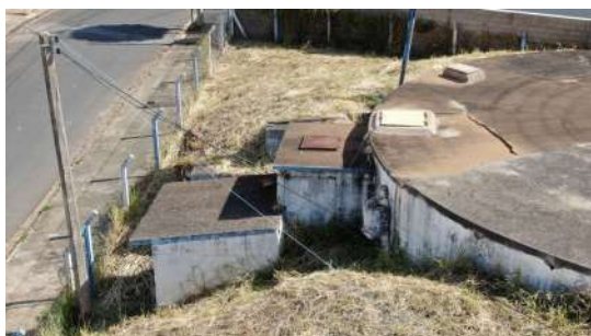
Foto 1 - Tampas de inspeção no Reservatório Vila Formoso 2 em São José do Rio Pardo
