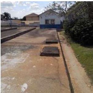
Foto 1 - Tampas de inspeção inadequadas no Reservatório da ETA Central I em São José do Rio
