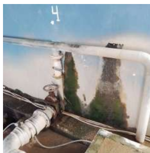
Foto 2 - Vazamentos na parede dos tanques na ETA Santo Antônio em São José do Rio Pardo
