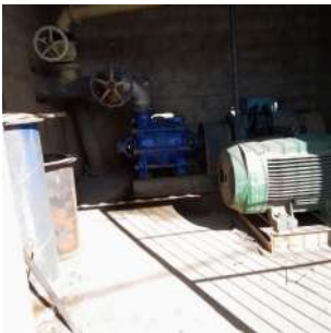
Foto 5 - Materiais estranhos à operação naCaptação Sylos em São José do Rio Pardo
