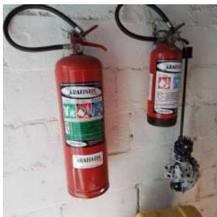
Foto 10 - Extintores de incêndio na ETA Sylos em São José do Rio Pardo
