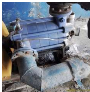
Foto 2 - Vazamentos nas bombas da ETA Central em São José do Rio Pardo
