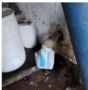
Foto 2 - Vazamento na tubulação na ETA Sylos em São José do Rio Pardo
