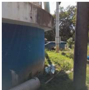
Foto 8 - ETA João de Souza em São José do Rio Pardo
