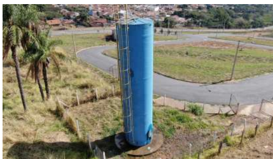
Foto 2 - Vazamentos na estrutura do Reservatório Mano Merli em São José do Rio Pardo
