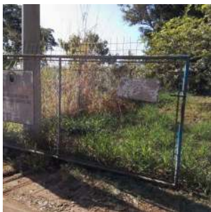
Foto 1 - Entrada da ETA Sylos em São José do Rio Pardo
