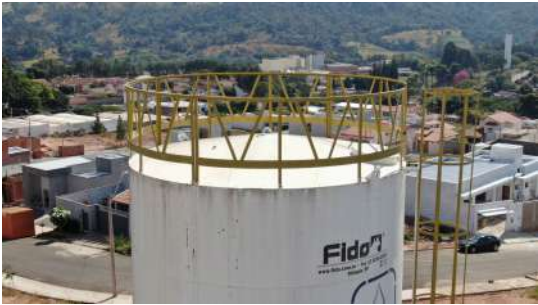
Foto 1 - Reservatório Vila Formosa 1 em São José do Rio Pardo
