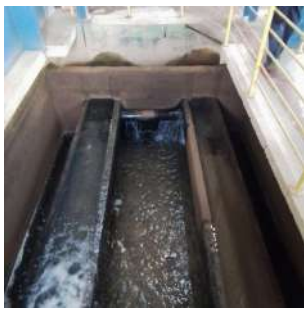
Foto 16 - ETA Central em São José do Rio Pardo
