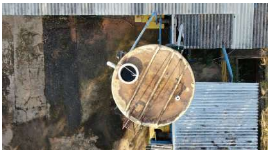
Foto 1 - Ausência de tampa de inspeção no Reservatório da ETA Domingos de Syllos em São José do Rio Pardo
