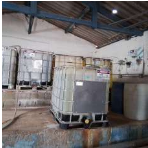
Foto 5 - Armazenamento de produtos químicos na ETA Cassucci em São José do Rio Pardo
