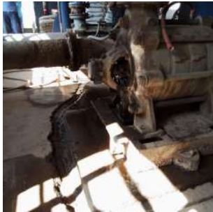
Foto 3 - Vazamento na bomba da Captação Central em São José do Rio Pardo
