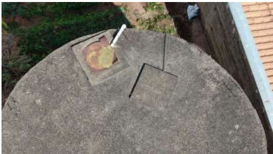
Foto 1 - Tampa de inspeção em condições inadequadas do Reservatório São Domingos 1 em São José do Rio Pardo
