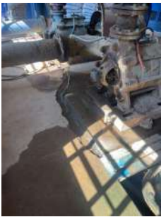
Foto 2 - Vazamento na bomba da Captação Central em São José do Rio Pardo
