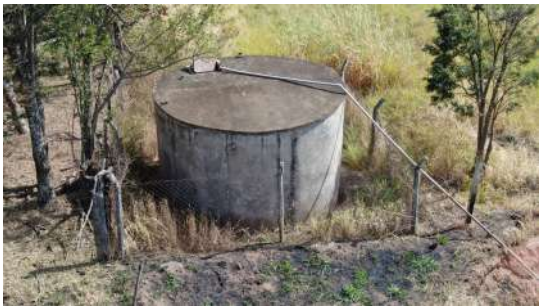
Foto 1 - Trincas ao redor da estrutura no Reservatório Boa Vista do Leste em São José do Rio Pardo
