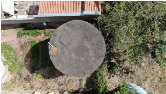
Foto 2 - Tampa de inspeção em condições inadequadas do Reservatório São Domingos 1 em São José do Rio Pardo
