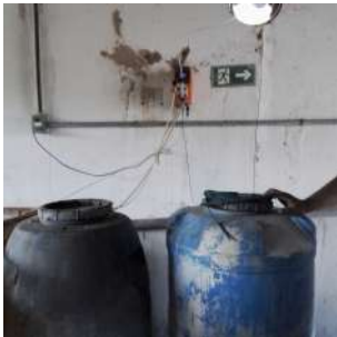
Foto 2 - Captação Santo Antônio em São José do Rio Pardo
