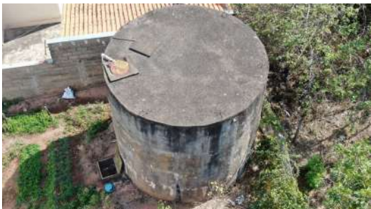
Foto 1 - Vazamentos na estrutura do Reservatório São Domingos 1 em São José do Rio Pardo
