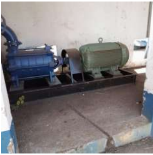
Foto 3 - Bombas na ETA Santo Antônio em São José do Rio Pardo
