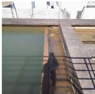
Foto 1 - Vertedores de água desnivelados na ETA Sylos em São José do Rio Pardo no decantador
