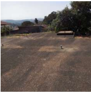
Foto 1 - Tubulação de ventilação no Reservatório Cassucci II em São José do Rio Pardo
