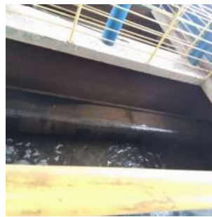
Foto 17 - ETA Central em São José do Rio Pardo
