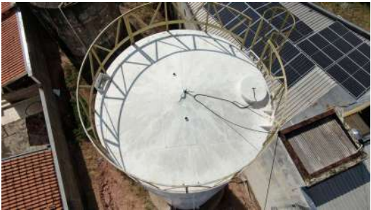
Foto 2 - Inexistência de telas de proteção nas aberturas do Reservatório São domingos 2 em São José do Rio Pardo
