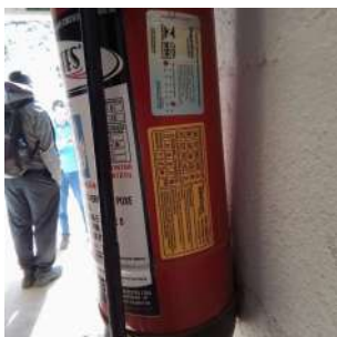
Foto 1 - Extintor de incêndio na ETA Sylos em São José do Rio Pardo
