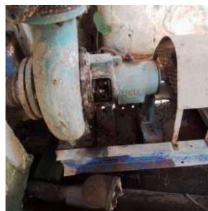
Foto 2 - Vazamento na bomba na ETA João de Souza em São José do Rio Pardo
