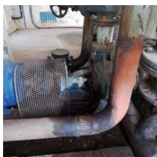
Foto 6 - Vazamentos e drenagem da lubrificação nas gaxetas inadequadas na ETA Santo Antônio em São José do Rio Pardo
