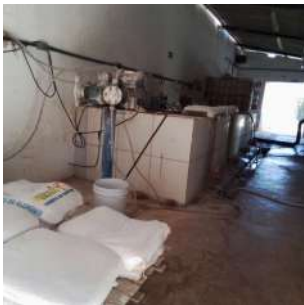
Foto 5 - Dosagem de produtos químicos na ETA Sylos em São José do Rio Pardo
