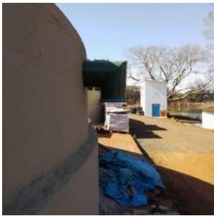
Foto 2 - Tubo extravasor em um dos reservatórios.
