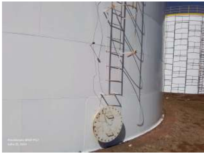
Foto 1 - Condutor de descarga cortado.
