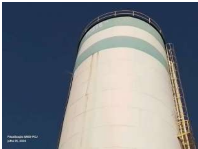
Foto 1 - Vazamento na estrutura metálica.
