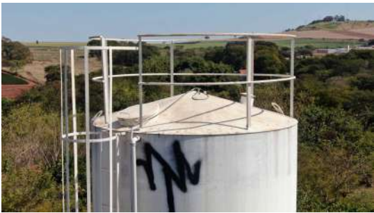
Foto 1 - Tubulação de ventilação no topo do reservatório.
