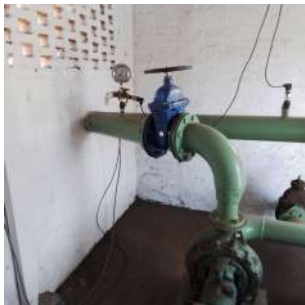
Foto 4 - Tubulação de recalque da elevatória.
