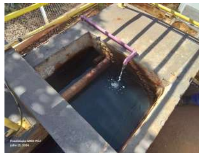
Foto 11 - Aplicação de hipoclorito de sódio na entrada de água bruta.
