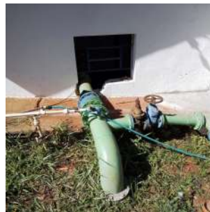
Foto 7 - Tubulação de recalque na saída da elevatória.
