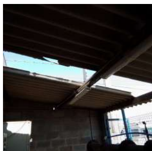
Foto 1 - Ausência de telhas na elevatória.
