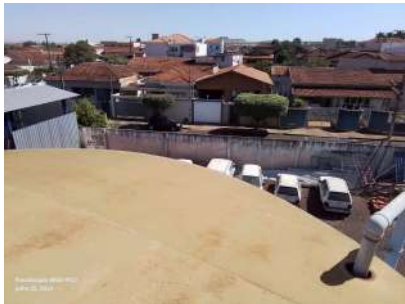
Foto 1 - Muro em uma das laterais.
