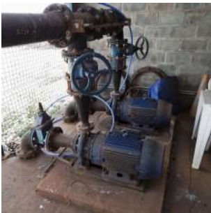
Foto 1 - Bombas da elevatória.
