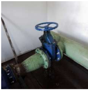
Foto 3 - Vazamento 1 em registro.
