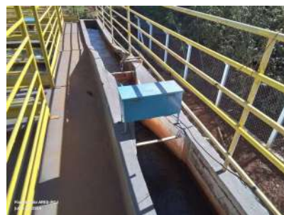
Foto 2 - Entrada com calha Parshall.
