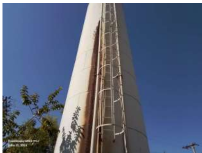
Foto 1 - Vazamentos na estrutura metálica.
