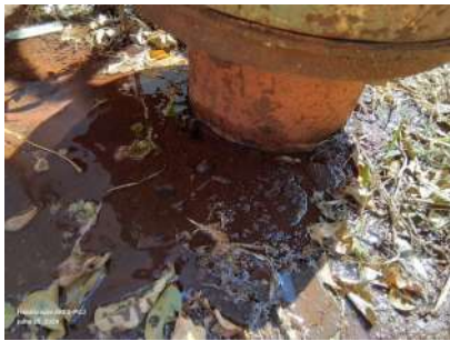
Foto 2 - Vazamento no subsolo da saída central de distribuição - detalhe.
