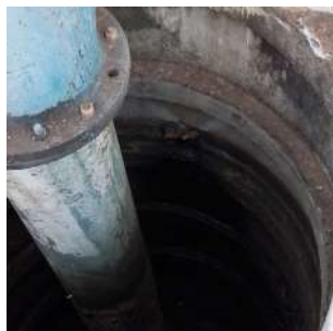
Foto 3 - Tubos para drenagem da água que acumula na captação, encaminhando-a para um dos poços de sucção.
