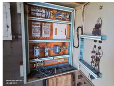
Foto 8 - Detalhe interno do painel de controle das bombas.
