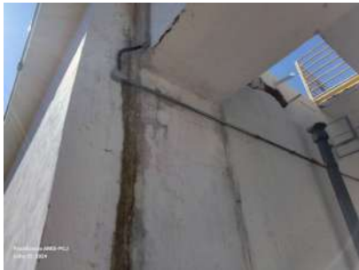
Foto 2 - Vazamento na alvenaria entre decantador 2 e calha para os filtros - ponto 1.
