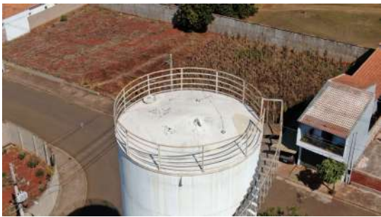
Foto 1 - Ausência de SPDA.
