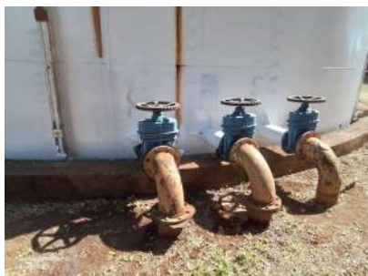
Foto 5 - Vista das saídas de distribuição.
