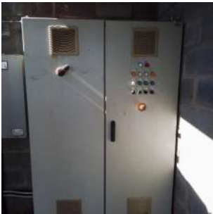
Foto 3 - Painel de comando das bombas.
