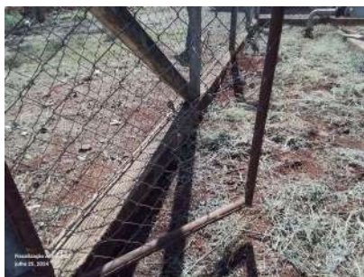
Foto 1 - Abertura na tela no portão de acesso.
