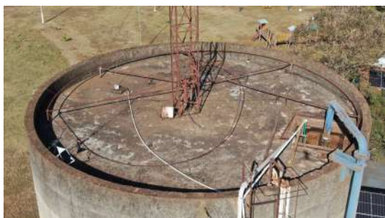
Foto 1 - Grade no lugar da tampa de inspeção.
