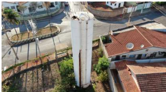
Foto 3 - Vazamentos na estrutura metálica.
