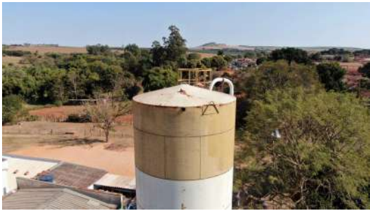
Foto 1 - Ausência de SPDA.
