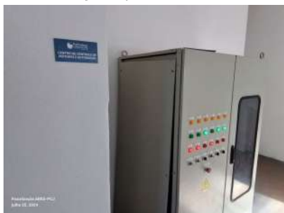
Foto 7 - Centro de controle de motores e automação - vista 2.
