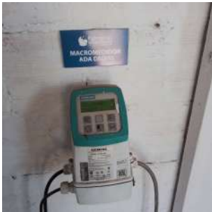
Foto 3 - Display do macromedidor.
