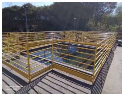
Foto 21 - Vista do decantador 2.
