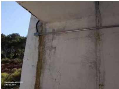
Foto 4 - Vazamento na alvenaria entre decantador 2 e calha para os filtros - ponto 1.
