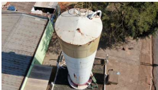
Foto 1 - Tampa de inspeção com corrosão.
