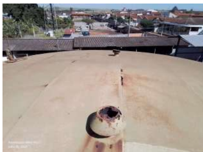
Foto 1 - Tubulação de ventilação.
