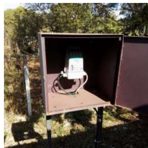
Foto 8 - Display do macromedidor.
