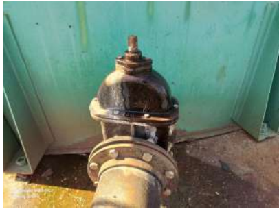
Foto 3 - Vazamento no registro.
