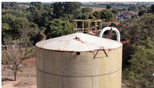
Foto 1 - Extravasor sem tela de proteção.
