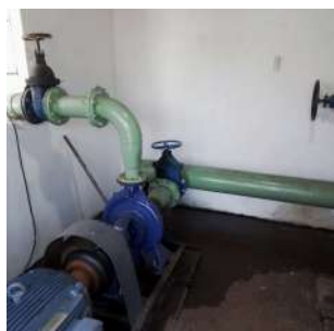
Foto 1 - Vazamento 1 em registro.
