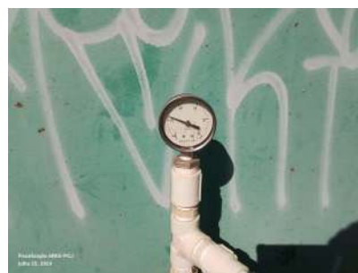
Foto 11 - Manômetro do reservatório.
