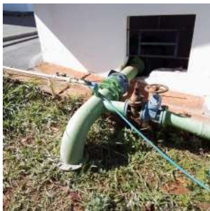
Foto 1 - Recalque das bombas.
