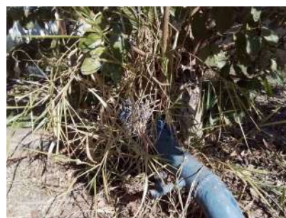
Foto 2 - Retirar vegetação da estrutura.
