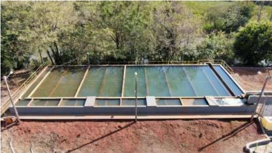
Foto 2 - Vista superior da ETA.
