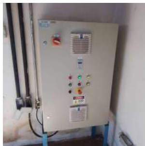
Foto 2 - Pannel de comando das bombas.
