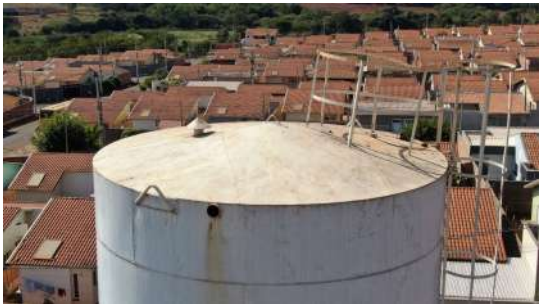
Foto 1 - Tubulação de ventilação no topo do reservatório.
