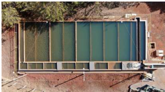
Foto 5 - Vista superior da ETA.
