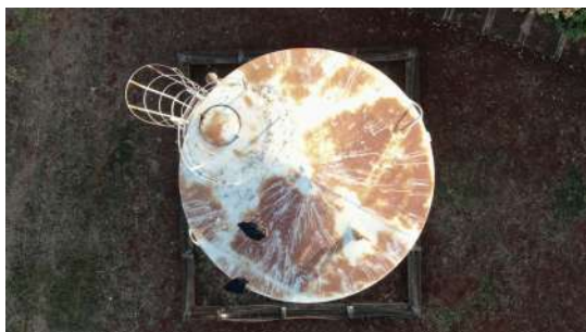
Foto 1 - Estrutura com oxidação.
