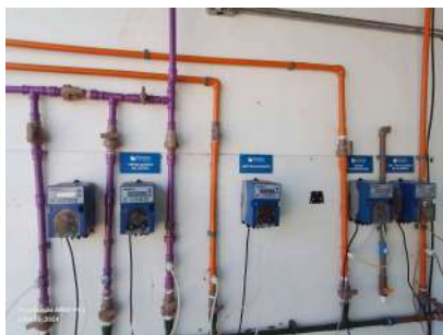
Foto 32 - Sistema de dosadoras automáticas da ETA - detalhe.
