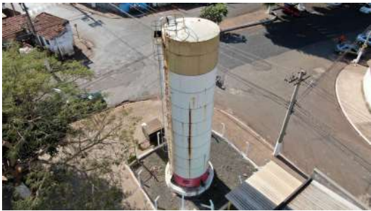
Foto 1 - Vazamento na estrutura metálica.
