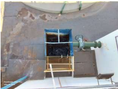
Foto 2 - Caixa de mistura para aplicação de fluor e cloro.
