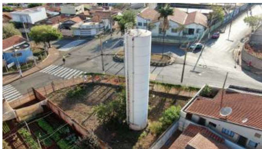
Foto 1 - Ausência de SPDA.
