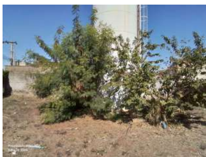
Foto 1 - Retirar vegetação da estrutura.
