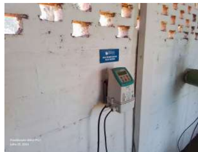
Foto 8 - Macromedidor EEA Ada Dedini.
