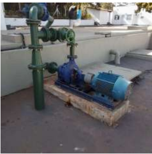
Foto 2 - Bomba da estação elevatória que recalca água sem flúor para o reservatório Varotti.
