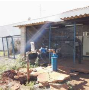
Foto 2 - Visão da elevatória, junto ao poço.
