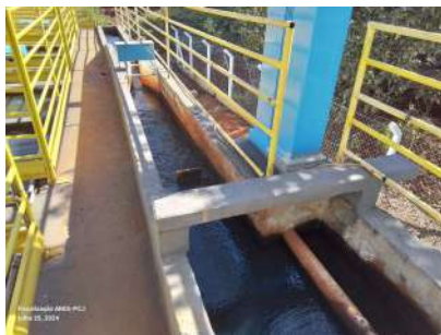
Foto 10 - Entrada de água bruta da represa.
