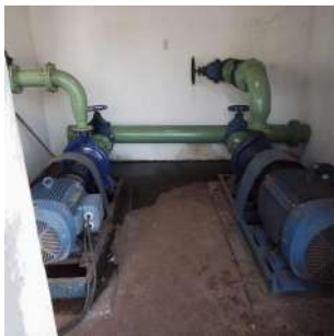
Foto 2 - Dois conjuntos motobombas instalados.
