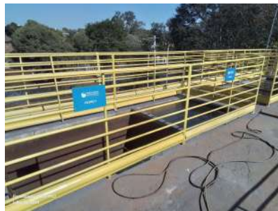
Foto 23 - Vista dos filtros 1 e 2.
