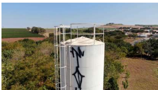
Foto 1 - Ausência de SPDA.
