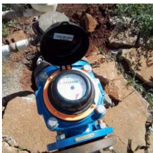
Foto 1 - Medidor de vazão na captação.
