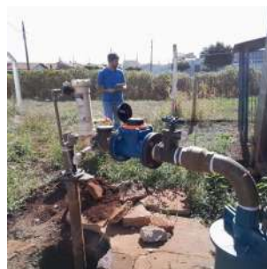
Foto 2 - Medidor de vazão no cavalete do poço.
