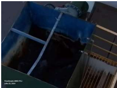
Foto 1 - Caixa de mistura para aplicação de fluor e cloro.
