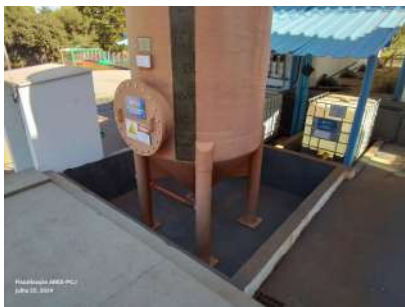
Foto 1 - Baia de detenção e reservação do PAC.
