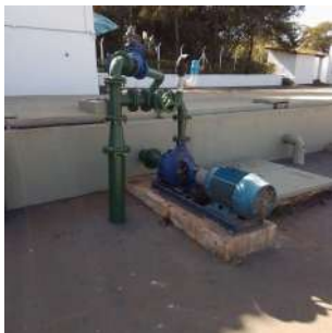
Foto 1 - Bomba da elevatória.
