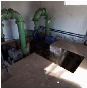
Foto 1 - Existe risco de queda no local, devendo ser adequado para segurança dos colaboradores.
