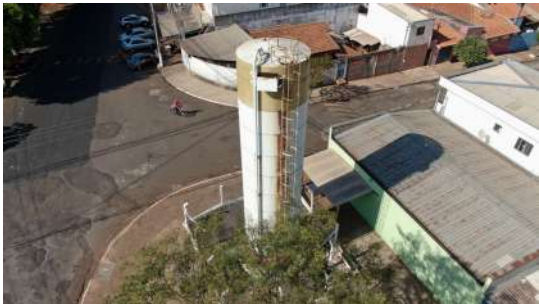
Foto 3 - Pontos de oxidação na lateral.
