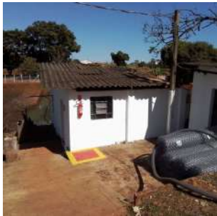
Foto 1 - A elevatória está sem porta.
