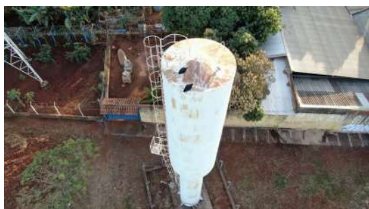
Foto 1 - Ausência de SPDA.
