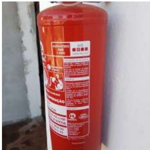
Foto 1 - Manutenção do extintor.
