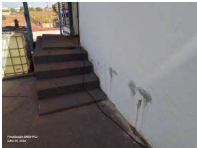
Foto 3 - Vazamento na alvenaria do decantador 1 junto à escada inferior de acesso ao vão com os filtros - ponto 3.
