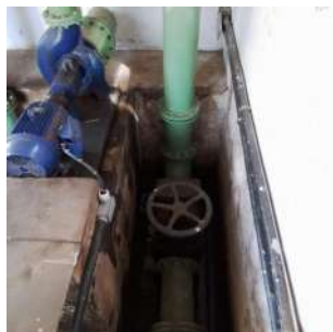
Foto 1 - A água de lubrificação das gaxetas escoa para o nível inferior e é drenada por tubos para um dos poços de sucção da própria elevatória.
