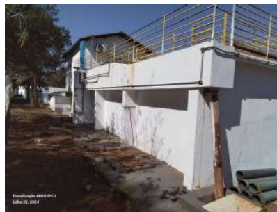
Foto 35 - Lateral da ETA - vista 2.
