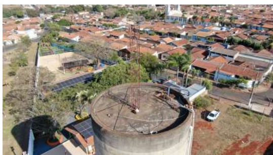
Foto 3 - Topo sem guarda-corpo.
