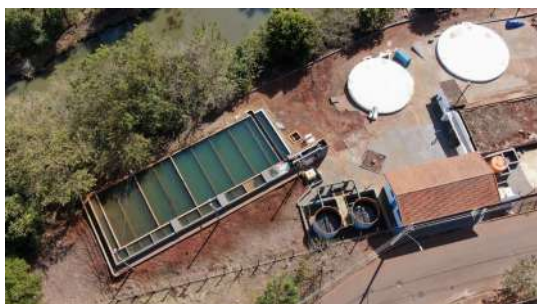
Foto 18 - Vista superior da ETA.
