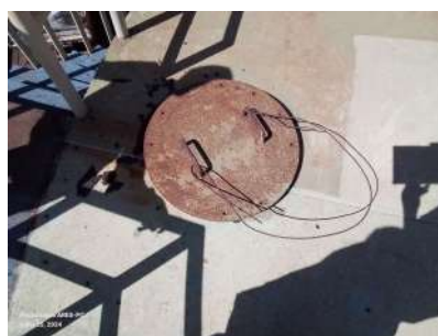
Foto 2 - Tampa oxidada e solta.
