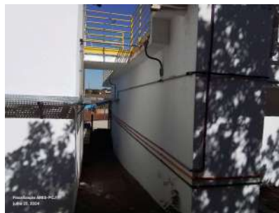
Foto 37 - Lateral da ETA - vista 4.
