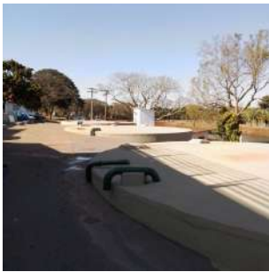
Foto 4 - Vista dos três reservatórios semienterrados.
