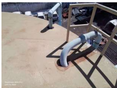
Foto 1 - Aberturas nas entradas de tubulações.
