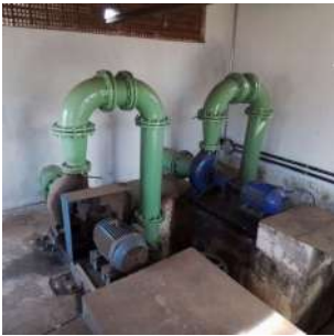
Foto 1 - Interior da captação.
