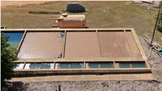
Foto 1 - Vista superior da ETA.
