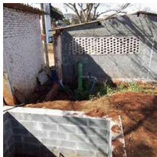
Foto 6 - Tubulação de recalque na saída da elevatória.
