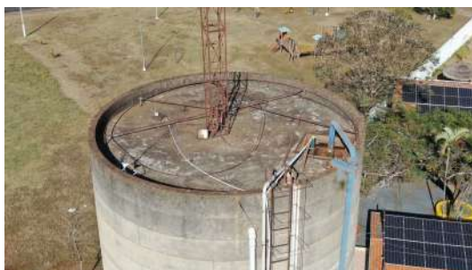
Foto 2 - Grade no lugar da tampa de inspeção.
