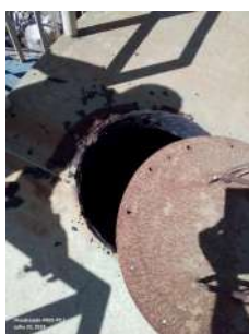
Foto 1 - Base da tampa corroída.
