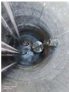
Foto 1 - Cesto no interior do poço.
