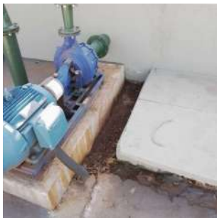
Foto 1 - Atualmente a água de drenagem da gaxeta acumula ao lado de uma caixa de passagem. O prestador prevê a instalação de tubulação para encaminhar diretamente para o interior da caixa.
