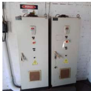
Foto 2 - Painéis das bombas.
