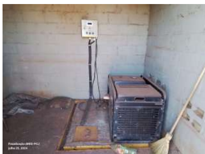
Foto 5 - Gerador de energia desativado.
