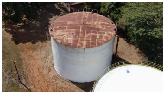
Foto 1 - Ausência de tubulação de ventilação.
