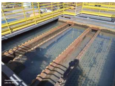
Foto 1 - Vertedores do decantador 1 sem verter água após retrolavagem do filtro 1.
