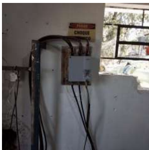
Foto 4 - Soft Starter para partida das bombas.
