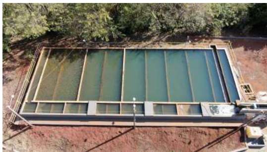
Foto 3 - Vista superior da ETA.
