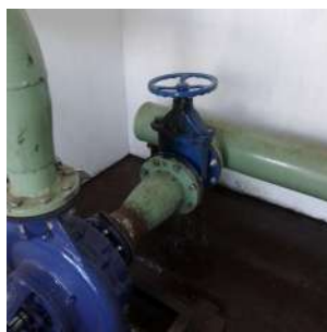
Foto 2 - Vazamento 1 em registro.
