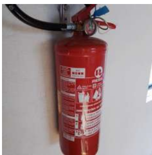
Foto 1 - Indicação da manutenção do extintor.
