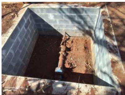
Foto 7 - Existem dois macromedidores de saída: EEA Ada Dedini.
