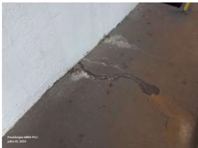
Foto 6 - Vazamento na alvenaria entre decantadores e calha para os filtros - ponto 2.
