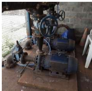
Foto 1 - Dois conjuntos motobomba instalados no local.
