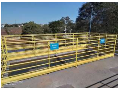
Foto 24 - Vista dos filtros 3 e 4.
