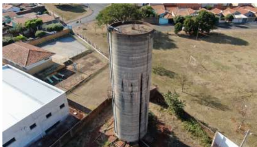
Foto 2 - Vazamentos na estrutura de concreto.
