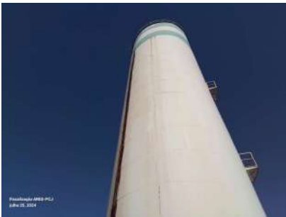
Foto 2 - Vazamento na estrutura metálica.
