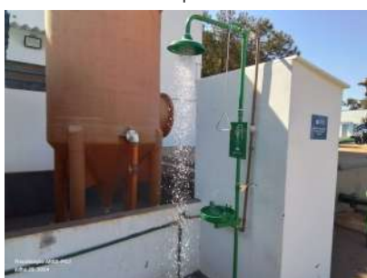
Foto 3 - Chuveiro em funcionamento.
