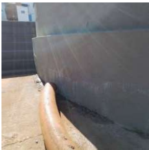
Foto 4 - Vazamentos na alvenaria.
