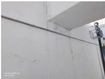
Foto 5 - Vazamento na alvenaria entre decantadores e calha para os filtros - ponto 2.
