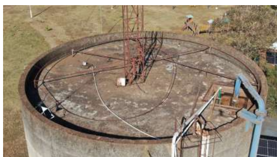
Foto 1 - Ausência de tubulação de ventilação.
