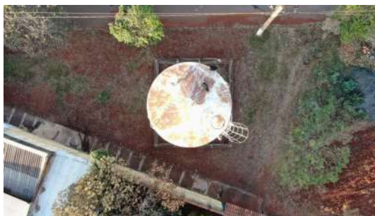
Foto 2 - Estrutura com oxidação.
