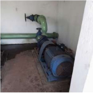
Foto 3 - Interior da elevatória.
