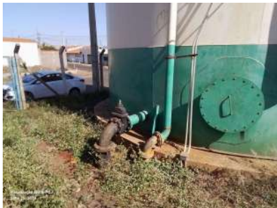
Foto 4 - Vista da entrada do poço Varotti 1e saída para EEA Varotti.
