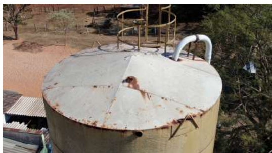
Foto 1 - Tubo de ventilação.
