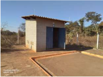
Foto 4 - Abrigo do painel de comando da elevatória.
