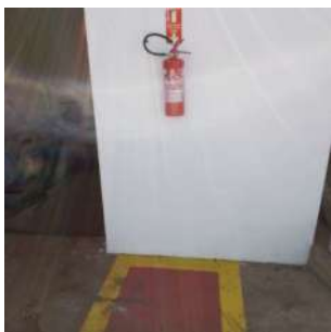
Foto 1 - Extintor de incêndio na elevatória.
