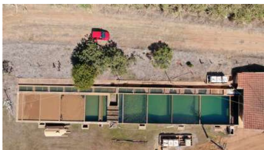
Foto 3 - Vista superior da ETA.
