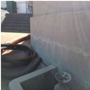
Foto 2 - Vazamentos na alvenaria.
