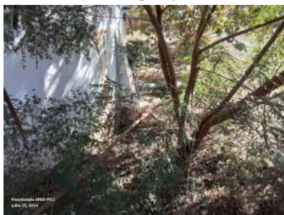
Foto 3 - Retirar vegetação da estrutura.
