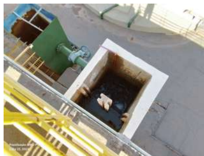
Foto 27 - Saída dos filtros com aplicação de ortopolifosfato - evita precipitação de manganês na rede.
