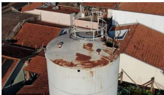
Foto 4 - Parte superior com oxidação.
