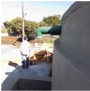
Foto 1 - Tubo extravasor em um dos reservatórios.
