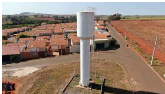
Foto 2 - Ausência de SPDA.
