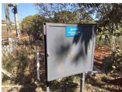
Foto 5 - Existem dois macromedidores de saída: EEA Talamoni.
