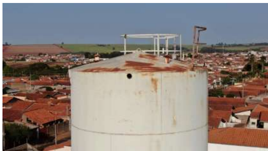
Foto 1 - Extravasador sem tela de proteção.
