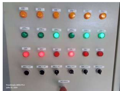
Foto 6 - Centro de controle de motores e automação - detalhe do painel de controle.
