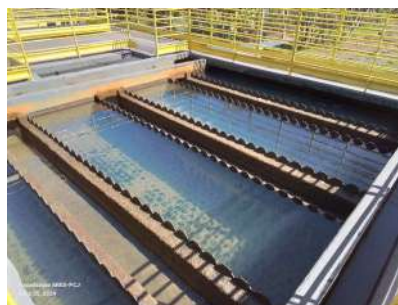
Foto 2 - Vertedores do decantador 2 sem verter água após retrolavagem do filtro 1.
