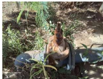
Foto 2 - Vazamento no registro.
