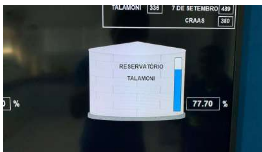
Foto 2 - Detalhe do CCO para o reservatório.
