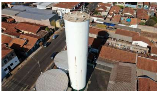
Foto 2 - Vazamento na estrutura metálica.
