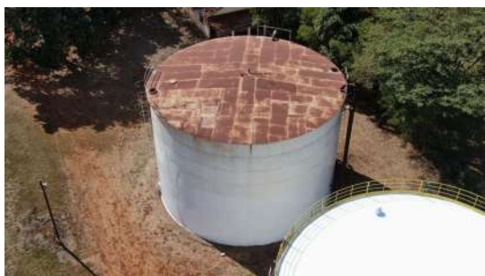
Foto 1 - Tampas de inspeção abertas.
