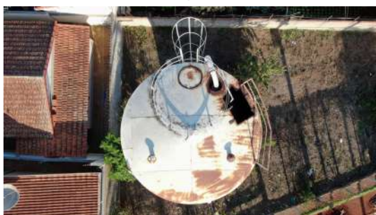
Foto 5 - Topo com oxidação.
