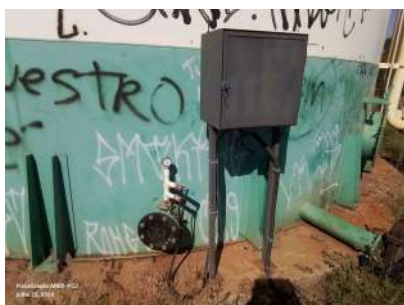
Foto 10 - Vista do sistema de telemetria.
