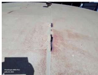
Foto 4 - Aberturas por corrosão.
