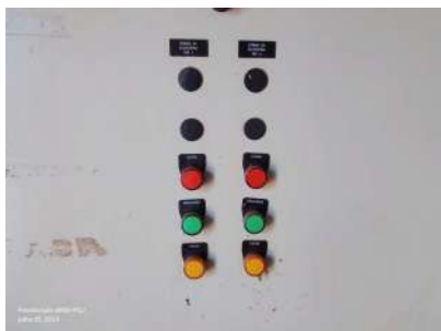
Foto 7 - Detalhe do painel de controle das bombas.
