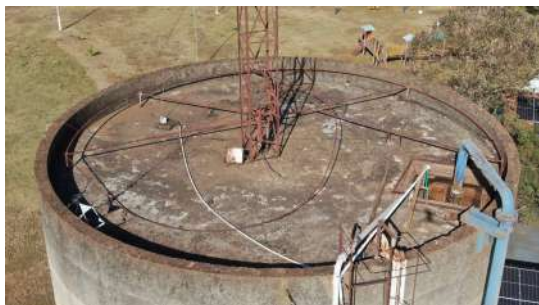
Foto 1 - Grade no lugar da tampa de inspeção sem proteção.
