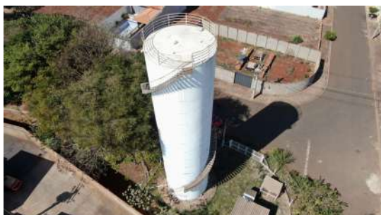
Foto 1 - Ausência de tela de proteção no extravasor e respiro.
