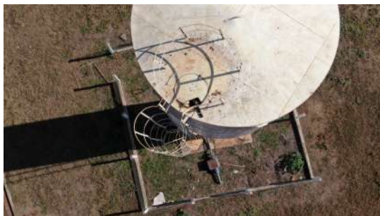
Foto 1 - Tampa de inspeção com abertura para contaminação.
