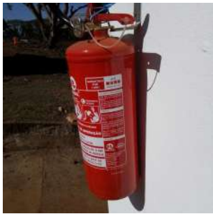
Foto 1 - Validade do extintor.
