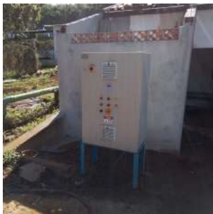
Foto 6 - Painel de controle das bombas, que posteriormente será abrigado na ampliação em execução.
