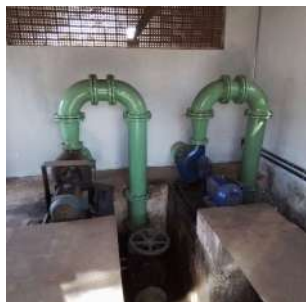
Foto 1 - Dois conjuntos motobomba instalados.
