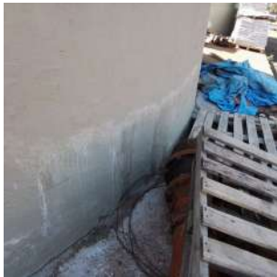
Foto 1 - Vazamentos na alvenaria.
