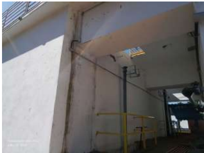
Foto 1 - Vazamento na alvenaria entre decantador 2 e calha para os filtros - ponto 1.
