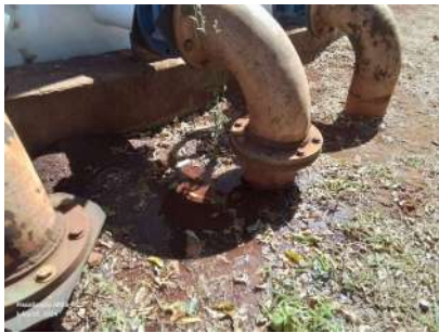
Foto 1 - Vazamento no subsolo da saída central de distribuição.
