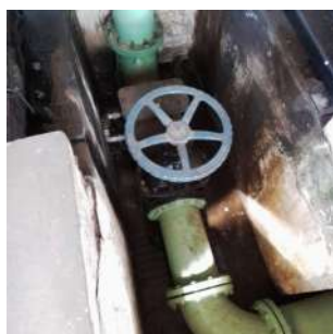
Foto 1 - Vazamento verificado em um registro.
