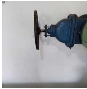
Foto 4 - Vazamento 2 em registro.
