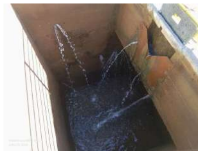
Foto 29 - Vazamentos internos no filtro 1.
