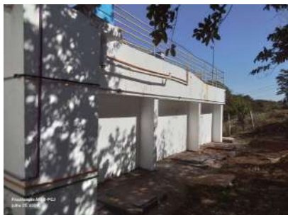
Foto 36 - Lateral da ETA - vista 3.
