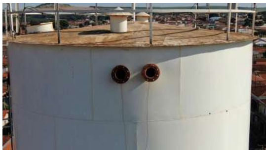
Foto 1 - Extravadores sem tela de proteção.
