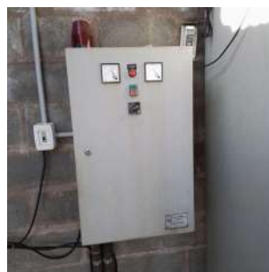
Foto 2 - Painel elétrico da bomba
