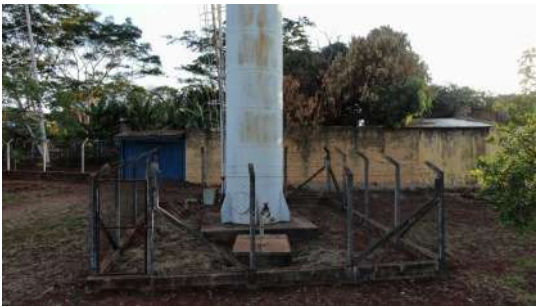
Foto 4 - Estrutura com oxidação.
