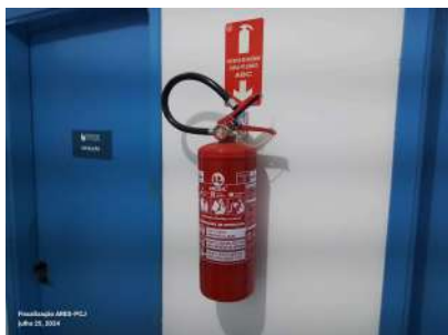
Foto 1 - Extintor do laboratório.
