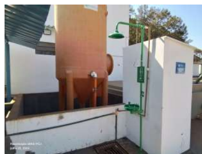
Foto 2 - Vista inferior do chuveiro.
