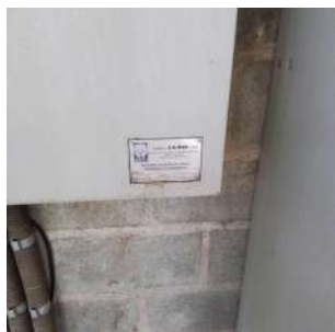
Foto 3 - Painel elétrico da bomba
