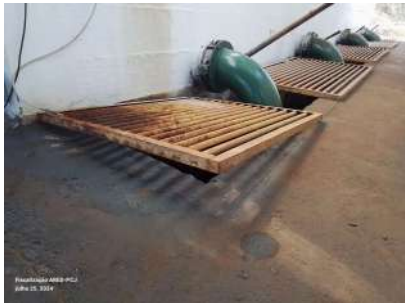
Foto 4 - Grade de proteção solta no vão entre os decantadores e filtros.
