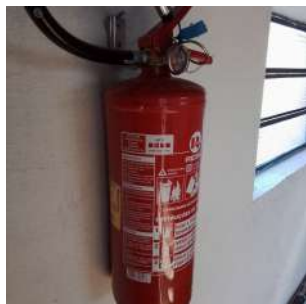
Foto 3 - Extintor na captação.
