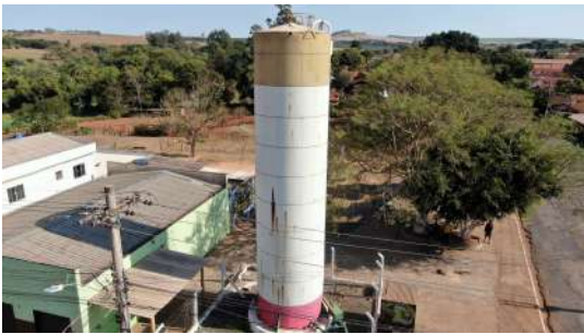
Foto 2 - Vazamento na estrutura metálica.
