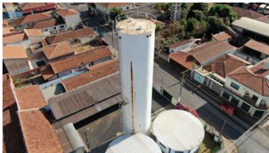
Foto 4 - Vazamento na estrutura metálica.
