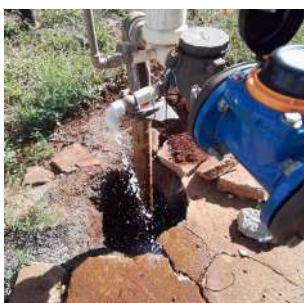
Foto 1 - Torneira para coleta de água bruta.
