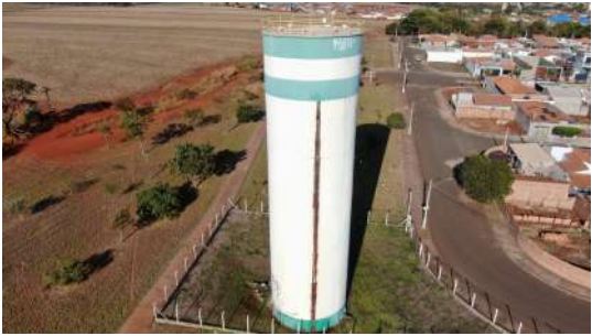
Foto 4 - Vazamento na estrutura metálica.
