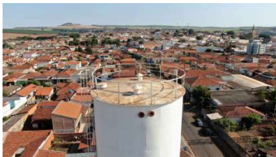
Foto 1 - Ausência de SPDA.
