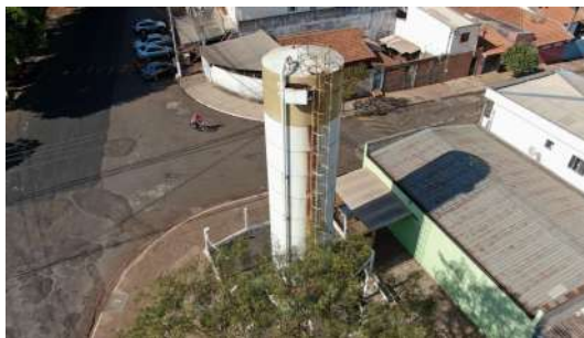
Foto 2 - Tampa de inspeção sem vedação lateral.
