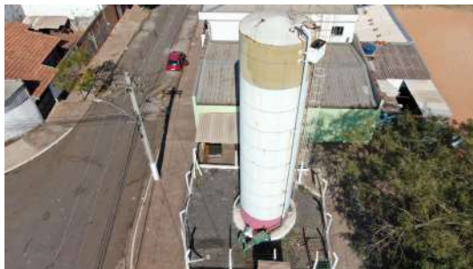
Foto 4 - Caixa com boia aberta no topo e sem proteção contra contaminação.
