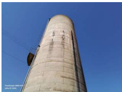
Foto 1 - Vazamentos na estrutura de concreto.
