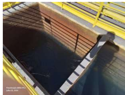
Foto 15 - Filtro 1 em processo de esgotamento para lavagem.
