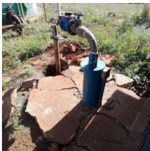
Foto 1 - Laje de concreto rachada.
