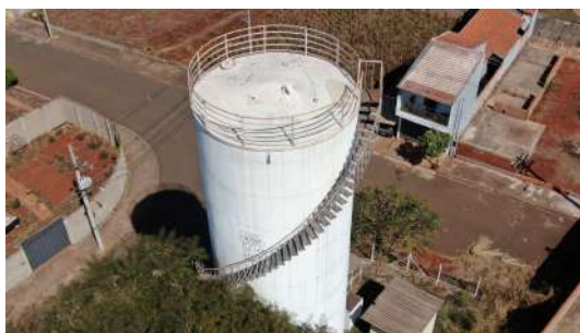
Foto 2 - Ausência de tela de proteção no extravasor e respiro.
