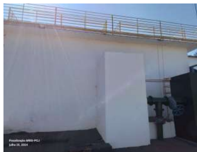
Foto 33 - Vista externa da dosagem de orto e cloro e fluor na saída dos filtros.
