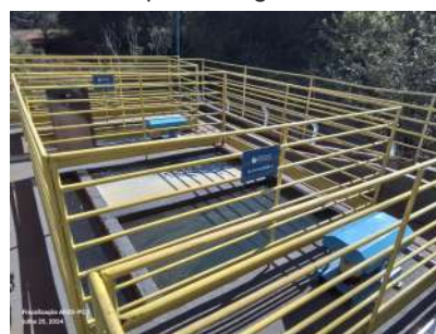
Foto 17 - Vista do floculador 2 (agitação média).
