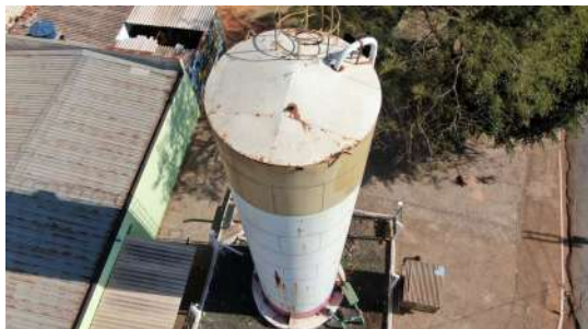
Foto 3 - Entrada de tubulação no topo sem tela de proteção.
