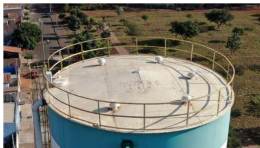
Foto 2 - Tubulação de ventilação.
