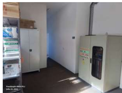
Foto 4 - Centro de controle de motores e automação - vista 1.
