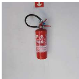
Foto 2 - Extintor na captação.
