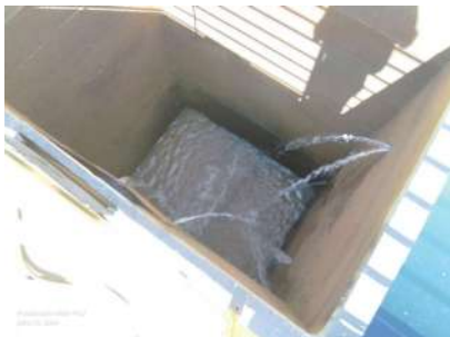
Foto 22 - Filtro 1 em processo de retrolavagem.
