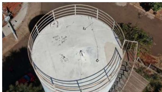
Foto 2 - Tubo de ventilação.
