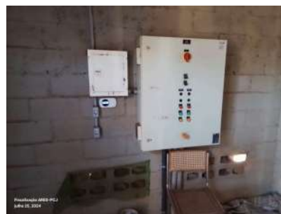
Foto 6 - Painel de controle das bombas.
