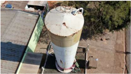
Foto 2 - Pontos de oxidação no topo.
