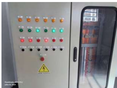
Foto 5 - Centro de controle de motores e automação - painel de controle.
