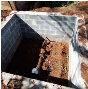
Foto 5 - Macromedidor no recalque.
