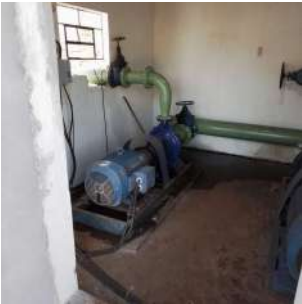
Foto 2 - Interior da elevatória.
