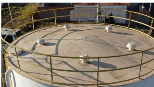
Foto 1 - Tubulação de ventilação.
