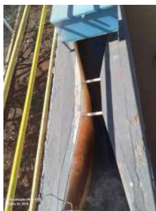
Foto 12 - Calha Parshall na entrada.
