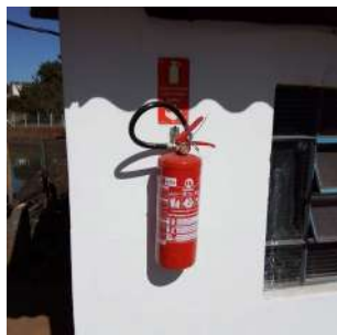
Foto 1 - Extintor na elevatória.
