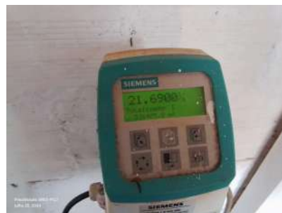
Foto 9 - Macromedidor EEA Ada Dedini.
