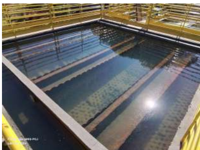
Foto 26 - Canaletas afogadas no decantador 2 devido à retrolavagem do filtro 1.
