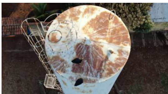
Foto 1 - Tampa com oxidação e sem vedação contra entrada de escoamento superficial..
