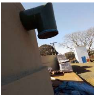
Foto 1 - Telas de proteção no tubo extravasor.
