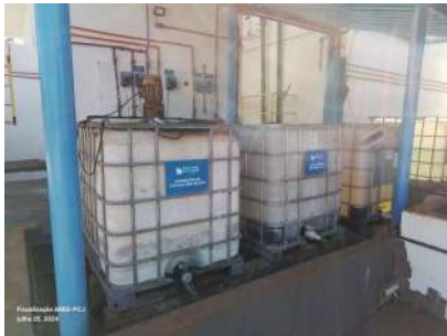
Foto 4 - Baia de detenção e 2 containers de hipoclorito e 1 de geocálcio.
