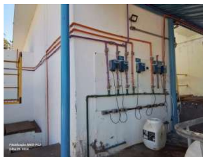
Foto 31 - Sistema de dosadoras automáticas da ETA.
