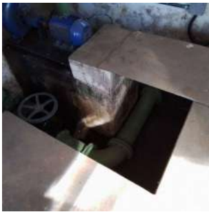
Foto 2 - Desnível acentuado na elevatória.
