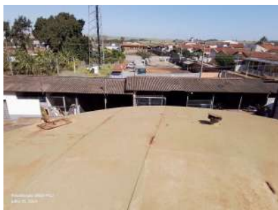
Foto 3 - Abertura na tubulação de respiro corroída.
