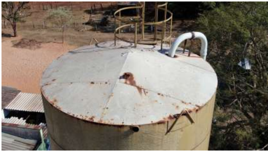
Foto 1 - Tubo de ventilação corroído.
