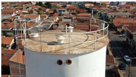
Foto 2 - Extravadores sem tela de proteção.
