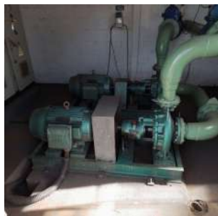
Foto 1 - Dois conjuntos motobomba instalados.
