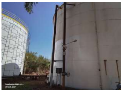
Foto 1 - Tubo extravasor do reservatório.
