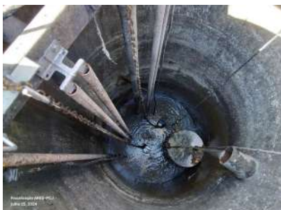
Foto 1 - Dois conjuntos moto-bombas instalados.
