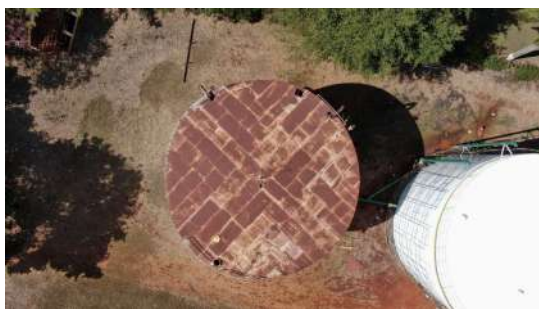
Foto 1 - Aberturas sem proteção.
