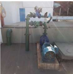
Foto 2 - Bomba da elevatória junto ao reservatório Blend.
