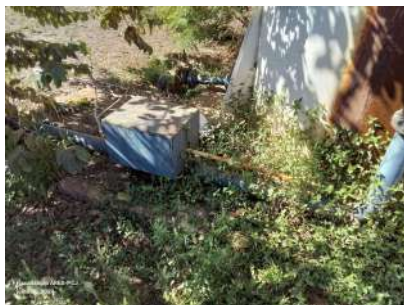
Foto 1 - Válvula que controla a entrada de água com boia.
