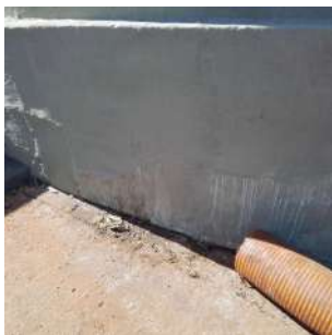
Foto 5 - Vazamentos na alvenaria.
