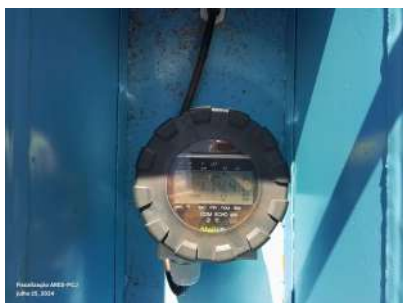
Foto 1 - Macromedidor automático na entrada.
