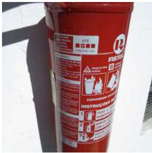
Foto 2 - Manutenção do extintor.
