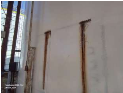
Foto 3 - Vazamento na estrutura metálica do reservatório.
