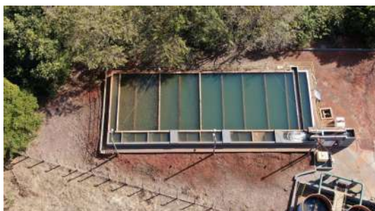
Foto 17 - Vista superior da ETA.
