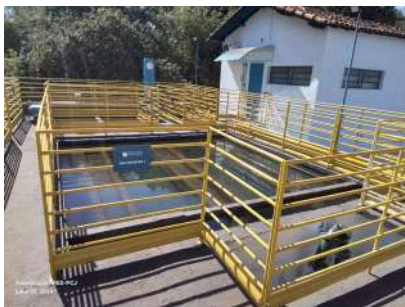
Foto 20 - Vista do decantador 1.
