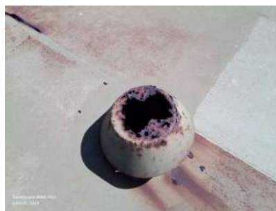
Foto 2 - Abertura na tubulação de respiro corroída.
