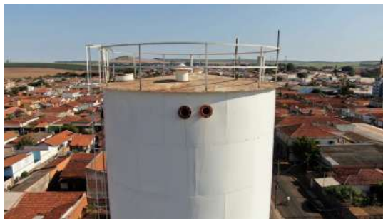
Foto 2 - Ausência de SPDA.
