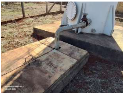
Foto 5 - Vista da saída de distribuição.
