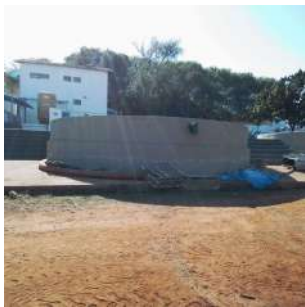
Foto 3 - Reservatório onde foram verificados vazamentos.
