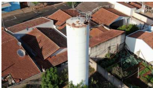
Foto 2 - Ausência de SPDA.
