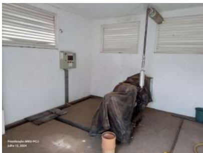
Foto 3 - Gerador de energia desativado.
