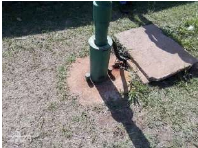
Foto 1 - Ausência de laje de proteção.
