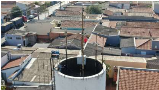
Foto 1 - Captor Franklin do reservatório desativado ao lado.
