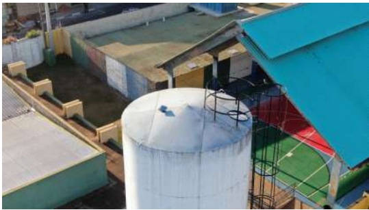
Foto 1 - Tamba de inspeção sem encaixe.
