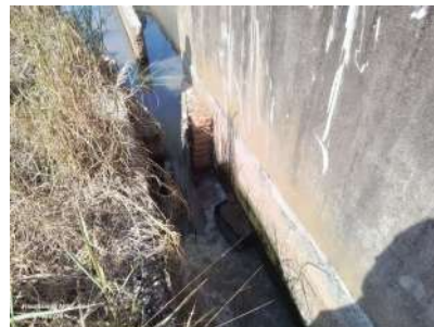
Foto 10 - Calha Parshall quebrada no preliminar.
