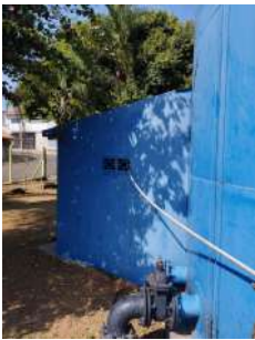
Foto 2 - Tubulação de dosagem automática.
