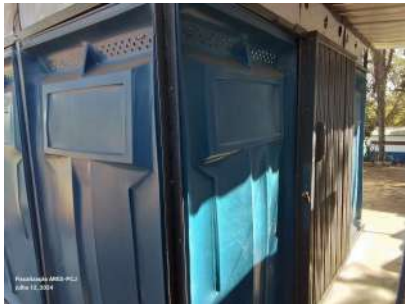
Foto 2 - Abrigo das dosadoras de produto químico.
