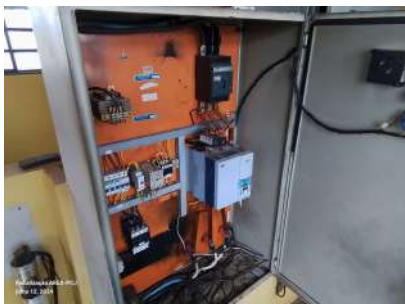
Foto 4 - Detalhe interno do painel elétrico do poço CBT Vila Bandeirantes.
