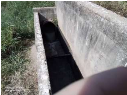
Foto 5 - Chegada do esgoto no preliminar.
