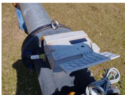
Foto 1 - Macromedidor do poço.
