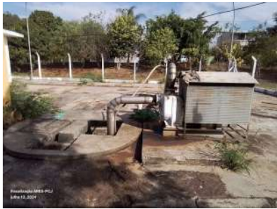
Foto 1 - Único conjunto moto-bomba.
