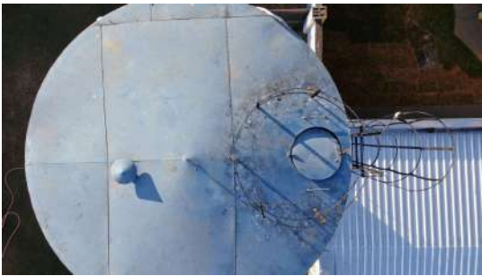
Foto 2 - Tamba de inspeção sem encaixe.
