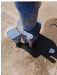
Foto 1 - Tubo de nível do poço.
