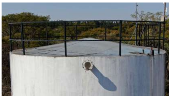
Foto 1 - Tela de proteção na tubulação de ventilação.
