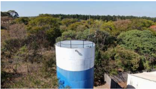
Foto 1 - Medidor de nível em vermelho.
