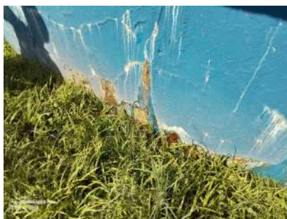
Foto 3 - Vazamento na alvenaria em toda lateral do reservatório.
