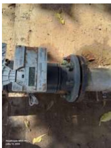
Foto 1 - Macromedidor do poço.
