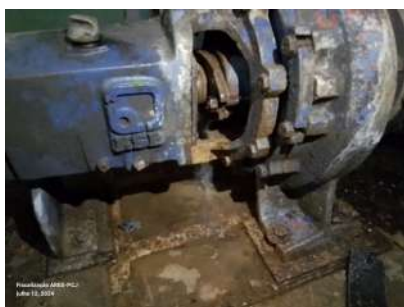
Foto 1 - Água de lubrificação da gaxeta - bomba 1.
