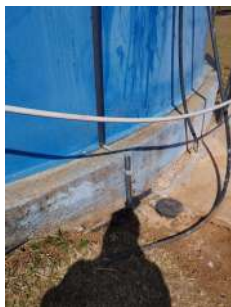
Foto 3 - SPDA do reservatório - aterramento.
