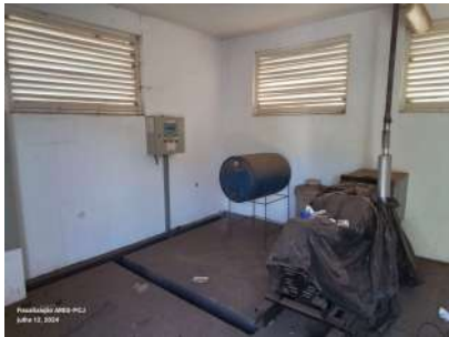
Foto 2 - Gerador de energia desativado.
