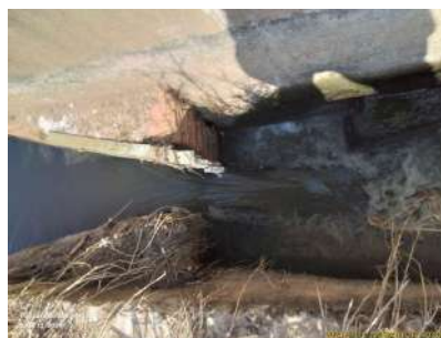
Foto 2 - Calha Parshall do preliminar quebrada.
