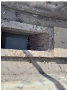
Foto 2 - Grade fina com acúmulo de sujeira.
