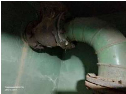
Foto 1 - Válvula com vazamento no recalque da bomba 1.
