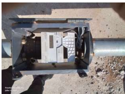
Foto 1 - Macromedidor do poço.
