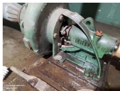
Foto 4 - Água de lubrificação da gaxeta - bomba 2.
