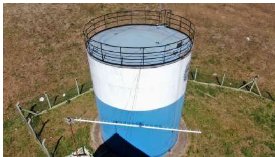
Foto 1 - Captor Franklin do SPDA sobre a escada.
