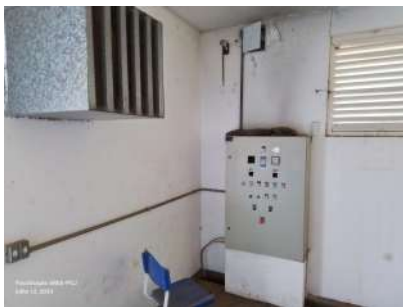
Foto 3 - Painel para acionamento do gerador de energia.
