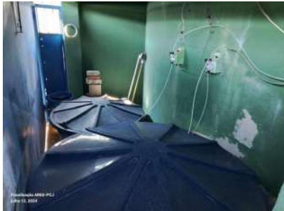
Foto 2 - Sistema de dosagem química.
