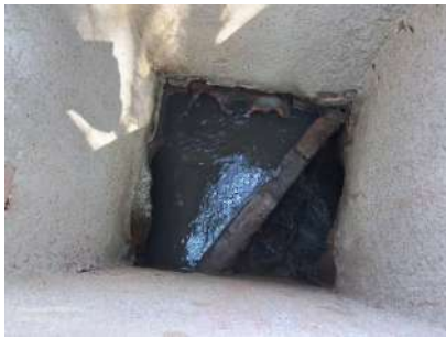
Foto 17 - Distribuição das lagoas 1 e 2 para a facultativa e bypass.
