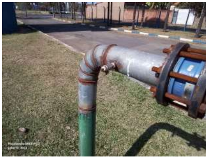
Foto 1 - Ausência de registro para tomada de água bruta.
