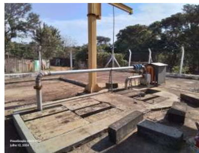
Foto 4 - Vista interna da EEEB.
