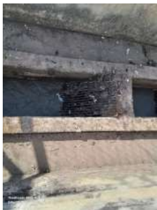
Foto 1 - Grade grossa com acúmulo de sujeira.
