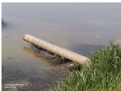
Foto 19 - Substituir os tubos rachados na lagoa anaeróbia 2.
