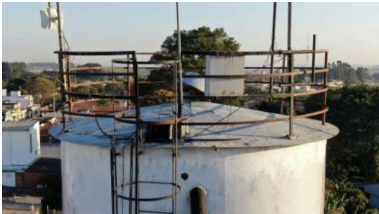
Foto 1 - Base da tampa de inspeção corroida.
