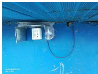
Foto 2 - Medidor de nível.
