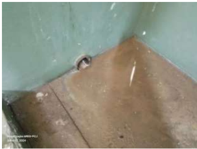
Foto 5 - Saída da água acumulada no piso da EEAT.
