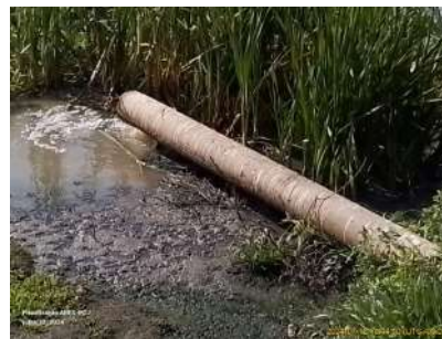
Foto 6 - Substituir os tubos rachados na lagoa anaeróbia 1.
