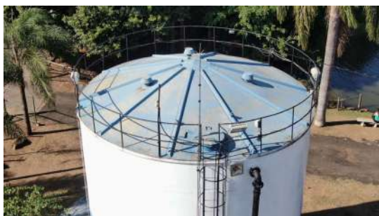
Foto 1 - Tela de proteção no extravasor.
