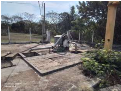
Foto 5 - Vista interna da EEEB.
