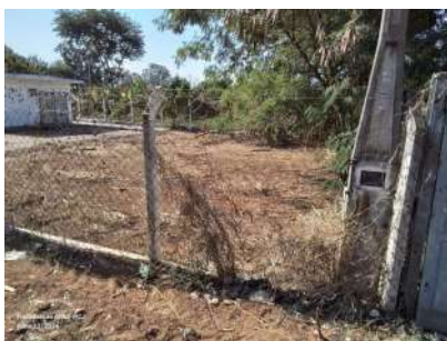
Foto 1 - Alambrado danificado junto ao relógio de energia.
