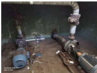
Foto 1 - Dois conjuntos moto bombas.
