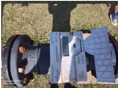
Foto 1 - Macromedidor do poço.
