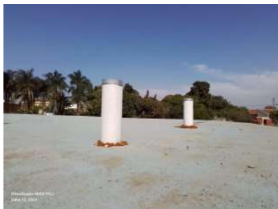
Foto 1 - Tubulações de ventilação.
