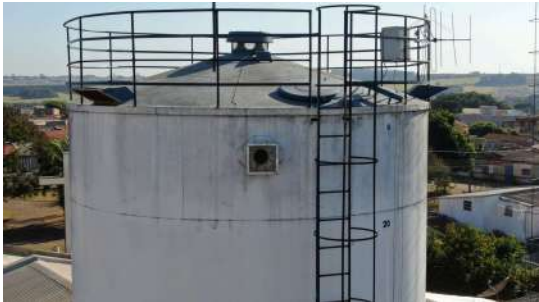
Foto 1 - Ventilação no topo.
