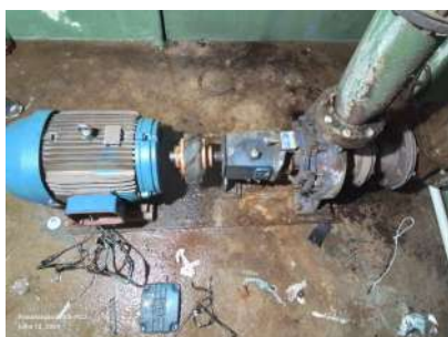
Foto 3 - Água de lubrificação da gaxeta - bomba 1.
