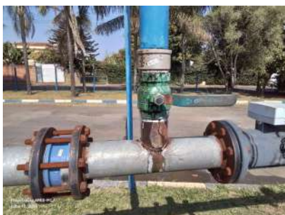
Foto 1 - Registro com vazamento.
