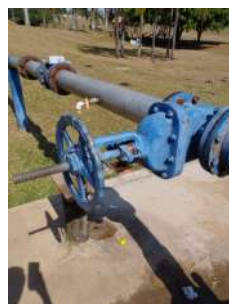
Foto 2 - Vazamento no registro.
