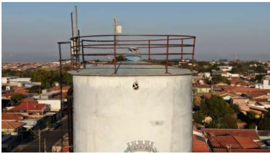
Foto 1 - Extravasor sem tela de proteção.
