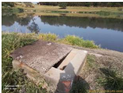
Foto 9 - Fechar as caixas de passagem abertas para limpeza - lagoa anaeróbia 1, saída 1.
