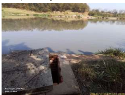
Foto 11 - Fechar as caixas de passagem abertas para limpeza - lagoa anaeróbia 2, saída 1.
