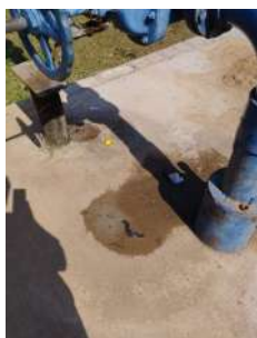
Foto 1 - Vazamento no registro - detalhe.
