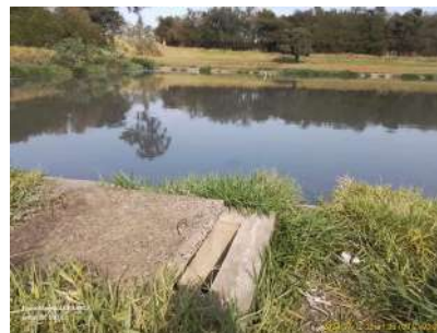
Foto 10 - Fechar as caixas de passagem abertas para limpeza - lagoa anaeróbia 1, saída 2.
