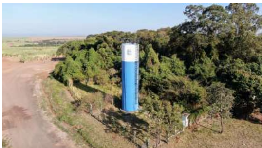
Foto 1 - SPDA do reservatório.
