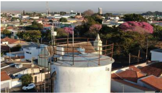
Foto 2 - Ausência de condutor de descarga do SPDA.
