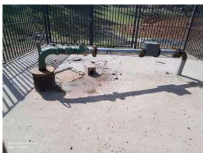
Foto 1 - Vazamento no cavalete.
