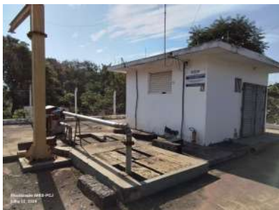
Foto 6 - Vista interna da EEEB.
