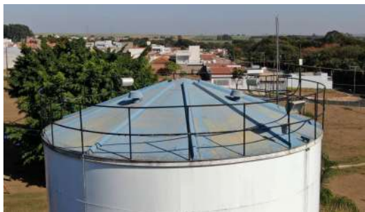
Foto 4 - SPDA do reservatório - Captor Franklin.
