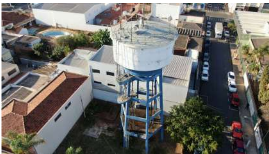
Foto 1 - Guarda-corpo nas escadas e topo.
