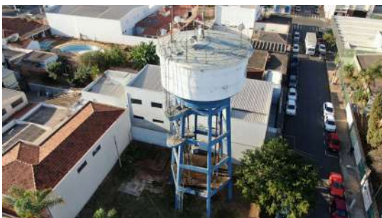
Foto 1 - SPDA com captor instalado ao lado direito da escada.
