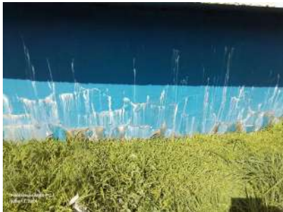
Foto 2 - Vazamento na alvenaria em toda lateral do reservatório.
