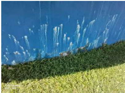
Foto 1 - Vazamento na alvenaria em toda lateral do reservatório.
