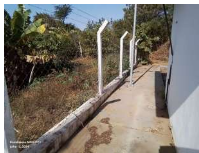
Foto 2 - Alambrado danificado atrás do abrigo do gerador de energia.
