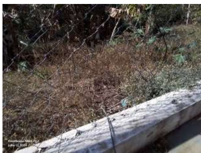
Foto 3 - Alambrado danificado atrás do abrigo do gerador de energia. - detalhe
