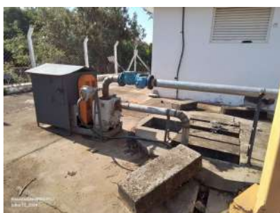
Foto 1 - Único conjunto moto-bomba.
