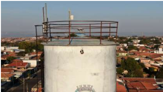
Foto 1 - Ausência de tela de proteção no extravasor.
