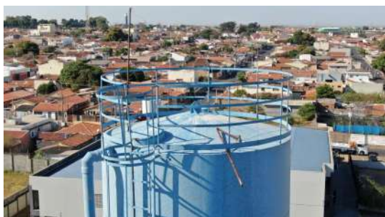
Foto 1 - Inexistência de captor do SPDA.
