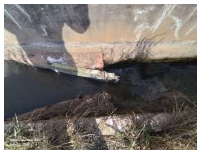
Foto 8 - Calha Parshall quebrada no preliminar.
