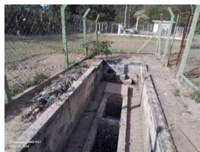
Foto 2 - Vista geral do sistema de gradeamento.
