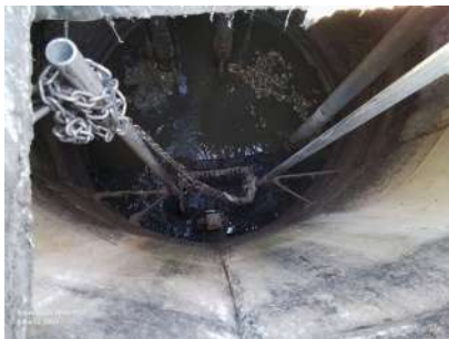
Foto 1 - Esgoto passando pelo lado do cesto devido ao acúmulo de sujeira.
