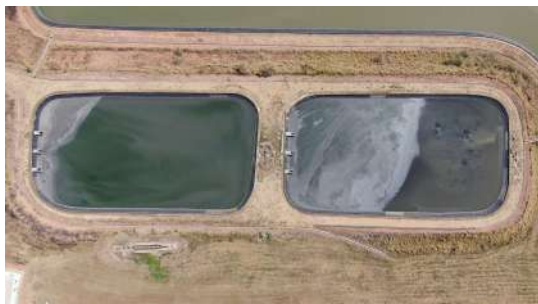
Foto 9 - Vista geral da ETE.
