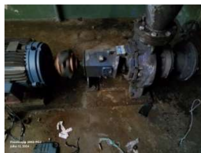
Foto 2 - Água de lubrificação da gaxeta - bomba 1.
