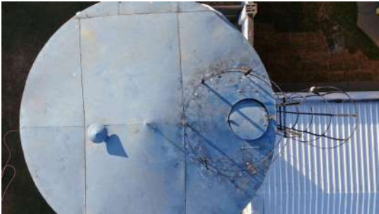
Foto 2 - Tubulação de ventilação no topo.
