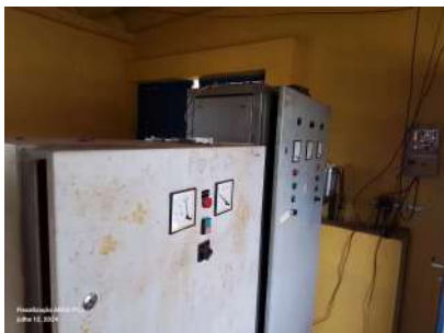
Foto 3 - Detalhe externo dos painéis elétricos.
