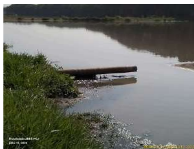
Foto 20 - Substituir os tubos rachados na lagoa anaeróbia 2.
