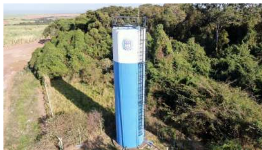
Foto 2 - SPDA do reservatório.
