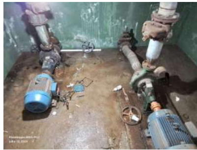
Foto 6 - Piso da EEAT todo molhado.
