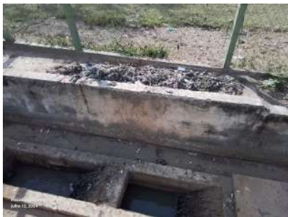
Foto 1 - Resíduos na lateral do sistema de gradeamento.
