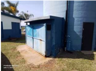
Foto 1 - Abrigo do sistema de dosagem química no reservatório elevado.
