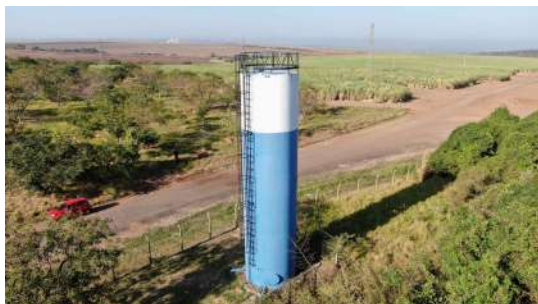
Foto 1 - Tubos extravasores sem tela.
