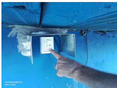
Foto 1 - Medidor de nível.
