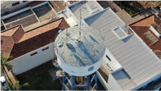
Foto 1 - Buraco na parte central junto à antena.
