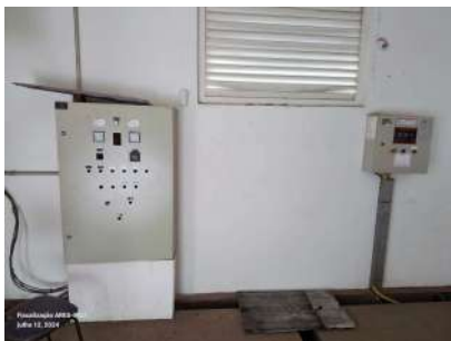
Foto 4 - Painel para acionamento do gerador de energia.
