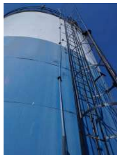
Foto 2 - SPDA do reservatório - condutor ao aterramento.
