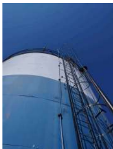
Foto 1 - SPDA do reservatório - Captor Franklin.
