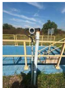
Foto 2 - Macromedidor da saída
