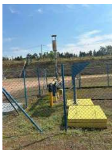
Foto 7 - Sistema queimador de gás
