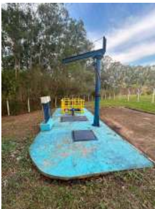
Foto 4 - Vista da elevatória
