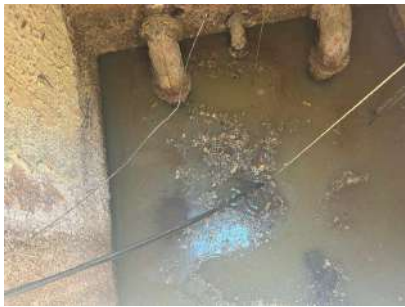
Foto 1 - Vazamentos e infiltração
