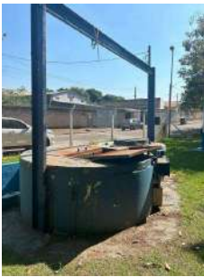
Foto 6 - Vista da elevatória
