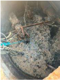
Foto 1 - Poço de sucção indicando bomba paralisada
