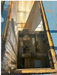
Foto 1 - Tampas sem manutenção
