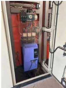
Foto 7 - Paineis de acionamento
