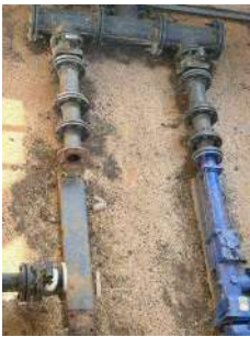
Foto 4 - Bomba de lodo dos reatores UASB sem reserva
