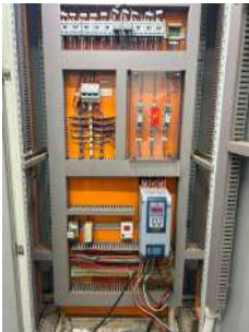
Foto 7 - Vista do painel de acionamento
