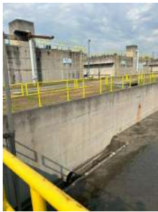
Foto 3 - Esgoto bruto vertendo
