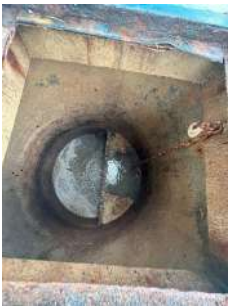
Foto 1 - Cesto trabalhando afogado devido a ausencia de limpeza
