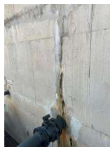
Foto 4 - Rachadura na parede
