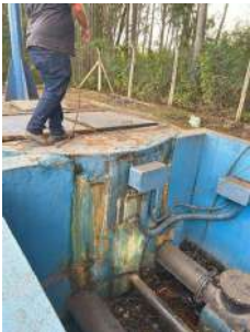
Foto 3 - Barrilete da Elevatória
