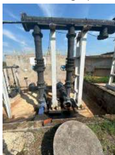
Foto 3 - Bombeamento de recirculação de lodo sem reserva
