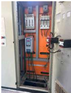
Foto 7 - Painel de acionamento
