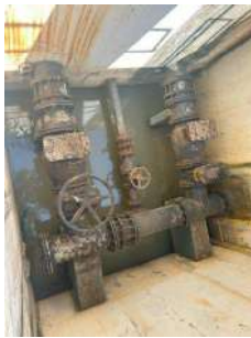
Foto 3 - Barrilete da Elevatória
