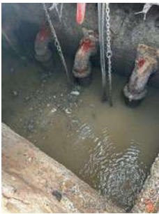
Foto 6 - Poço de sucção
