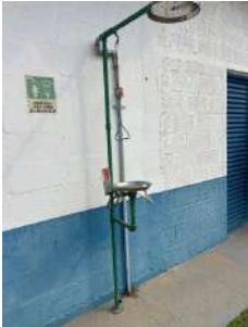
Foto 24 - Chuveiro de emergência
