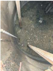
Foto 6 - Poço de sucção
