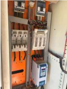
Foto 6 - Painel de acionamento
