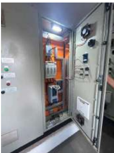
Foto 5 - Painel de acionamento
