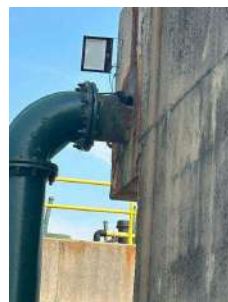
Foto 6 - Oxidação do tubo e vazamento
