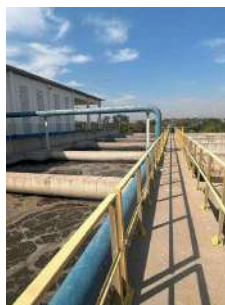
Foto 15 - Tanques de aeração 2
