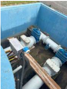
Foto 2 - Barrilete da EEEB
