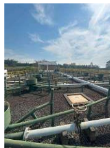
Foto 8 - Válvulas em péssimo estado de conservação
