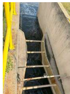
Foto 6 - Canal de entrada com medidor de vazão
