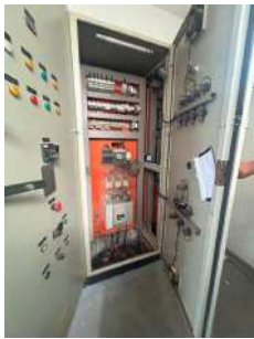
Foto 7 - Painel de acionamento
