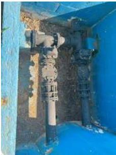
Foto 3 - Barrilete da Elevatória
