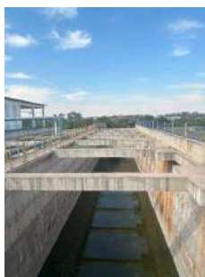
Foto 13 - Módulo de aeração - ampliação (inoperante)
