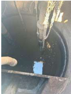
Foto 3 - Poço de Sucção
