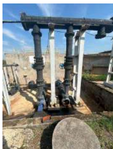
Foto 18 - Bombas de recirculação de lodo
