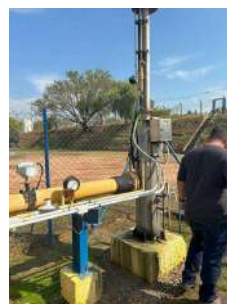
Foto 8 - Detalhe - queimador de gás
