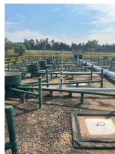
Foto 12 - Sistema distribuição - cobertura UASB
