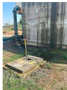
Foto 6 - Indícios de transbordamento do reator UASB
