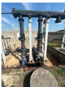
Foto 1 - Bombeamento de recirculação de lodo sem reserva
