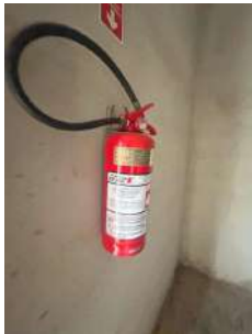
Foto 1 - Extintor com data expirada
