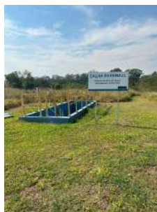
Foto 19 - Medição esgoto tratado (medidor inoperante)
