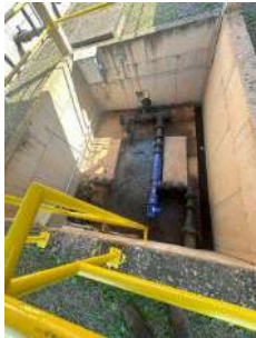
Foto 5 - Bomba de lodo dos reatores UASB sem reserva
