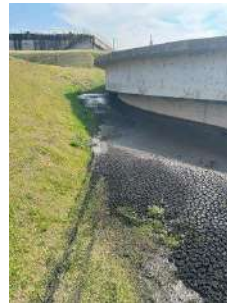
Foto 2 - Transbordamento de lodo
