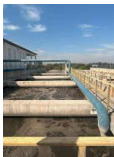
Foto 14 - Tanques de Aeração
