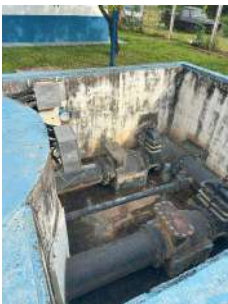
Foto 2 - Barrilete da EEEB
