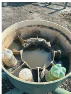
Foto 7 - Distribuição precária da entrada do UASB
