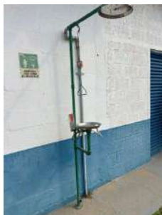
Foto 1 - Chuveira de emergência
