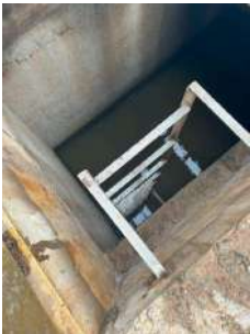
Foto 1 - Canal do gradeamento afogado
