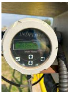
Foto 1 - Macromedidor da entrada
