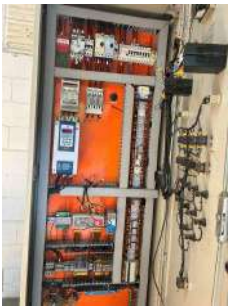
Foto 6 - Painel de acionamento
