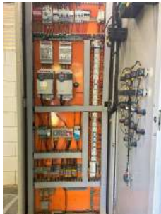
Foto 7 - Painel de acionamento
