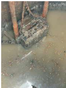
Foto 1 - Ausência de manutenção e limpeza
