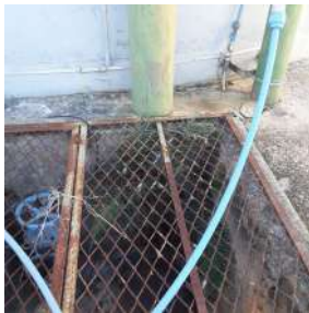
Foto 1 - Saída do tubo extravasor
