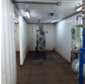
Foto 7 - Gerador de cloro
