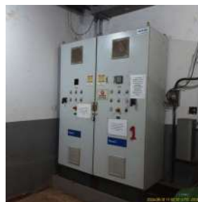
Foto 6 - Paineis de controle dos conjuntos motobomba
