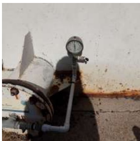
Foto 1 - Manômetro para medição de nível
