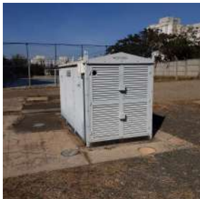
Foto 3 - Booster (atualmente inoperante) instalado no centro de reservação Viva Vista
