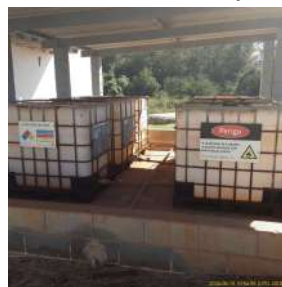
Foto 8 - Tanques de hipoclorito instalados com contenção ao redor e cobertura para proteção
