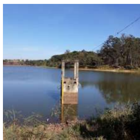
Foto 1 - Estrutura de passagem da água para captação
