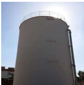
Foto 1 - Aspecto geral do centro de reservação Viva Vista
