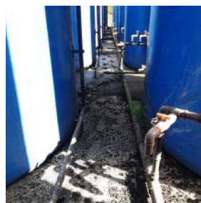
Foto 2 - Lodo no chão da ETE
