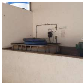
Foto 1 - Tanque de hipoclorito para desinfecção do efluente
