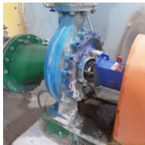
Foto 1 - Gaxeta sem drenagem adequada
