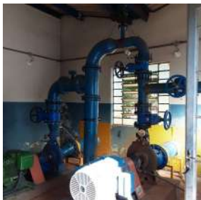
Foto 1 - Conjuntos motobomba instalados
