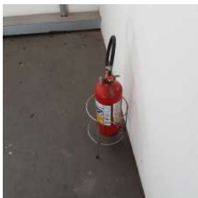
Foto 1 - Extintor de incêndio da elevatória de esgoto
