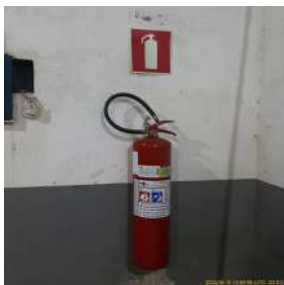
Foto 1 - Extintor de incêndio de pó químico instalado
