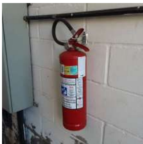
Foto 1 - Extintor de incêndio da elevatória
