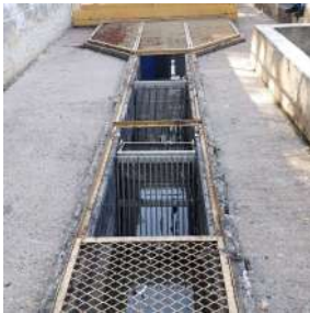
Foto 3 - Gradeamento para resíduos grosseiros e finos na entrada do efluente na ETE
