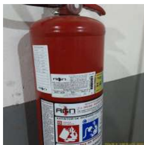
Foto 1 - Extintor de pó químico com próxima manutenção de 2º nível em outubro de 2024
