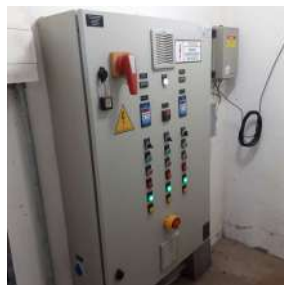
Foto 2 - Pannel de controle do conjunto motobomba
