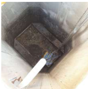
Foto 1 - Gradeamento da elevatória
