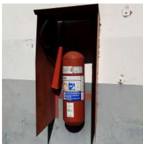
Foto 1 - Extintor de incêndio de CO2 instalado
