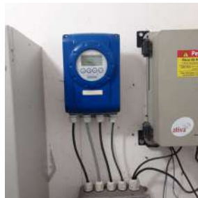
Foto 3 - Pannel do medidor de vazão
