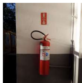
Foto 3 - Extintor de incêndio de pó químico instalado
