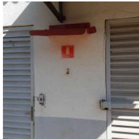
Foto 1 - Área sem extintor (água)
