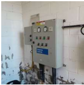
Foto 1 - Painele de controle dos conjuntos motobomba
