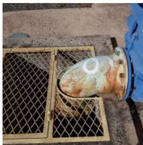
Foto 2 - Tubulação de descarga/limpeza do reservatório
