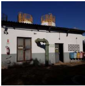
Foto 1 - Aspecto geral da área externa da Elevatória de Água Nova Esperança I e II
