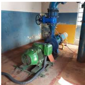
Foto 1 - Conjunto motobomba instalado
