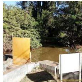
Foto 2 - Estrutura sem guarda-corpo
