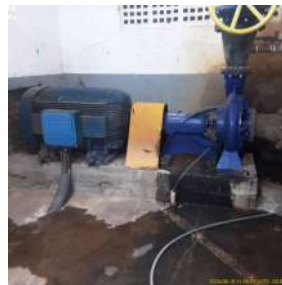
Foto 2 - Água de lubrificação da gaxeta escorrendo pelo piso
