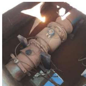
Foto 4 - Macromedidor de vazão instalado
