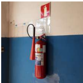
Foto 1 - Extintor de incêndio de CO2 instalado
