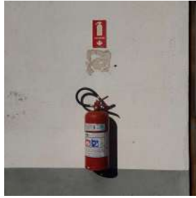
Foto 1 - Extintor de incêndio de pó químico instalado
