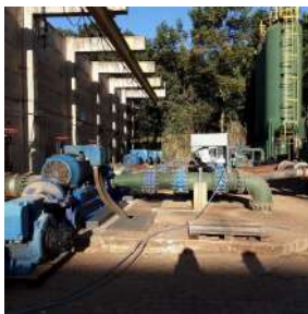
Foto 1 - Conjuntos motobomba instalados
