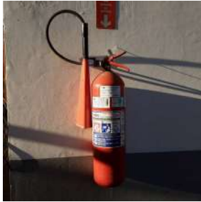
Foto 3 - Extintor de incêndio com próxima manutenção de 2º nível para agosto de 2024
