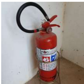
Foto 1 - Extintor de incêndio da captação subterrânea
