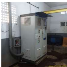
Foto 7 - Paineis de controle do conjunto motobomba
