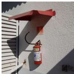
Foto 3 - Área do extintor de pó químico
