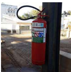
Foto 1 - Extintor de incêndio com carga dá água instalado
