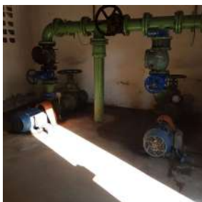
Foto 1 - Conjuntos motobombas instalados (principal e reserva)
