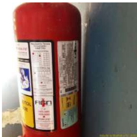
Foto 1 - Extintor de pó químico com manutenção de 2º nível em agosto de 2024
