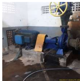
Foto 2 - Conjunto motobomba reserva instalado
