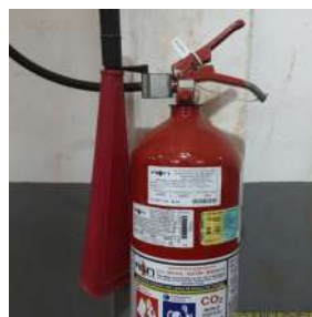
Foto 2 - Extintor de CO2 com próxima manutenção de 2º nível em agosto de 2024
