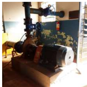
Foto 2 - Conjunto motobomba instalado
