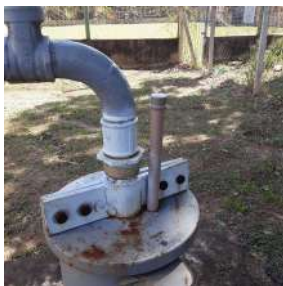
Foto 1 - Tubo de medição de nível da captação subterrânea
