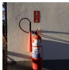
Foto 2 - Extintor de incêndio de CO2 instalado
