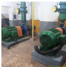
Foto 1 - Conjuntos motobomba instalados
