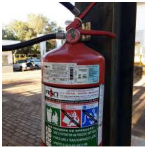
Foto 1 - Extintor de incêndio com próxima manutenção de 2º nível para outubro de 2024
