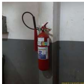
Foto 2 - Extintor de incêndio de CO2 instalado
