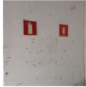
Foto 2 - Área para instalação de extintor de incêndio sem os equipamentos
