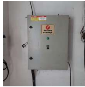
Foto 2 - Pannel de controle operacional dos conjuntos motobomba
