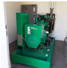
Foto 1 - Gerador da elevatória
