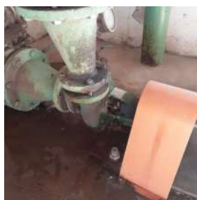
Foto 1 - Piso molhado pela drenagem inadequada de lubrificação das gaxetas
