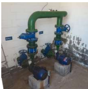
Foto 1 - Conjuntos motobomba instalados
