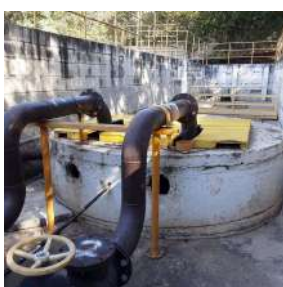
Foto 1 - Tubulações de recalque das duas motobombas
