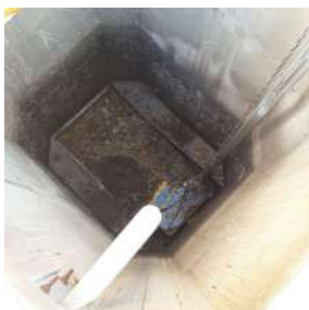
Foto 1 - Gradeamento da elevatória
