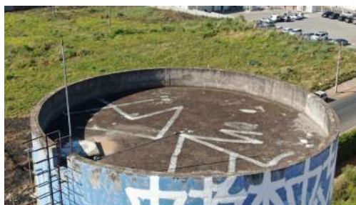
Foto 2 - Detalhamento do pára-raio instalado
