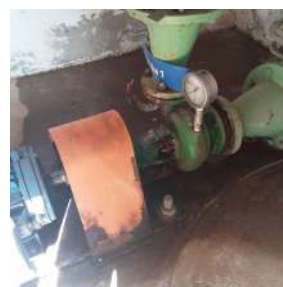
Foto 2 - Piso molhado pela drenagem inadequada de lubrificação das gaxetas
