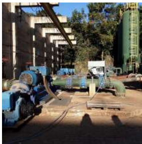
Foto 1 - Conjuntos motobomba instalados
