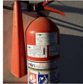
Foto 4 - Extintor de incêndio com próxima manutenção de 2º nível para agosto de 2024
