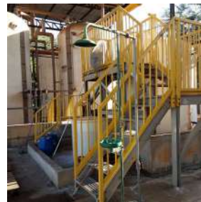
Foto 4 - Guarda-corpo na planta de geração de cloro
