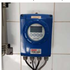
Foto 5 - Pannel do macromedidor
