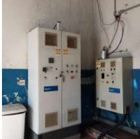
Foto 7 - Painel de controle dos conjuntos motobomba
