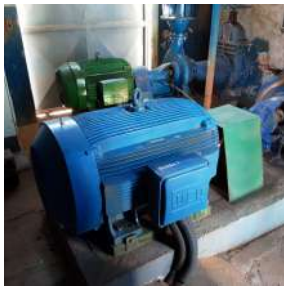
Foto 1 - Conjuntos motobomba instalados
