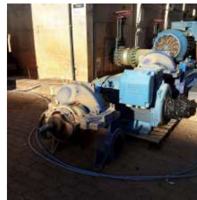
Foto 2 - Conjunto motobomba instalado
