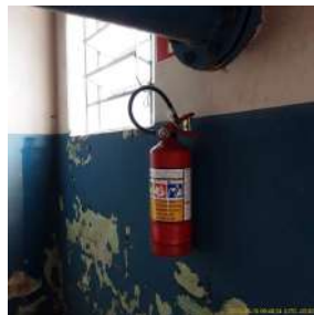
Foto 2 - Extintor de incêndio de pó químico instalado
