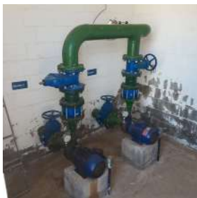
Foto 1 - Conjuntos motobomba (principal e reserva) instalados
