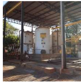
Foto 6 - Tanques da planta de geração de cloro
