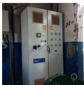
Foto 6 - Pannel de controle dos conjuntos motobomba
