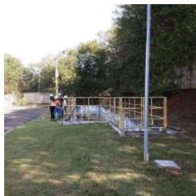
Foto 1 - Guarda-corpo na elevatória de esgoto
