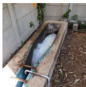
Foto 2 - Calha Parshall para medição de vazão da saída
