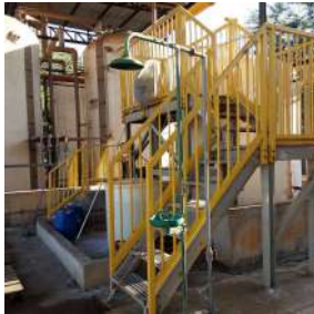
Foto 9 - Chuveiro de emergência da planta de geração de cloro
