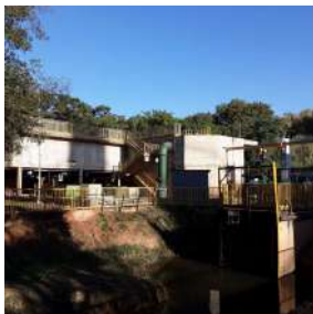
Foto 1 - Visão geral dos guarda-corpos
