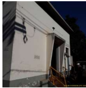
Foto 6 - Aspecto geral da casa de bombas
