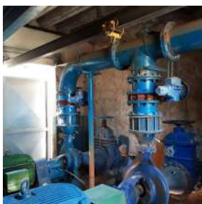
Foto 1 - Vista interna da casa de bombas
