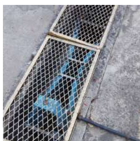
Foto 1 - Calha Parshall para medição de vazão da entrada
