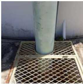
Foto 1 - Tubo extravasor do reservatório
