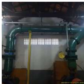
Foto 1 - Vista interna da casa de bombas
