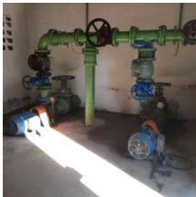
Foto 1 - Conjuntos motobombas instalados
