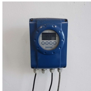
Foto 12 - Display do medidor de vazão
