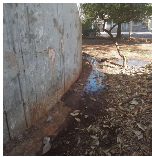
Foto 2 - Detalhe dos vazamentos
