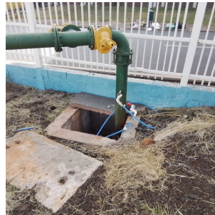
Foto 4 - Ponto de aplicação da dosagem de cloro e flúor
