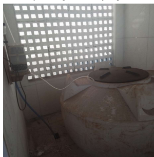
Foto 6 - Armanezamento e dosagem de flúor
