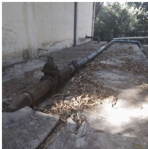
Foto 2 - Vista superior do reservatório Via do Café - Caixa de Sucção
