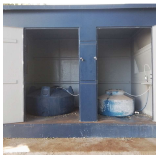
Foto 6 - Armazenamento dos produtos químicos, com bacia de contenção
