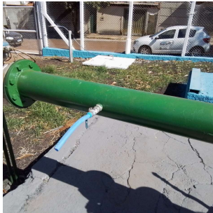
Foto 5 - Tomada para coleta de água bruta
