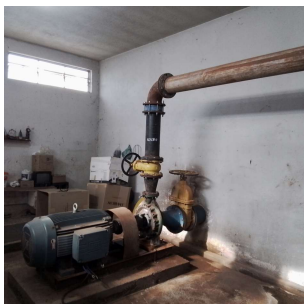
Foto 8 - Conjunto motor-bomba II
