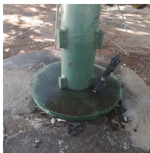
Foto 2 - Tubo de medição de nível
