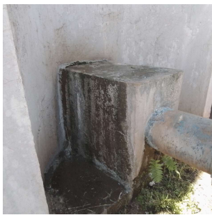
Foto 1 - Vista do local dos vazamentos
