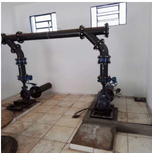
Foto 1 - Vista interna da cada de bombas
