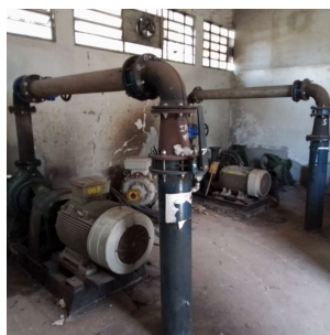
Foto 8 - Conj. recalque do sistema Alto do Ipiranga, com bomba reserva
