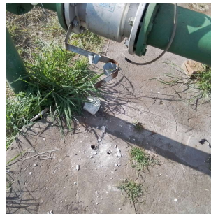
Foto 2 - Detalhe da fiação cortada
