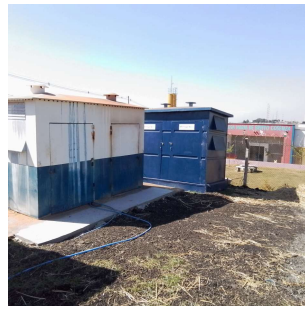
Foto 12 - Abrigo dos produtos químicos
