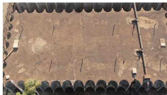
Foto 2 - Vista superior da tubulação de ventilação, sem tela de proteção
