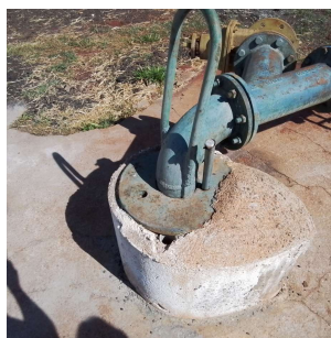
Foto 6 - Tubo de medição de nível
