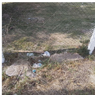
Foto 1 - Cercamento danificado I
