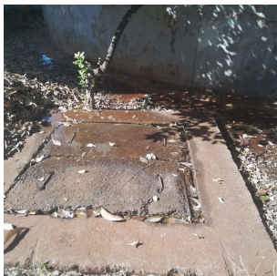
Foto 3 - Detalhe dos vazamentos
