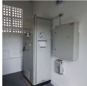
Foto 10 - Pannel de comando
