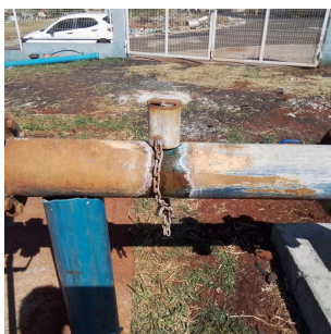
Foto 1 - Detalhe do vazamento aparente
