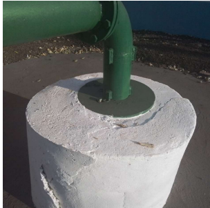
Foto 3 - Tubo de medição de nível
