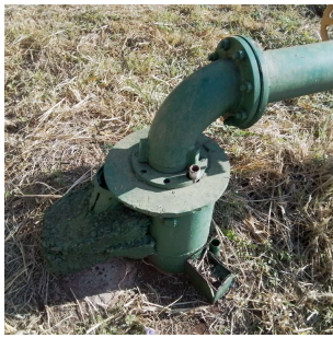
Foto 5 - Tubo de medição de nível
