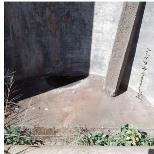
Foto 6 - Detalhe dos vazamentos
