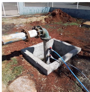
Foto 10 - Ponto de dosagem de cloro e flúor
