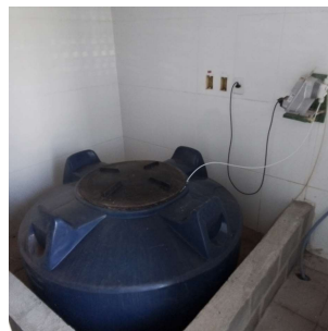
Foto 14 - Armazenamento e dosagem de cloro
