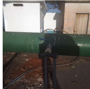
Foto 4 - Tomada para coleta de água bruta
