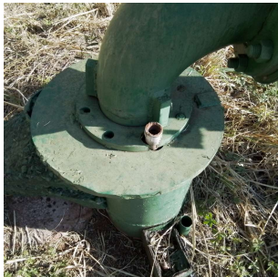
Foto 2 - Ausência de CAP no tubo de medição de nível
