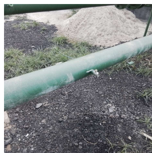
Foto 4 - Tomada de água para coleta de água bruta
