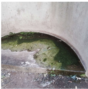
Foto 3 - Detalhe dos vazamentos
