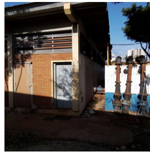
Foto 10 - Vista externa da EEAT e caixa de sucção Matadouro
