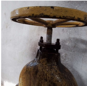
Foto 1 - Detalhe da válvula com vazamento aparente
