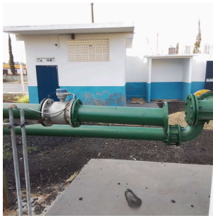
Foto 8 - Medidor em linha desligada para o reservatório
