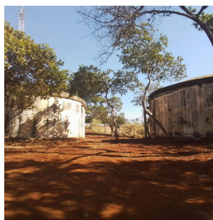
Foto 9 - Reservatórios desativados para manutenção
