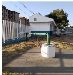
Foto 10 - Cavalete do poço
