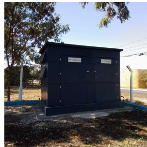
Foto 10 - Abrigo de dosagem de produtos químicos
