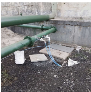
Foto 5 - Ponto de aplicação da dosagem de cloro e flúor
