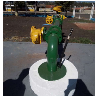
Foto 4 - Tubo de medição de nível e laje de proteção do poço Arlindo Laguna
