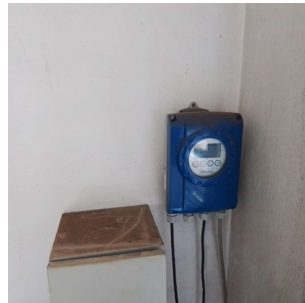
Foto 14 - Display do medidor de vazão
