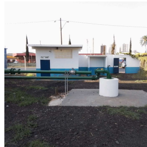
Foto 10 - Cavalete do poço
