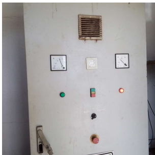
Foto 5 - Painel de comando e controle
