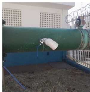
Foto 6 - Tomada para coleta de água bruta
