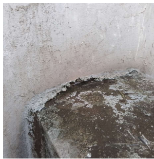
Foto 2 - Detalhe dos vazamentos
