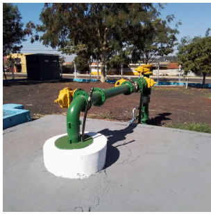
Foto 3 - Cavalete do poço Arlindo Laguna
