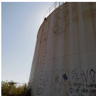
Foto 1 - Ausência de medidor de nível
