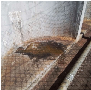
Foto 3 - Detalhe dos vazamentos
