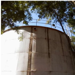
Foto 1 - Ausência de tela de proteção no extravassor
