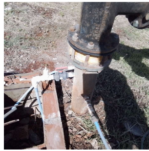
Foto 6 - Ponto de dosagem de cloro e flúor
