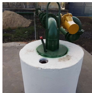
Foto 7 - Tubo de medição de nível
