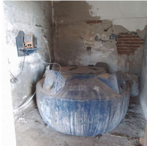
Foto 7 - Armazenamento e dosagem de Cloro
