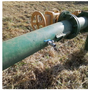
Foto 6 - Tomada de água para coleta de água bruta
