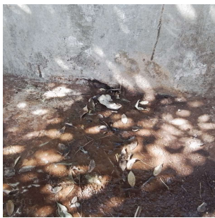
Foto 1 - Detalhe dos vazamentos
