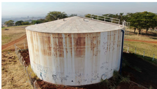
Foto 1 - Pontos de oxidação no reservatório
