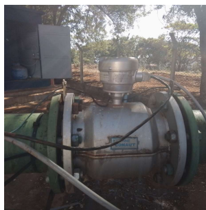
Foto 7 - Macromedidor de vazão
