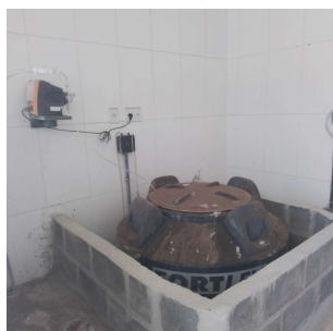
Foto 9 - Dosagem e armazenamento de flúor
