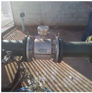
Foto 1 - Ausência de macromedidor secundário
