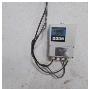
Foto 9 - Display do medidor de vazão
