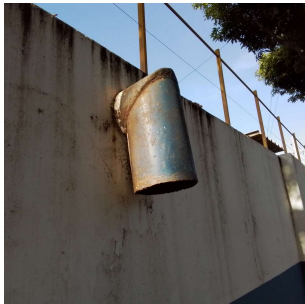
Foto 1 - Ausência de tela de proteção no extravasor
