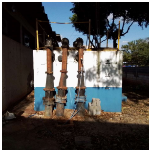
Foto 2 - Chegada da água dos poços
