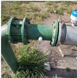
Foto 1 - Ausência de tomada para coleta de água bruta
