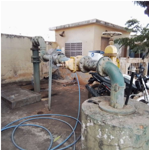
Foto 1 - Cavalete do poço Pernambuco
