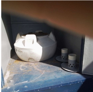
Foto 9 - Armazenamento e dosagem de cloro
