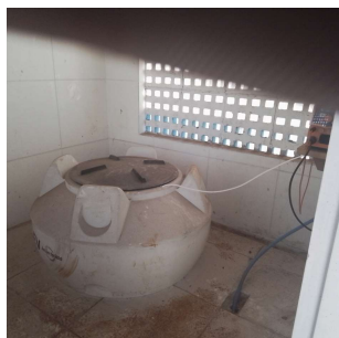
Foto 5 - Armanezamento e dosagem de cloro
