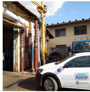
Foto 6 - Bombas reservas dos poços
