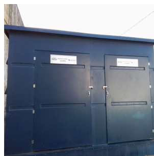
Foto 6 - Casa de dosagem de cloro e flúor
