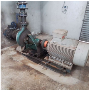
Foto 3 - Conjunto motor-bomba I
