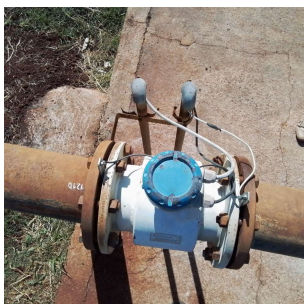
Foto 9 - Macromedidor de vazão
