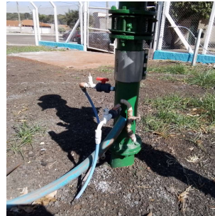
Foto 6 - Ponto de dosagem de cloro e flúor
