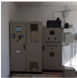
Foto 3 - Painel de comando e acionamento das bombas
