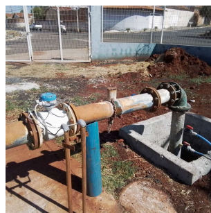
Foto 2 - Detalhe do vazamento aparente
