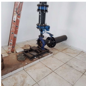
Foto 1 - Ausência de conjunto moto bomba reserva
