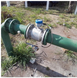
Foto 1 - Macromedidor com fiação cortada
