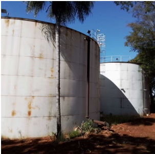
Foto 3 - Reservatórios Monte Alegre
