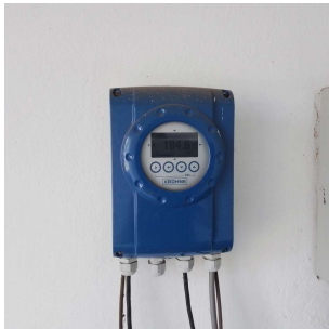
Foto 7 - Display do medidor de vazão
