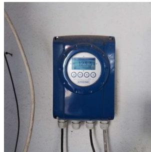
Foto 4 - Display do medidor de vazão
