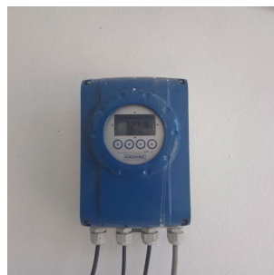
Foto 8 - Display do medidor de vazão
