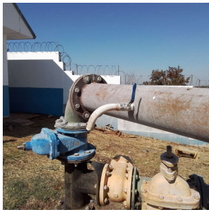
Foto 5 - Tomada para coleta de água bruta
