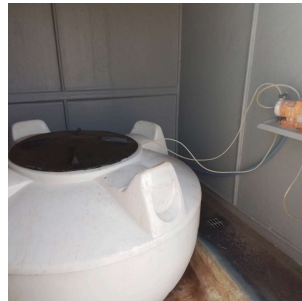
Foto 8 - Armazenamento e dosagem de cloro
