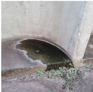
Foto 5 - Detalhe dos vazamentos
