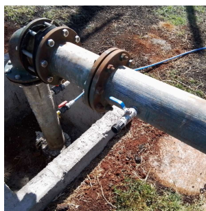
Foto 8 - Tomada para coleta de água bruta
