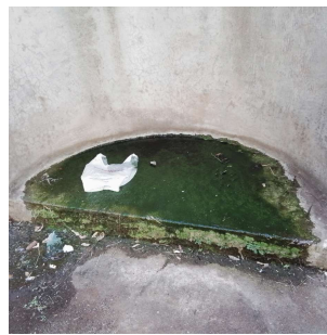
Foto 4 - Detalhe dos vazamentos
