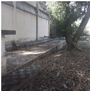
Foto 1 - Reservatório Via do Café - Caixa de Sucção
