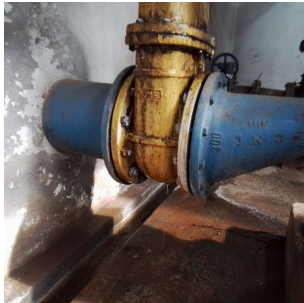
Foto 2 - Detalhe do vazamento aparente
