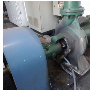
Foto 4 - Drenagem da gaxeta
