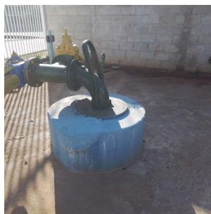
Foto 4 - Tubo de medição de nível e laje de proteção do poço
