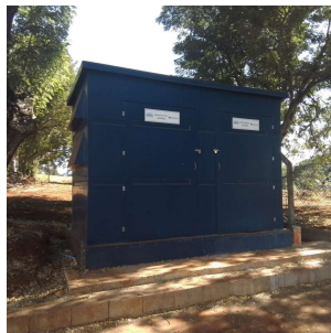
Foto 5 - Abrigo de cloro e flúor
