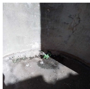
Foto 2 - Detalhe dos vazamentos
