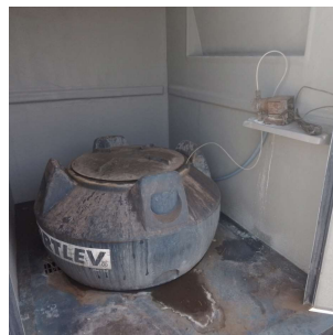
Foto 9 - Armazenamento e dosagem de flúor
