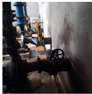
Foto 6 - Vista das válvulas
