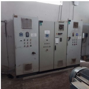
Foto 4 - Painel de comando e acionamento das bombas
