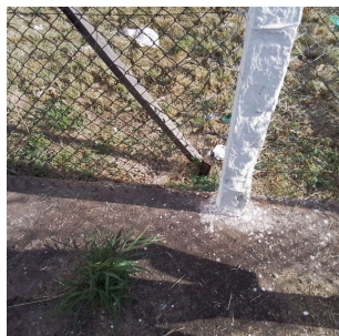
Foto 3 - Cercamento danificado III
