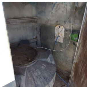
Foto 15 - Armazenamento e dosagem de cloro
