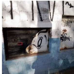
Foto 10 - Caixa protegida de furtos de equipamentos elétricos e visor do relógio de energia
