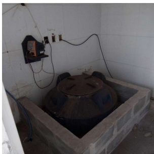
Foto 13 - Armazenamento e dosagem de fluor
