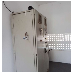
Foto 8 - Painel de comando
