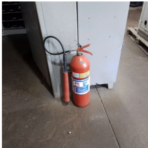
Foto 9 - Extintor de incêndio
