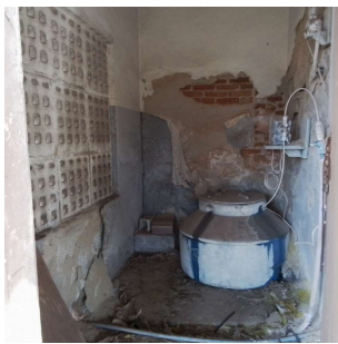
Foto 1 - Casa de dosagem de produtos químicos
