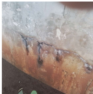
Foto 4 - Detalhe dos vazamentos
