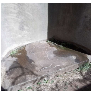
Foto 1 - Detalhe dos vazamentos
