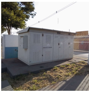
Foto 9 - Cabine de força
