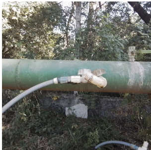
Foto 2 - Tomada da coleta de água bruta
