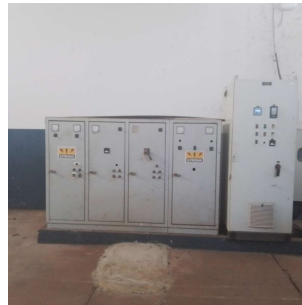
Foto 2 - Painel de comando e acionamento das bombas
