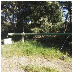
Foto 1 - Cavalete do poço Pedreira
