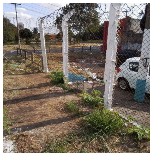
Foto 2 - Cercamento danificado II
