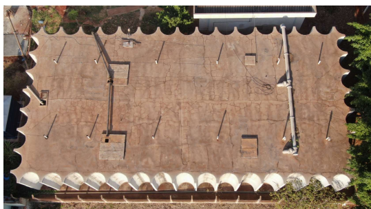
Foto 1 - Ausência de tela de proteção
