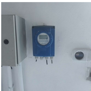
Foto 1 - Ausência de fios no display
