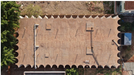
Foto 1 - Aberturas na cobertura do reservatório
