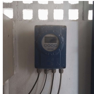
Foto 7 - Display do medidor de vazão
