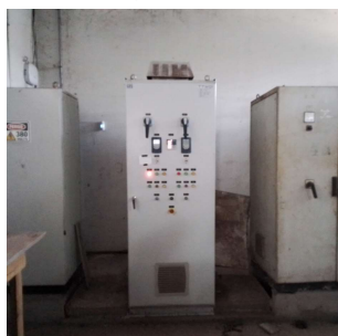
Foto 7 - Paineis de comando e acionamento das bombas
