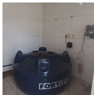
Foto 10 - Dosagem e armazenamento de cloro
