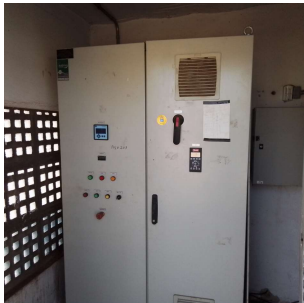
Foto 13 - Painel de comando
