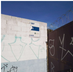
Foto 1 - Placa de identificação danificada
