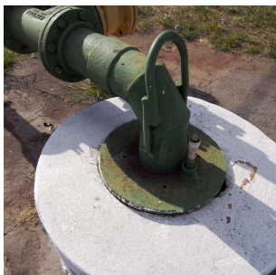
Foto 5 - Tubo de medição de nível
