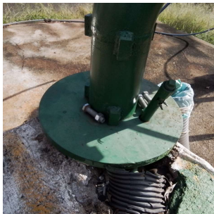
Foto 3 - Tubo de medição de nível
