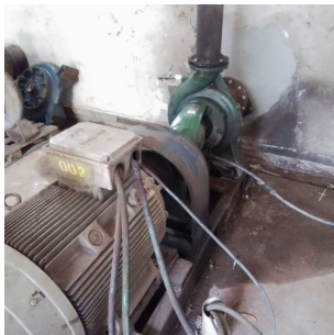
Foto 1 - Drenagem inadequada de água
