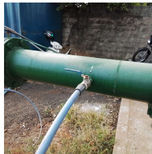
Foto 6 - Tomada para coleta de água bruta
