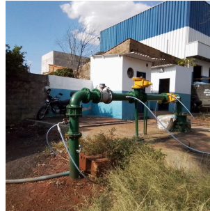
Foto 2 - Cavalete do poço Ciane II
