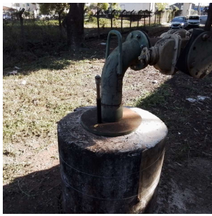
Foto 5 - Tubo de medição de nível
