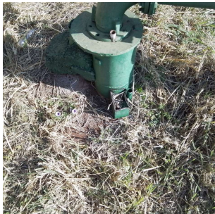
Foto 1 - Ausência de laje de proteção
