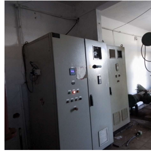
Foto 2 - Painel de comando e acionamento das bombas
