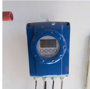
Foto 8 - Display do medidor de vazão
