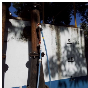
Foto 7 - Aplicação Cloro e flúor na EEAT Matadouro
