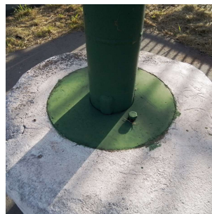
Foto 8 - Tubo de medição de nível
