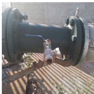
Foto 3 - Tomada de água para coleta de água bruta
