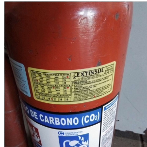
Foto 10 - Extintor de incêndio, dentro da validade
