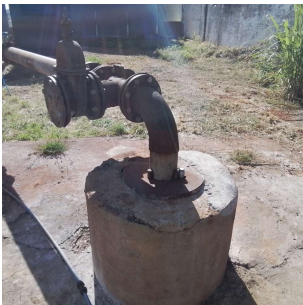
Foto 3 - Tubo de medição de nível
