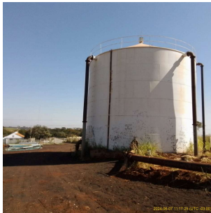
Foto 1 - Ausência de medidor de nível
