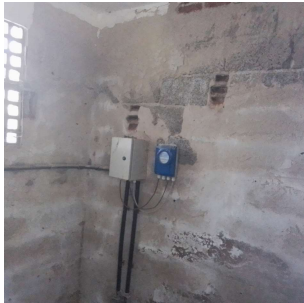
Foto 4 - Display do medidor de vazão
