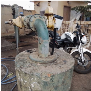
Foto 2 - Laje de proteção e tubo de medição de nível
