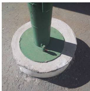
Foto 5 - Tubo de medição de nível
