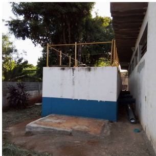
Foto 1 - Reservatório Matadouro - Caixa de Contato
