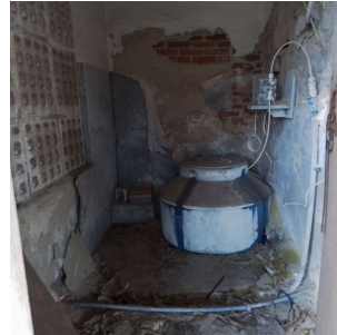
Foto 8 - Armazenamento e dosagem de Flúor
