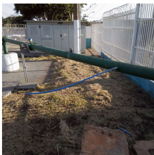
Foto 5 - Tomada para coleta de água bruta
