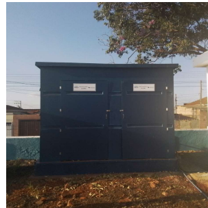
Foto 6 - Casa de dosagem de cloro e flúor
