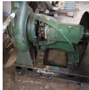
Foto 2 - Drenagem inadequada de água
