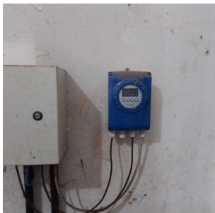
Foto 10 - Displau do medidor de vazão
