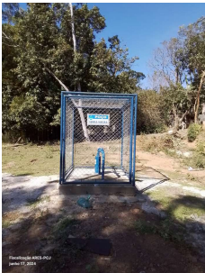
Foto 1 - Vista geral da captação subterrânea.
