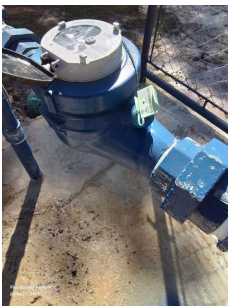
Foto 1 - Água do vazamento acumulada sobre a laje de proteção do poço.
