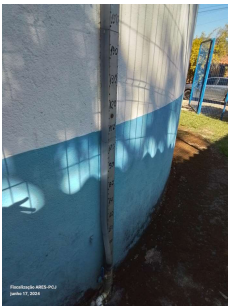
Foto 1 - Régua de medição de nível.
