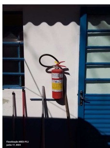
Foto 1 - Extintor de incêndio localizado ao lado da porta do laboratório.
