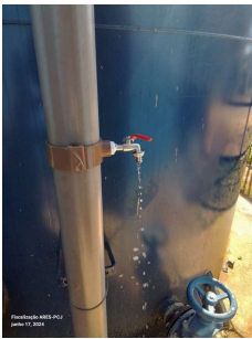
Foto 1 - Ponto de tomada de água bruta.
