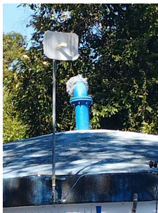
Foto 2 - Tela de proteção na tubulação de ventilação.
