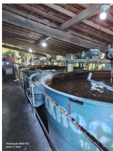
Foto 5 - Área de operação do sistema de tratamento, à direita, três tanques de floculação/decantação em funcionamento.
