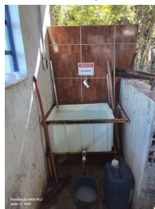
Foto 7 - Tanque de preparação de polímero utilizado no processo de floculação/decantação.
