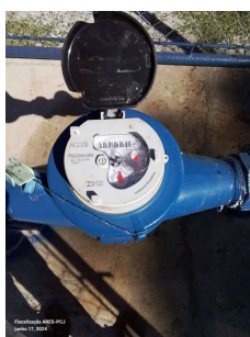
Foto 1 - Macromedidor de vazão da captação.
