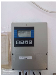
Foto 1 - Macromedidor da vazão de entrada da água bruta no sistema de tratamento.
