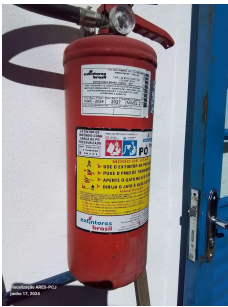
Foto 1 - Etiqueta de controle de manutenções, a manutenção de 2º nível deveria ter sido realizada em março/2024. A manutenção de 3º nível está válida até 2027.
