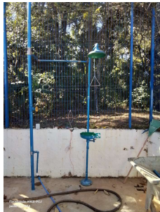
Foto 1 - Chuveiro de emergência localizado próximo do laboratório e área de operação.
