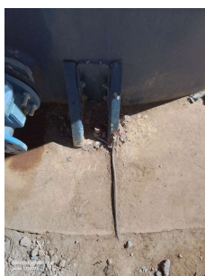
Foto 1 - Detalhe do aterramento do para raio.
