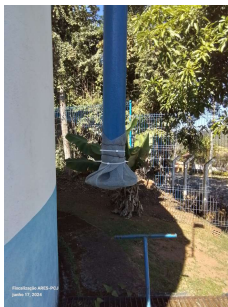
Foto 1 - Tela de proteção na extremidade do tubo extravasor.
