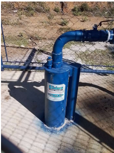
Foto 1 - Tubo de medição de nível à esquerda da tubulação principal.
