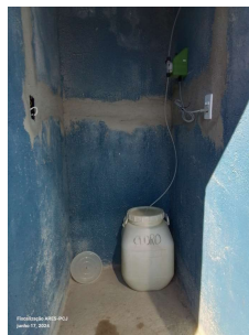
Foto 2 - Tanque de hipoclorito de sódio e bomba dosadora em local protegido.
