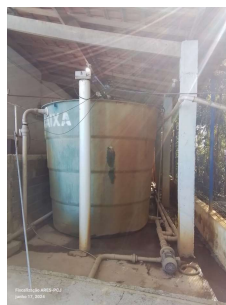
Foto 4 - Área coberta abrigando os tanques de floculação/decantação - sistema de tratamento por batelada.
