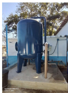
Foto 2 - Novo filtro - em funcionamento desde agosto de 2023.
