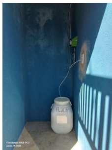
Foto 1 - Tanque de ácido fluossilícico e bomba dosadora em local protegido.
