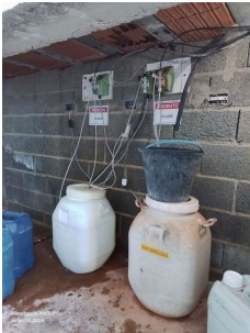
Foto 1 - Galões de Hipoclorito de Sódio e Ácido Fluossilícico. Acima dos galões, as bombas dosadoras com as respectivas placas de identificação.
