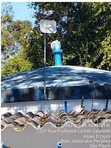
Foto 1 - Tubulação de ventilação no topo do reservatório.
