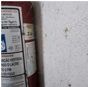
Foto 1 - Extintor de incêndio com validade expirada da Elevatória da EEBB Jardim Orquídeas em Iracemápolis
