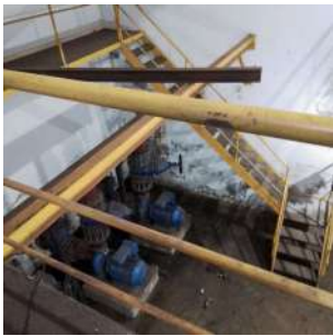
Foto 6 - Bombas da elevatória EEEB Geral de Iracemápolis
