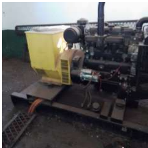
Foto 2 - Gerador da Elevatória da EEEB Jardim Orquídeas em Iracemápolis
