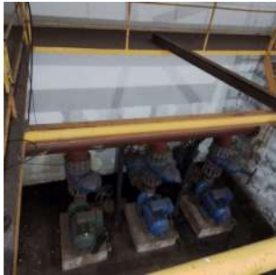
Foto 7 - Bombas da elevatória EEEB Geral de Iracemápolis
