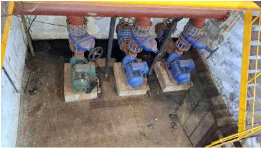
Foto 2 - Vazamento nas bombas da elevatória EEEB Geral de Iracemápolis
