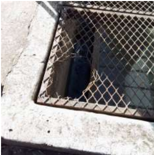
Foto 1 - Grade do piso com buracos na EEEB Geral de Iracemápolis
