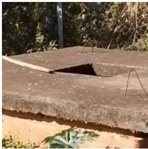
Foto 3 - Abertura no piso na Elevatória da EEEB Jardim Orquídeas em Iracemápolis
