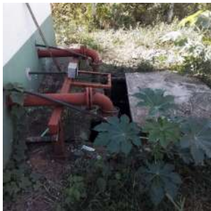
Foto 2 - Abertura no piso na Elevatória da EEBB Jardim Orquídeas em Iracemápolis
