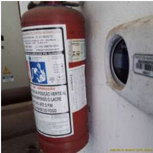
Foto 1 - Extintor de incêndio com validade expirada na EEEB Cidade Nova em Iracemápolis
