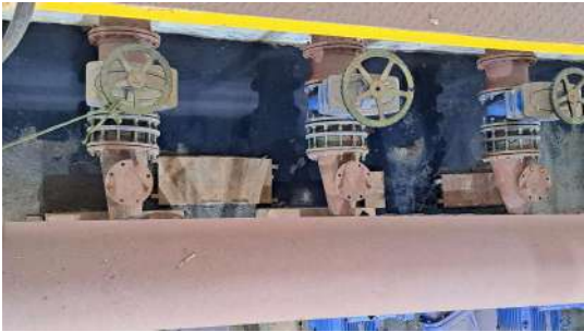
Foto 1 - Vazamento nas bombas da elevatória EEEB Geral de Iracemápolis
