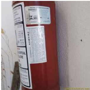
Foto 1 - Extintor de incêndio com validade expirada na EEEB do Distrito Industrial em Iracemápolis
