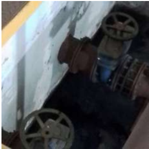
Foto 8 - Bombas da elevatória EEEB Geral de Iracemápolis
