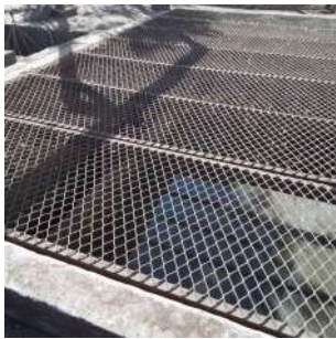
Foto 5 - Elevatória da EEEB Geral de Iracemápolis
