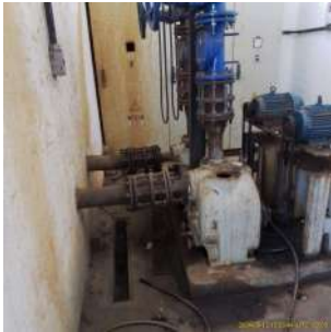
Foto 8 - Bombas na EEEB do Distrito Industrial em Iracemápolis
