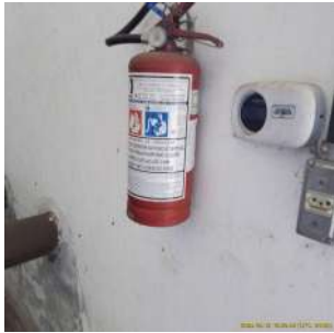
Foto 6 - Extintor de incêndio na EEEB Cidade Nova em Iracemápolis
