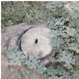
Foto 1 - Tampa fora do local adequada na Elevatória da EEBB Jardim Orquídeas em Iracemápolis
