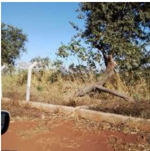
Foto 1 - Cerca danificada na ETE Iracemápolis
