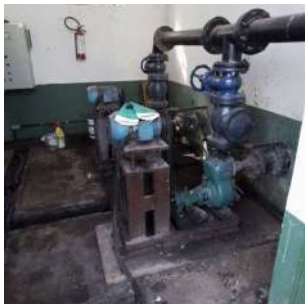
Foto 1 - Bombas da Elevatória da EEEB Jardim Orquídeas em Iracemápolis
