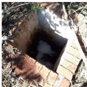
Foto 3 - Caixa de saída de esgoto sem proteção na ETE Iracemápolis
