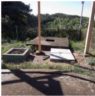
Foto 1 - Elevatória da EEEB Jardim Orquídeas em Iracemápolis
