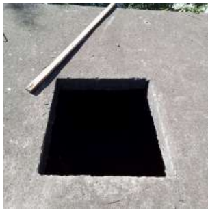
Foto 4 - Abertura no piso na Elevatória da EEEB Jardim Orquídeas em Iracemápolis
