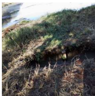
Foto 1 - Caixa de entrada de esgoto sem proteção na ETE Iracemápolis
