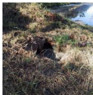
Foto 2 - Caixa de entrada de esgoto sem proteção na ETE Iracemápolis
