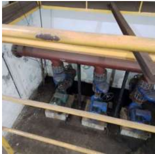
Foto 9 - Bombas da elevatória EEEB Geral de Iracemápolis
