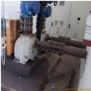
Foto 5 - Bombas na EEEB Cidade Nova em Iracemápolis
