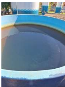
Foto 10 - Unidade de filtração - ETA de Fibra
