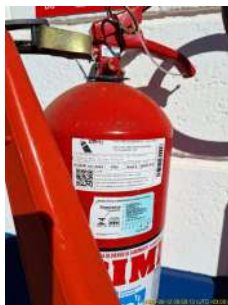
Foto 1 - Extintor com validade regular
