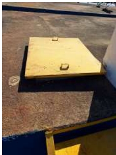
Foto 1 - Tampa de inspeção - regular
