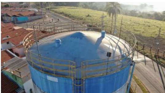
Foto 1 - RESERVATÓRIO NOSSO SONHO - presença de para-raios
