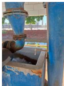
Foto 11 - Ponto de chegada da água das duas ETA, com a dosagem de hipoclorito de sódio e ácido fluossilícico
