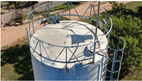
Foto 1 - Reservatório Palmeiras - tampa deslocada do local
