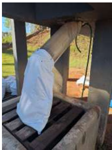
Foto 1 - ETE Sítio Novo - recolhimento de resíduos do peneiramento
