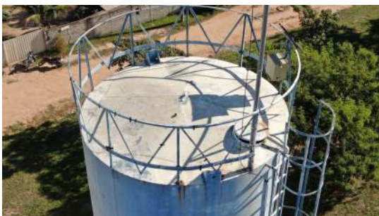
Foto 1 - Descida do para-raios
