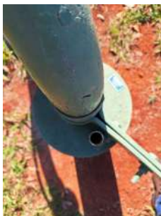
Foto 1 - Tubo de medição de nível
