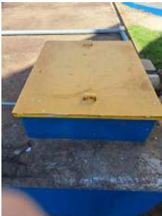
Foto 1 - Tampa de inspeção regular.
