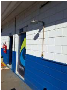
Foto 1 - Chuveiro de emergência
