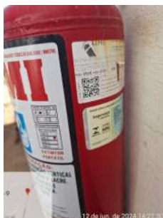
Foto 1 - Extintor de incêndio com validade regular
