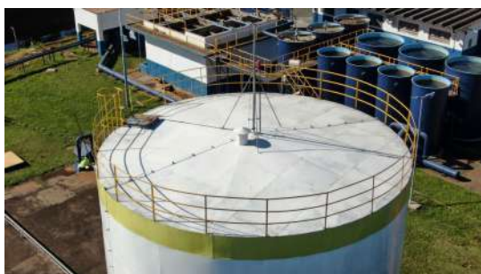
Foto 1 - Res Apoiado 600 mil L ETA III (Caldeirão) - para-raios
