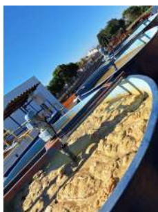
Foto 8 - Unidade de floculação da ETA de Fibra
