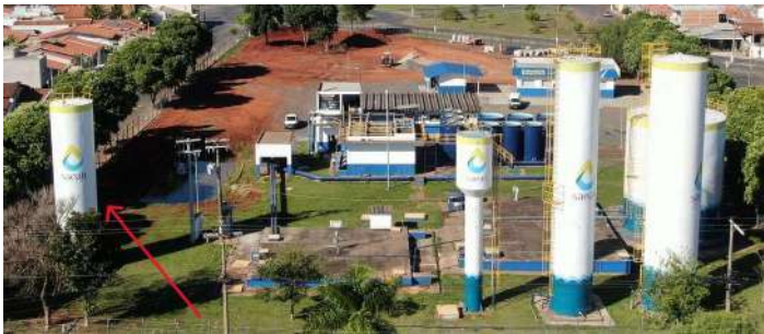
Foto 4 - Localização - Reservatório 110 mil litros - Carolina
