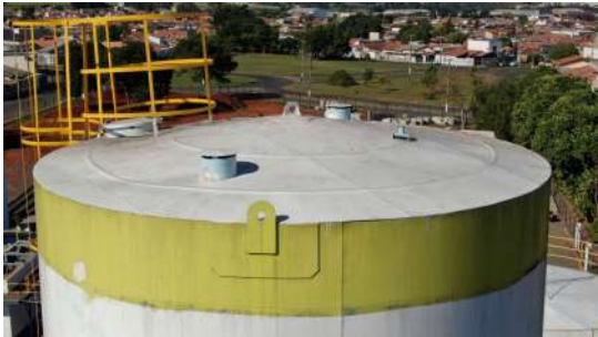
Foto 1 - Reservatório ETA III - 200 mil L - cobertura - ventilação
