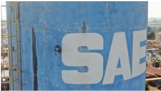
Foto 1 - Reservatório Elevado Coração Criança - extravasor e ventilação
