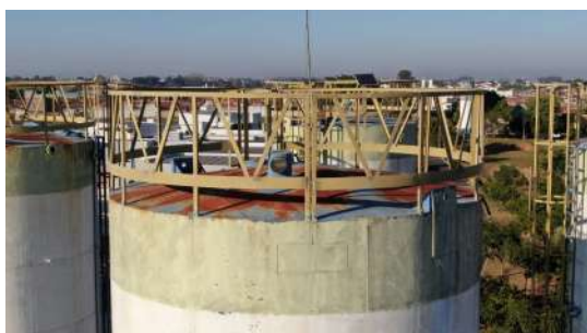
Foto 1 - Reservação - Vila Nogueira - Ventilação
