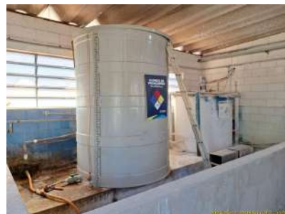
Foto 4 - Tanque com estocagem de PAC
