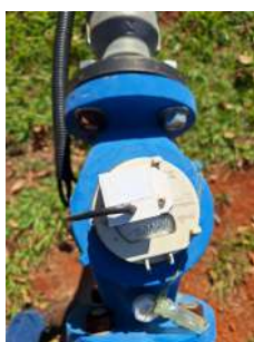
Foto 1 - Macromedidor - Poço ETA III
