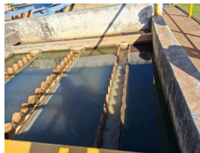
Foto 5 - Decantador de alta taxa - ETA de concreto
