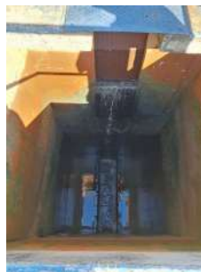
Foto 7 - Comporta fechada para interromper a chegada de água decantada e iniciar retrolavagem
