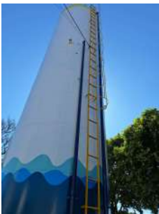
Foto 3 - Separação em câmaras - Reservatório 110 mil litros - Carolina
