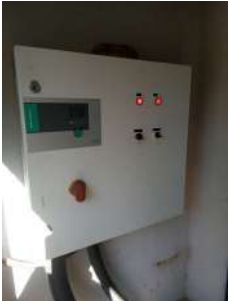
Foto 3 - Painel de controle - bomba - EEE SÍTIO NOVO
