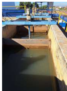
Foto 3 - unidade de floculação da ETA de concreto
