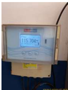
Foto 1 - Macromedidor - entrada da ETA
