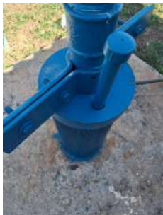
Foto 1 - Tubo de medição de nível POÇO ITAMARATY II (JOÃO BOMBO)
