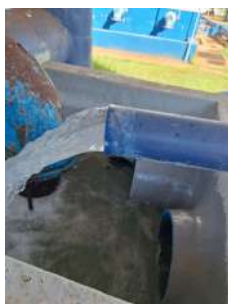
Foto 1 - Local de chegada da água do Poço
