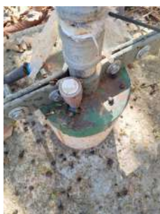
Foto 1 - Tubo de medição de nível - POÇO SERINGUEIRA
