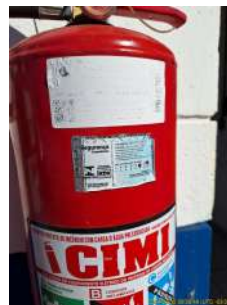
Foto 2 - Extintor com validade regular
