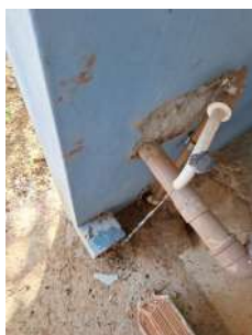
Foto 1 - Ponto de tomada de água bruta - POÇO SERINGUEIRA
