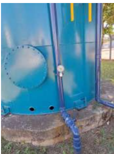
Foto 2 - manômetro - Reservatório 140 mil litros
