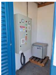
Foto 1 - Sala com painel de controle da bomba e transformador - ausência de extintor
