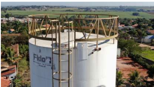
Foto 1 - Reservatório Palmeiras - Tela de proteção
