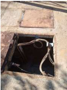
Foto 2 - Poço de sucção - EEE SÍTIO NOVO
