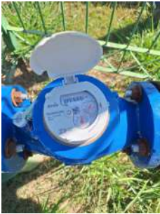
Foto 1 - Macromedidor - POÇO LAGOA DOS PÁSSAROS
