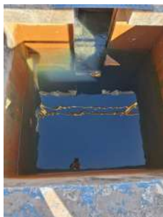
Foto 6 - filtros em operação de retrolavagem
