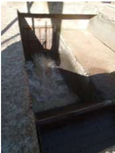
Foto 1 - Chegada do esgoto e gradeamento - EEE SÍTIO NOVO
