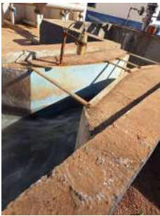
Foto 4 - ETE Sítio Novo - medidor Parshall - com macromedidor ultrassônico
