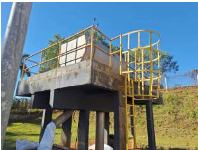
Foto 2 - ETE Sítio Novo - peneira rotativa - tratamento preliminar
