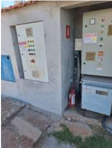
Foto 3 - Painel elétrico - Poço ETA III
