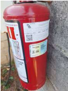
Foto 1 - Extintor de incêndio com validade regular
