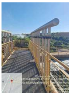
Foto 1 - Guarda-corpos na parte de cima do reator
