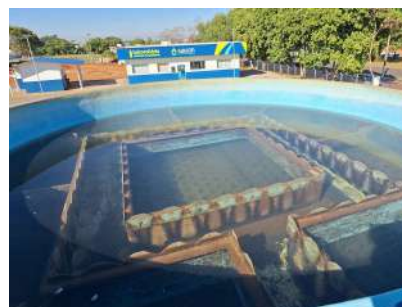
Foto 9 - Decantador de alta taxa - ETA de Fibra
