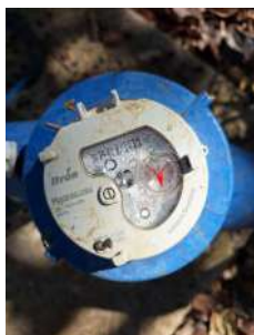
Foto 1 - Macromedidor - POÇO SERINGUEIRA
