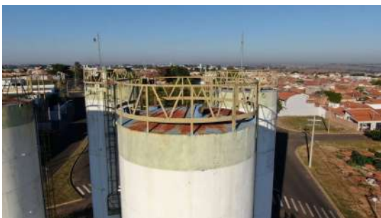
Foto 1 - Para-raios - Reservação Vila Nogueira
