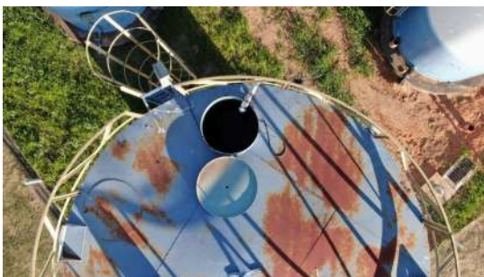
Foto 1 - Reservatório Vila Nogueira - cobertura - tampa aberta
