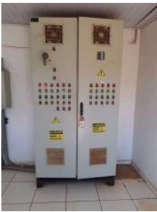
Foto 9 - ETE Sítio Novo - painel de comando
