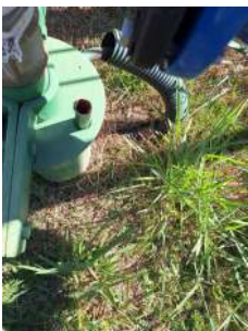
Foto 1 - Tubo de medição de nível - POÇO LAGOA DOS PÁSSAROS
