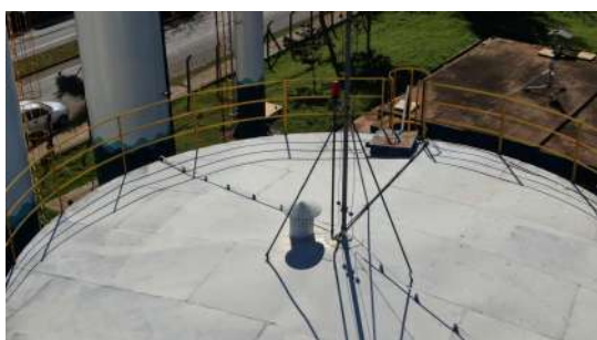
Foto 1 - Res Apoiado 600 mil L ETA III (Caldeirão) - tampa e ventilação com tela de proteção
