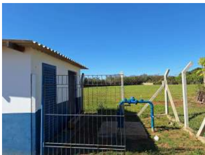
Foto 1 - Portão - ausência de identificação
