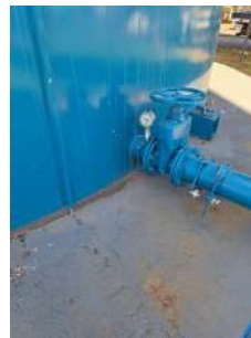
Foto 2 - Res Apoiado 600 mil L ETA III (Caldeirão) - manômetro
