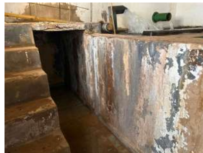
Foto 2 - Vazamento nas paredes do tanque com chicanas
