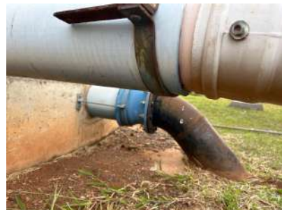
Foto 2 - Vazamento na tubulação do reservatório
