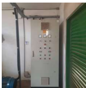
Foto 4 - Painel da elevatória
