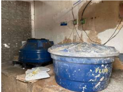
Foto 11 - Reservatórios de cloro e flúor
