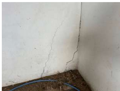
Foto 2 - Fissuras na edificação
