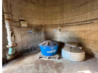
Foto 8 - Armazenagem de cloro e flúor
