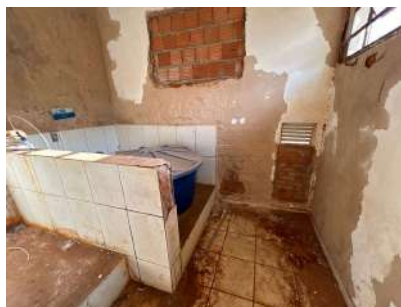
Foto 2 - Casa de química suja e em más condições de conservação
