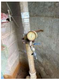
Foto 5 - Torneira de coleta de água do reservatório
