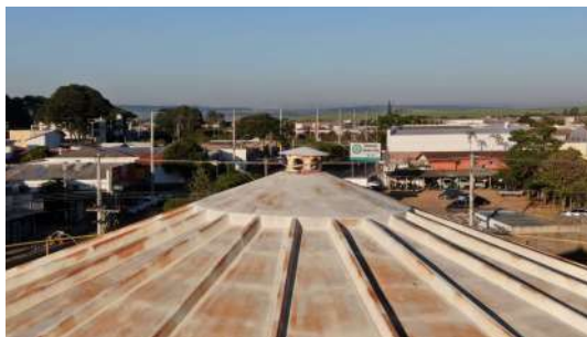
Foto 2 - Tubulação de ventilação sem tela de proteção
