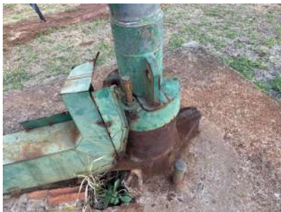
Foto 5 - Tubo de medição de nível
