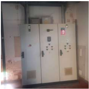
Foto 4 - Painel da elevatória
