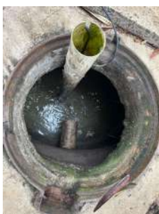
Foto 1 - Ausência de gradeamento na EEE
