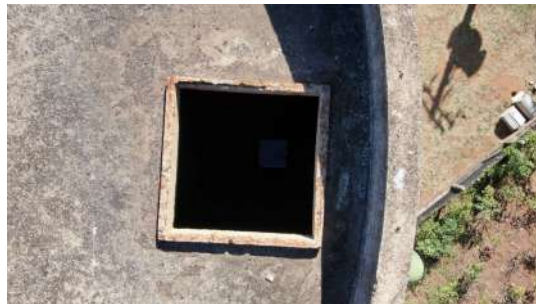
Foto 2 - Detalhe da ausência de tampa de inspeção na abertura
