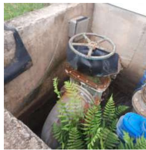
Foto 2 - Vazamento em tubulação do reservatório
