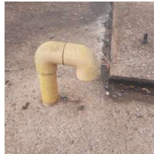
Foto 2 - Tubulação sem tela de proteção
