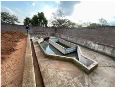
Foto 3 - Gradeamento e desarenador
