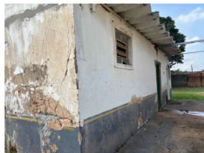
Foto 2 - Patologias diversas nas paredes
