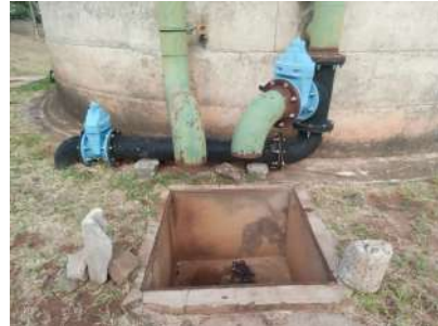
Foto 4 - Tubulações de extravasor e limpeza do reservatório
