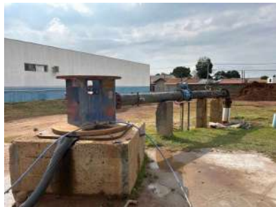
Foto 6 - Cavalete do poço
