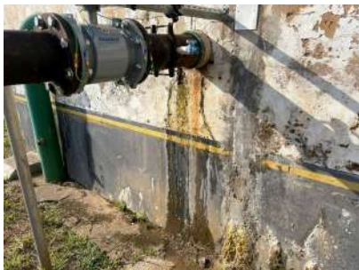
Foto 1 - Vazamento na parede na parte externa da EEAT São Carlos III
