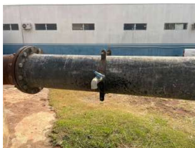
Foto 4 - Torneira para coleta de água bruta
