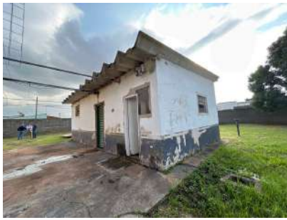
Foto 3 - Patologias diversas nas paredes
