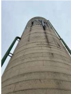
Foto 3 - Vazamentos no reservatório
