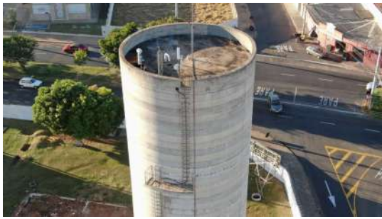
Foto 1 - Ausência de tela nas tubulações de ventilação
