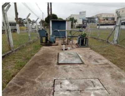
Foto 2 - Vista interna da elevatória
