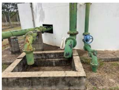
Foto 3 - Tubulações do reservatório
