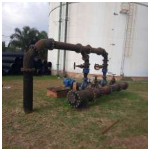
Foto 1 - Barrilete da elevatória
