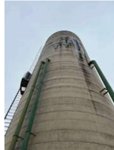
Foto 4 - Vazamentos no reservatório
