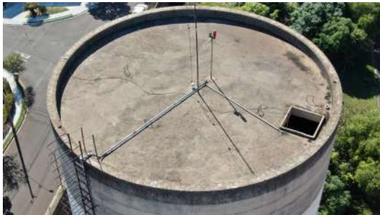
Foto 1 - Tubulação de ventilação no reservatório sem tela de proteção
