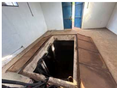
Foto 1 - Tampa de inspeção em más condições de conservação
