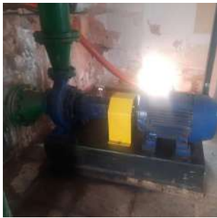
Foto 3 - Bomba da elevatória
