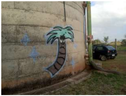
Foto 1 - Ausência do subsistema de aterramento
