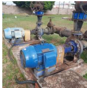
Foto 2 - Conjuntos motor-bomba da elevatória
