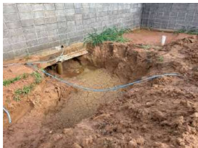
Foto 4 - Vala aberta na EEE
