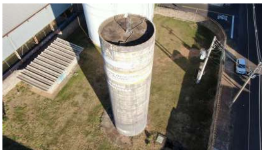
Foto 2 - Ausência de tela na tubulação
