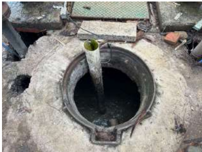
Foto 1 - Ausência de tampa na EEE
