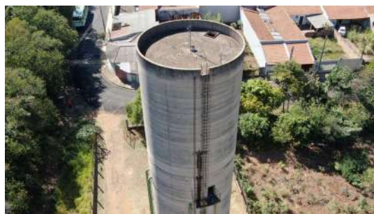
Foto 2 - Detalhe de vazamentos no reservatório
