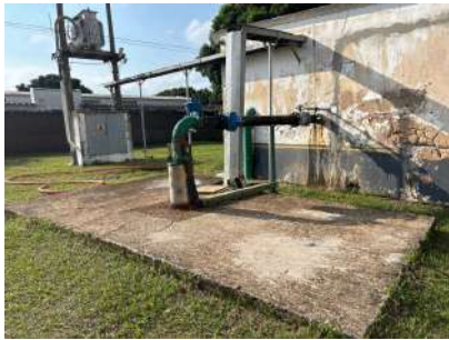
Foto 3 - Cavalete do poço São Carlos III
