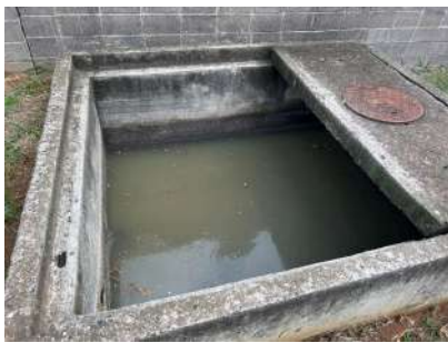
Foto 5 - Caixa de entrada de efluentes
