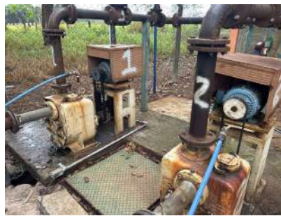
Foto 2 - Conjuntos motor-bomba da elevatória
