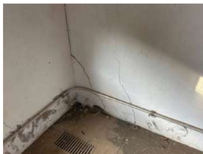
Foto 3 - Fissuras na edificação
