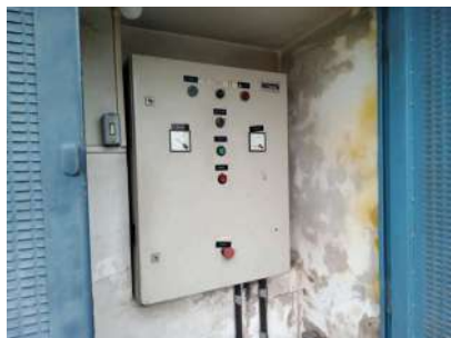
Foto 5 - Painel de comando e acionamento das bombas
