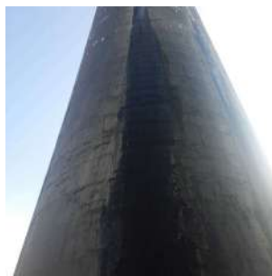
Foto 4 - Vazamentos no reservatório
