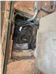
Foto 2 - Ausência de proteção no cabeamento elétrico
