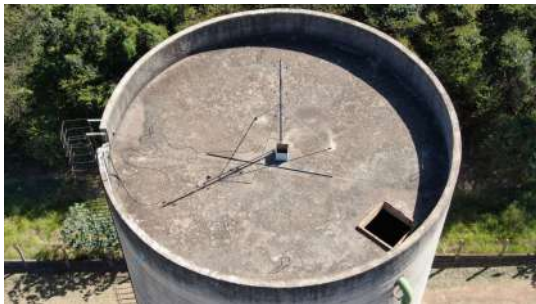
Foto 1 - Vista superior, com ausência de tampa de inspeção
