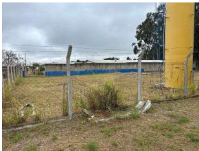
Foto 2 - Cercamento aberto e danificado
