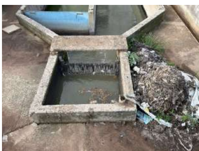
Foto 1 - Acúmulo de resíduos do gradeamento
