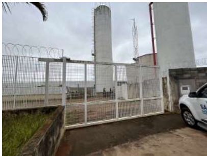
Foto 1 - Ausência de placa de identificação
