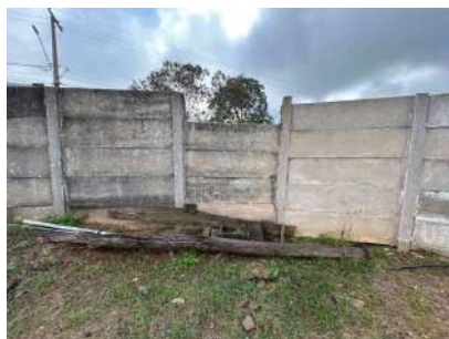
Foto 1 - Cercamento com falhas
