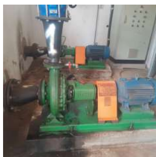
Foto 3 - Bombas da elevatória
