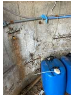
Foto 2 - Armadura exposta na área interna do reservatório
