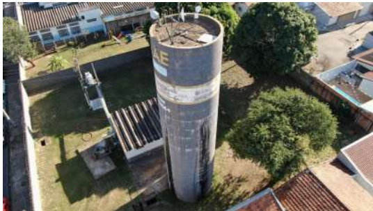
Foto 9 - Vista superior do poço, reservatório e EEAT São Carlos III
