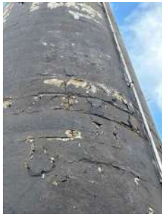
Foto 1 - Armadura exposta na área externa do reservatório
