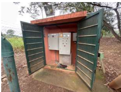
Foto 1 - Painel da EEE sem extintor
