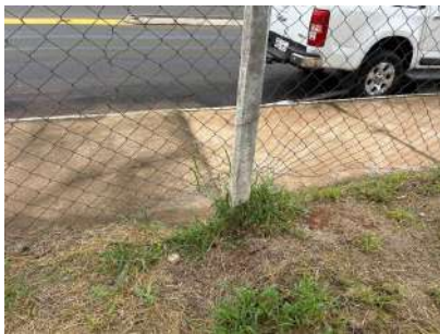
Foto 1 - Abertura no cercamento
