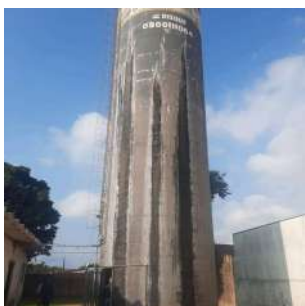
Foto 1 - Vazamentos no reservatório
