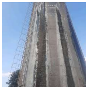
Foto 2 - Vazamentos no reservatório
