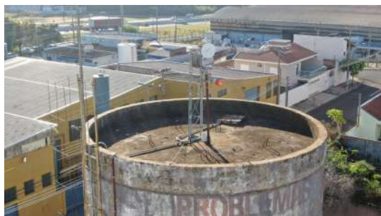
Foto 1 - Ausência de tela na tubulação
