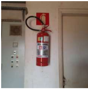
Foto 5 - Extintor da elevatória
