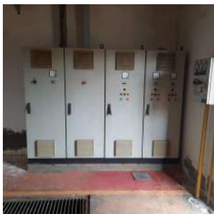
Foto 3 - Painel da elevatória
