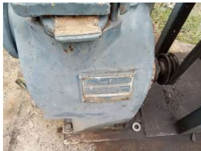
Foto 7 - Bomba da elevatória
