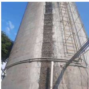
Foto 1 - Ausência do subsistema de descida e aterramento
