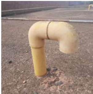
Foto 1 - Tubulação sem tela de proteção
