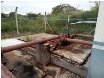
Foto 2 - Corrosão nas tampas da elevatória
