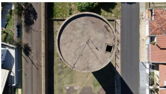
Foto 1 - Ausência de tampa no reservatório
