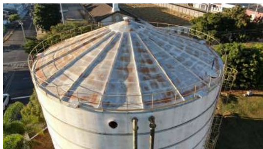
Foto 1 - Tampa semiaberta no reservatório
