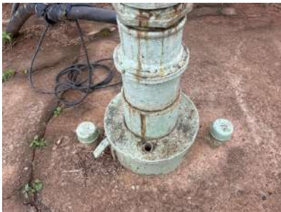
Foto 4 - Tubo de medição de nível
