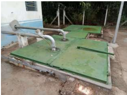
Foto 2 - Tampa do poço de sucção
