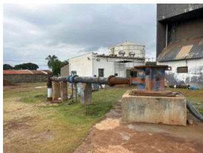
Foto 3 - Cavalete do poço
