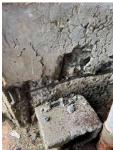
Foto 3 - Armadura exposta na área interna do reservatório
