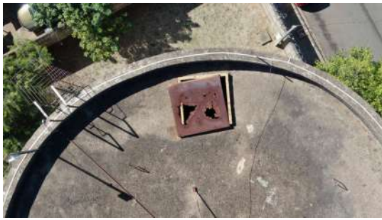
Foto 1 - Tapa de inspeção corroída
