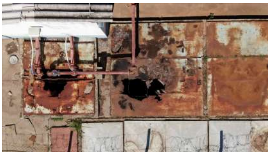
Foto 3 - Vista superior da corrosão nas tampas da elevatória
