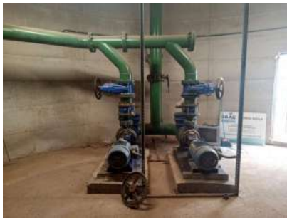
Foto 1 - Barrilete da elevatória
