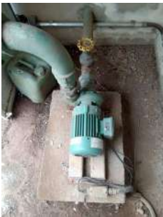
Foto 2 - Bomba da elevatória
