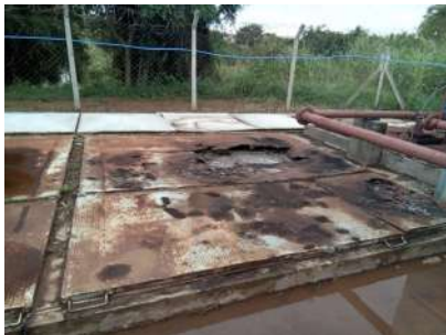
Foto 1 - Corrosão nas tampas da elevatória
