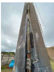
Foto 1 - Vazamento no reservatório
