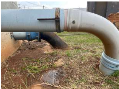
Foto 1 - Vazamento na tubulação do reservatório
