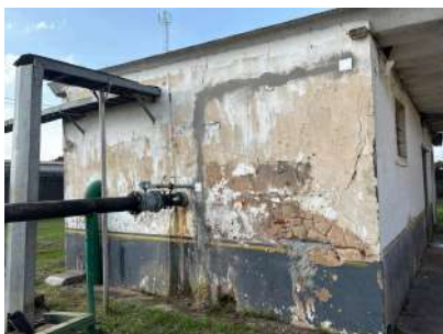
Foto 1 - Patologias diversas nas paredes
