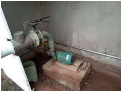
Foto 1 - Bomba da elevatória
