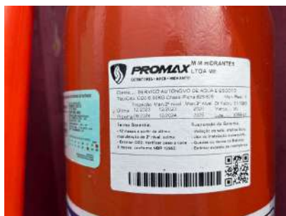
Foto 8 - Extintor dentro da validade
