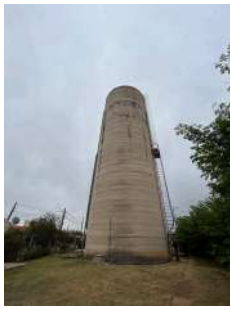
Foto 1 - Vazamentos no reservatório
