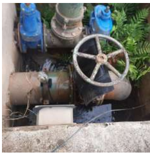
Foto 1 - Vazamento em tubulação do reservatório
