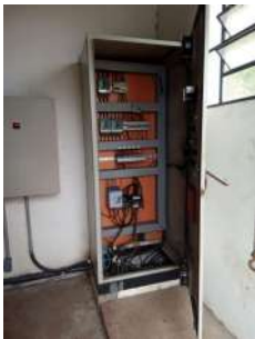
Foto 3 - Painel de comando e acionamento das bombas
