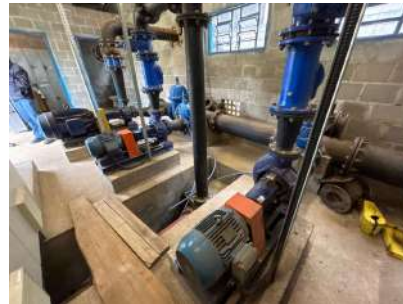
Foto 4 - Barrilete e bombas
