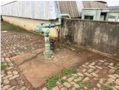
Foto 1 - Cavalete do poço
