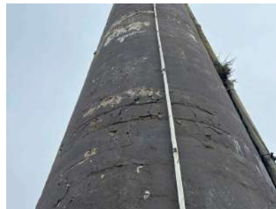
Foto 4 - Armadura exposta na área externa do reservatório
