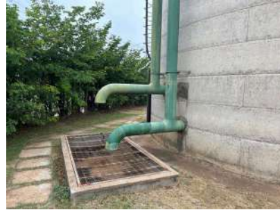
Foto 4 - Tubulações de extravasão e limpeza do reservatório
