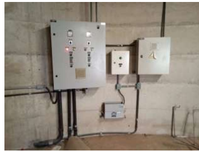
Foto 2 - Painele da elevatória
