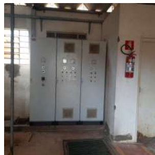
Foto 4 - Painel da elevatória
