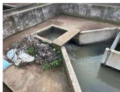
Foto 2 - Condicionamento dos resíduos inadequado
