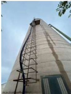
Foto 5 - Vazamentos no reservatório
