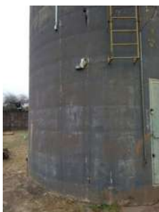
Foto 1 - Ausência do subsistema de descida e aterramento
