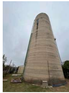
Foto 2 - Vazamentos no reservatório
