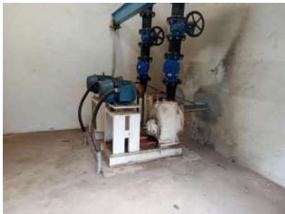
Foto 3 - Conjuntos motor-bomba da elevatória
