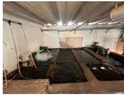
Foto 6 - Dosagem de cloro e flúor no tanque com chicanas
