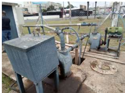
Foto 3 - Barrilete e bombas
