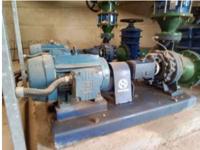
Foto 3 - Bombas da elevatória
