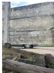
Foto 2 - Cercamento com falhas
