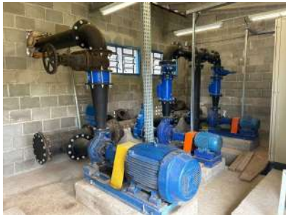
Foto 3 - Barrilete e bombas
