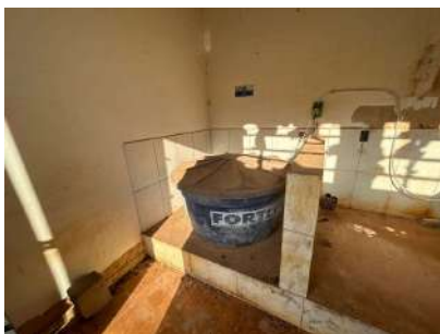
Foto 1 - Casa de química suja e em más condições de conservação
