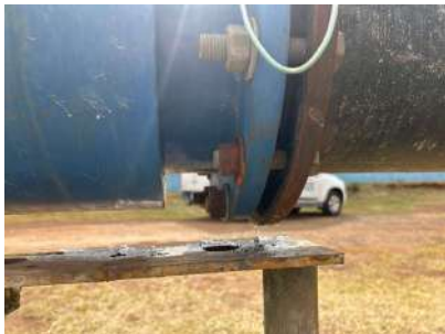
Foto 1 - Vazamento no cavalete
