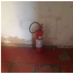
Foto 5 - Extintor de incêndio
