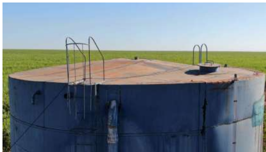
Foto 2 - Vale do sol - reservatório azul cobertura - tampas regulares
