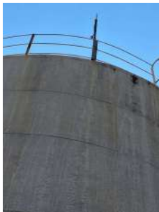
Foto 1 - Cabo de descida do para-raios cortado - - Centro de Reserva Vale do Sol
