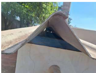
Foto 1 - Ausência de tela de proteção
