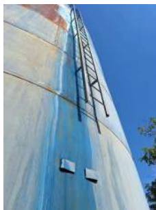
Foto 1 - Foco de vazamento - Centro de Reservação Vale do Sol - Reservatório azul
