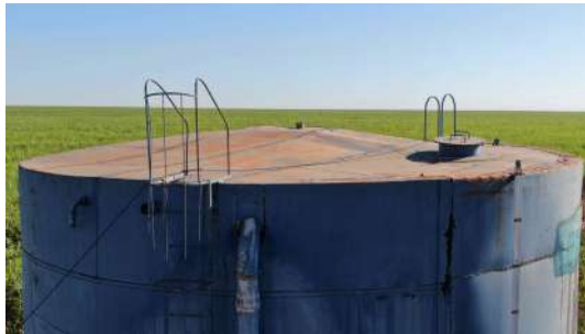
Foto 2 - Reservatório Azul - ausência de guarda-corpos
