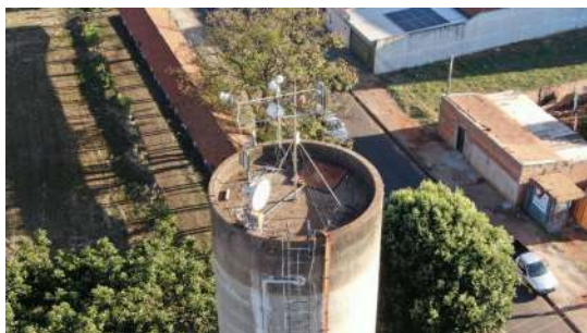
Foto 1 - Tampa de inspeção - COHAB I
