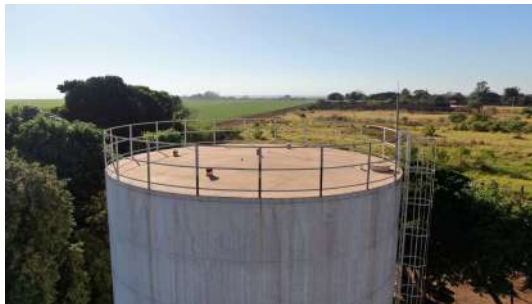
Foto 2 - Vista de cima, cabo de aterramento cortado.
