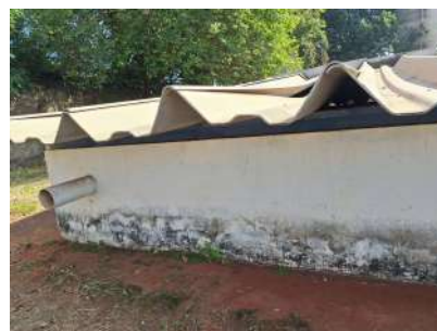
Foto 2 - Ausência de tela de proteção: pontos do telhado sem este item.
