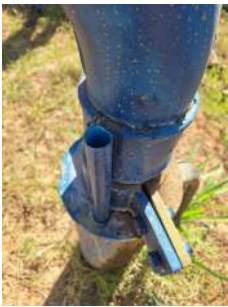
Foto 1 - Tubo medidor de nível instalado.
