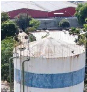
Foto 1 - Para raios - Reservatório Distrito Industrial
