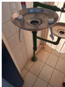
Foto 2 - Lavador de olhos sem conexão com rede de água
