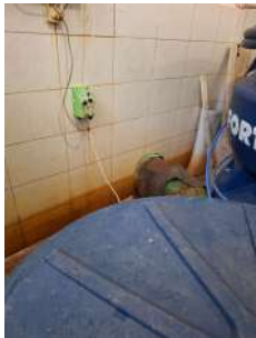
Foto 1 - Tanque contendo hipoclorito de sódio e bomba de dosagem do produto para o tanque de contato
