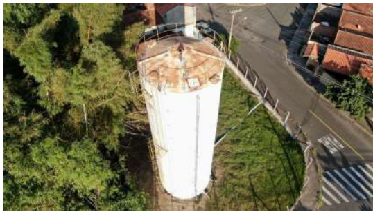
Foto 1 - Cobertura do RES 24 - Sistema Terra Nova - Ausência de para-raios
