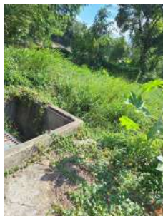
Foto 1 - Mato alto no momento da inspeção
