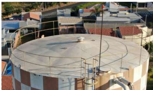
Foto 1 - RES 25 - Terra Nova - Cobertura sem para-raios
