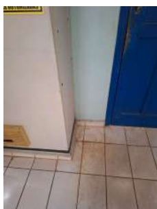
Foto 1 - Local onde ficaria posicionado extintor de incêndio.
