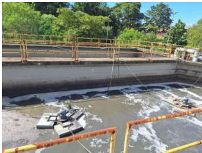
Foto 2 - Módulo de aeração -ETE Povo Feliz
