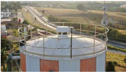
Foto 1 - Ausência de tela de proteção na ventilação
