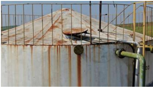
Foto 1 - RES 19 - Distrito Industrial - Tampa parcialmente aberta para entrada de tubulação
