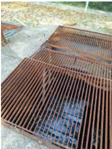
Foto 1 - Grade sobre o poço de sucção - esgoto parado ao fundo
