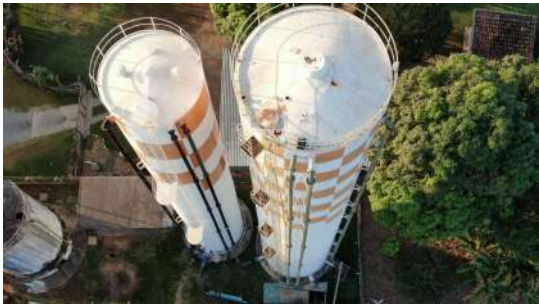
Foto 1 - Reservatórios - São Pedro - tampas regulares
