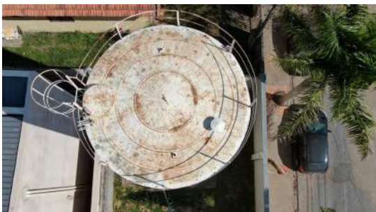
Foto 1 - Cobertura - Reservatório Moinho Novo - Tampa regular
