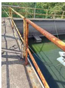
Foto 1 - Guarda corpos em estado de oxidação
