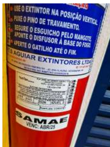
Foto 1 - Extintor, com validade regular
