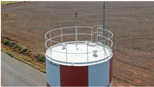
Foto 1 - Para-raios - Reservatório Jatobá
