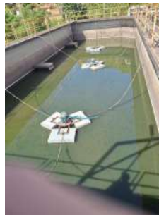
Foto 4 - Reator em paralelo: não ligado no momento da fiscalização, ausência de um aerador.
