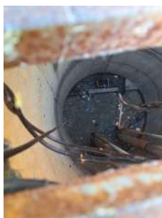
Foto 1 - Cesto de retenção de sólidos em funcionamento
