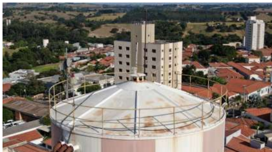
Foto 1 - Para-raios - Reservatório R03
