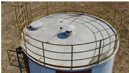
Foto 1 - RES 26 - TERRAS DO FRANCÊS - Cobertura - ausência de para-raios
