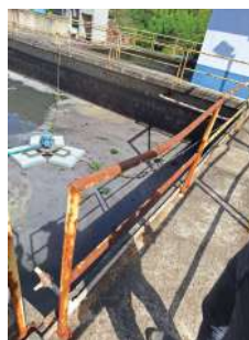
Foto 2 - Guarda corpos deteriorado por oxidação e torto
