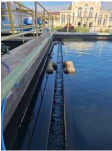
Foto 1 - Vertedor da unidade de decantação nivelado
