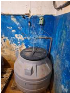
Foto 1 - Tanque contendo Ácido Fluossilícico com injeção no tanque de contato
