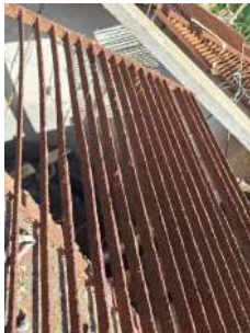
Foto 1 - Grade da elevatória - Deslocada do posicionamento correto e não oferecendo segurança
