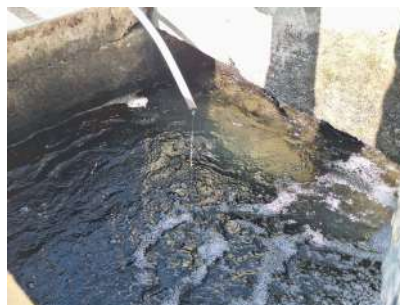
Foto 3 - Dosagem de hipoclorito de sódio em ponto de chegada da água
