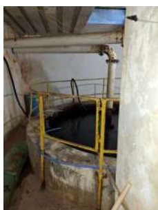
Foto 6 - Tanque de contato, recebendo dosagem de ortopolifosfato, hipoclorito de sódio e ácido fluossilícico
