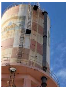
Foto 1 - Nível mecânico de indicação de volume do reservatório
