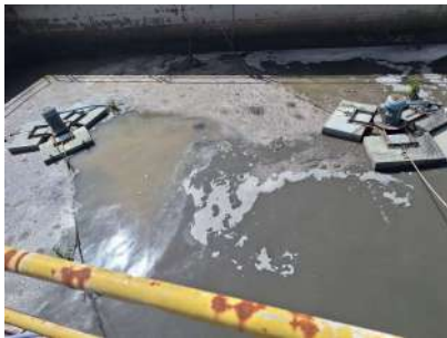
Foto 3 - Reator aeróbio: um aerador em funcionamento e outros dois com defeito.
