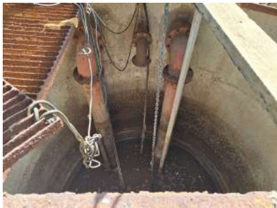
Foto 1 - Poço de sucção e apenas uma bomba instalada
