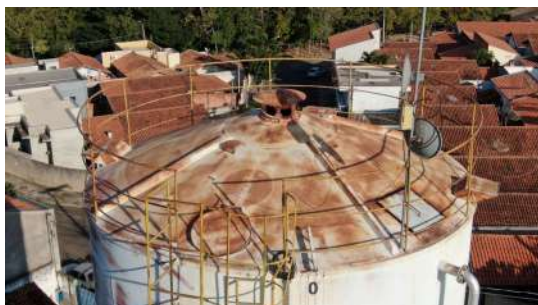
Foto 1 - Cobertura do RES 24 - Sistema Terra Nova - Ausência de tela de proteção na ventilação.
