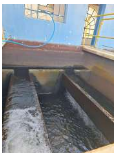
Foto 4 - Água vertendo para os filtros
