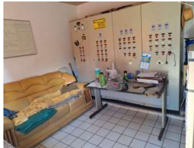
Foto 2 - Paineis de controle e acionamento da ETE juntamente com área de descanso e refeição do operador
