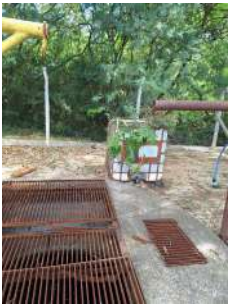
Foto 2 - Grade sobre poço de sucção; trave para içamento da bomba; proteção para acesso ao gradeamento.
