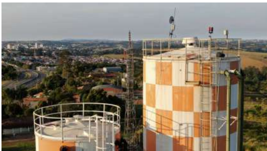
Foto 1 - Sistema São Pedro - ausência de para-raios
