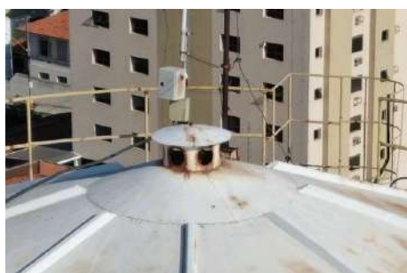
Foto 1 - Reservatório R03 - Ausência de Tela de Proteção
