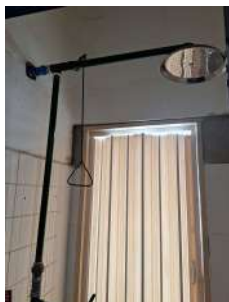
Foto 1 - Chuveiro de emergência
