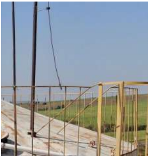
Foto 2 - Detalhe de cabo de aterramento do para-raios cortado
