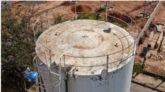
Foto 1 - Cobertura Reservatório Moinho Novo - Ausência de Para-raios
