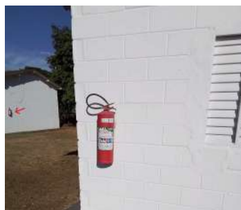
Foto 2 - Extintores de incêndio próximos ao Poço P67.
