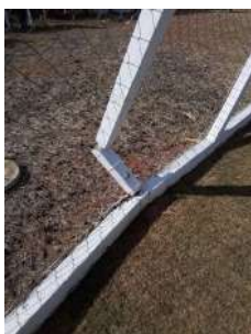
Foto 1 - Na data da fiscalização, um dos pilares da cerca estava danificado, sendo necessário o seu reparo.
