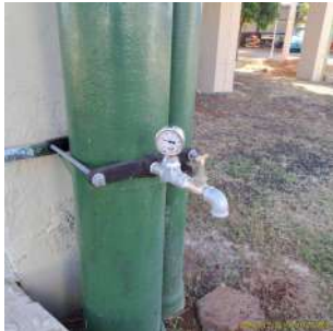
Foto 1 - Manômetro na saída do reservatório.
