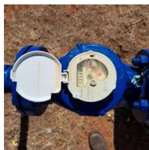
Foto 2 - Macromedidor no cavalete do poço.
