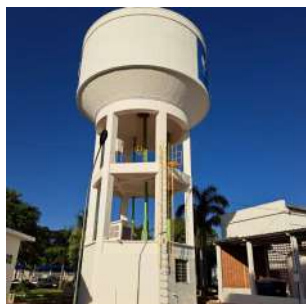
Foto 1 - Ausência de guarda-corpo no patamar intermediário do reservatório elevado.
