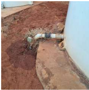
Foto 1 - Manômetro na tubulação de saída do reservatório.
