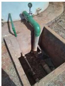
Foto 3 - Saída para a rede de distribuição.
