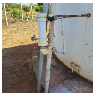
Foto 1 - Sistema de cloração por pastilha instalado na tubulação de recalque do Poço para o reservatório.
