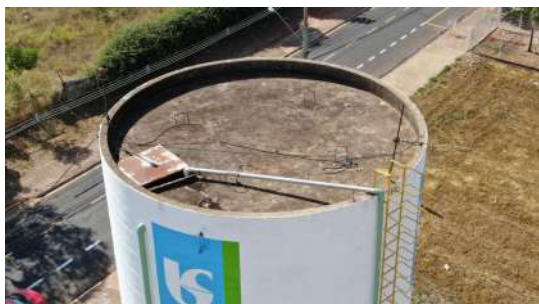
Foto 1 - Tampa de inspeção no topo do reservatório, deteriorada e semiaberta.
