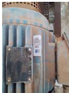
Foto 4 - Especificações da bomba.
