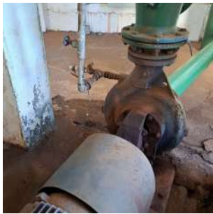
Foto 1 - Vazamento nas conexões da tubulação lateral da bomba 2.
