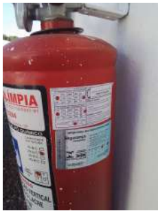
Foto 1 - Extintor com validade regular.
