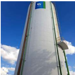
Foto 2 - Lateral 2 do reservatório com vazamento.
