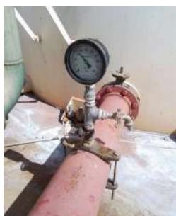
Foto 1 - Manômetro na base do reservatório.
