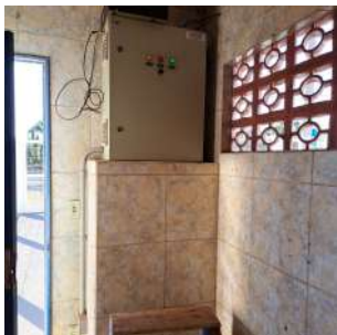
Foto 5 - Vista interna do abrigo do painel elétrico e de comando do Poço.
