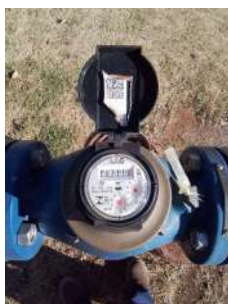
Foto 1 - Detalhe do macromedidor.
