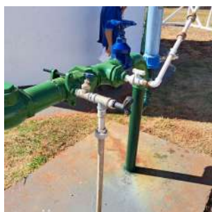
Foto 1 - Tomada de água bruta no cavalete do Poço.
