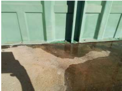
Foto 3 - Vazamento na base do refrigerador.
