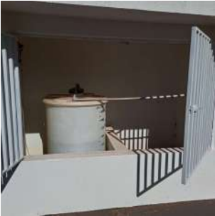
Foto 5 - Abrigo do tanque e da bomba dosadora de flúor.
