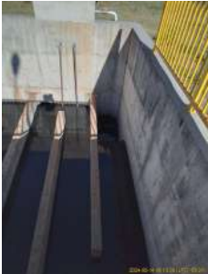
Foto 25 - Saída do efluente tratado.
