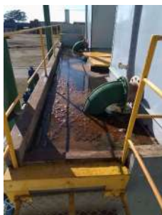
Foto 1 - Detalhe do acúmulo de água junto aos refrigeradores, logo após a passarela que os conecta ao reservatório.
