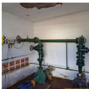
Foto 3 - Vista interna da EEAT.
