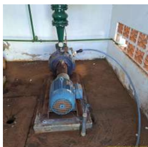
Foto 5 - Conjunto motobomba 1 (próximo à entrada).
