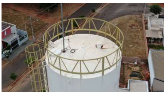
Foto 1 - Detalhe da haste do reservatório e condutor de descida ligado ao próprio reservatório.
