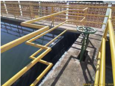
Foto 2 - Ausência de proteção adequada no trecho da passarela próximo ao registro (entre decantador e filtros).
