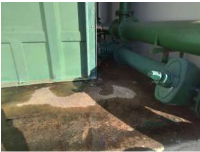
Foto 2 - Detalhe do vazamento junto às tubulações (vão entre refrigerador e abrigo).
