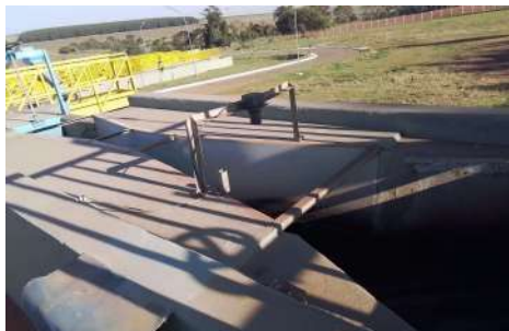
Foto 1 - Detalhe do macromedidor de entrada.
