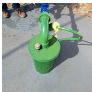
Foto 1 - Tubo de medição de nível.
