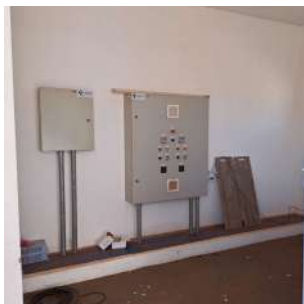
Foto 9 - Painel elétrico e de comando da EEE.
