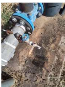
Foto 1 - Registro para coleta de água bruta.
