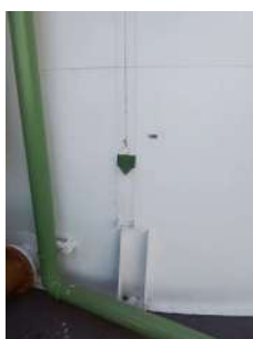
Foto 1 - Boia para controle do nível do reservatório.
