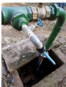
Foto 1 - Registro para coleta de água bruta.
