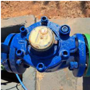
Foto 2 - Macromedidor no cavalete do poço.
