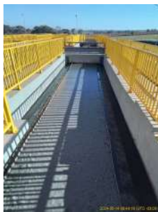
Foto 12 - Tanque 1 de lodo ativado.
