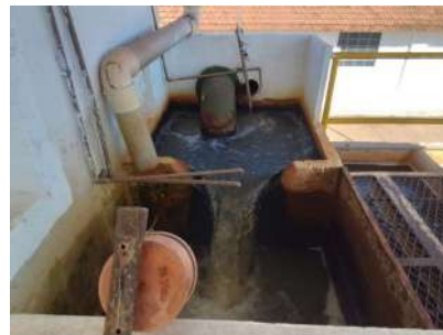
Foto 2 - Chegada de água bruta.
