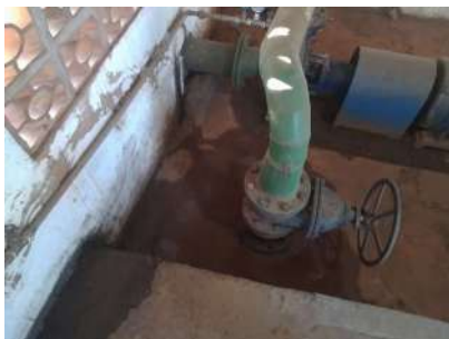
Foto 3 - Escoamento da água em direção à bomba 4.
