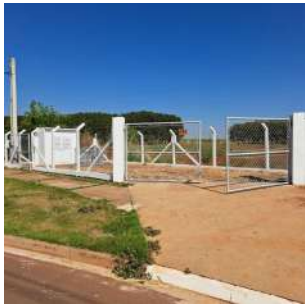
Foto 1 - Vista externa da área do Poço.
