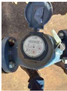
Foto 1 - Macromedidor em funcionamento.
