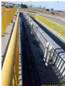
Foto 14 - Calha de distribuição de efluente entre os tanques. De acordo com o Prestador, o tanque 2 recebe uma vazão maior do que o tanque 1.
