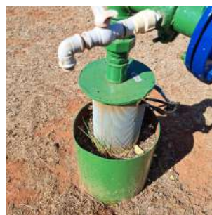
Foto 2 - Ausência de tubo para medição de nível do Poço.
