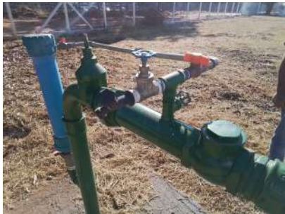
Foto 1 - Registro para coleta de água bruta.
