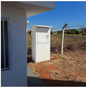
Foto 4 - Abrigo do painel elétrico e de comando.
