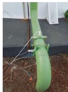
Foto 2 - Chegada de água oriunda dos poços, com aplicação de cloro e flúor.
