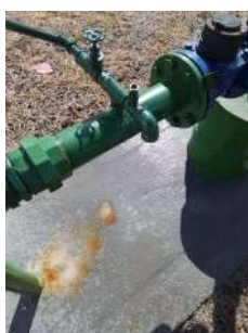
Foto 1 - Registro para coleta de água bruta.
