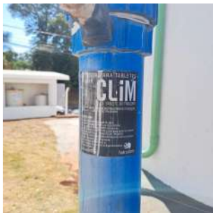
Foto 1 - Sistema de cloração por pastilha instalado no cavalete do Poço.
