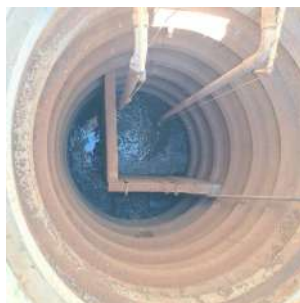
Foto 4 - Poço de chegada do esgoto e das tubulações de sucção das bombas de recalque.
