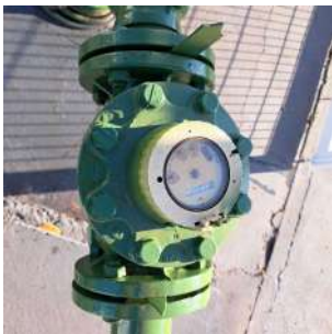
Foto 2 - Macromedidor no cavalete do poço.
