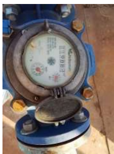
Foto 1 - Macromedidor em funcionamento.
