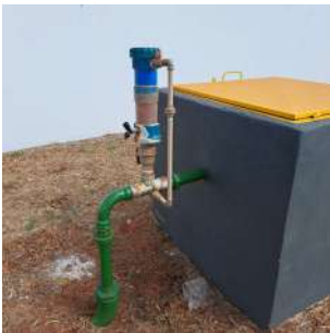
Foto 1 - Sistema de aplicação de cloro e flúor no cavalete do Poço.
