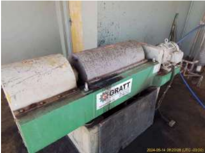
Foto 27 - Centrífuga usada na secagem do lodo.
