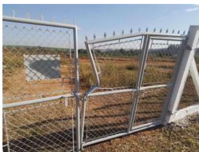
Foto 3 - Cerca danificada, próxima ao poço.
