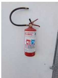
Foto 1 - Detalhe do extintor junto ao abrigo.
