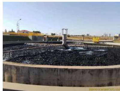
Foto 17 - Detalhe 1 do filtro
