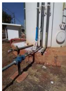
Foto 2 - Aplicação de cloro e flúor na chegada das tubulações ao reservatório (captação via poços).
