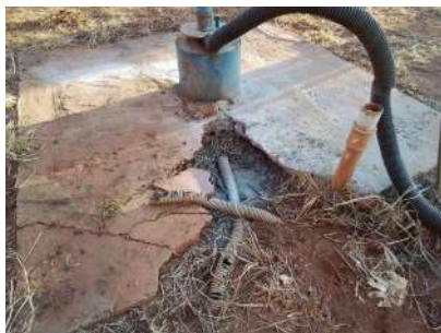
Foto 1 - Detalhe da laje danificada.
