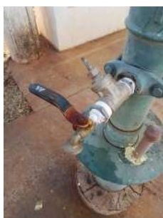
Foto 1 - Registro para coleta de água bruta.
