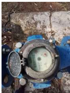
Foto 1 - Macromedidor em funcionamento.
