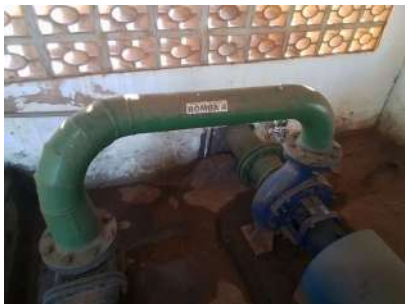
Foto 4 - Detalhe da bomba 4.
