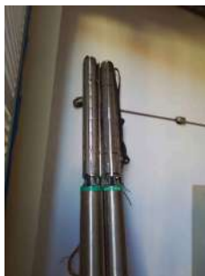
Foto 1 - Detalhe das bombas reservas do Poço Profundo 2.
