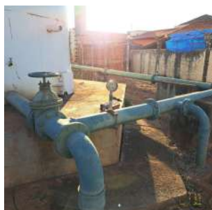
Foto 1 - Manômetro na tubulação de saída.
