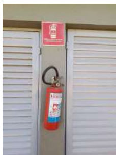
Foto 1 - Extintor de incêndio junto ao painel elétrico.
