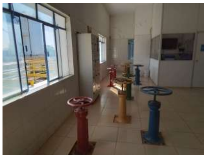
Foto 9 - Vista geral interna da ETA (registros de manobras e sala do sistema supervisório).
