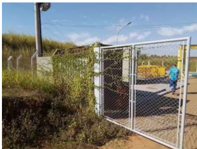
Foto 1 - Há crescimento de vegetação no cercamento da EEEF. É necessário fazer a remoção desse material da cerca.
