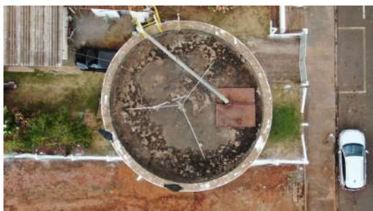
Foto 1 - Detalhe da tampa de inspeção com sinal de deterioração. Recomenda-se verificar a condição da mesma.
