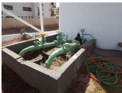
Foto 3 - Tubulações na saída do reservatório.
