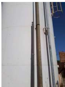
Foto 1 - Local onde estaria o condutor de descida (proteção à esquerda).
