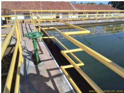
Foto 3 - Ausência de proteção adequada no trecho da passarela próximo ao registro (entre decantador e filtros).
