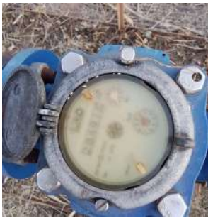
Foto 1 - Macromedidor em funcionamento.
