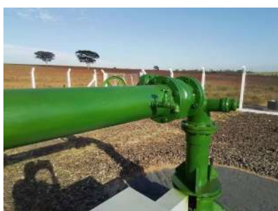
Foto 1 - Registro para coleta de água bruta.
