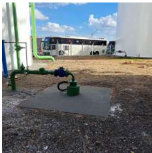
Foto 2 - Vista do Poço P-72 e dos reservatórios Viva Olímpia ao fundo.
