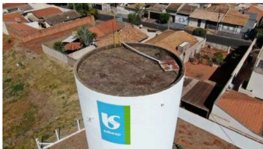
Foto 2 - Topo do reservatório sem guarda-corpos.
