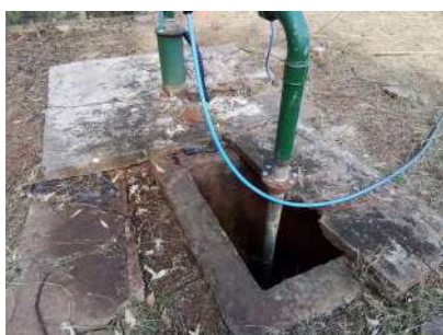
Foto 1 - Detalhe da abertura junto ao Poço P52.
