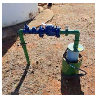
Foto 1 - Ausência da laje de proteção.
