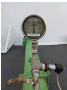
Foto 1 - Detalhe do manômetro na base do reservatório.
