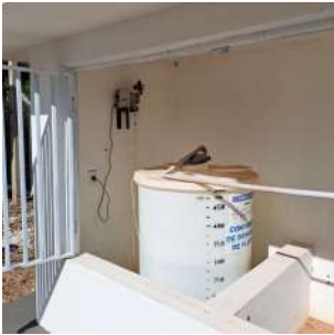
Foto 6 - Abrigo do tanque e da bomba dosadora de flúor.
