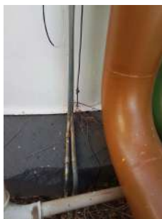
Foto 1 - O reservatório dispõe de haste de para-raios (conforme fotos gerais) e condutor de descida.
