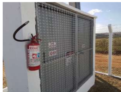
Foto 2 - Detalhe do extintor junto aos painéis elétricos.
