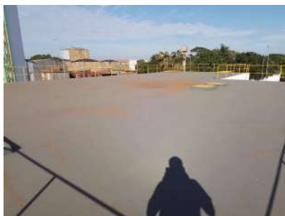
Foto 1 - Detalhe do topo do reservatório, sem qualquer tubulação de ventilação.
