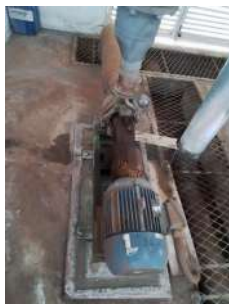
Foto 3 - Detalhe da bomba 2.
