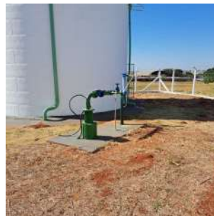
Foto 2 - Vista geral do reservatório Tropical e do Poço P68.
