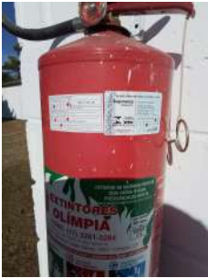
Foto 1 - Extintor próximo ao Poço P67 e dentro da validade.
