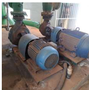
Foto 5 - Conjuntos motobomba (1+1R) da EEAT: conjunto nº1 (à direita, próximo à entrada) e nº 2 (esquerda).
