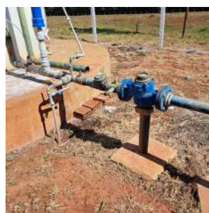
Foto 2 - Tomada de água bruta no cavalete do Poço.
