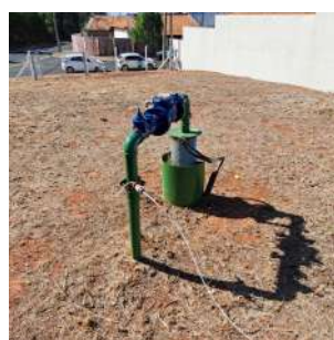
Foto 2 - Dosagem de flúor na tubulação de saída do Poço.
