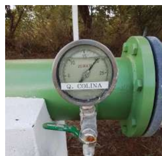
Foto 2 - Manômetro na base do reservatório.
