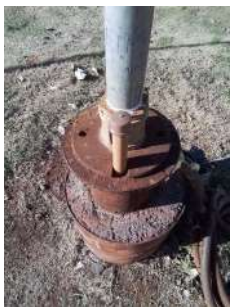
Foto 1 - Tubo de medição de nível.
