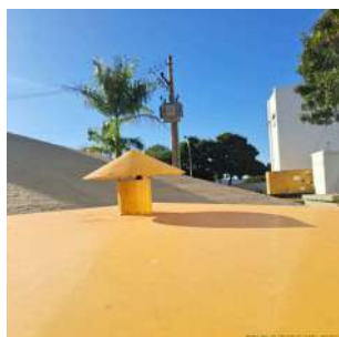
Foto 1 - Detalhe do tubo de ventilação sem tela de proteção.
