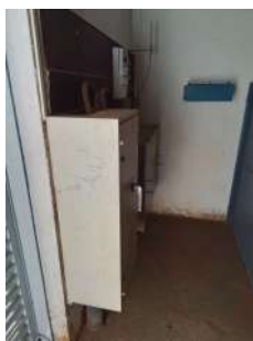
Foto 14 - Pannel elétrico junto ao trafo.
