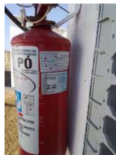
Foto 2 - Extintor próximo aos painéis elétricos com validade regular.
