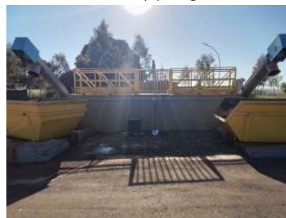
Foto 7 - Tanques de areia e caçambas.
