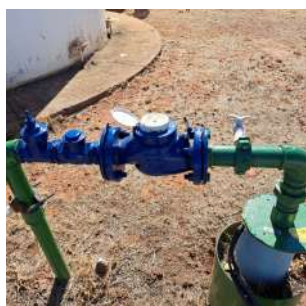
Foto 1 - Macromedidor no cavalete do poço.
