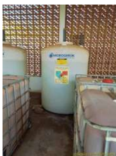
Foto 6 - Tanque de hipoclorito de sódio.
