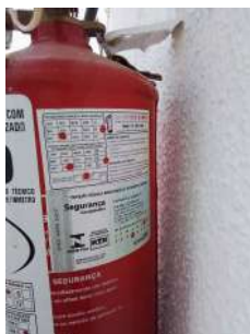
Foto 1 - Extintor próximo ao abrigo com validade regular.
