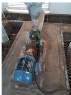
Foto 5 - Detalhe da bomba 1.
