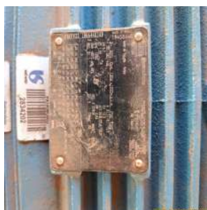
Foto 6 - Placa de especificações técnicas do motor do conjunto motobomba 1.
