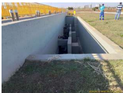
Foto 1 - Local sem guarda-corpo, junto aos registros de manobra do tanque 2.
