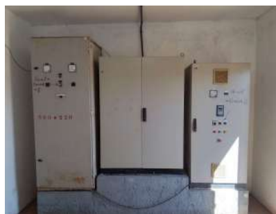
Foto 15 - Detalhe dos painéis elétricos da captação. dentro do abrigo
