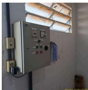
Foto 4 - Painel elétrico e de comando da EEAT.
