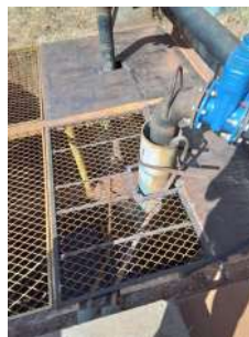
Foto 9 - Detalhe do recalque.
