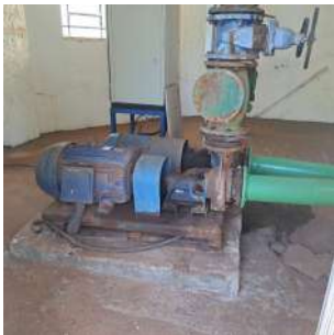
Foto 2 - Conjuntos motobomba da EEAT.
