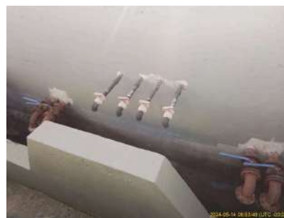
Foto 2 - Os registros usados ficam em local de difícil acesso pelo operador, representando risco de queda durante o seu manuseio.
