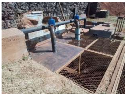
Foto 8 - Detalhe da tubulação de recalque.
