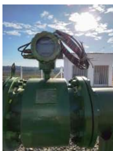
Foto 1 - Macromedidor junto ao Poço Profundo 2.
