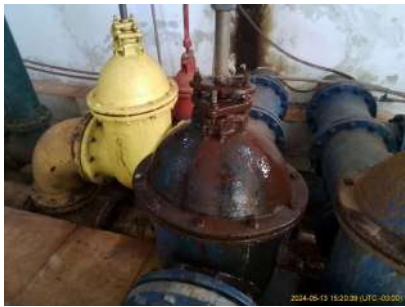
Foto 2 - Detalhe do vazamento em um dos registros.
