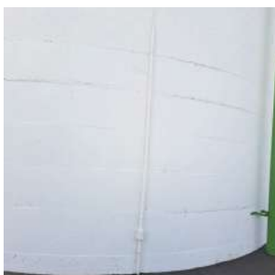
Foto 1 - Sistema de descida do SPDA.
