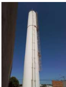
Foto 1 - Guarda-corpos na lateral do reservatório.
