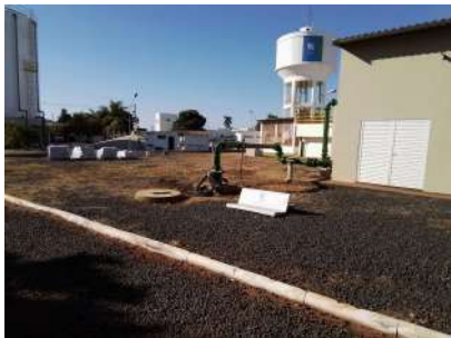
Foto 1 - Vista geral do Poço Profundo I.
