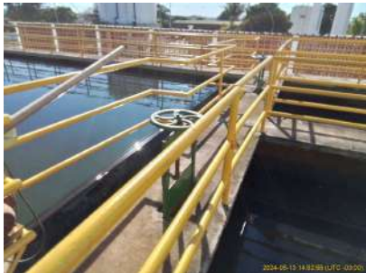
Foto 1 - Ausência de proteção adequada no trecho da passarela próximo ao registro (entre decantador e filtros).
