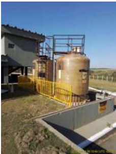
Foto 1 - Tanques dentro de área de contenção
