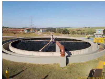
Foto 15 - Filtro após os tanques de lodo ativado. De acordo com o Prestador, o nivelamento dos filtros é feito a cada 3 meses.
