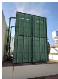
Foto 4 - Vista dos refrigeradores do Poço Profundo I.
