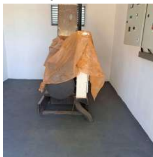
Foto 6 - Vista interna do abrigo dos painéis elétricos e de comando e do gerador da EEE.
