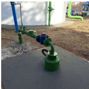
Foto 1 - Vista do Poço P-72.
