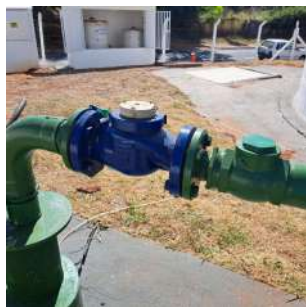
Foto 1 - Macromedidor no cavalete do poço.
