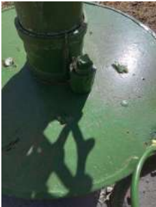
Foto 1 - Tubo de medição de nível.
