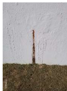
Foto 2 - Detalhe do vazamento.
