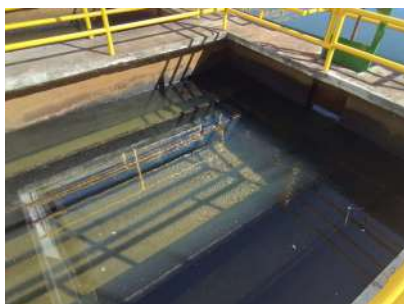
Foto 7 - Vista de um dos filtros.
