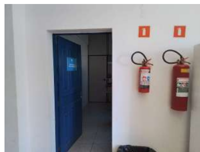
Foto 2 - Extintores de incêndio da ETA.
