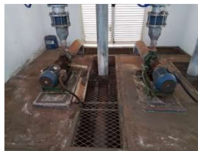
Foto 6 - Bombas da EEA (1+1R).
