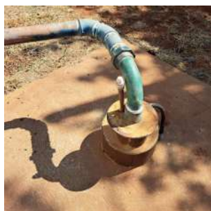
Foto 1 - Tubo de medição de nível.
