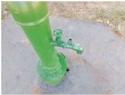
Foto 1 - Registro para coleta de água bruta.
