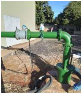
Foto 2 - Tomada de água para coleta de água bruta instalada.
