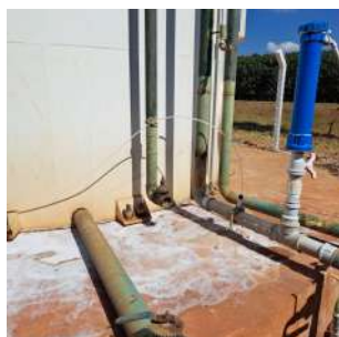
Foto 3 - Sistema de cloração no cavalete do Poço e dosagem de flúor na tubulação de recalque para o reservatório elevado.
