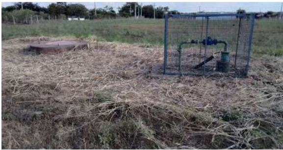
Foto 2 - Detalhe do acúmulo de vegetação roçada junto ao Poço P83.
