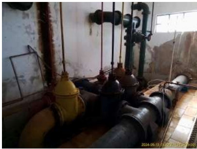
Foto 1 - Barrilete de saída da água filtrada.
