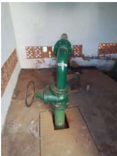
Foto 2 - Detalhe da bomba 3.
