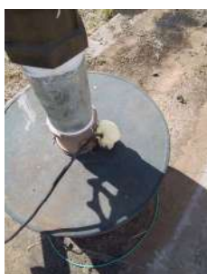
Foto 1 - Tubo de medição de nível.
