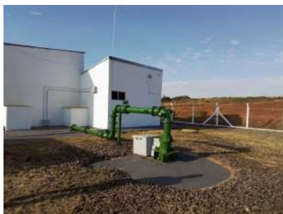
Foto 1 - Vista geral do Poço Profundo 2.
