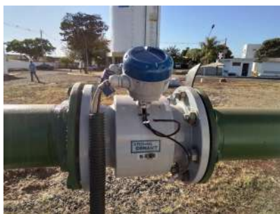
Foto 3 - Detalhe do medidor de vazão. O visor fica dentro do abrigo próximo aos refrigeradores.
