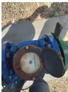
Foto 1 - Macromedidor em funcionamento.
