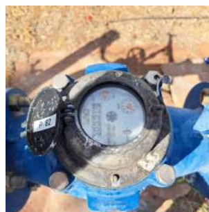
Foto 2 - Macromedidor no cavalete do Poço.
