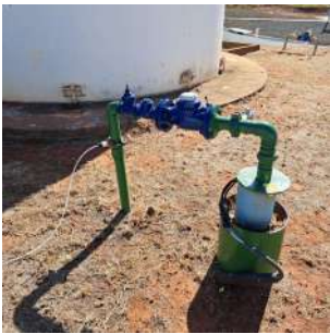
Foto 3 - Vista do Poço P54.
