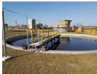
Foto 19 - Decantadores após os filtros.
