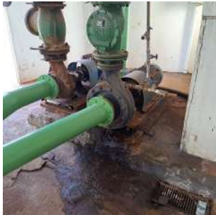
Foto 3 - Detalhe do piso molhado devido ao vazamento na bomba 2.
