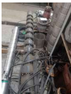
Foto 1 - Detalhe da bomba reserva - imagem cedida pelo Prestador.
