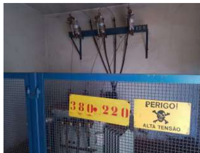
Foto 13 - Transformador junto à captação.
