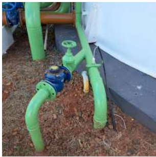
Foto 2 - Ponto de dosagem do flúor na tubulação de chegada ao reservatório.
