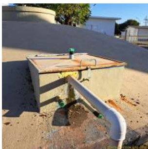
Foto 1 - Situação de uma das tampas de inspeção do reservatório.
