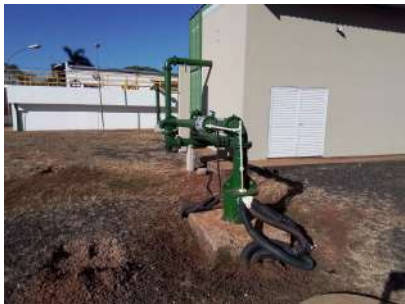
Foto 2 - Vista geral do Poço Profundo I.
