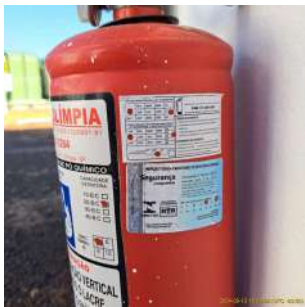
Foto 1 - Validade do extintor de incêndio próximo à EEAT dentro do prazo adequado.
