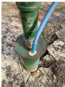
Foto 1 - Tubo de medição de nível.
