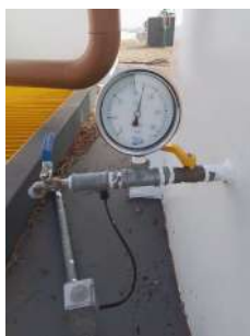
Foto 1 - Manômetro na base do reservatório.
