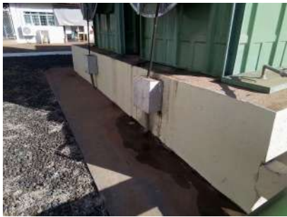
Foto 1 - Vazamento identificado junto aos refrigeradores.
