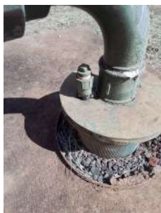
Foto 1 - Tubo de medição de nível.
