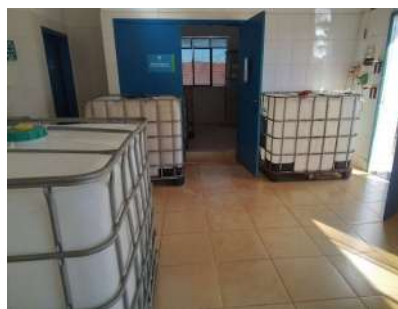
Foto 2 - Tanques de produtos químicos (hipoclorito) sem bacias de contenção.
