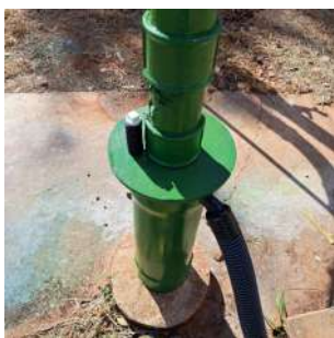
Foto 1 - Tubo de medição de nível.
