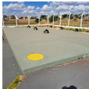
Foto 4 - Tanque pulmão da EEE.
