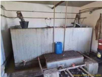
Foto 2 - Tanque de polímeros dentro de área de contenção.
