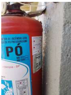
Foto 1 - Extintor com validade regular.
