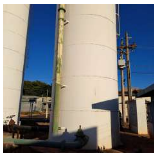
Foto 1 - Tubo extravasor do reservatório de maior altura.
