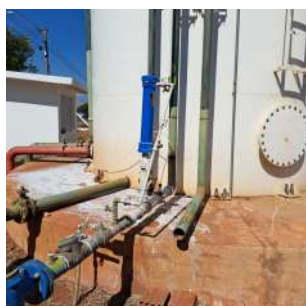
Foto 1 - Sistema de cloração no cavalete do Poço.
