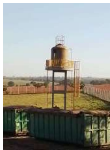
Foto 4 - Reservatório de água de reúso.
