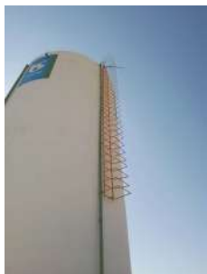
Foto 1 - Guarda-corpos na lateral do reservatório.
