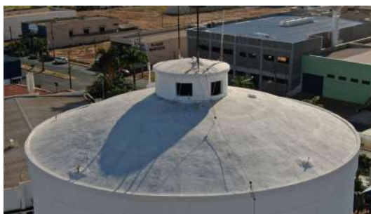
Foto 2 - Detalhe das aberturas na estrutura no topo da laje do reservatório elevado.
