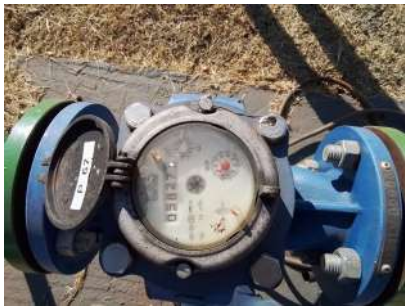
Foto 1 - Macromedidor do Poço P67.
