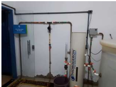
Foto 17 - Dosagem de cloro na água tratada.
