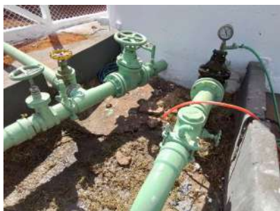
Foto 1 - Foto 1 do vazamento.
