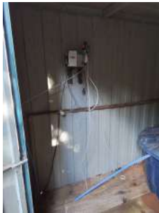
Foto 2 - Bomba para aplicação de cloro e flúor.
