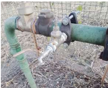
Foto 1 - Registro para coleta de água bruta.
