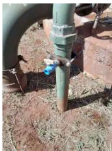
Foto 1 - Registro para coleta de água bruta.
