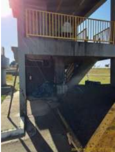
Foto 28 - Casa de secagem do lodo.
