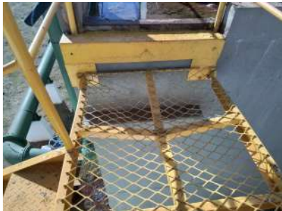
Foto 2 - Detalhe do afundamento na passarela que liga o reservatório aos refrigeradores.
