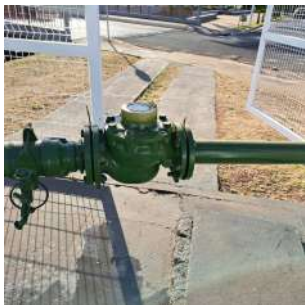
Foto 1 - Macromedidor no cavalete do poço.
