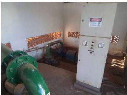
Foto 3 - Vista do interior da elevatória.
