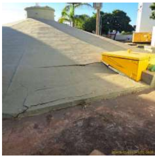
Foto 1 - Situação da laje do reservatório no momento da fiscalização.
