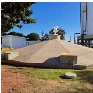
Foto 4 - Vista geral do reservatório semienterrado e do elevado metálico (direita) e EEAT Jd. Toledo (esquerda).
