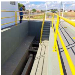
Foto 5 - Chegada de esgoto na EEE e gradeamento grosseiro.
