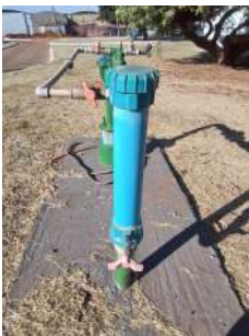
Foto 1 - Detalhe da aplicação de cloro e flúor por pastilhas.
