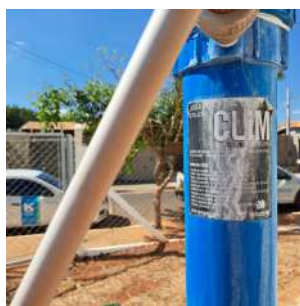
Foto 2 - Sistema de cloração no cavalete do Poço.
