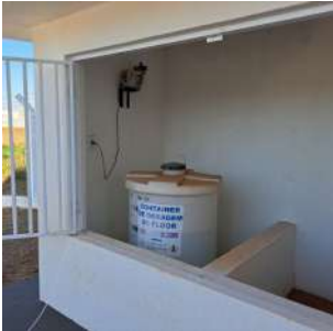
Foto 5 - Abrigo dos tanques de flúor e da bomba dosadora.
