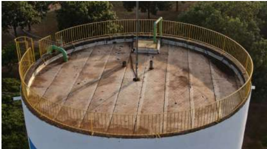
Foto 1 - Tubulação de ventilação.
