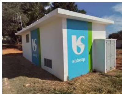
Foto 17 - Abrigo dos painéis elétricos e trafo.
