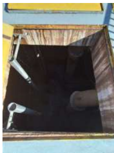
Foto 1 - Poço com duas bombas, sendo 1 reserva (1+1R).
