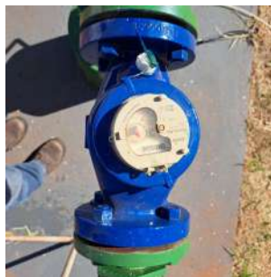
Foto 2 - Macromedidor no cavalete do poço.
