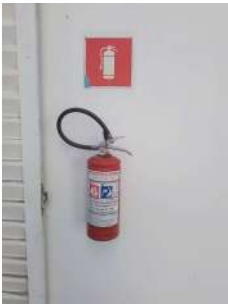
Foto 1 - Extintor na fachada da elevatória.
