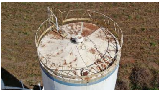
Foto 5 - Topo do reservatório, com sinais de deterioração.
