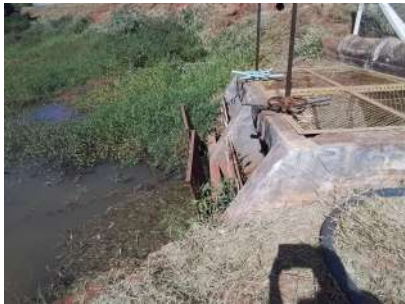
Foto 1 - Detalhe 1 do gradeamento deteriorado.
