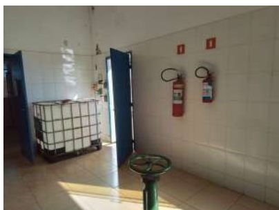
Foto 1 - Extintores de incêndio da ETA.
