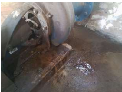
Foto 1 - Detalhe da ausência de drenagem.
