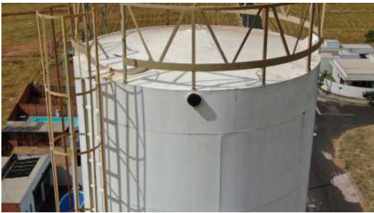
Foto 1 - Detalhe do extravasor sem tela de proteção contra entrada de insetos e pequenos animais.
