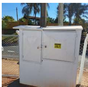
Foto 7 - Painel elétrico e de comando do Poço.
