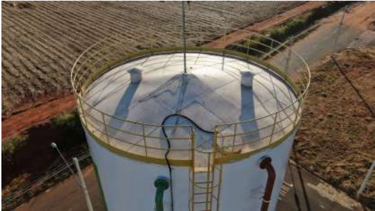
Foto 3 - Ventilação e tampas de inspeção no topo do reservatório.
