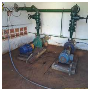
Foto 2 - Vista interna da EEAT e os conjuntos motobomba de recalque (1+1R).
