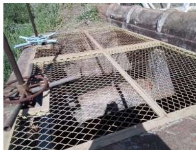
Foto 5 - Entrada dos canais junto ao gradeamento.
