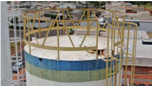
Foto 2 - Cobertura do reservatório elevado (100m³) sem tubulação de respiro (ventilação).
