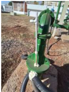
Foto 1 - Tubo de medição de nível.
