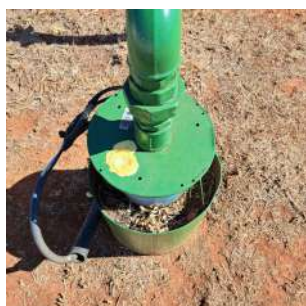
Foto 1 - Ausência de tubo para medição de nível do Poço.
