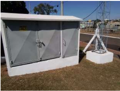
Foto 2 - Painéis elétricos junto ao Poço P2.
