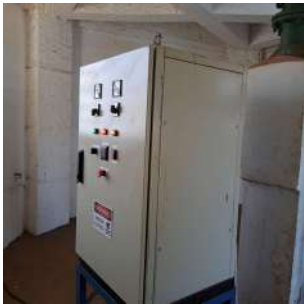
Foto 3 - Paineis elétrico e de comando da EEAT.
