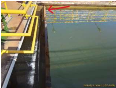
Foto 2 - Indicação do local desnivelado.
