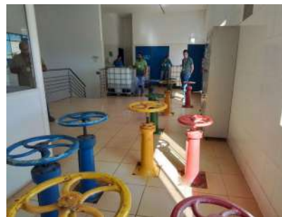
Foto 10 - Vista geral interna da ETA (registros de manobras e abrigo de parte dos produtos químicos).
