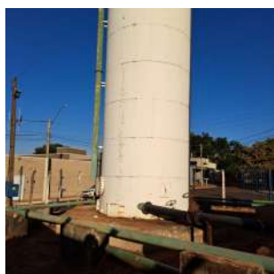
Foto 3 - Tubo extravasor do reservatório de menor altura.
