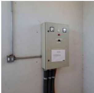
Foto 4 - Pannel elétrico e de comando do Poço.
