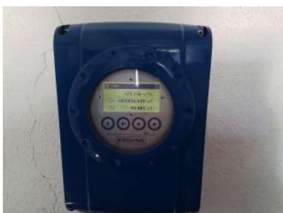
Foto 1 - Visor do macromedidor, localizado dentro do abrigo junto aos refrigeradores.
