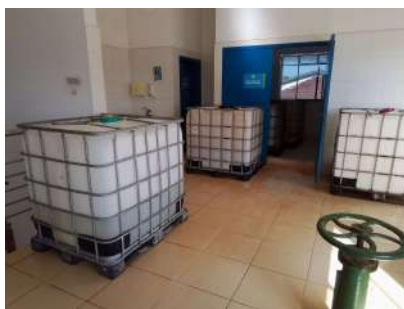
Foto 1 - Tanques de produtos químicos (hipoclorito) sem bacias de contenção.
