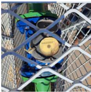
Foto 2 - Macromedidor no cavalete do Poço.
