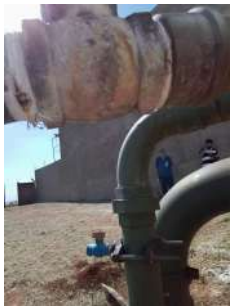
Foto 1 - Vazamento identificado na tubulação entre Poço e Reservatório, mais próximo deste.
