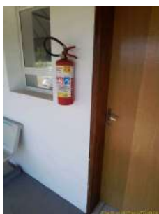
Foto 1 - Extintor junto à área administrativa.
