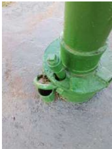
Foto 1 - Tubo de medição de nível.
