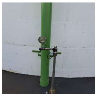
Foto 1 - Manômetro da tubulação de saída do reservatório.
