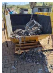
Foto 6 - Caçamba com acúmulo de material retido no gradeamento grosseiro.
