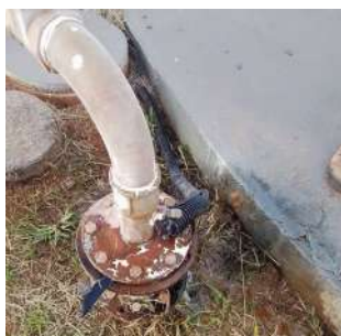
Foto 1 - Vazamento na tubulação próxima à base do reservatório apoiado.
