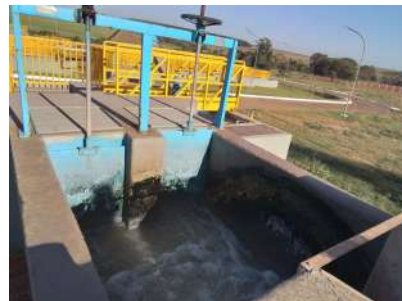
Foto 5 - Comportas para divisão de vazão entre as caixas de areia (após gradeamento).
