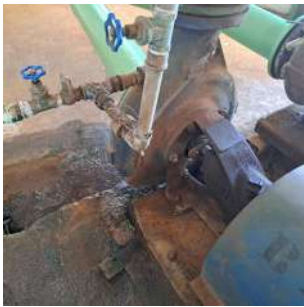
Foto 2 - Vazamento nas conexões da tubulação lateral da bomba 2.
