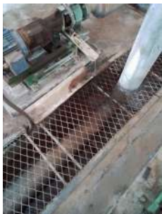
Foto 1 - Acúmulo de água no canal entre as bombas.
