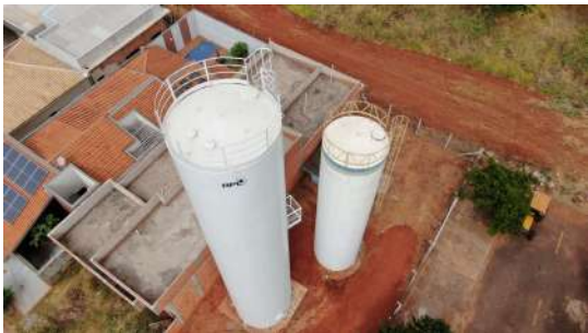
Foto 1 - Cobertura do reservatório elevado (100m³) sem tubulação de respiro (ventilação).
