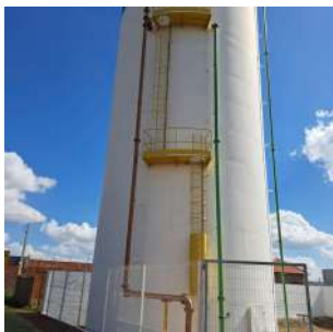
Foto 1 - Tubo extravasor do reservatório.
