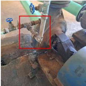
Foto 4 - Detalhe do vazamento nas conexões da tubulação lateral da bomba 2.
