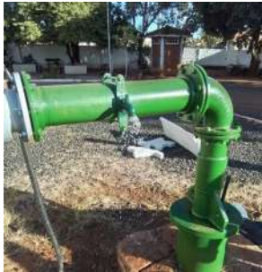
Foto 3 - Registro aberto da tomada de água.
