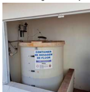
Foto 6 - Abrigo dos tanques de flúor e da bomba dosadora.
