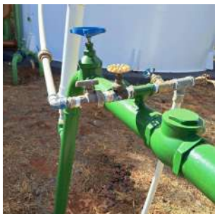
Foto 1 - Vazamento no registro da tubulação do sistema de cloração do Poço.
