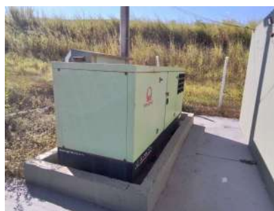
Foto 2 - Gerador da EEEF.
