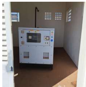
Foto 10 - Gerador de emergência da EEE.
