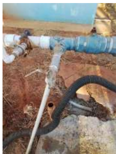
Foto 1 - Registro para coleta de água bruta.
