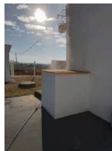
Foto 4 - Detalhe da saída de vapor junto ao reservatório.
