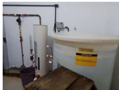
Foto 16 - Dosagem de cloro na água tratada.
