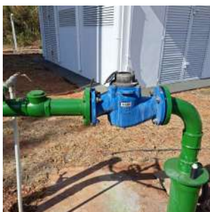
Foto 1 - Macromedidor no cavalete do Poço.
