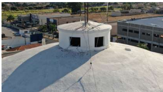
Foto 3 - Detalhe das aberturas na estrutura no topo da laje do reservatório elevado.
