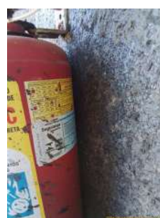
Foto 2 - Validade regular do extintor junto à centrífuga.
