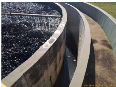
Foto 18 - Detalhe 2 do filtro.
