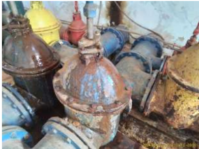
Foto 3 - Detalhe do vazamento em outro registro (ao lado do apontado na Foto 2 anterior).
