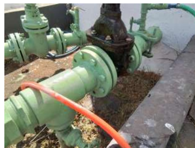
Foto 2 - Foto 2 do vazamento.
