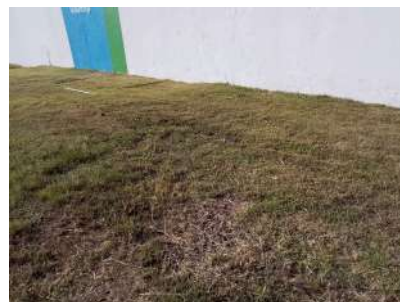
Foto 2 - Acúmulo de água na frente do reservatório, sendo necessário verificar a sua origem e tomar as providências necessárias.
