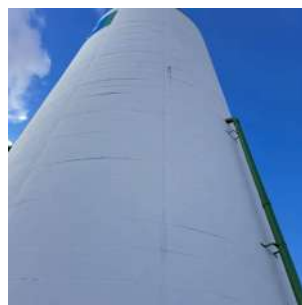
Foto 2 - Sistema de descida do SPDA.
