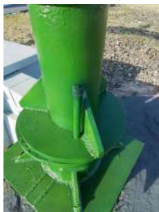
Foto 1 - Tubo de medição de nível.
