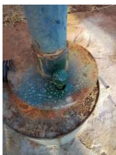
Foto 1 - Tubo de medição de nível.
