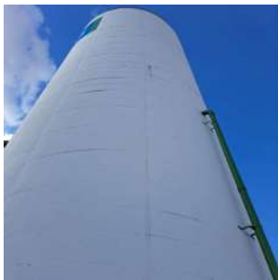
Foto 1 - Lateral 1 do reservatório com vazamento.
