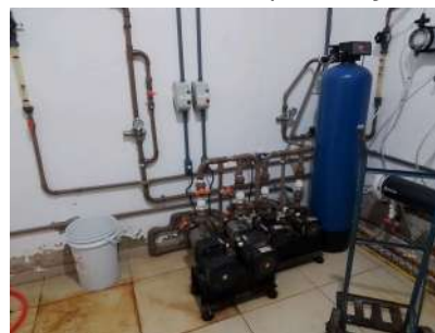
Foto 14 - Sistema de geração de hipoclorito para aplicação na água bruta e tratada.
