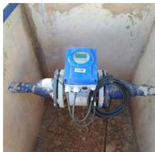
Foto 1 - Macromedidor no cavalete do poço.
