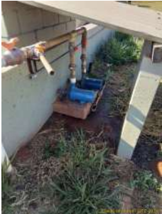
Foto 26 - Bombas usadas para direcionamento de água de reúso.
