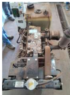
Foto 2 - Gerador junto à EEA.
