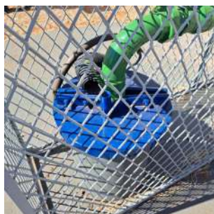
Foto 1 - Tubo para medição de nível do Poço.
