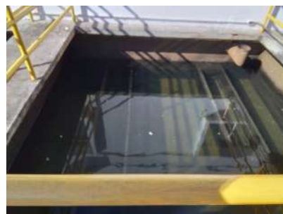
Foto 8 - Vista de um dos filtros.
