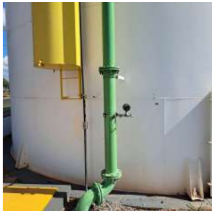
Foto 1 - Manômetro na tubulação de saída do reservatório.
