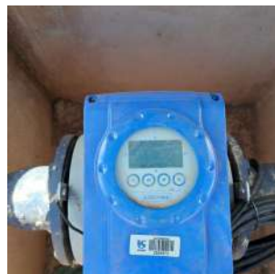
Foto 2 - Macromedidor no cavalete do poço.
