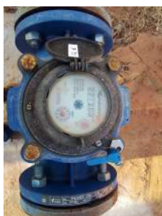
Foto 1 - Macromedidor em funcionamento.
