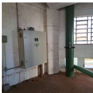
Foto 4 - Pannel elétrico e de comando da EEAT.
