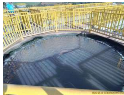
Foto 13 - Aeração dos tanques.
