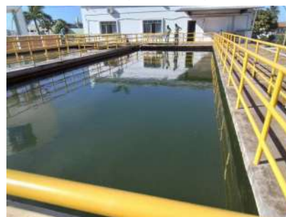
Foto 4 - Vista de um dos decantadores (paralelos).
