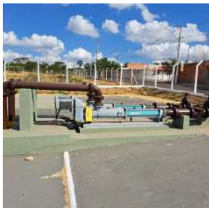
Foto 3 - Conjuntos motobomba (1+1R) da EEE.
