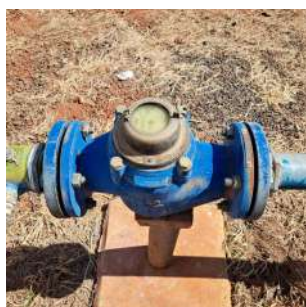
Foto 1 - Macromedidor no cavalete do Poço.
