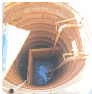
Foto 8 - Poço de chegada do esgoto e das tubulações de sucção das bombas de recalque.
