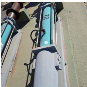
Foto 7 - Conjunto motobomba 2 da EEE.
