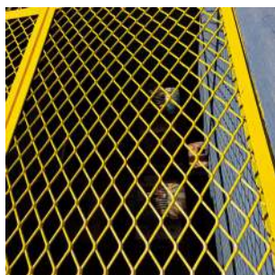
Foto 7 - Poço dos conjuntos motobomba de recalque do esgoto.
