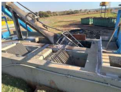
Foto 3 - Gradeamento na chegada do esgoto bruto.
