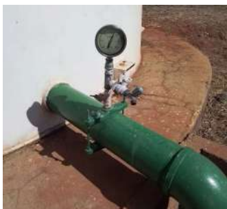
Foto 1 - Manômetro na base do reservatório.
