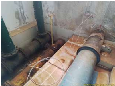
Foto 1 - Oxidação das tubulações do barrilete de saída da água filtrada.
