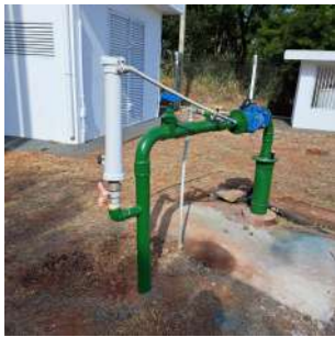
Foto 1 - Sistema de cloração do Poço.
