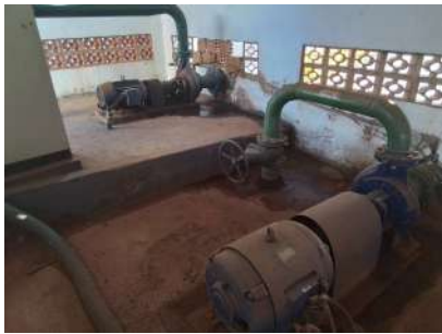
Foto 5 - Bombas da elevatória (1+1R).
