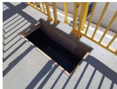
Foto 9 - Ponto de lançamento do lodo recirculado.
