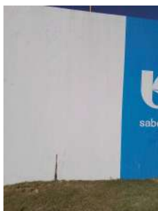
Foto 1 - Vazamento próximo ao logo da SABESP.
