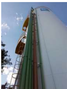
Foto 5 - Tubulações na lateral do reservatório.
