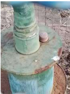
Foto 1 - Tubo de medição de nível.
