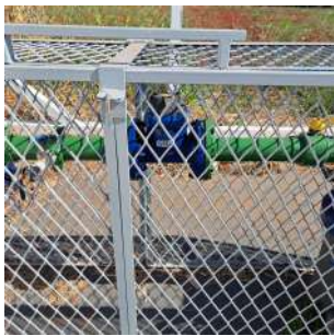
Foto 1 - Macromedidor no cavalete do Poço.
