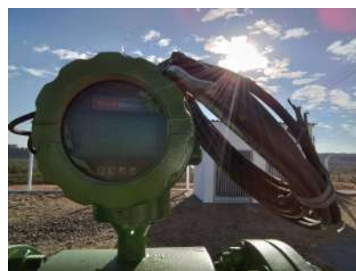
Foto 2 - Detalhe do macromedidor.
