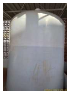
Foto 7 - Tanque de hipoclorito comercial da SABESP.
