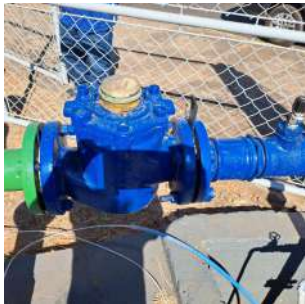
Foto 1 - Macromedidor no cavalete do Poço.
