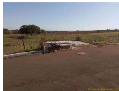
Foto 2 - Detalhe da plataforma cuja obra foi interrompida.
