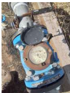
Foto 1 - Macromedidor em funcionamento.
