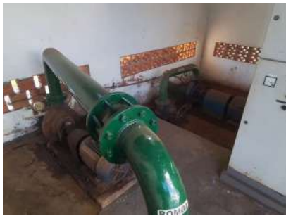
Foto 1 - Bombas da elevatória (1+1R).
