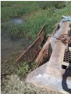
Foto 2 - Detalhe 2 do gradeamento deteriorado.
