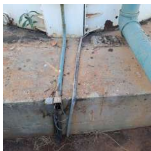
Foto 1 - Fiação única de aterramento da estrutura metálica do reservatório de menor altura.
