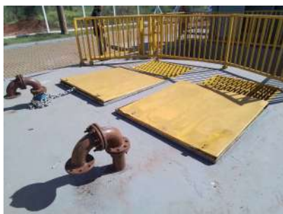
Foto 5 - Poço com duas bombas (1+1R).
