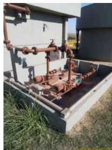
Foto 2 - Bombas usadas na recirculação de lodo.
