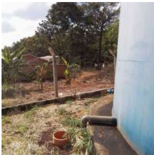
Foto 4 - A cerca necessita de manutenção para vedar as aberturas.
