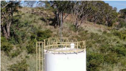
Foto 2 - Para-raios na cobertura do reservatório.
