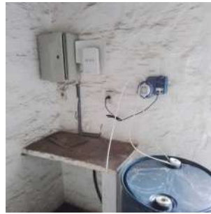
Foto 5 - Bomba dosadora de flúor.
