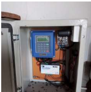
Foto 1 - Display do medidor de vazão do poço, situado na casa de produtos químicos.
