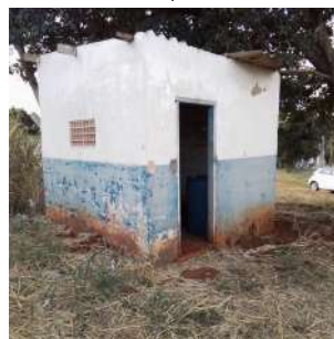
Foto 3 - Abrigo de flúor em condições inadequadas de conservação e limpeza.
