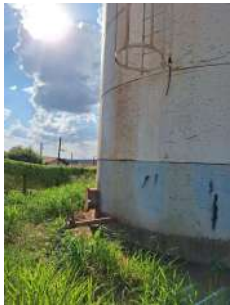
Foto 3 - Indicação de localização de vazamento
