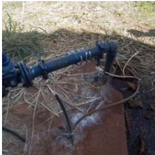
Foto 6 - Mangueiras para aplicação de produtos químicos.
