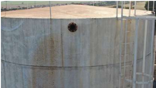
Foto 1 - Extravasor necessita de tela de proteção.
