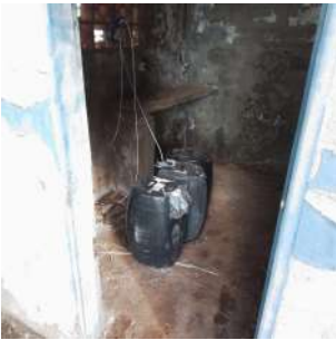
Foto 2 - Armazenamento de cloro.
