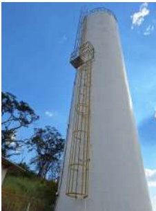
Foto 1 - Escada com guarda-corpos - Reservatório Campanário
