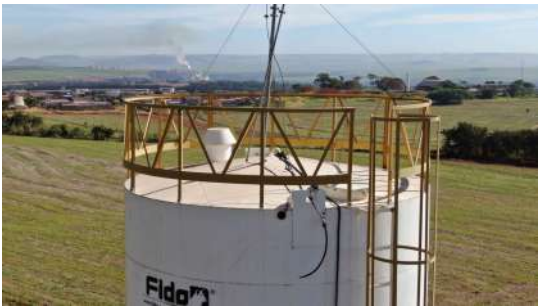
Foto 1 - Tubo extravasor do reservatório.
