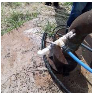
Foto 1 - Torneira para tomada de água bruta.
