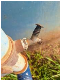
Foto 1 - Registro com vazamento
