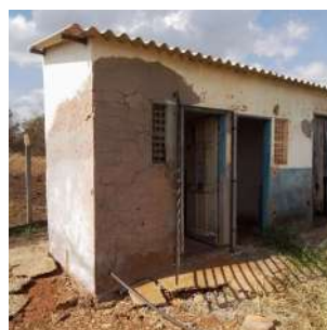
Foto 2 - Casa de produtos químicos necessita de reforma e adequação.
