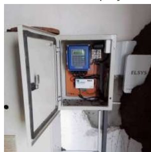
Foto 3 - Observa-se cupinzeiro ao redor dos equipamentos para monitoramento da vazão do poço.
