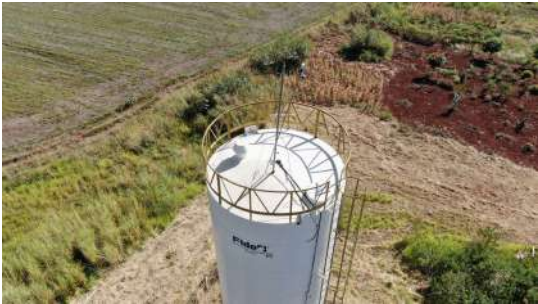
Foto 1 - Para-raios na cobertura do reservatório.
