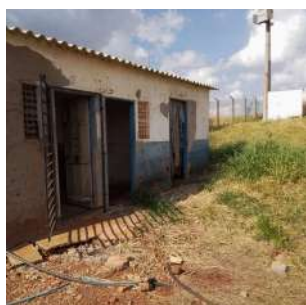
Foto 1 - Condições precárias do abrigo de produtos químicos. Portas de madeira em péssimo estado de conservação e interior com sujeira e detritos.
