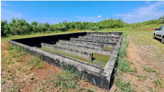
Foto 1 - Ausência de guarda-corpos no entorno das chicanas.
