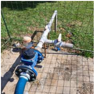
Foto 1 - Ponto de tomada de água bruta.
