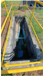
Foto 10 - Macromedidor de saída da ETE (Calha Parshall).
