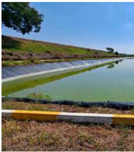
Foto 8 - Vista de parte de uma das lagoas da ETE.
