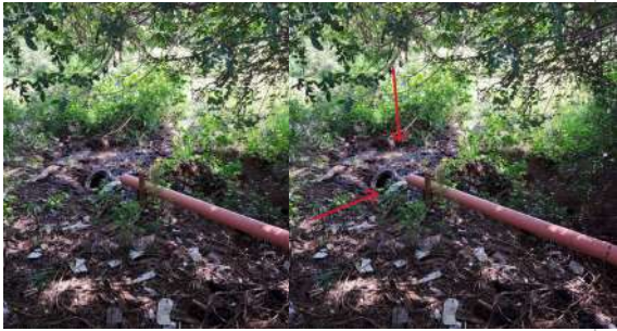
Foto 3 - Lançamento do esgoto in natura. Foto 4 - Detalhe do lançamento do esgoto in natura.
