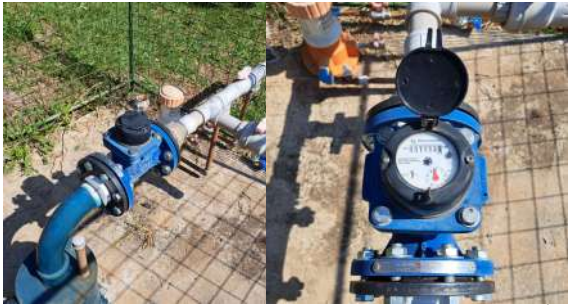
Foto 1 - Macromedidor no cavelete do Poço. Foto 2 - Macromedidor no cavelete do Poço.
