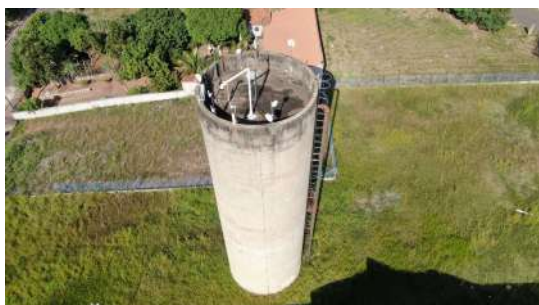
Foto 5 - Cabo de descida do SPDA, visto a partir de imagem de drone.
