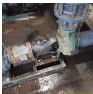
Foto 1 - Água de lubrificação de uma das bombas.
