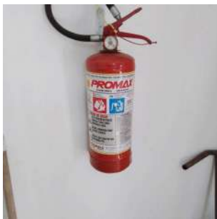
Foto 1 - Extinto de incêndio na casa de bombas.
