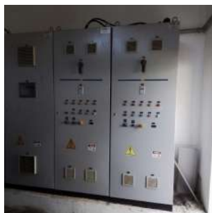
Foto 3 - Painéis de comando das bombas.
