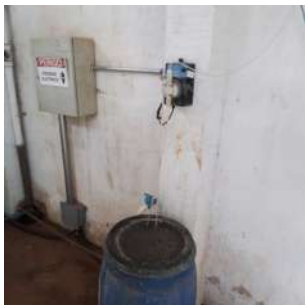
Foto 3 - Bomba dosadora de flúor.
