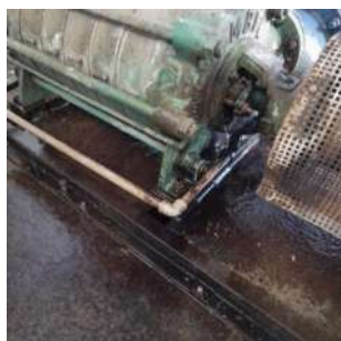
Foto 1 - Verifica-se que há tubulação para drenagem de água de lubrificação, porém a mesma não se mostra suficiente, gerando extravasamento na elevatória.
