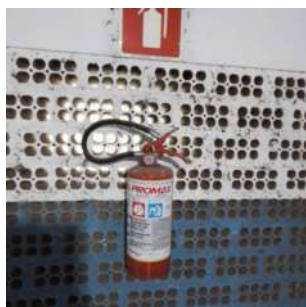
Foto 1 - Extinto de incêndio na casa de bombas.
