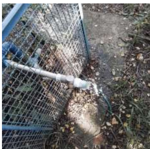
Foto 1 - Torneira para tomada de água bruta.
