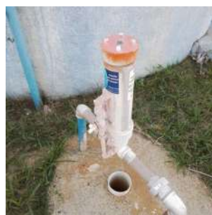
Foto 2 - Sistema de cloração por pastilhas.
