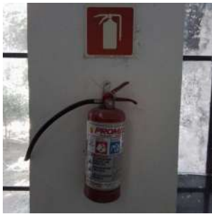
Foto 2 - Extintor de incêndio na casa de bombas.
