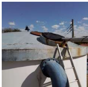
Foto 1 - Tela de proteção na entrada do reservatório.
