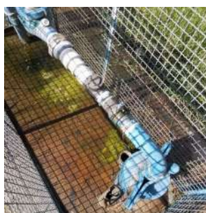
Foto 2 - Vazamento no cavelete.
