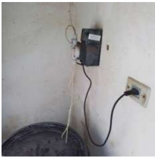
Foto 4 - Bomba dosadora de flúor.
