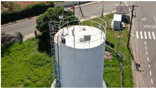
Foto 1 - Ausência de para-raios (reservatório superior).
