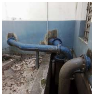
Foto 10 - Poço e tubulação de sucção.
