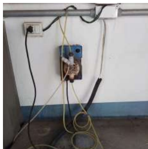
Foto 3 - Bomba dosadora de flúor.
