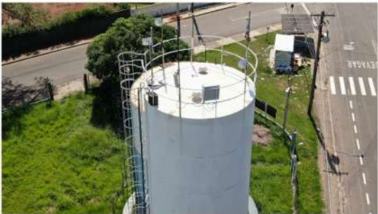
Foto 2 - Ventilação no reservatório superior.
