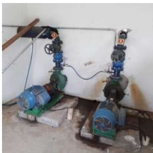
Foto 1 - 2 bombas instaladas, funcionando ora em conjunto, ora alternadas.
