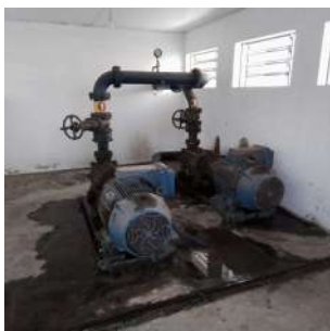
Foto 6 - Bombas da elevatória.
