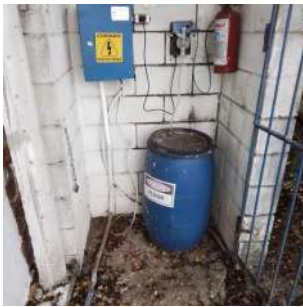
Foto 4 - Bombona para armazenamento de flúor e bomba dosadora.
