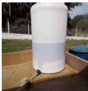
Foto 5 - Tanque para armazenamento de PAC
