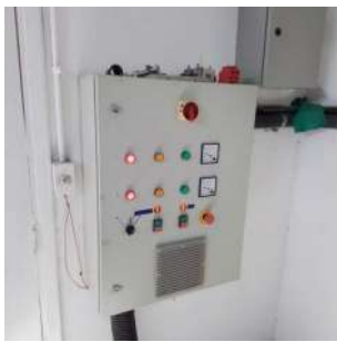
Foto 5 - Pannel das bombas
