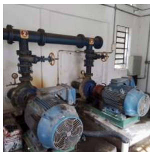
Foto 2 - Espaço e acesso adequado para manutenção das bombas.
