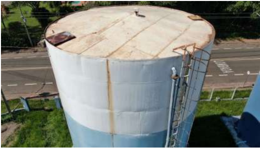
Foto 2 - Observa-se que a escada possui partes com corrosão, necessitando de manutenção.
