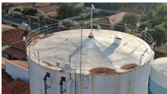
Foto 1 - Para-raios no reservatório maior.
