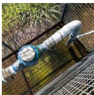
Foto 1 - Vazamento verificado no cavalete do poço.
