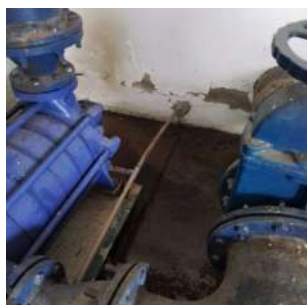
Foto 4 - Tubulação para drenagem da água de lubrificação.
