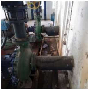
Foto 2 - Tubulação de drenagem da água de lubrificação verificada na captação, porém insuficiente para drenar toda a água.
