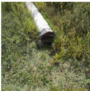
Foto 1 - Tela de proteção no tubo extravasor.
