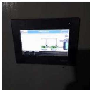
Foto 3 - Operação das bombas.
