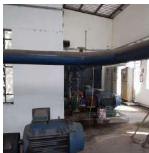
Foto 8 - Disposição das 3 bombas instaladas no local e tubulação de recalque.
