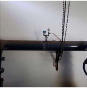
Foto 3 - Medidor de pressão no recalque.
