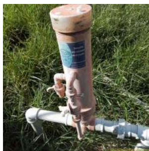
Foto 2 - Sistema de cloração por pastilhas.
