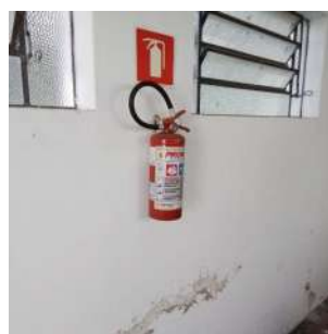
Foto 2 - Extintor em uma das elevatórias.
