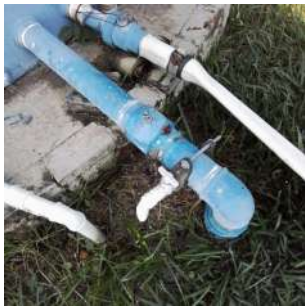
Foto 1 - Vazamento em tubulação de saída.
