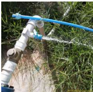
Foto 1 - Torneira para tomada de água bruta.
