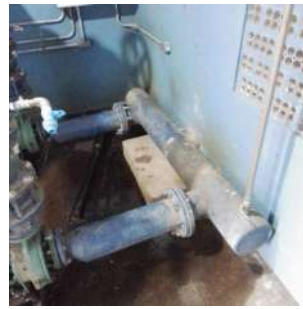
Foto 6 - Tubulação de sucção das bombas.
