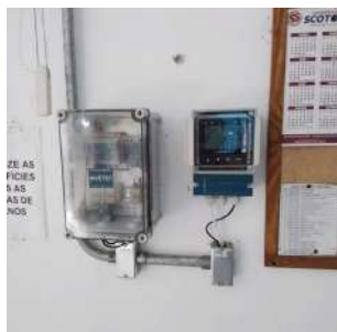
Foto 1 - Medidor de vazão não está funcionando, não havendo outros dispositivos para monitorar a vazão.
