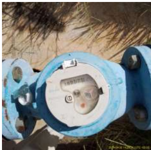
Foto 1 - Macromedidor do poço.
