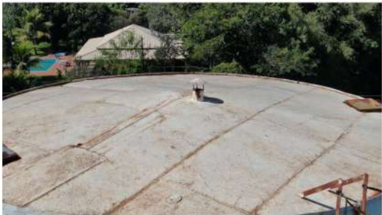
Foto 1 - Ventilação do reservatório inferior
