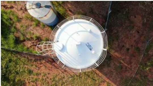
Foto 1 - Chaminé para ventilação na cobertura do reservatório.
