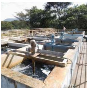
Foto 1 - Misturadores para floculação.
