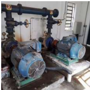
Foto 6 - Bombas centrífugas da captação
