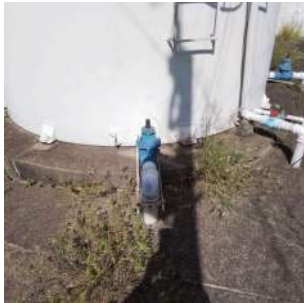
Foto 2 - Tubulações de saída e alimentação.
