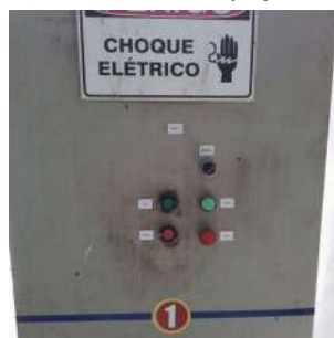
Foto 4 - Pannel da bomba 1.
