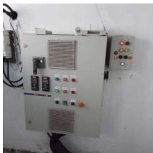
Foto 5 - Painel de comando das bombas.
