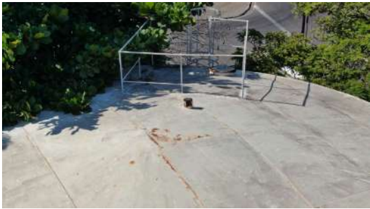
Foto 1 - Tela de proteção em tubo de ventilação.
