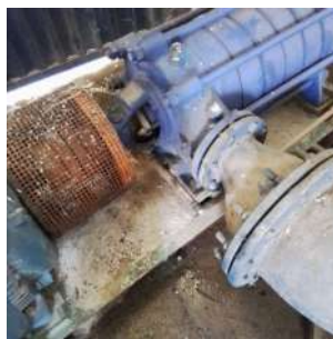
Foto 3 - Tubulação de drenagem de água de lubrificação em bomba que não estava operando.
