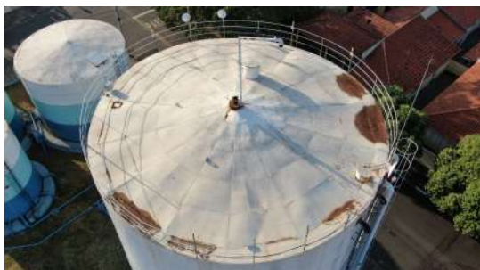
Foto 1 - Corrosão verificada na cobertura do reservatório.
