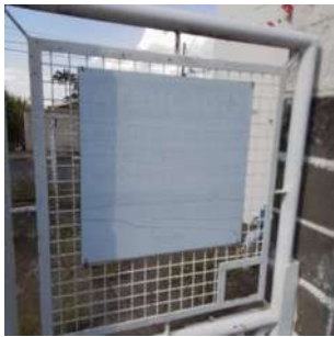
Foto 1 - Placa de identificação desgastada, sendo recomendada a atualização ou substituição.
