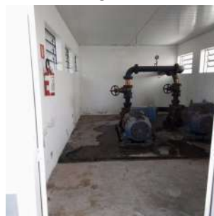
Foto 7 - Vista da elevatória.
