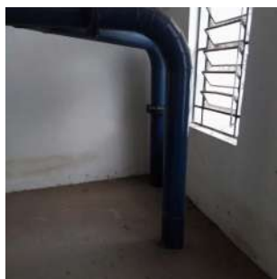
Foto 7 - Tubulação de recalque das bombas.
