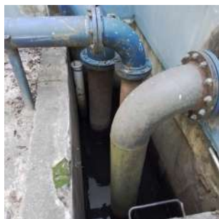
Foto 9 - Poço de sucção.
