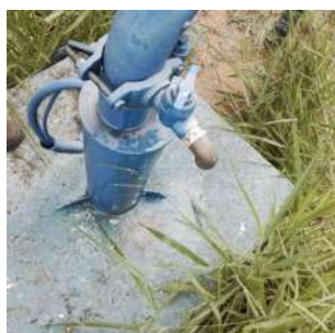
Foto 1 - Torneira para tomada de água bruta.
