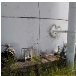
Foto 1 - Cabo para aterramento.
