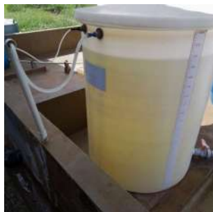
Foto 1 - Tanque para armazenamento e dosagem de cloro (hipoclorito de sódio)
