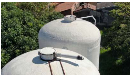
Foto 2 - Tubulação com tela de proteção.
