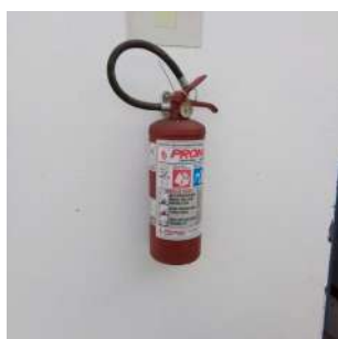
Foto 1 - Extintor em uma das elevatórias.
