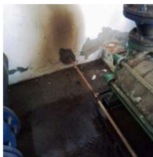
Foto 2 - Tubulação para drenagem da água de lubrificação.
