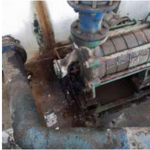
Foto 8 - Água de drenagem de lubrificação extravasando.
