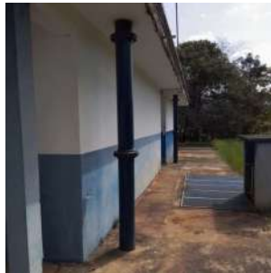
Foto 10 - Tubulações de entrada da água bruta no tratamento.
