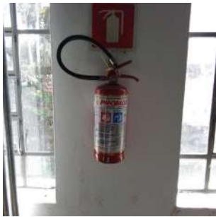
Foto 1 - Extintor de incêndio na casa de bombas.
