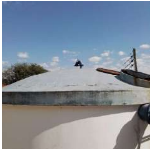
Foto 1 - Tubo de ventilação.
