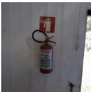
Foto 1 - Extintor situado abaixo do reservatório.
