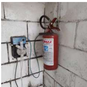
Foto 1 - Extintor no abrigo de flúor.
