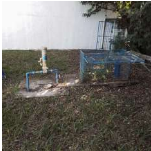
Foto 1 - Poço Jardim Itália.
