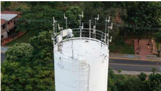
Foto 1 - Ausência de para-raio.
