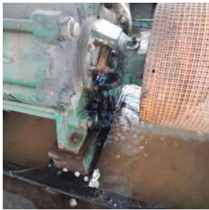
Foto 6 - Na bomba 1 da elevatória de cima, não existe sistema para drenar a água de lubrificação das gaxetas, fazendo com que a água extravase e acumule na base do conjunto moto bomba.
