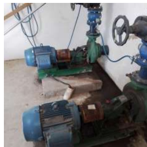
Foto 2 - Bombas da captação.
