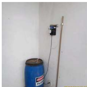
Foto 4 - Bomba dosadora de flúor
