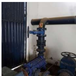
Foto 1 - Bomba com a respectiva identificação em uma das elevatórias.
