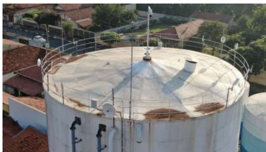
Foto 2 - Pontos de corrosão.
