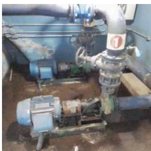
Foto 1 - Apesar de a casa de bombas ter dimensões modestas, o porte dos equipamentos permite a manutenção adequada.
