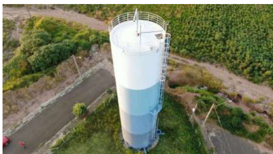
Foto 1 - Nesta foto, verifica-se o medidor de nível por contrapeso.
