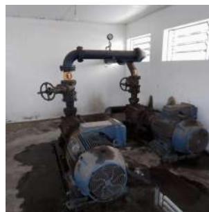
Foto 4 - Bombas da elevatória que envia água tratada para o Centro de Reservação Alpes das Águas.
