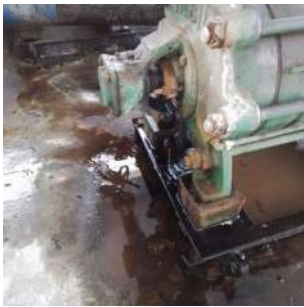
Foto 7 - Ausência de sistema de drenagem da água de lubrificação das gaxetas, levando ao extravasamento no piso da casa de bombas (elevatório para Alpes das Águas)
