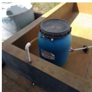
Foto 4 - Bombona para dosagem de PAC (coagulante)
