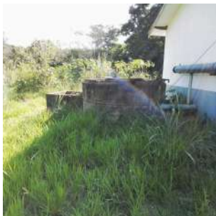
Foto 9 - Poço de sucção.
