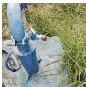
Foto 2 - Torneira para tomada de água bruta.
