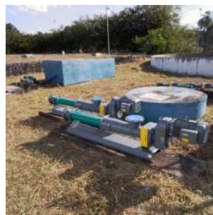
Foto 5 - Equipamentos para futura instalação
