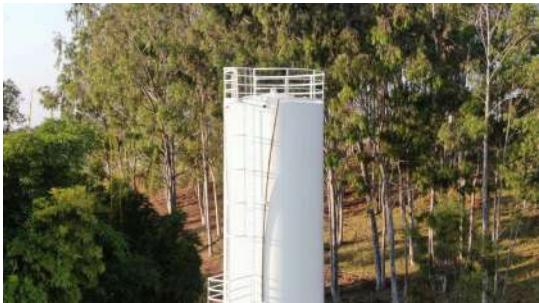
Foto 1 - Há saída para extravasor, contudo, falta conexão à tubulação.
