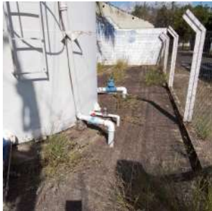
Foto 3 - Tubulações saída e alimentação do reservatório.
