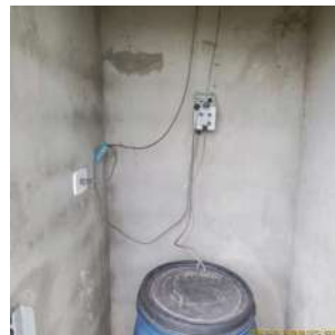
Foto 4 - Bomba dosadora de flúor.
