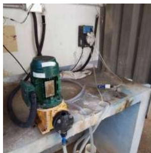
Foto 3 - Bomba dosadora de cloro.
