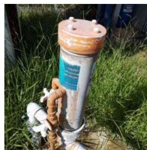
Foto 2 - Sistema de cloração por pastilhas.
