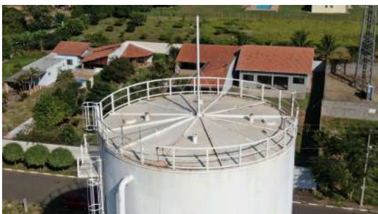
Foto 3 - Para-raios do reservatório metálico.
