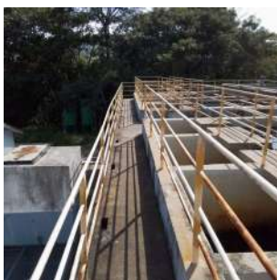
Foto 1 - Guarda-corpo na ETA.
