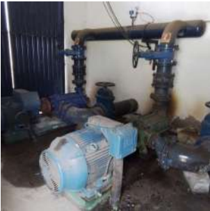
Foto 2 - EEAT ETA II - Jardim Colina
