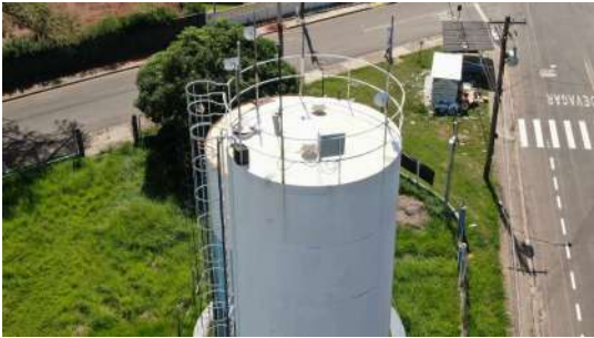
Foto 4 - Guarda-corpo na cobertura do reservatório superior.
