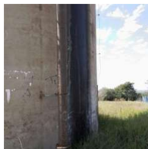
Foto 2 - Vazamento verificado no reservatório.
