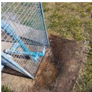
Foto 1 - Torneira para tomada de água bruta.
