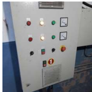
Foto 2 - Pannel de comando das bombas.
