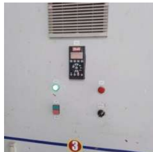
Foto 2 - Pannel da bomba 3, em funcionamento no momento da inspeção.
