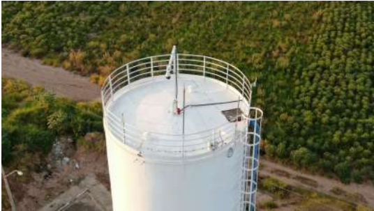
Foto 2 - Para-raios na cobertura do reservatório.
