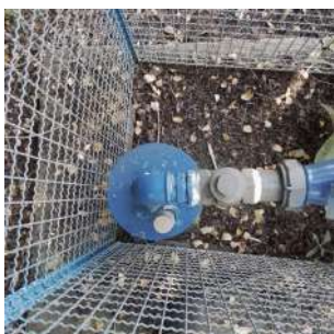
Foto 1 - Tubo medidor de nível.
