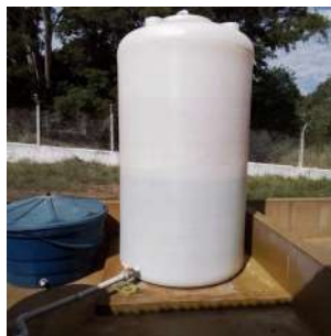
Foto 2 - Tanque para armazenamento de cloro.
