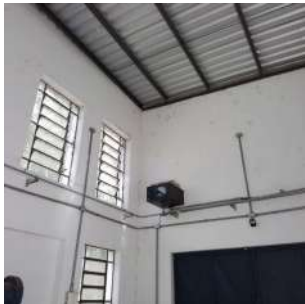
Foto 1 - Casa de bombas amplas e ventilada.
