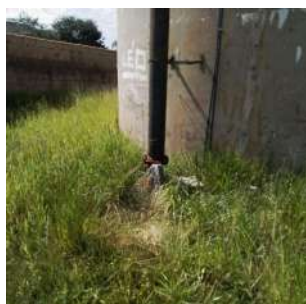
Foto 1 - Vazamento em tubulação.
