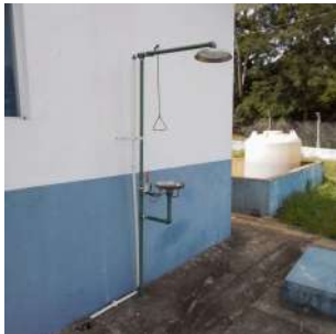
Foto 9 - Chuveiro de emergência.
