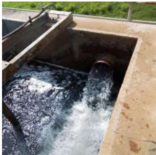
Foto 7 - Entrada de água bruta na ETA.
