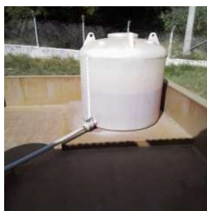
Foto 2 - Tanque para armazenamento de flúor.
