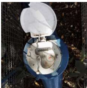
Foto 1 - Macromedidor do poço.
