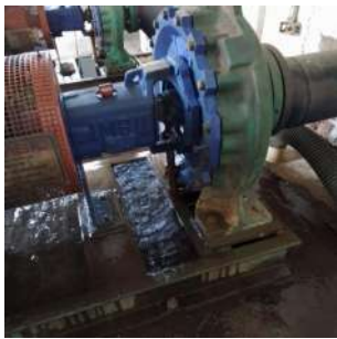
Foto 1 - Água de lubrificação extravasando.
