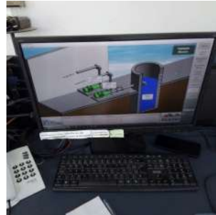
Foto 8 - Monitoramento do nível do poço de sucção e acionamento das bombas a partir do CCO.
