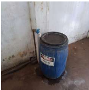
Foto 4 - Bombona para armazenamento de flúor.
