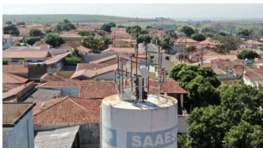
Foto 1 - Ausência de para-raios.
