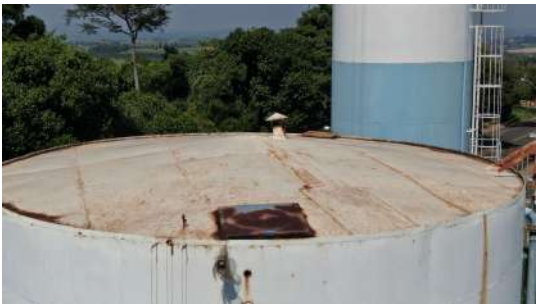
Foto 2 - Tampa corroída no reservatório inferior..
