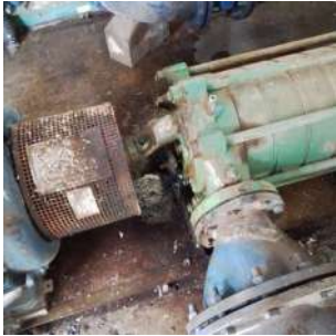
Foto 9 - Extravasamento da água de lubrificação da gaxeta de uma das bombas.
