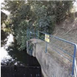
Foto 4 - Guarda-corpo para proteção.
