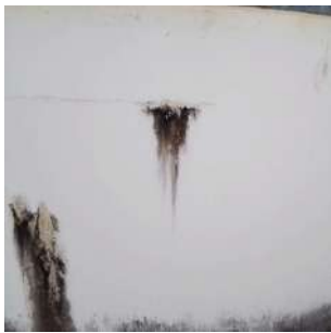
Foto 2 - Pontos de vazamentos no reservatório da ETA II.
