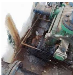
Foto 5 - Água de lubrificação das gaxetas não é drenada adequadamente pelo sistema de drenagem.
