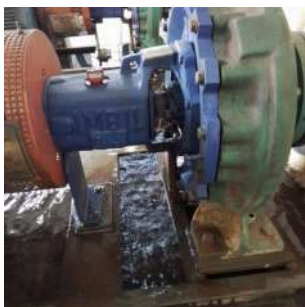
Foto 3 - Extravasamento e acúmulo de água de lubrificação das gaxetas.
