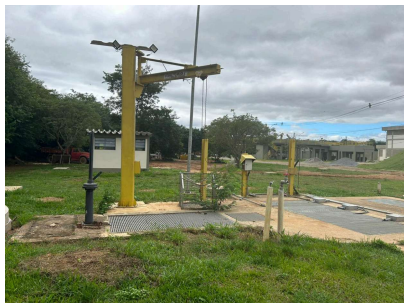
Foto 3 - Elevatório de Esgoto Bruto
