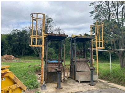
Foto 1 - Tratamento preliminar comprometido
