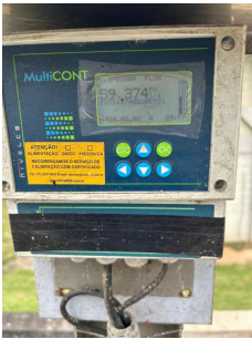
Foto 6 - Macromedidor de saída
