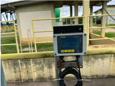
Foto 10 - Macromedidor de saída
