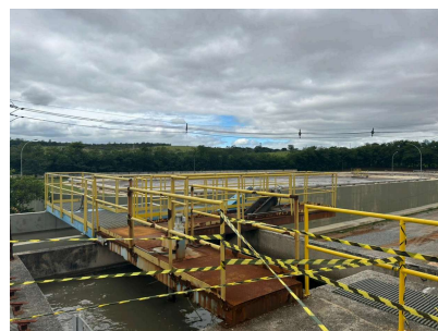
Foto 2 - Guarda-corpos com oxidação avançada
