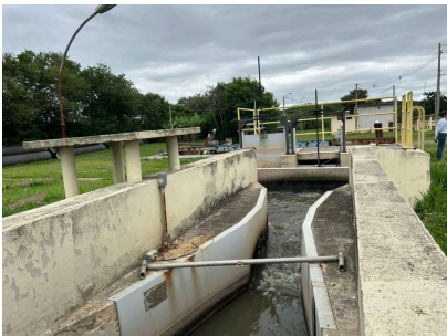
Foto 3 - Entrada es esgoto bruto
