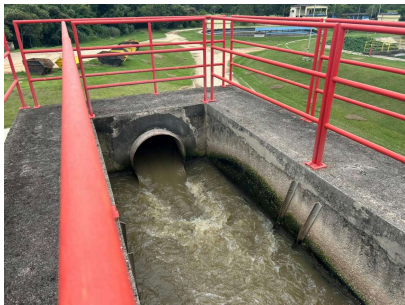
Foto 4 - Entrada de esgoto bruto
