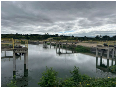
Foto 3 - Tanques inoperantes e sem limpeza
