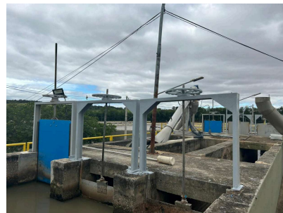
Foto 4 - Entrada de esgoto bruto
