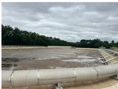
Foto 7 - Tanque de aeração II
