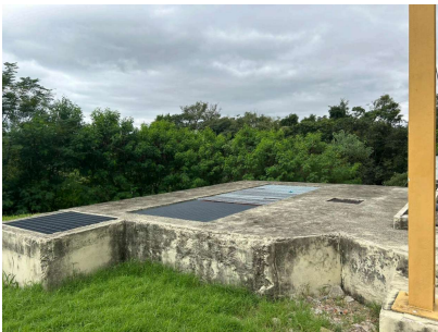
Foto 2 - Elevatória de esgoto bruto
