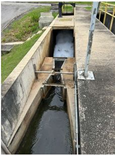
Foto 5 - Canal de saída da ETE
