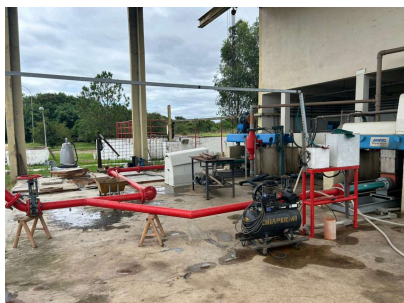
Foto 13 - Desidratação do lodo
