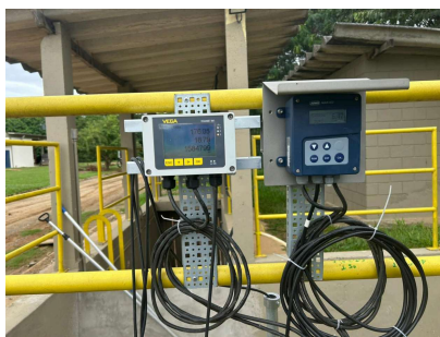
Foto 11 - Macromedidor de saída
