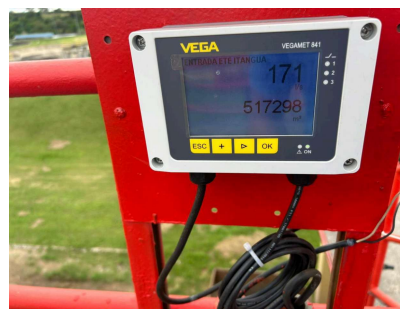
Foto 8 - Macromedidor de entrada
