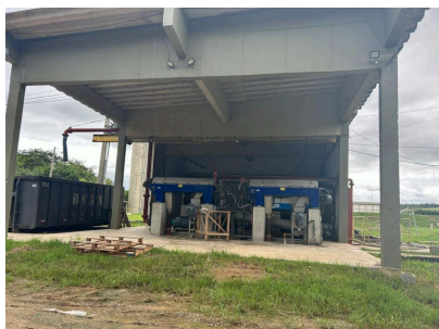
Foto 13 - Centrifugação de lodo
