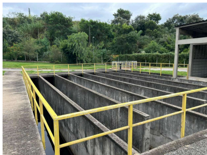
Foto 9 - Tanque de contato
