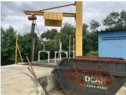
Foto 1 - Vista geral da elevatória
