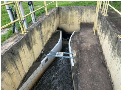
Foto 11 - Canal de saída de esgoto tratado
