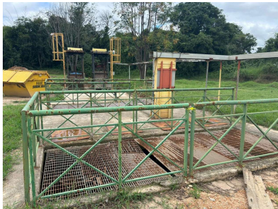
Foto 2 - Guarda-corpo e pisos totalmente oxidados
