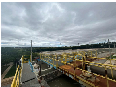
Foto 1 - Passarela com oxidação avançada, oferecendo riscos
