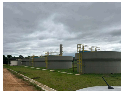
Foto 10 - Adensadores de lodo
