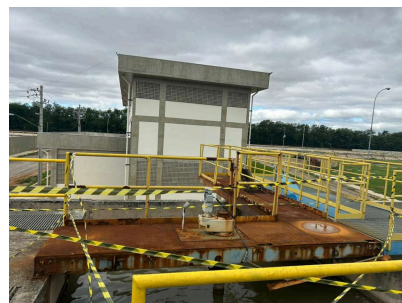
Foto 2 - Passarela com oxidação avançada, oferecendo riscos
