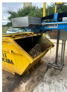
Foto 2 - Caçamba de resíduos do gradeamento
