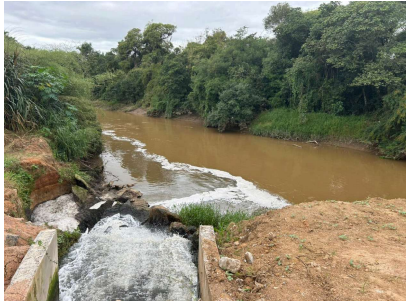
Foto 9 - Lançamento de esgoto tratado
