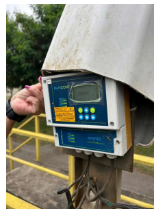
Foto 12 - Macromedidor de entrada
