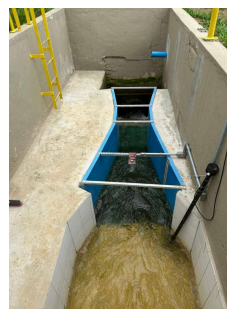
Foto 12 - Canal de saída do efluente tratado
