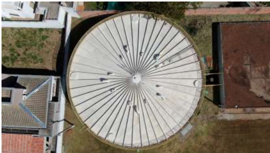
Foto 1 - Tampas de inspeção
