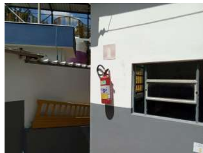
Foto 2 - Extintor na parede externa ao laboratório
