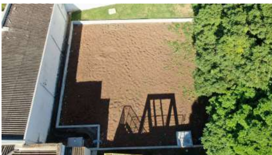
Foto 1 - Vista superior com tubulação de ventilação
