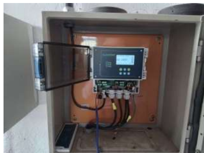
Foto 6 - Display do medidor de vazão
