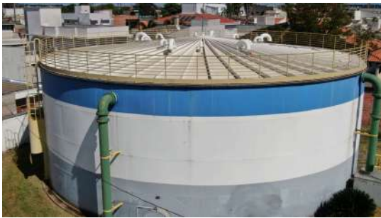
Foto 1 - Tubulações de ventilação
