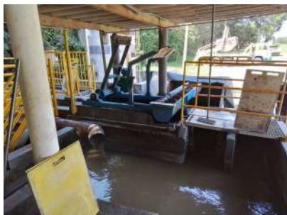
Foto 8 - Entrada do efluente na elevatória
