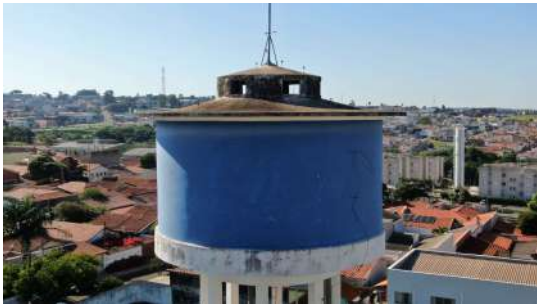
Foto 1 - Ausência de tela de proteção na abertura
