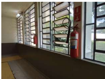
Foto 1 - Extintor de incêndio
