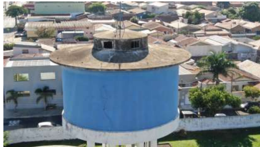
Foto 2 - Ausência de tela de proteção na abertura
