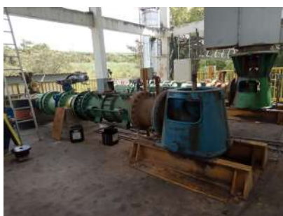
Foto 1 - Ausência de conjunto motor-bomba reserva
