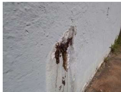
Foto 2 - Vazamento aparente II
