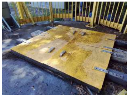
Foto 4 - Tampa de proteção
