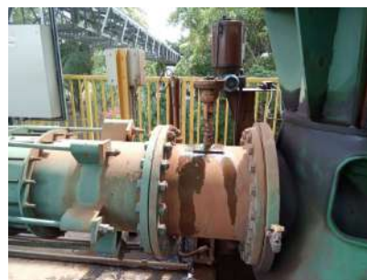
Foto 2 - Vazamento aparente II
