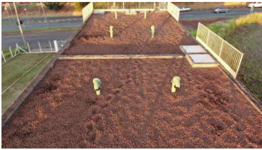
Foto 1 - Tubulação de ventilação
