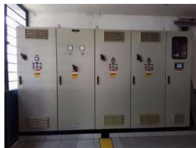
Foto 3 - Painel de comando e acionamento das bombas
