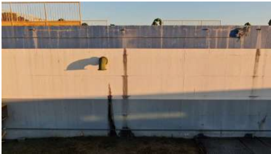
Foto 1 - Indícios de vazamento na parte central do reservatório
