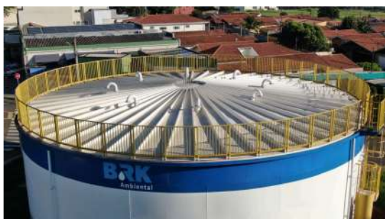
Foto 1 - Reservatório com tubulação de ventilação
