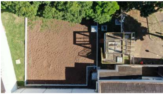
Foto 1 - Plantas crescendo sobre a laje do reservatório
