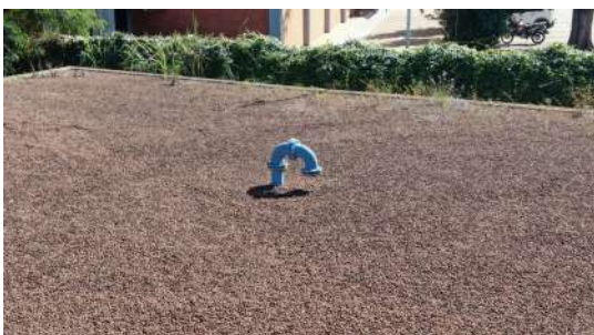
Foto 1 - Tubulação de ventilação
