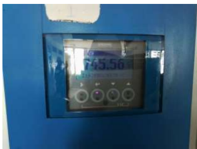
Foto 4 - Display do medidor de vazão
