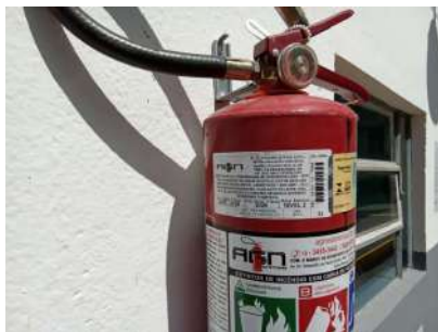
Foto 1 - Extintor de incêndio, dentro do prazo de validade
