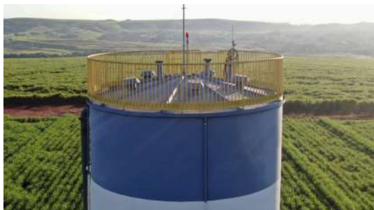
Foto 1 - Dispositivos de ventilação
