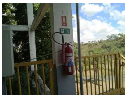
Foto 1 - Extintor de incêndio
