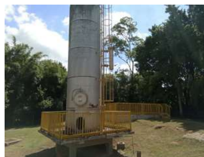
Foto 2 - RHO - Reservatório Hidropneumático
