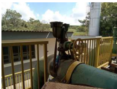
Foto 1 - Vazamento aparente I
