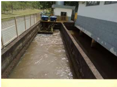
Foto 4 - Chegada da água bruta
