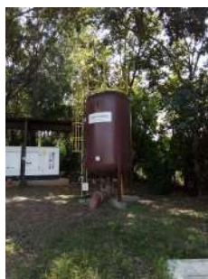
Foto 2 - RHO - Reservatório Hidropneumático
