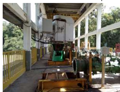
Foto 3 - Guarda-corpo ao redor da casa de bombas
