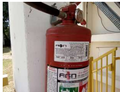
Foto 2 - Extintor de incêndio, dentro do prazo de validade
