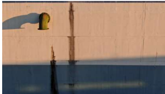
Foto 2 - Indícios de vazamento na parte central do reservatório
