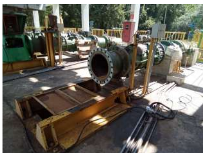
Foto 1 - Segundo informado, a bomba reserva da captação está operando no São Lucas. Há 7 bombas no total, sendo 2 operando na captação, 2 no São Lucas e 3 em manutenção (fora de operação).
