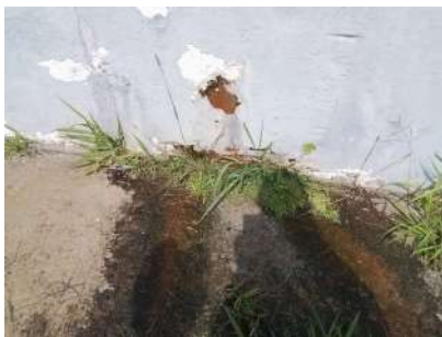
Foto 1 - Vazamento aparente I
