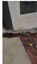
Foto 2 - Serviço não realizado
