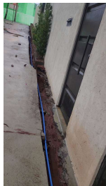
Foto 1 - Serviço não realizado
