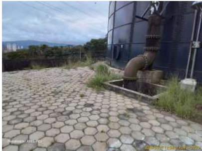
Foto 2 - Mato alto no entorno do reservatório.
