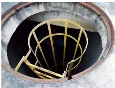
Foto 3 - Acesso dos operadores às bombas (poço seco).
