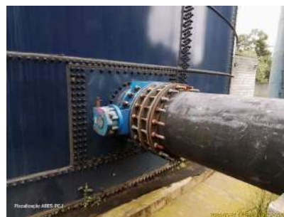
Foto 4 - Reservatório da aço vitrificado.
