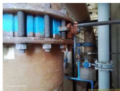
Foto 4 - Vazamento na saída do filtro 4.
