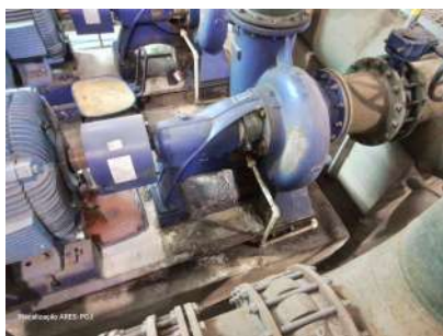
Foto 1 - Base de concreto molhada pela ineficiência da drenagem.
