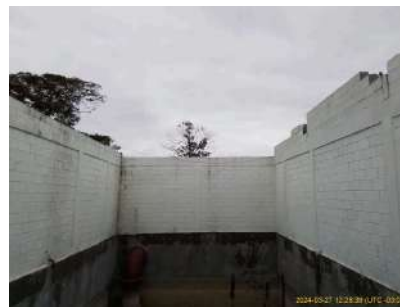
Foto 6 - Detalhe da ausência de telhado no abrigo da EEEB.
