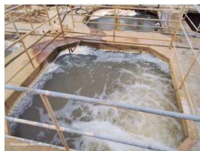
Foto 4 - Detalhe do primeiro tanque de floculação.
