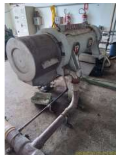
Foto 52 - No local, há 2 centrífugas para secagem do lodo que operam através de revezamento.
