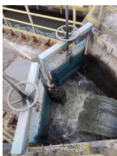
Foto 8 - Comportas de distribuição de vazão entre as caixas de areia.
