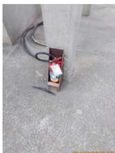
Foto 3 - Extintor 3 junto ao tratamento preliminar.
