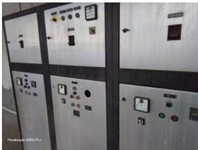
Foto 4 - Detalhe do painel elétrico.
