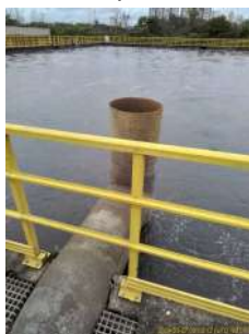
Foto 21 - Chegada do efluente ao tanque de aeração 1.
