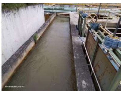
Foto 13 - Vista do canal que leva aos decantadores.
