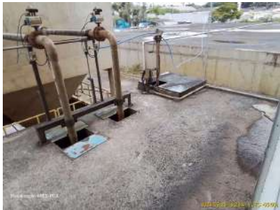
Foto 1 - Tanque de equalização do lodo sem guarda-corpo.
