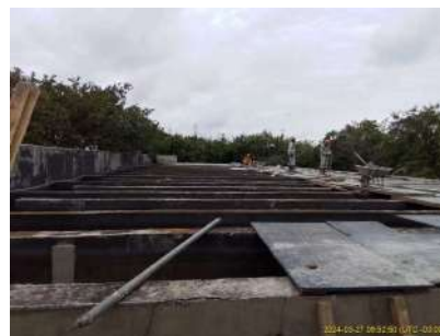
Foto 37 - Chicanas de desinfecção, próximas ao laboratório. Atualmente, as chicanas estão passando por obras para melhoramento do fluxo.
