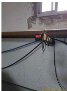
Foto 49 - Nível do tanque de lodo descartado.
