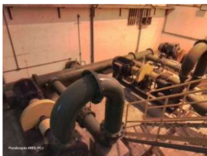
Foto 5 - Detalhe do sistema EEA ETA Leste.
