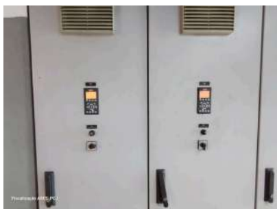
Foto 3 - Painel elétrico da bomba 1 e 2.
