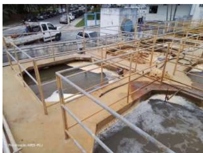
Foto 5 - Primeiro tanque de floculação.
