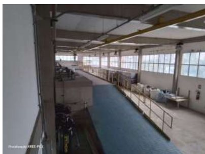
Foto 22 - Tanques de preparação de produtos químicos. Tanque de contato abaixo do nível do chão.
