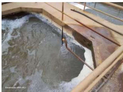
Foto 7 - Aspersor para controle de espuma.
