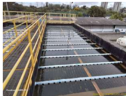
Foto 4 - Vertedor desnivelado detalhe 4.
