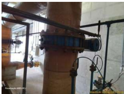
Foto 1 - Vazamento na saída do filtro 3.
