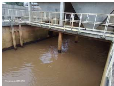
Foto 2 - Tanque de homogeneização.
