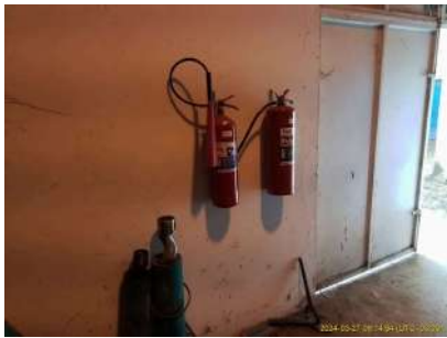
Foto 5 - Extintores junto aos sopradores, próximo à entrada.
