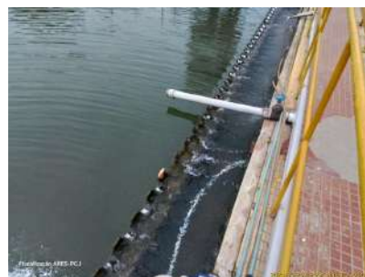
Foto 4 - Vertedor desnivelado detalhe 4.
