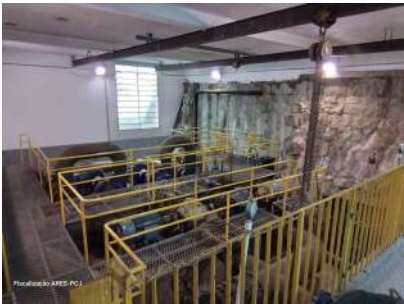
Foto 2 - Vista geral do booster.
