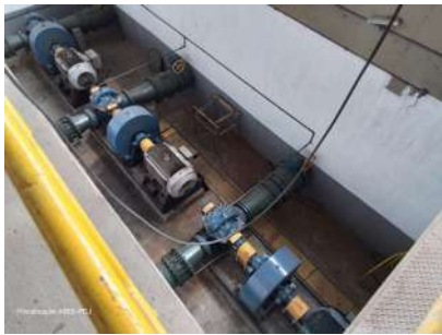
Foto 5 - Vista geral da EEA.
