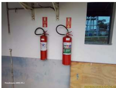
Foto 1 - Dois tipos de extintores.
