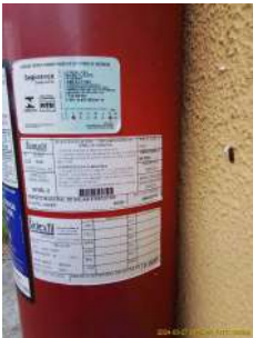
Foto 2 - Extintor junto ao tratamento preliminar com validade adequada.
