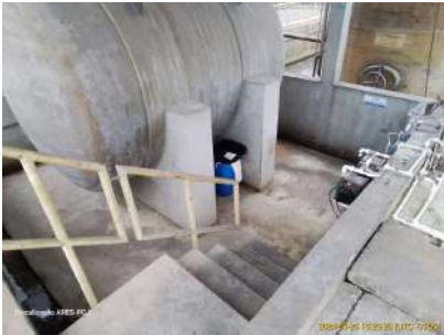
Foto 10 - Baia de contenção dos tanques de produtos químicos.
