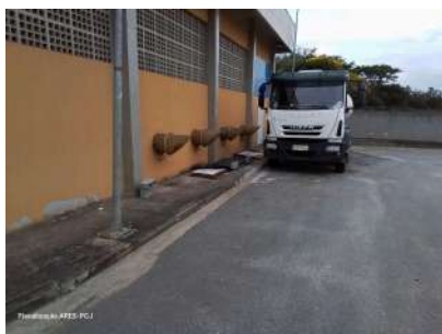
Foto 40 - Exaustores de gás cloro vazado para a área externa da ETA.
