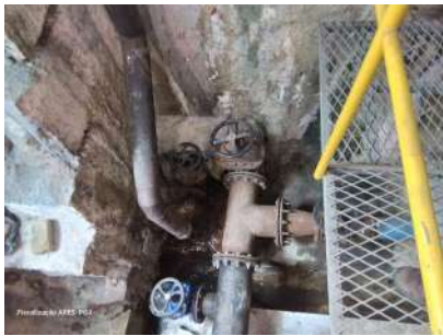
Foto 1 - Vazamento no interior do abrigo do booster proveniente da parede do reservatório ETA Centro I e II.
