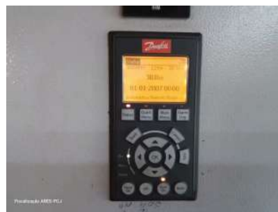
Foto 4 - Detalhe do painel elétrico.
