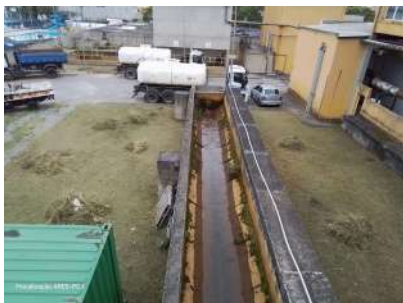
Foto 13 - Canal em operação após a retrolavagem do filtro.
