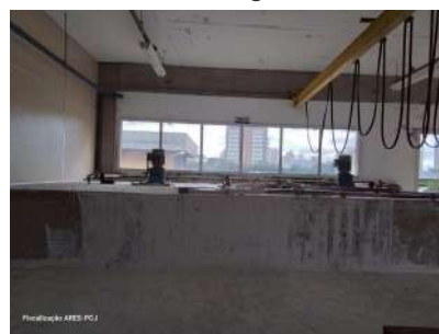
Foto 26 - Tanques de hidróxido de cálcio.
