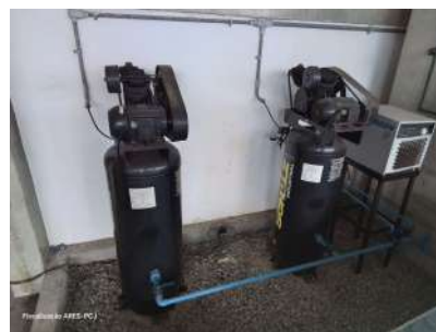
Foto 23 - Compressores de ar para retrolavagem dos filtros.
