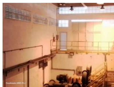
Foto 2 - Extintor próximo ao portão de acesso.
