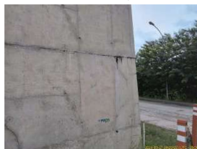
Foto 4 - Vazamento 4 identificado em uma das esquinas do tanque 2.
