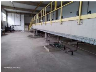
Foto 31 - Sistemas de dosagem de produtos químicos. Abaixo do chão, tanque de contato.
