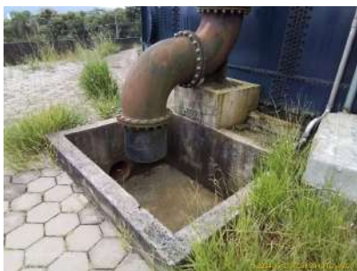
Foto 1 - Tubo extravasor do reservatório.
