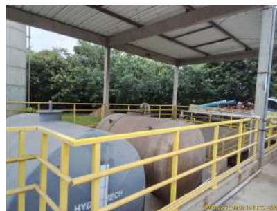
Foto 2 - Tanque de hipoclorito de sódio, próximo às chicanas de desinfecção, sem identificação.
