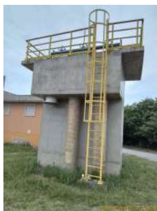
Foto 36 - Local de distribuição para os decantadores (após aeradores).
