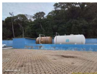
Foto 8 - Tanques de armazenamento de hipoclorito de sódio.
