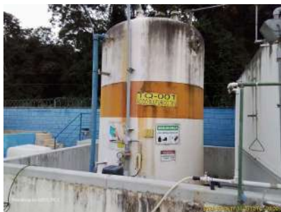
Foto 9 - Tanque de ácido sulfúrico para produzir hidróxido de cloro.
