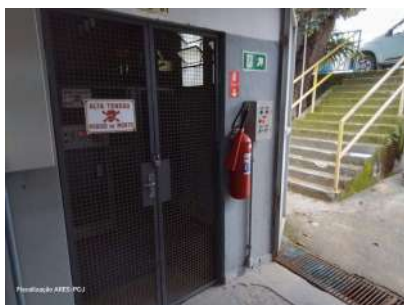
Foto 1 - Extintor próximo aos painéis elétricos.
