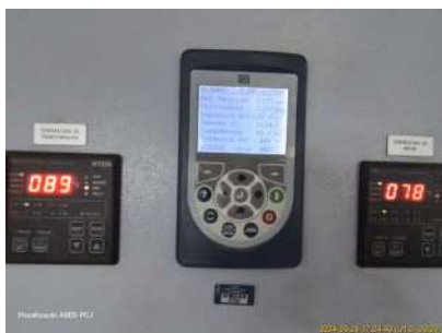
Foto 23 - Pannel operacional de um conjunto moto bomba.
