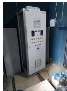
Foto 5 - Paineleletrico da elevatória de água desativada.
