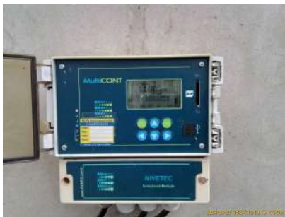
Foto 1 - Macromedidor de esgoto bruto.
