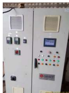
Foto 54 - Painele elétricos junto às centrifugas.
