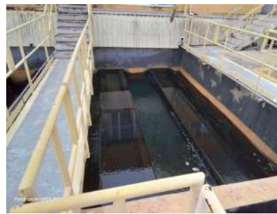
Foto 10 - Detalhe do filtro no início do processo de retrolavagem.
