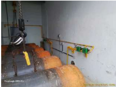
Foto 44 - Sistema de detecção de vazamento de gás cloro.
