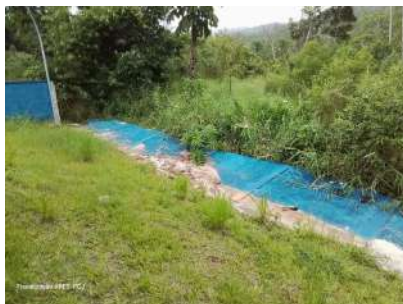
Foto 3 - Muro do fundo caído.
