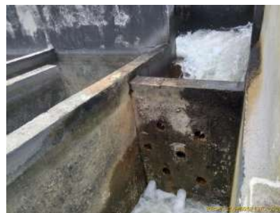
Foto 39 - Chegada do efluente às chicanas, após demais tratamentos na ETE.
