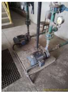
Foto 44 - Bombas água de lavagem da mesa adensadora e da centrífuga.
