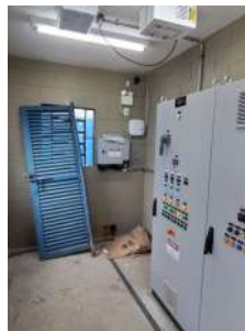
Foto 5 - Painelelétrico dentro do abrigo.
