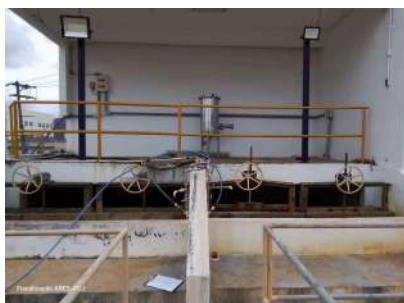
Foto 1 - Caixa de entrada da água na ETA.
