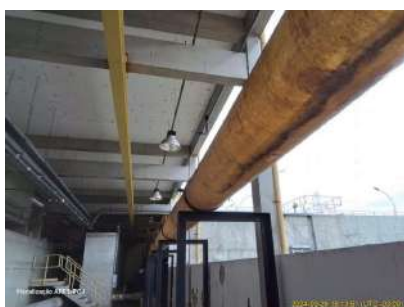
Foto 5 - Vazamento na linha de recalque para lavagem dos filtros.
