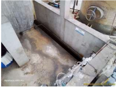
Foto 11 - Baia de contenção dos tanques de produtos químicos.
