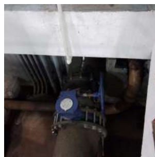
Foto 5 - Tubulação junto a bomba 3.
