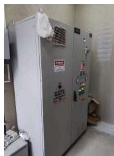
Foto 4 - Painel elétrico dentro do abrigo.
