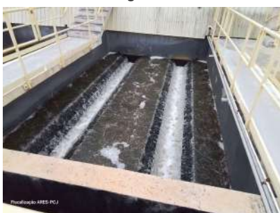
Foto 15 - Elevação do nível para remoção da água de retrolavagem.
