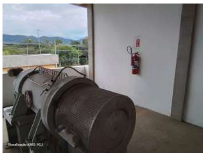
Foto 5 - Extintor na centrífuga.
