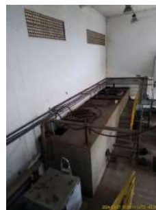
Foto 48 - Reservatórios internos de água para lavagem.
