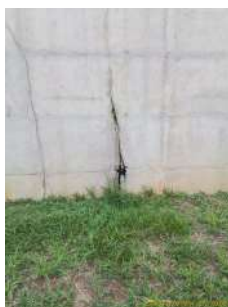
Foto 1 - Vazamento 1 na fachada próxima ao tratamento preliminar.
