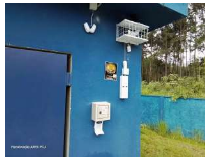
Foto 4 - Sistema de proteção externo.
