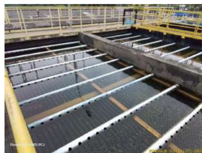
Foto 2 - Vertedor desnivelado detalhe 2.
