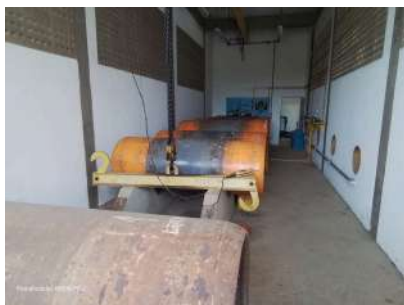
Foto 38 - Cilindros de gás cloro e sistema de alerta contra vazamentos..
