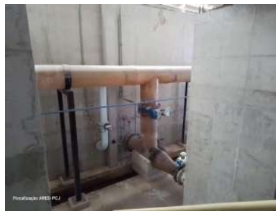
Foto 32 - Saída dos filtros.
