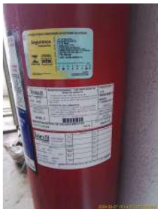
Foto 5 - Extintor junto às chicanas com validade adequada.
