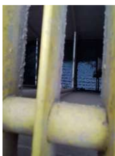
Foto 1 - Detalhe do gradeamento.
