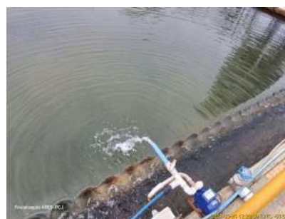
Foto 2 - Vertedor desnivelado detalhe 2.
