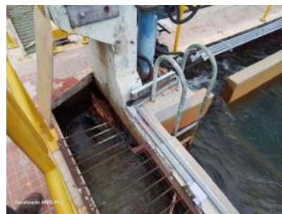
Foto 23 - Canal de distribuição de água para os filtros.
