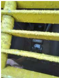
Foto 1 - Detalhe do gradeamento grosseiro.
