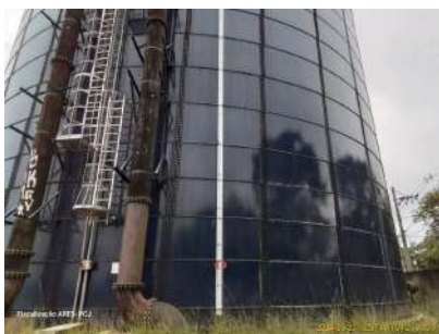
Foto 1 - Sistema físico visual de controle de nível.
