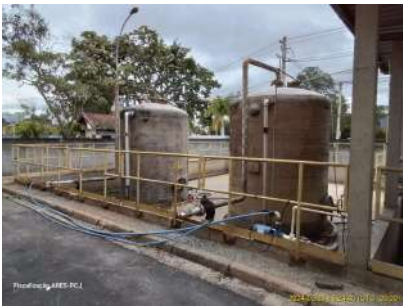
Foto 8 - Baia de contenção dos tanques de produtos químicos.
