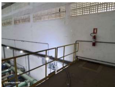
Foto 3 - Detalhe do extintor próximo ao portão de acesso.
