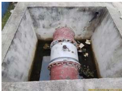
Foto 12 - Tubulação com macromedidor danificado.
