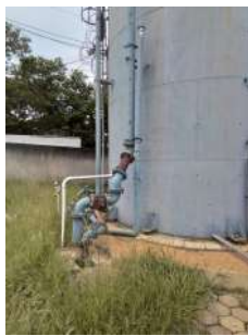
Foto 4 - Tubulação do reservatório Pomar.
