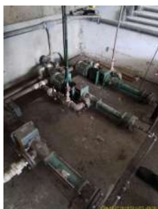
Foto 42 - Bombeamento de polímero para as centrífugas.
