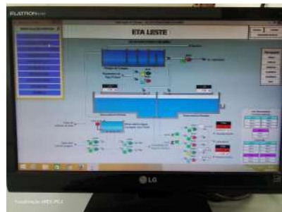
Foto 21 - Detalhe do CCO da ETA Leste.
