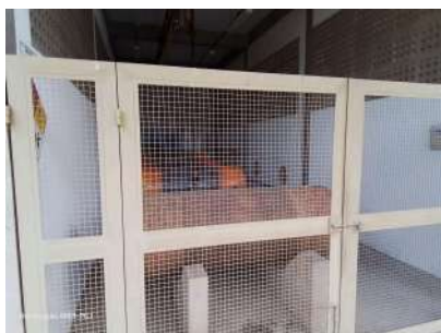
Foto 36 - Cilindros de gás cloro.
