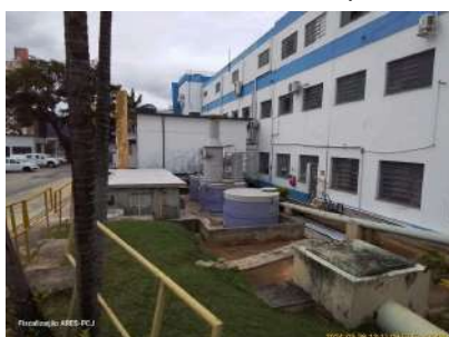
Foto 40 - Sistema de lavagem de gás cloro.
