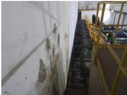
Foto 11 - Vazamento aparente dentro da casa da EEA, junto à parede que separa o reservatório da EEA.
