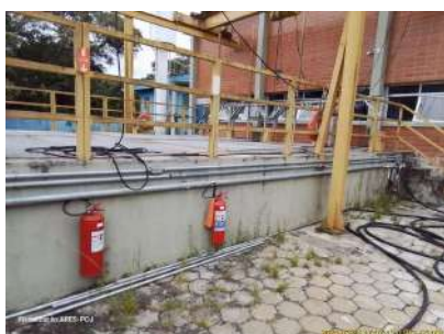
Foto 1 - Extintores próximos às peneiras.
