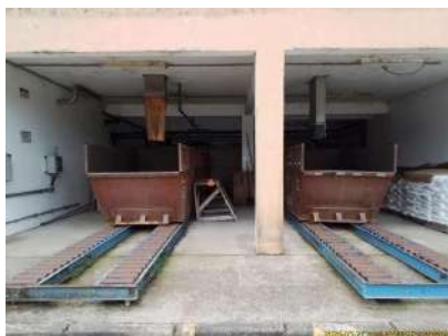
Foto 55 - Detalhe das caçambas para retirada do material seco. De acordo com o prestador, ao menos duas caçambas são retiradas por dia.
