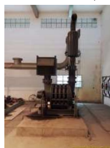
Foto 25 - Detalhe do soprador.
