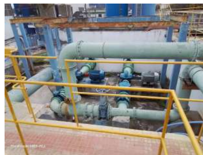
Foto 19 - Sistema de bombeamento para a filtração auxiliar.
