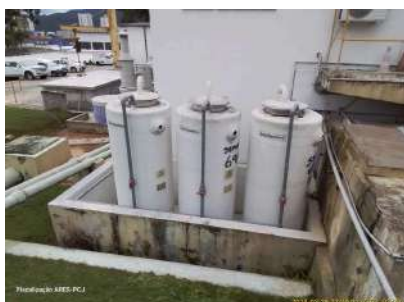
Foto 1 - Baia de contenção dos tanques de ácido fluossilícico.
