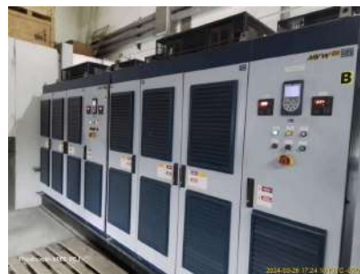
Foto 22 - Painéis elétricos dos conjuntos moto bomba.
