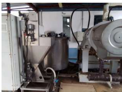
Foto 30 - Detalhe do sistema de tratamento de lodo.
