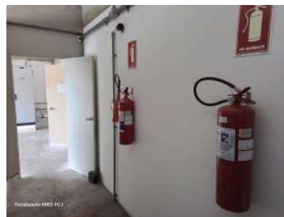
Foto 2 - Extintores do corredor do anfiteatro.
