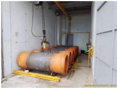
Foto 42 - Atual sistema de armazenamento de gás cloro.
