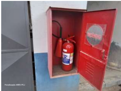
Foto 1 - Extintor ao lado do portão de acesso.
