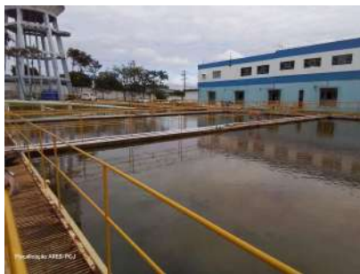
Foto 15 - Vista do sistema de decantação.
