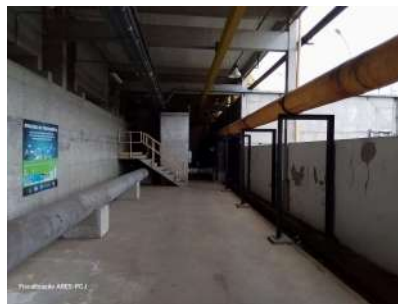
Foto 33 - Tubulação de retrolavagem.
