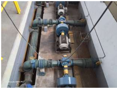
Foto 1 - Três conjuntos moto bombas.
