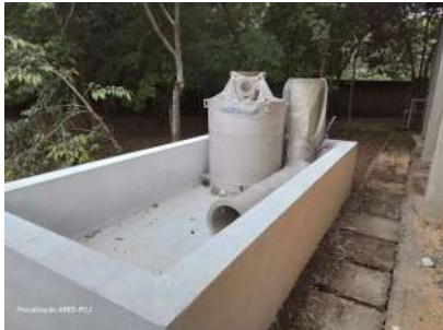
Foto 2 - Providenciar a instalação e operação do sistema de lavagem de gás cloro.
