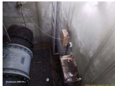
Foto 4 - Detalhe do macromedidor da adutora de água bruta.
