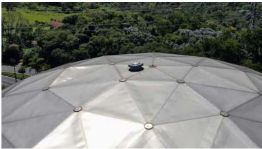
Foto 1 - Detalhe da tubulação de ventilação.
