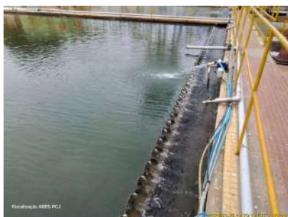
Foto 3 - Vertedor desnivelado detalhe 3.
