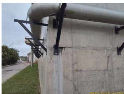
Foto 3 - Vazamento 3 identificado em uma das esquinas do tanque 2.
