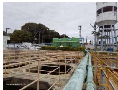
Foto 16 - Sistema de filtração auxiliar em verde ao fundo.
