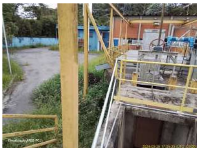
Foto 1 - Dispor de caçamba para remoção de material sólido gradeado.
