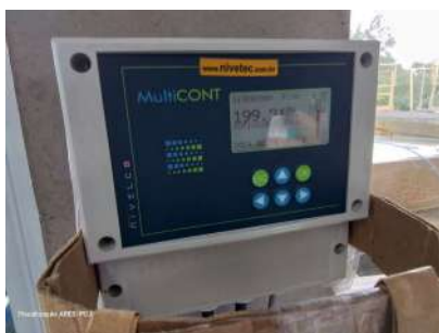
Foto 1 - Macromedidor na entrada da ETA.
