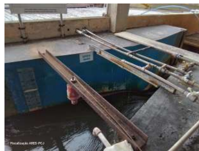
Foto 2 - Canal de chegada com calha Parshall, medidor de vazão e aplicação de PAC.
