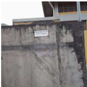
Foto 1 - Detalhe da placa de identificação deteriorada.
