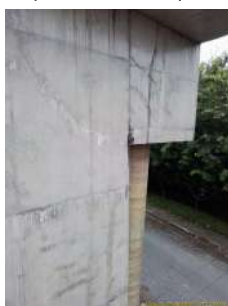
Foto 5 - Vazamento 5 próximo a escada de acesso ao tanque 2.
