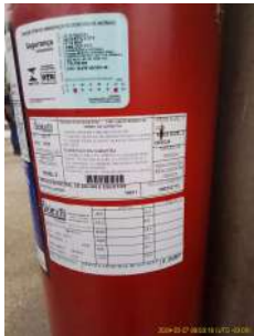
Foto 1 - Extintor junto ao tratamento preliminar com validade adequada.
