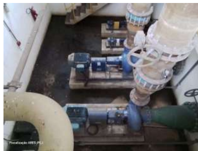
Foto 35 - Sistema de bombeamento da retrolavagem.
