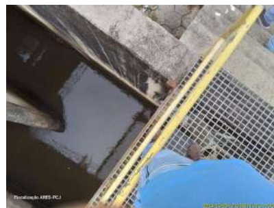
Foto 2 - Elevar a altura do guarda-corpo na passarela sobre a captação da água do manancial.
