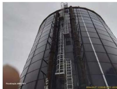
Foto 2 - Tubo extravasor do reservatório.
