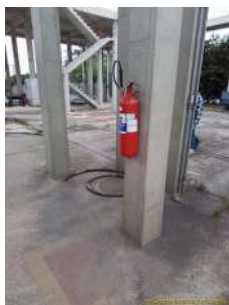
Foto 1 - Extintor 1 junto ao tratamento preliminar.
