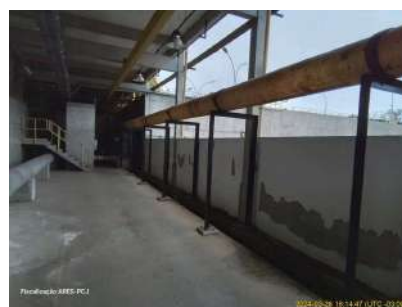
Foto 6 - Vazamento na linha de recalque para lavagem dos filtros.
