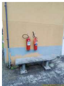
Foto 2 - Extintor 2 junto ao tratamento preliminar.
