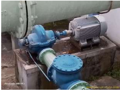
Foto 1 - Vazamento no sistema de bombeamento para a filtração auxiliar.
