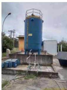
Foto 1 - Tanque de hidróxido de cálcio junto ao tratamento preliminar, sem identificação.
