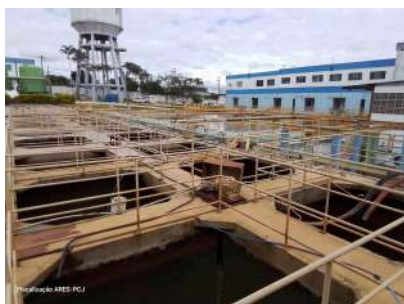
Foto 9 - Sistema de floculação adicional paralelo.
