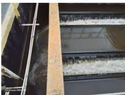
Foto 17 - Detalhe da retirada da água de retrolavagem do filtro.
