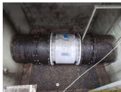
Foto 2 - Macromedidor da adutora de água bruta.
