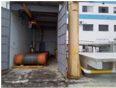
Foto 43 - Sistema de armazenamento de gás cloro.
