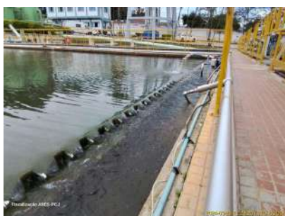
Foto 1 - Vertedor desnivelado detalhe 1.
