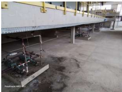
Foto 29 - Sistemas de dosagem de produtos químicos. Abaixo do chão, tanque de contato.
