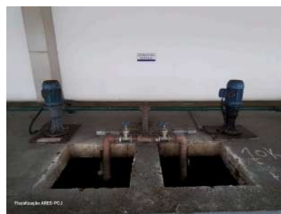
Foto 24 - Tanques de polímeros para as centrífugas.
