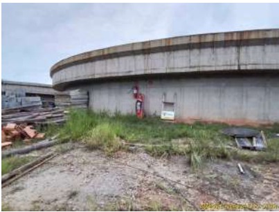
Foto 6 - Extintor junto ao decantador 1.
