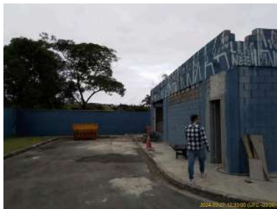
Foto 7 - Segundo abrigo no local onde ficam os painéis elétricos e possível local de instalação de gerador.
