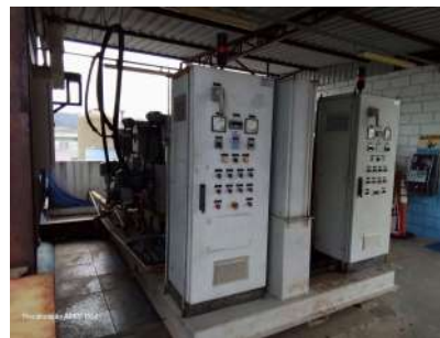
Foto 25 - Painel elétrico do sistema de centrifugação.
