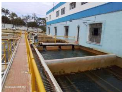
Foto 22 - Sistema de filtração descendente.
