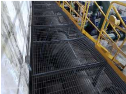
Foto 1 - Detalhe do local com grades do piso amassadas e não encaixadas corretamente.
