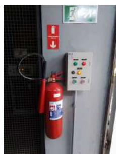
Foto 1 - Extintor próximo aos painéis elétricos.
