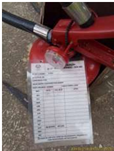
Foto 3 - Extintor junto ao tratamento preliminar com validade adequada.
