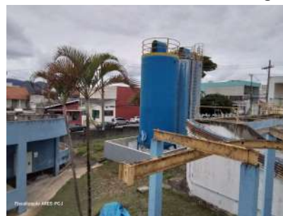
Foto 29 - Tanques de hidróxido de cálcio.
