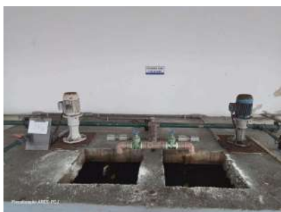
Foto 25 - Tanques de polímeros para os floculadores.
