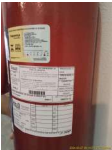
Foto 4 - Extintor junto aos sopradores com validade adequada.
