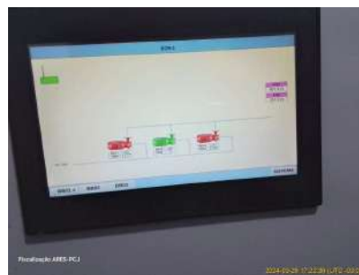
Foto 17 - CCO da captação.
