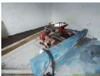
Foto 14 - Sistema de dosagem de hipoclorito na adutora.
