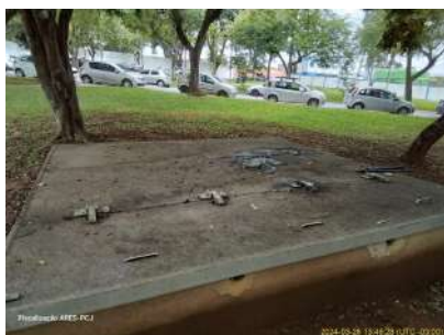
Foto 1 - Caixa do macromedidor externa à ETA.
