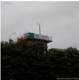
Foto 1 - Faixa de identificação da ETE.
