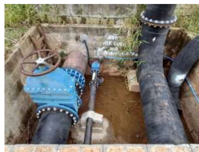
Foto 4 - Detalhe do registro e manômetro próximos ao reservatório.
