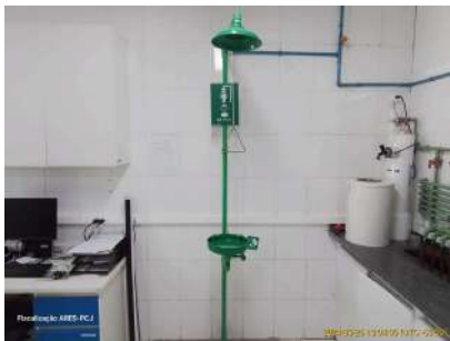
Foto 1 - Chuveiro de emergência no laboratório.
