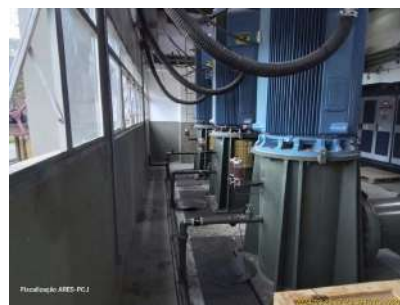
Foto 20 - Vista posterior do conjunto de moto bombas de recalque.
