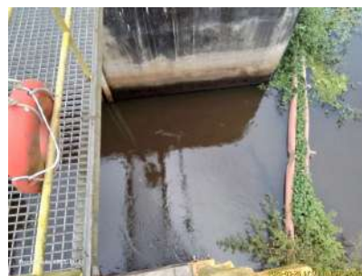
Foto 2 - Entrada da captação de água com boia de proteção contra macrófitas.
