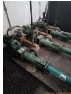
Foto 46 - Há 3 bombeamentos para a mesa adensadora, sendo 1 bomba reserva. Fluxo: tanque (ao lado da casa de secagem) -> mesa adensadora -> centrífuga.
