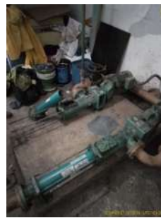
Foto 45 - Bombeamento de lodo, sendo 1 reserva.
