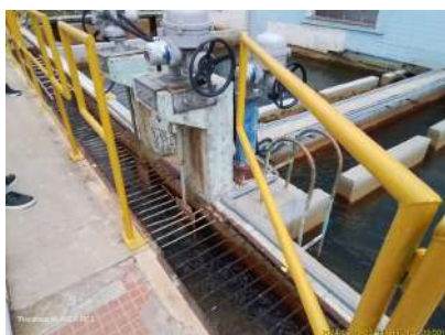
Foto 1 - Formato do guarda-corpo que impede o completo fechamento e segurança da estrutura.
