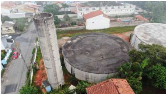
Foto 1 - Vista geral dos reservatórios Vila Suissa.
