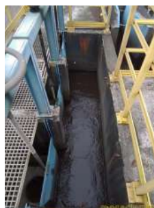
Foto 16 - Distribuição de vazão através de comportas após as caixas de areia. De acordo com o prestador, a distribuição é feita conforme a concentração de oxigênio dissolvido (OD) no efluente.
