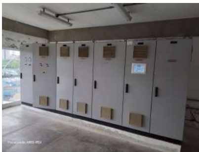
Foto 27 - Painéis elétricos da ETA.
