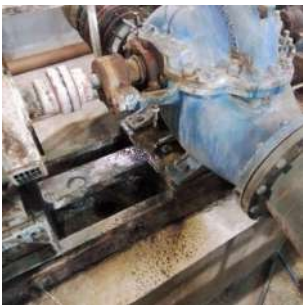
Foto 1 - Detalhe da tubulação de drenagem com vazamento.
