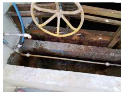
Foto 2 - Sistema de aplicação de PAC na caixa de entrada.
