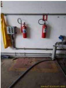
Foto 8 - Extintores dentro da casa das centrífugas.
