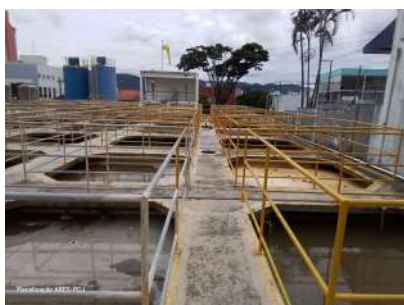
Foto 11 - Sistema de floculação.
