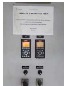
Foto 3 - Detalhe do painel elétrico da Bomba 3.
