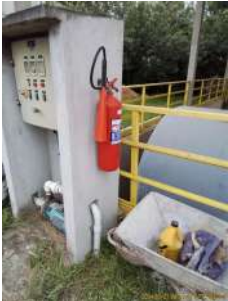
Foto 7 - Extintor próximo às chicanas de desinfecção.
