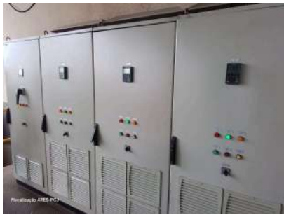
Foto 6 - Detalhe do painel elétrico.
