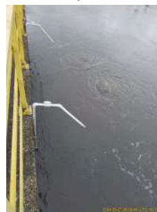
Foto 22 - Respiro do tanque de aeração.
