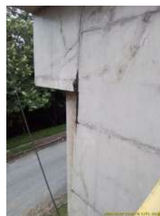
Foto 2 - Vazamento 2 próximo a escada de acesso ao tanque 1.
