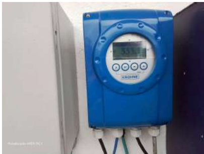
Foto 1 - Medidor de vazão da EEA.
