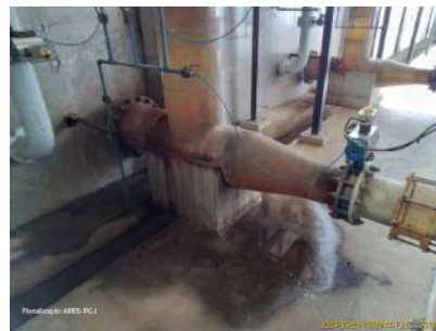
Foto 2 - Vazamento na saída do filtro 3.
