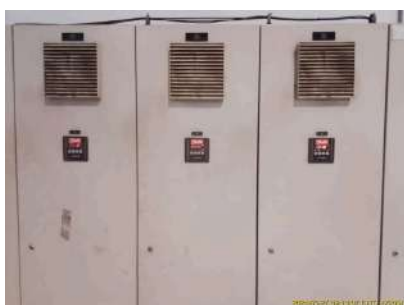
Foto 24 - Painéis elétricos juntos aos sopradores.
