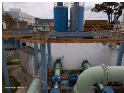
Foto 20 - Em branco tanque de recalque para a filtração auxiliar.
