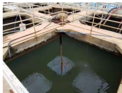
Foto 10 - Detalhe do sistema de agitação inoperante.
