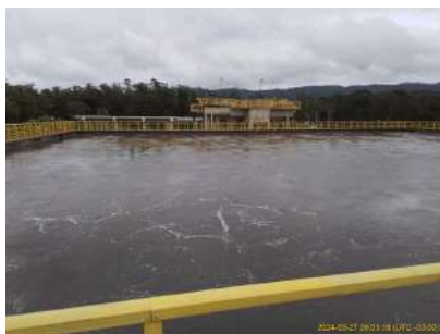
Foto 19 - Tanque de aeração 1.
