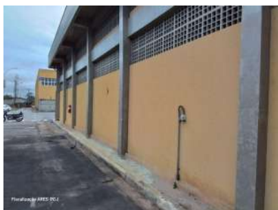
Foto 1 - Vista externa das EEAs.
