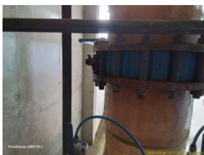
Foto 3 - Vazamento na saída do filtro 4.
