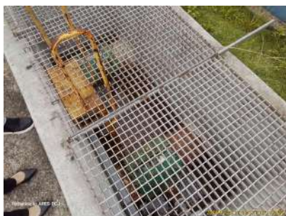
Foto 16 - Saídas das duas adutoras da captação com macromedidor.
