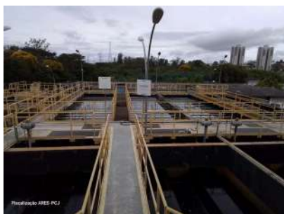
Foto 19 - Vista geral do processo de tratamento da ETA.
