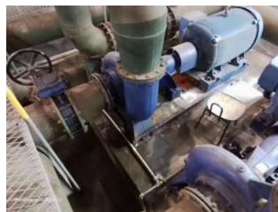
Foto 2 - Base de concreto molhada pela ineficiência da drenagem.
