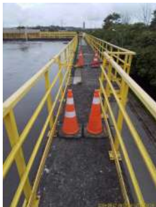
Foto 1 - Detalhe do trecho interditado no tanque de aeração 1.
