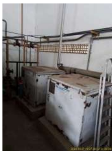
Foto 47 - Sopradores dentro da casa de secagem.
