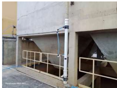
Foto 3 - Tanques de adensamento de lodo.
