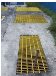
Foto 3 - Chegada do esgoto bruto.
