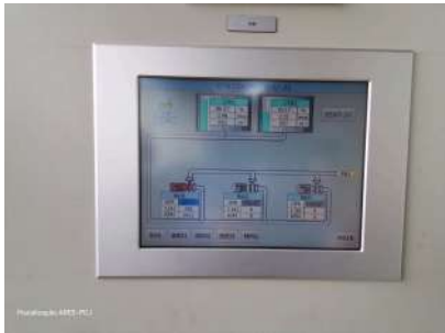
Foto 7 - Painel de monitoramento da operação.
