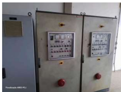
Foto 7 - Painel elétrico das centrífugas.
