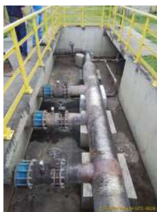
Foto 34 - Saída dos decantadores.
