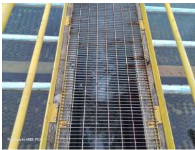
Foto 9 - Detalhe do decantador de alta taxa.
