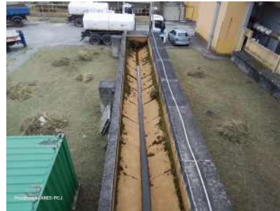
Foto 12 - Cana de condução do efluente de lavagem dos filtros.
