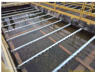
Foto 1 - Vertedor desnivelado detalhe 1.
