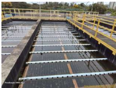
Foto 3 - Vertedor desnivelado detalhe 3.
