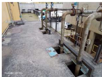
Foto 5 - Laje sem guarda-corpo sobre o tanque de equalização de lodo.
