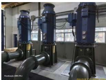
Foto 19 - Vista frontal do conjunto de moto bombas de recalque.
