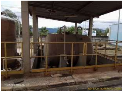
Foto 9 - Baia de contenção dos tanques de produtos químicos.
