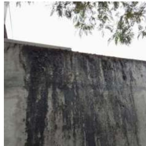
Foto 2 - Vazamento 2 (próximo ao muro).
