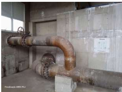
Foto 34 - Entrada da água tratada no tanque de contato.
