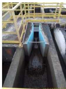
Foto 14 - Chegada da recirculação. O efluente de recirculação é misturado com o bruto após tratamento preliminar.
