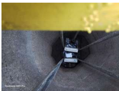
Foto 1 - Detalhe do gradeamento grosseiro.
