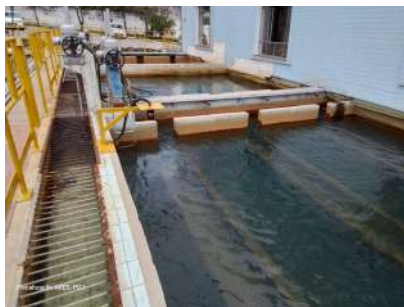
Foto 24 - Detalhe do sistema de filtração.
