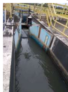
Foto 7 - Calha Parshall e macromedidor na chegada, após peneiras e anterior às caixas de areia.
