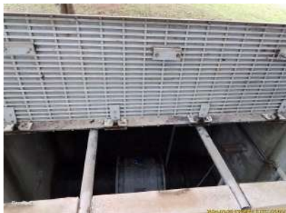
Foto 3 - Vista da caixa de proteção aberta.
