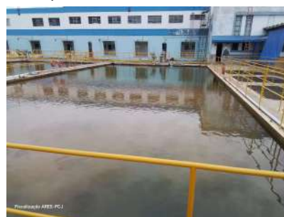
Foto 14 - Detalhe do decantador.
