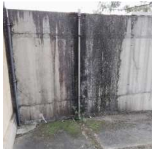
Foto 1 - Vazamento 1 (próximo à EEA).
