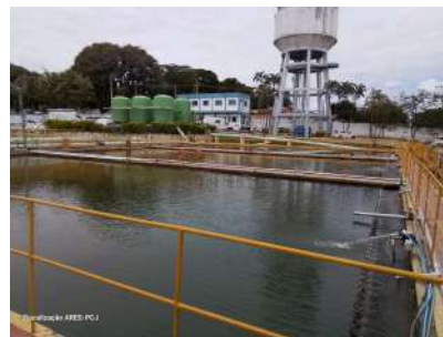
Foto 21 - Sistema de decantação e filtro auxiliar ao fundo em verde.
