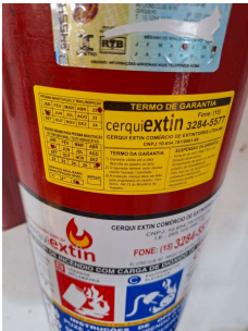
Foto 2 - Validade regular extintor de incêndio Captação Rio Sorocaba
