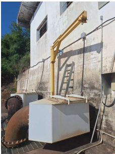
Foto 5 - Trave para manobra de peneiramento
