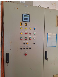
Foto 7 - Painel de indicação de funcionamento dos conjuntos motobomba
