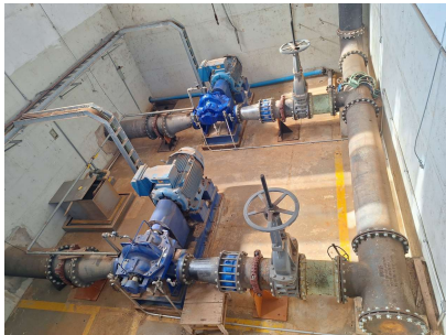
Foto 6 - Conjuntos motobomba: duas unidades que funcionam alternadamente
