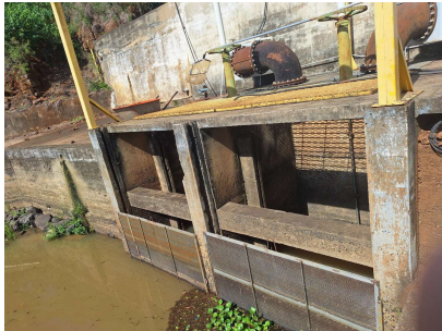
Foto 4 - Grades de retenção de materiais sólidos.
