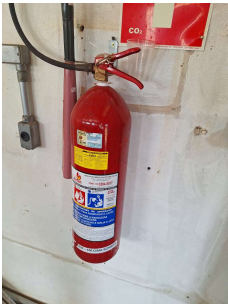
Foto 1 - Extintor de incêndio
