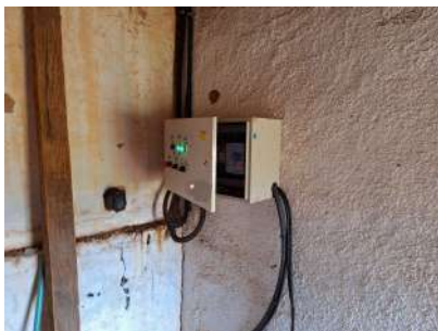
Foto 5 - Painel de controle do acionamento das bombas
