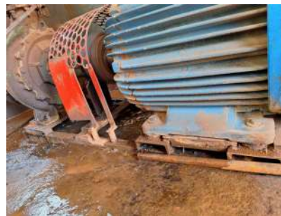
Foto 2 - Detalhe de vazamento em bomba
