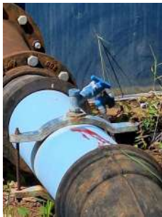
Foto 3 - Ponto para coleta de água para amostragem
