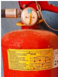
Foto 1 - Validade expirada - extintor de incêndio
