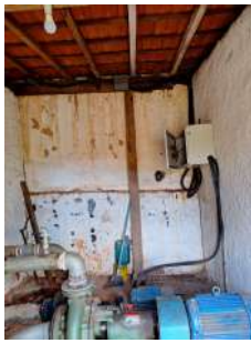
Foto 1 - O acesso para manutenção é dificultado
