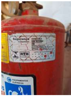
Foto 2 - Extintor de incêndio com validade expirada (2)
