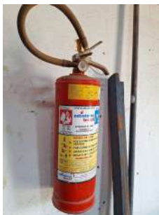
Foto 1 - Extintor de incêndio
