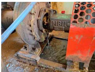
Foto 3 - Detalhe segundo ponto de vazamento na bomba
