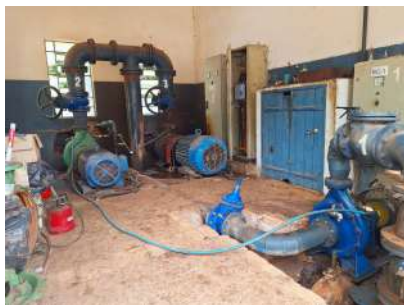
Foto 5 - Conjuntos motobomba da captação
