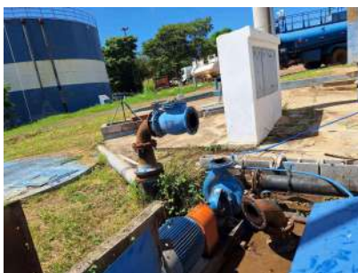
Foto 1 - Ausência de bomba reserva e bomba em manutenção
