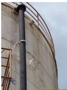
Foto 1 - Tubo extravasor no reservatório
