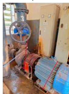
Foto 8 - Indicação de dois locais de vazamento - Bomba
