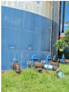
Foto 2 - Saídas para diferentes setores da rede de distribuição
