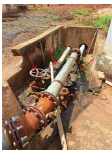
Foto 7 - Indicação de três locais de vazamento - Adutora
