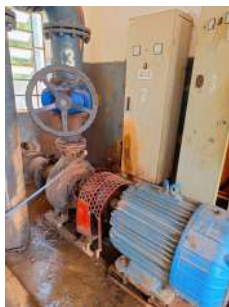
Foto 1 - Bomba com vazamento
