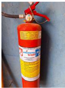
Foto 1 - Extintor de incêndio
