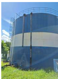
Foto 5 - Indicação de nível do reservatório (ausência de régua)
