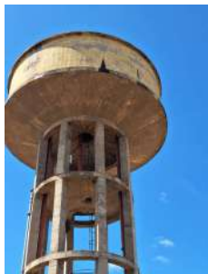
Foto 1 - Ponto de vazamento de água
