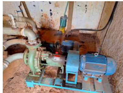
Foto 4 - Conjuntos motobomba - Booster dos Reservatórios Saleme 1 e 2
