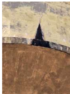
Foto 2 - Detalhe do vazamento no reservatório
