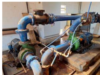
Foto 4 - Conjuntos motobomba de alimentação do RES ELEVADO
