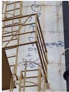
Foto 2 - Pixação no reservatório
