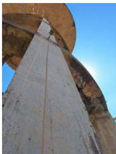
Foto 3 - Cabo de aterramento do para-raios
