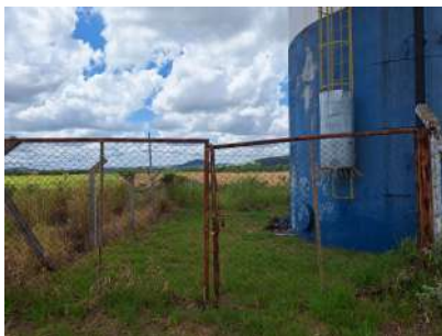
Foto 1 - Entrada do Reservatório Flórida - ausência de identificação
