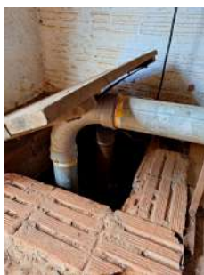
Foto 1 - Poço de sucção aberto, com risco de entrada de animais
