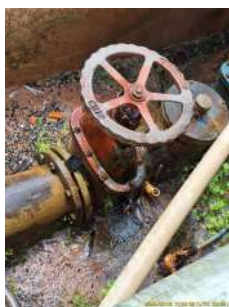
Foto 5 - vazamento no registro
