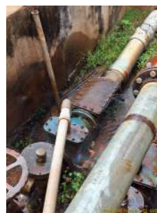
Foto 6 - Vazamento na tubulação da adutora à esquerda
