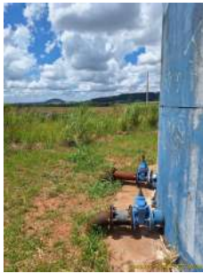
Foto 1 - Mato alto e Pixação no reservatório
