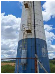
Foto 1 - Guarda-corpos em escada - Reservatório Flórida
