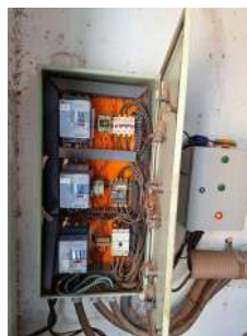
Foto 2 - Pannel de acionamento das bombas - aberto
