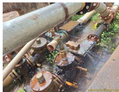
Foto 4 - Vazamentos na Tubulação da adutora à direita
