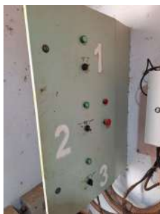
Foto 1 - Painéis de acionamento das Bombas
