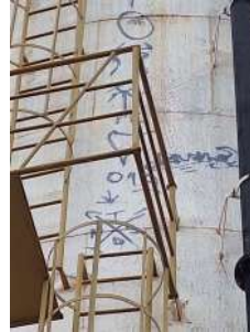
Foto 2 - Pixação sobre reservatório
