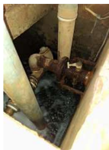
Foto 2 - Poço de sucção aberto, com risco de entrada de animais (2)
