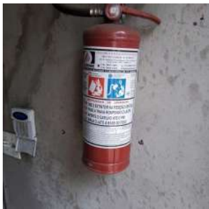
Foto 1 - Extintor de incêndio da Estação Elevatória de água bruta da Captação Boa Vista
