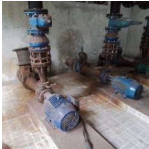
Foto 5 - Bombas da Estação Elevatória de água bruta da Captação Boa Vista
