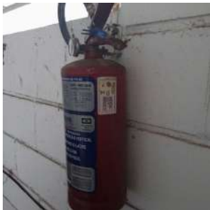
Foto 1 - Extintor de incêndio do reservatório Campo Verde em Iracemápolis
