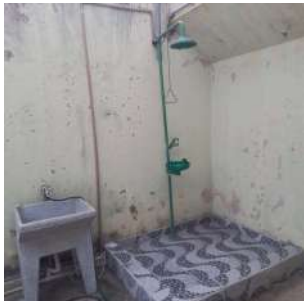
Foto 3 - Chuveiro de emergência da ETA de Iracemápolis
