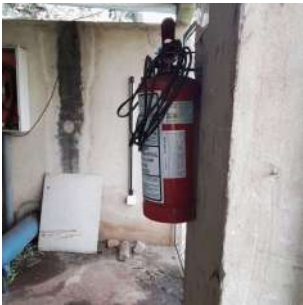
Foto 1 - Extintor de incêndio dos reservatórios Ometto Pavan em Iracemápolis
