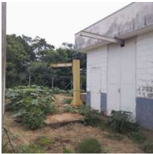
Foto 2 - Estação elevatória de efluente bruto Campos Verde em Iracemápolis
