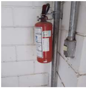
Foto 1 - Extintor de incêndio com validade expirada da Estação elevatória de efluente bruto Campos Verde em Iracemápolis
