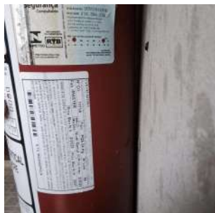
Foto 1 - Extintor com validade expirada na Estação elevatória de água bruta da Captação Boa vista
