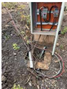
Foto 1 - Fios desencapados na cabine de baixa tensão das bombas elevatórias de água bruta da Captação Boa vista
