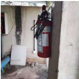
Foto 4 - Extintor de incêndio do Reservatório apoiado Ometto Pavan em Iracemápolis
