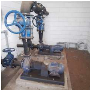
Foto 1 - Estação elevatória de água tratada do reservatório Campo Verde em Iracemápolis
