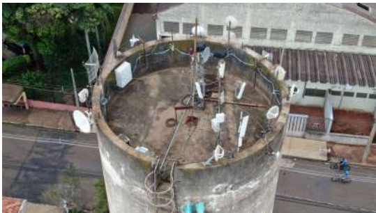
Foto 1 - Para-raios visto por drone do reservatório do Ometto Pavan elevado em Iracemápolis
