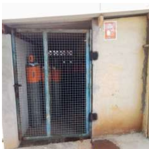
Foto 1 - Gás cloro utilizado na ETA de Iracemápolis
