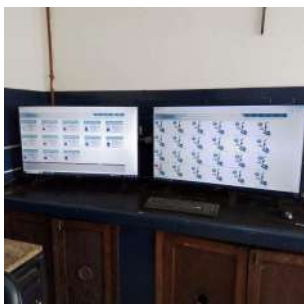
Foto 9 - Central de controle da ETA de Iracemápolis
