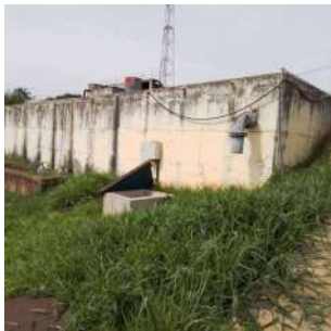
Foto 1 - Tampa em más condições de uso no reservatório enterrado da ETA em Iracemápolis
