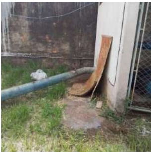
Foto 6 - Objetos espalhados no Reservatório apoiado Ometto Pavan em Iracemápolis
