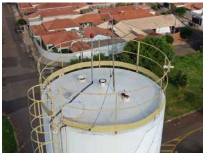
Foto 1 - Para-raios do reservatório Campo Verde em Iracemápolis
