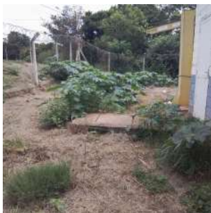
Foto 1 - Falta de limpeza e corte de grama na Estação elevatória de efluente bruto Campos Verde em Iracemápolis
