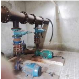
Foto 6 - Bombas da Estação Elevatória de água bruta da Captação Boa Vista
