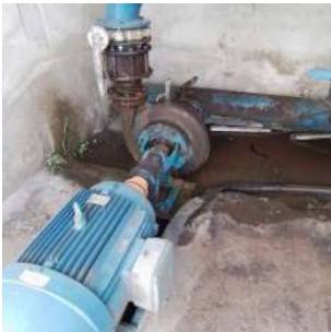
Foto 1 - Vazamento na bomba da estação elevatória de água tratada dos reservatórios Ometto Pavan em Iracemápolis
