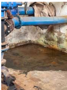
Foto 1 - Vazamento na sala de bombas na ETA de Iracemápolis
