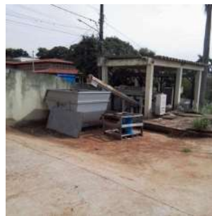
Foto 2 - Centrifuga do Tratamento de lodo não operante da ETA de Iracemápolis
