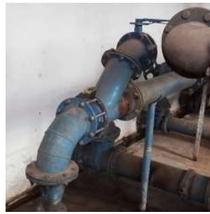
Foto 12 - Bombas da ETA de Iracemápolis
