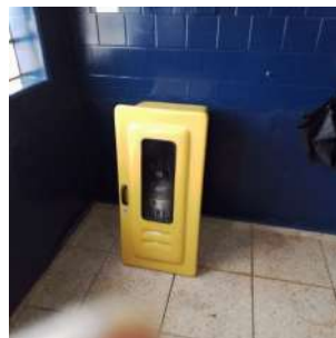
Foto 8 - Kit de emergência do gás cloro da ETA de Iracemápolis
