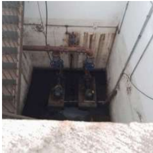
Foto 3 - Estação elevatória de efluente bruto Campos Verde em Iracemápolis
