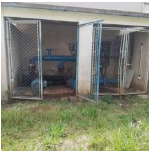
Foto 3 - Bombas da estação elevatória de água tratada dos reservatórios Ometto Pavan em Iracemápolis
