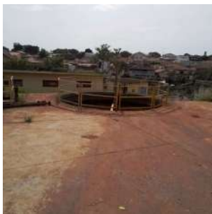
Foto 1 - Tratamento de lodo não operante da ETA de Iracemápolis
