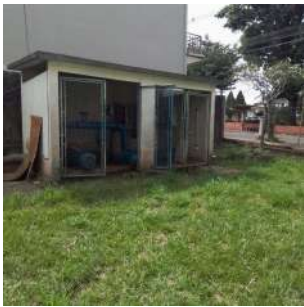
Foto 2 - Bombas da estação elevatória de água tratada dos reservatórios Ometto Pavan em Iracemápolis
