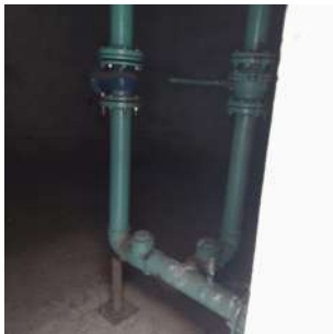
Foto 5 - Tubulação de água do reservatório do Ometto Pavan elevado em Iracemápolis
