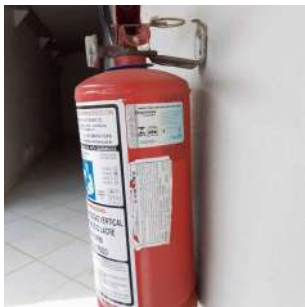
Foto 1 - Extintor de incêndio vencido na ETA de Iracemápolis
