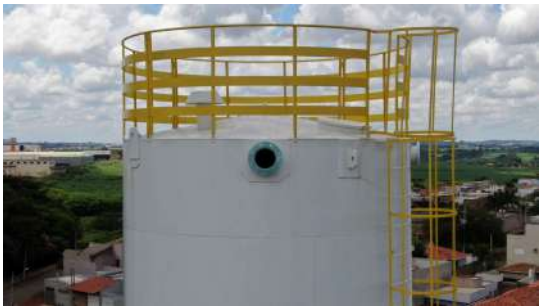
Foto 1 - Inexistência de tela de proteção na tubulação de ventilação do reservatório elevado Campo Verde em Iracemápolis
