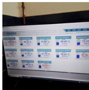
Foto 10 - Central de controle da ETA de Iracemápolis
