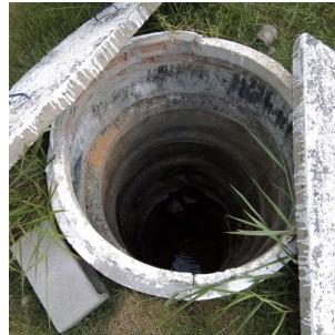
Foto 3 - Tampas de proteção abertas.
