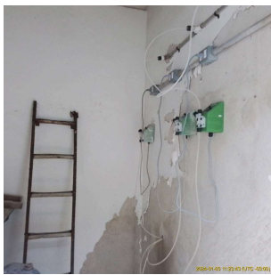
Foto 1 - Dosadoras da ETA.
