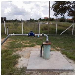
Foto 1 - Macromedidor do poço.
