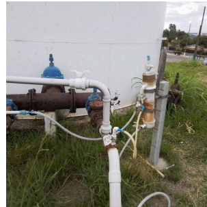
Foto 4 - Sistema de dosagem química.
