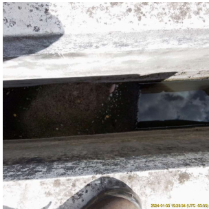
Foto 2 - Caixa de areia com material acumulado.
