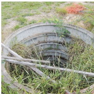
Foto 11 - Tanque de recalque do futuro tratamento de lodo.
