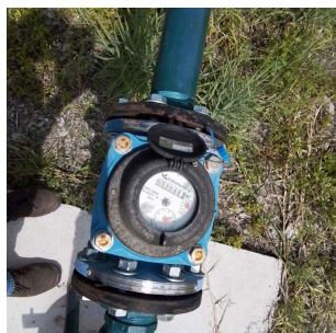
Foto 1 - Macromedidor do poço.
