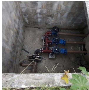
Foto 4 - Saída da linha de recalque.
