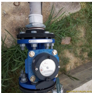
Foto 1 - Macromedidor do poço.
