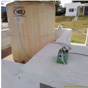
Foto 3 - Tanque de hipoclorito vazio (inoperante).
