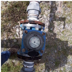
Foto 1 - Macromedidor do poço.
