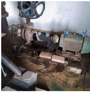
Foto 1 - Vazamento na conexão da bomba da antiga EEAT.
