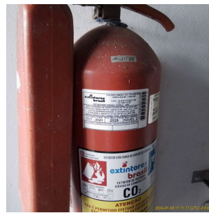
Foto 2 - Validade de manutenção vencida.
