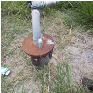
Foto 1 - Tubo de nível do poço.
