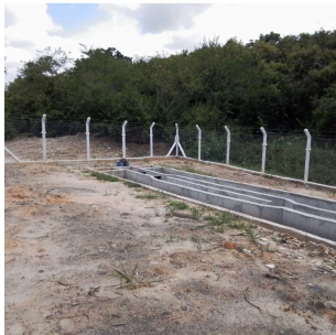
Foto 1 - Vista do gradeamento e caixa de areia da EEE.
