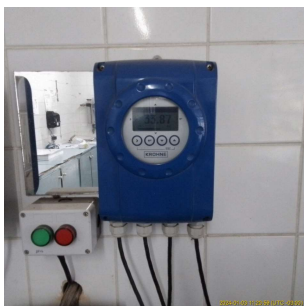
Foto 1 - Medição da água tratada.
