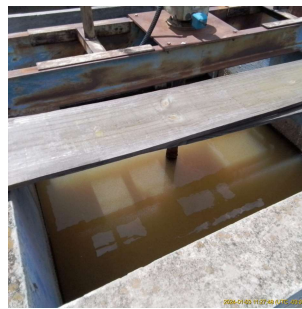
Foto 16 - Floclador da ETA.
