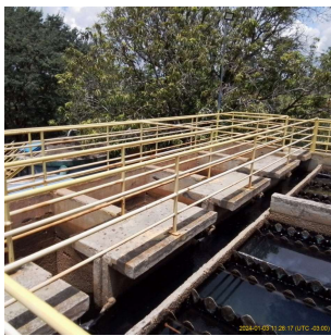
Foto 1 - Guarda-corpo baixo na passarela de limpeza dos filtros.
