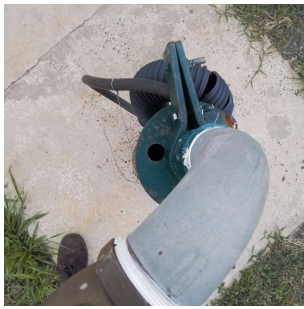
Foto 1 - Poço sem tubo de medição de nível.
