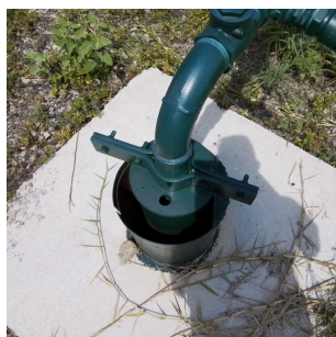
Foto 1 - Poço sem tubo de medição de nível.
