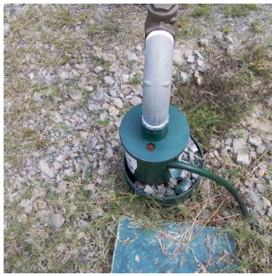
Foto 1 - Poço sem tubo de medição de nível.
