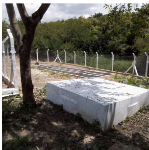
Foto 4 - Vista do gradeamento e caixa de areia da EEE.
