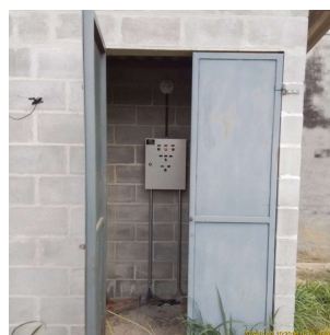
Foto 2 - Vista do abrigo do painel elétrico.
