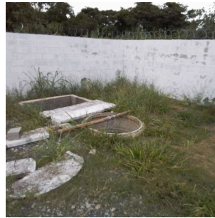
Foto 2 - Mato no interior da EEEB.
