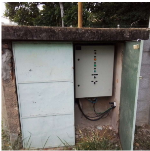
Foto 2 - Vista do abrigo do painel elétrico.
