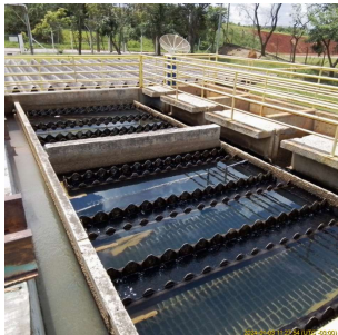
Foto 17 - Vista dos decantadores.
