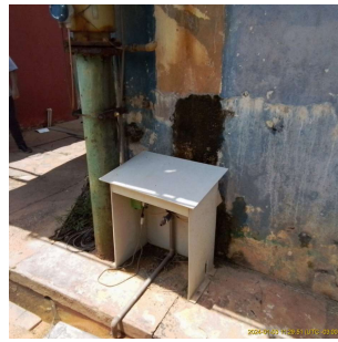
Foto 2 - Vazamento na alvenaria da estrutura da ETA. Ponto 1.
