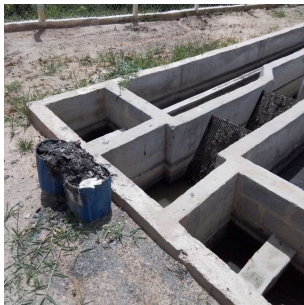
Foto 1 - Recipiente para limpeza das grades.
