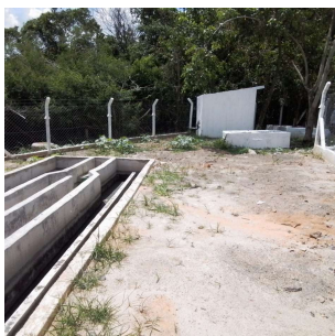
Foto 1 - Vista da EEE.
