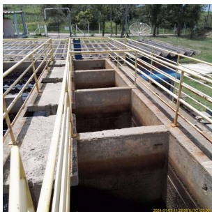
Foto 19 - Filtros da ETA.
