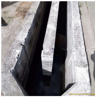
Foto 3 - Caixa de areia.
