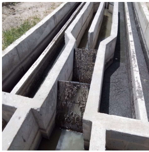
Foto 1 - Sistema de gradeamento da EEE.
