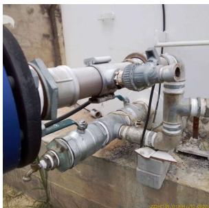
Foto 1 - Vazamento na tomada de água bruta.
