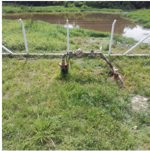
Foto 1 - Poço sem laje.
