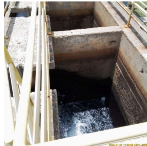
Foto 18 - Filtro da ETA.
