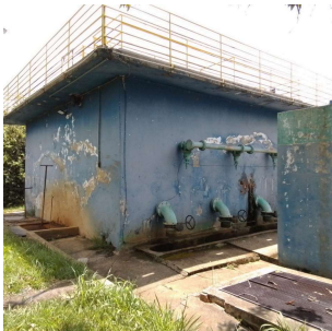
Foto 4 - Vista da ETA.
