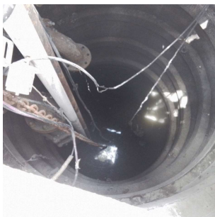
Foto 6 - Vista do poço de sucção.
