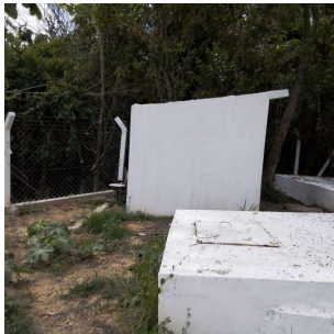
Foto 2 - Vista do sistema de bombeamento e elétrica.
