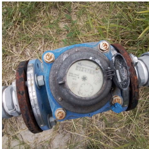
Foto 1 - Macromedidor do poço.
