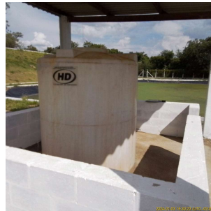
Foto 10 - Armazenamento de hipoclorito.
