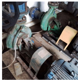
Foto 6 - Drenagem das gaxetas da EEAT.
