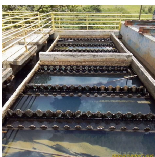
Foto 1 - Vertedores da ETA.
