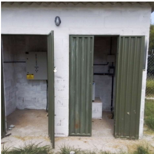
Foto 3 - Vista do abrigo do painel elétrico.
