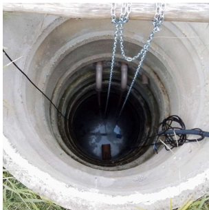
Foto 3 - Poço de sucção.
