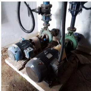
Foto 7 - EEAT da ETA.
