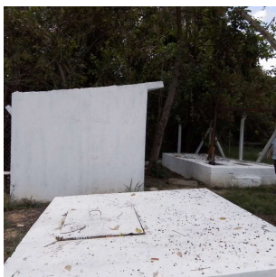
Foto 3 - Vista do sistema de bombeamento e elétrica.
