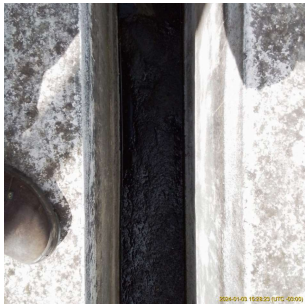
Foto 1 - Caixa de areia com material acumulado.
