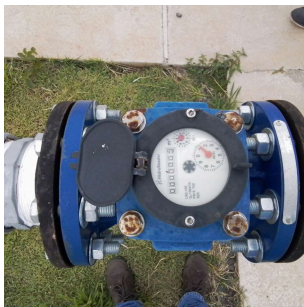
Foto 1 - Macromedidor do poço.
