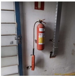
Foto 1 - Extintor da ETA.
