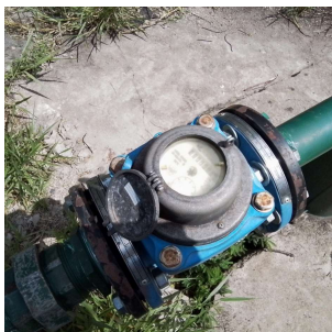
Foto 1 - Macromedidor do poço.
