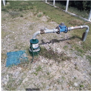
Foto 1 - Poço sem laje.
