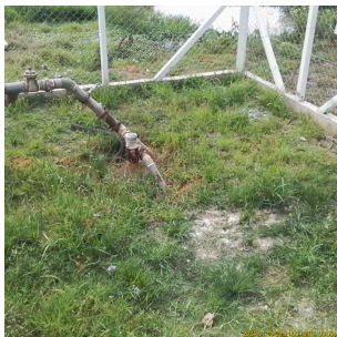
Foto 1 - Poço sem desinfecção e fluoretação.
