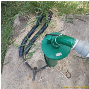
Foto 1 - Tubo de nível do poço.
