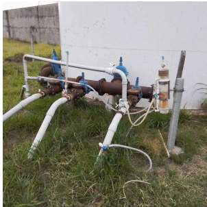
Foto 3 - Sistema de dosagem química.
