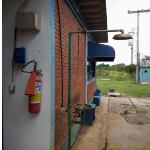
Foto 1 - Chuveiro da ETA inoperante.
