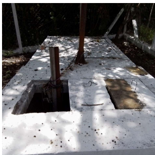
Foto 5 - Vista do poço de sucção.
