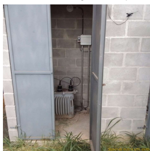
Foto 3 - Vista do abrigo do transformador elétrico.
