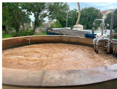
Foto 22 - Entrada de água bruta
