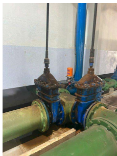
Foto 1 - Vazamento nos registros
