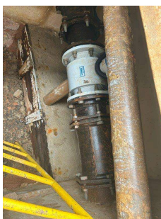
Foto 11 - Macromedidor de vazão
