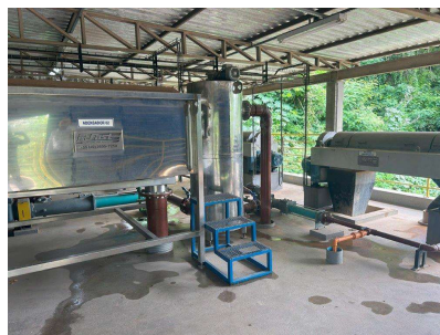
Foto 28 - Tratamento de lodo
