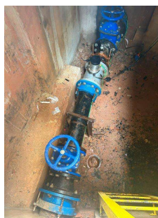
Foto 12 - Macromedidor de vazão
