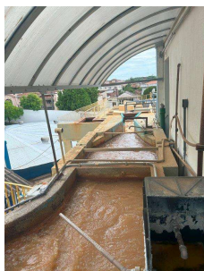
Foto 23 - Entrada de água bruta
