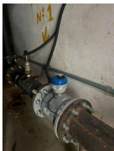
Foto 9 - Macromedidor de vazão
