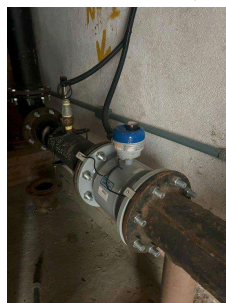
Foto 8 - Macromedidor de vazão
