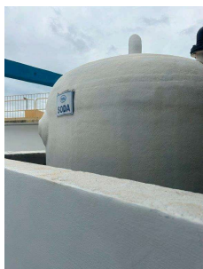
Foto 3 - Armazenamento de produto químico
