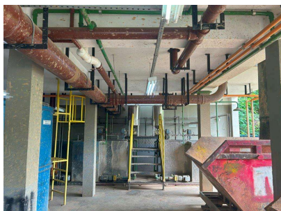
Foto 27 - Tratamento de lodo
