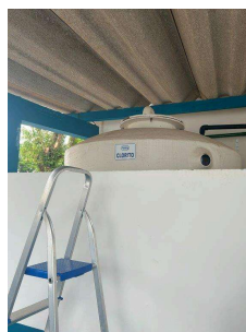
Foto 6 - Armazenamento de produto químico
