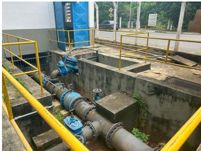
Foto 1 - Barrilete da casa de bombas
