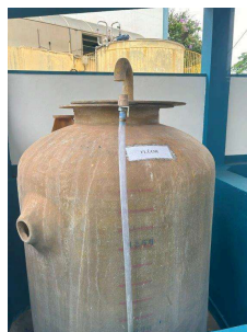
Foto 4 - Armazenamento de produto químico
