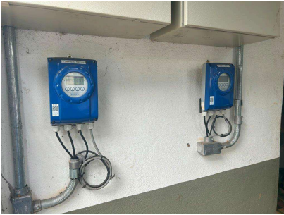
Foto 4 - Medidores de vazão
