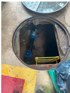
Foto 13 - Macromedidor de vazão
