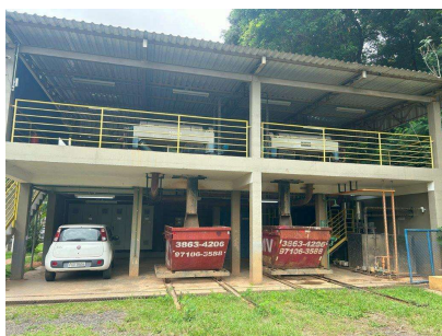
Foto 1 - Sistema de tratamento de lodo
