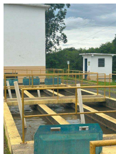
Foto 7 - Entrada de esgoto bruto
