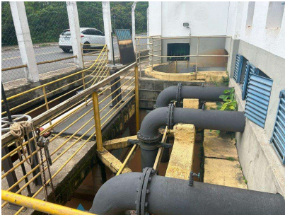
Foto 6 - Barrilete da captação
