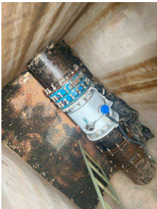
Foto 2 - Medidor de vazão
