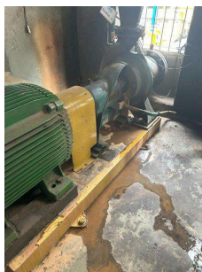
Foto 1 - Drenagem da gaxeta inadequada
