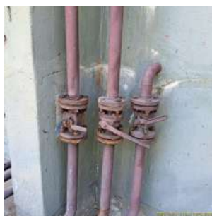
Foto 6 - Oxidação nos registros das tubulações da parede lateral do Reator UASB II.
