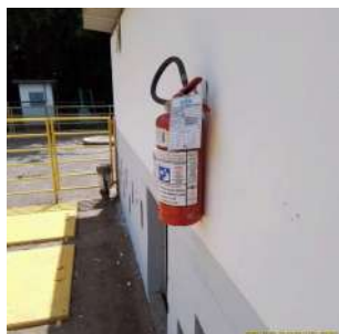
Foto 1 - Extintor junto à elevatória.
