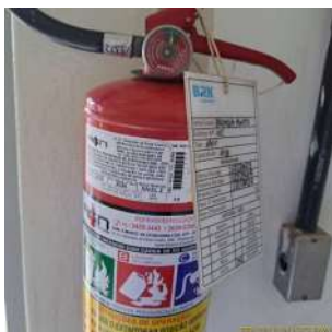
Foto 1 - Validade vigente do extintor de incêndio do prédio operacional.
