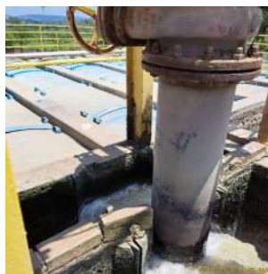
Foto 2 - Oxidação da base da estrutura de sustentação da tubulação de chegada do esgoto bruto.
