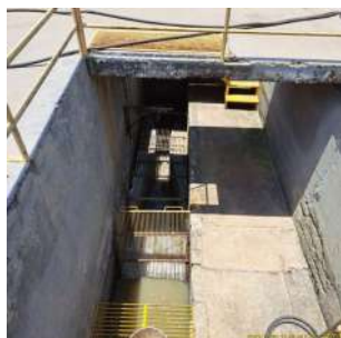
Foto 7 - Gradeamento grosseiro e calha Parshal (ao fundo).
