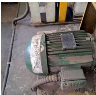
Foto 19 - Primeiro conjunto motobomba de recirculação do lodo.
