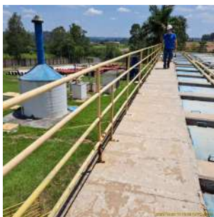
Foto 3 - Guarda-corpos com sinais de oxidação (ferrugem) na base de fixação na cobertura dos reatores UASB.
