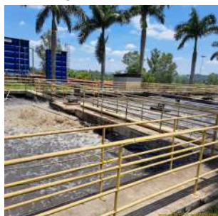
Foto 9 - Vista dos tanques do processo de tratamento por lodos ativados (pós UASB) com aeração mecanizada.
