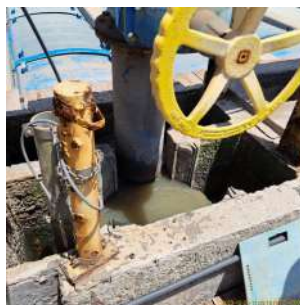
Foto 6 - Chegada do esgoto bruto e distribuição entre os 4 módulos UASB.
