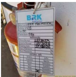
Foto 1 - Detalhe da validade do extintor junto à elevatória.
