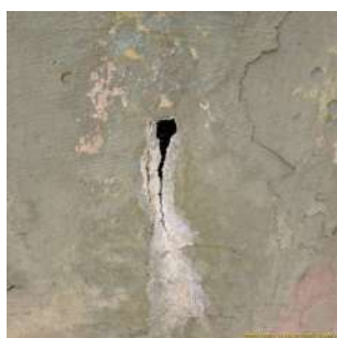
Foto 7 - Detalhe do vazamento na parede do Reator UASB III (frente para os tanques de lodos ativados e ao lado dos antigos tanques de oxigênio).
