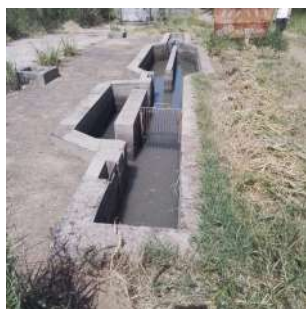
Foto 1 - Chegada do esgoto bruto.
