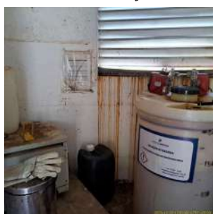
Foto 7 - Armazenamento e bombas dosadoras do catalisador metabólico.
