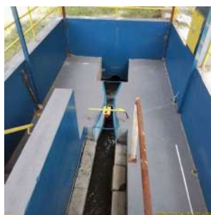
Foto 2 - Vista geral da saída do efluente tratado.
