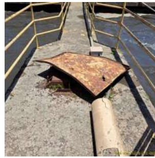
Foto 9 - Passarela sobre os tanques de aeração de lodos (pós UASB), onde há cobertura inadequada de espaço onde antes havia aerador mecânico.
