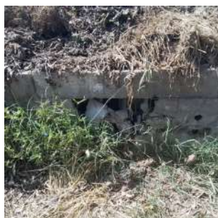
Foto 1 - Estrutura de contenção dos aguapés danificada.
