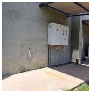
Foto 6 - Parede do Reator UASB III (frente para os tanques de lodos ativados e ao lado dos antigos tanques de oxigênio) com vazamento.
