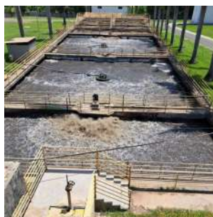
Foto 8 - Vista dos tanques do processo de tratamento por lodos ativados (pós UASB) com aeração mecanizada.
