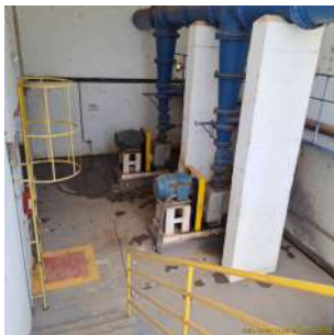
Foto 11 - Vista interna da casa de bombas e dos dois conjuntos motobomba externos da elevatória.
