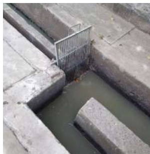
Foto 6 - Detalhe do gradeamento grosseiro na chegada do esgoto bruto.
