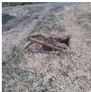
Foto 3 - Local com risco de queda.
