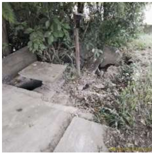
Foto 1 - Próximo ao tratamento preliminar, foram identificadas estruturas danificadas. É necessário providenciar a manutenção no local.
