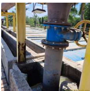
Foto 3 - Oxidação da base da estrutura de sustentação da tubulação de chegada do esgoto bruto.
