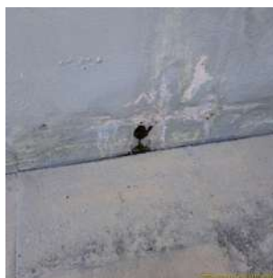
Foto 2 - Vazamento da parede lateral do Reator UASB II.
