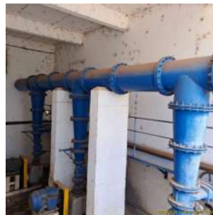
Foto 12 - Barrilete da elevatória.
