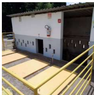
Foto 2 - Elevatória junto ao tratamento preliminar.
