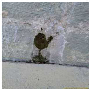
Foto 3 - Detalhe do vazamento da parede lateral do Reator UASB II.
