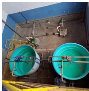
Foto 16 - Tanques de mistura do polímero para adensamento do lodo, sendo o polímero adicionado na tubulação de subida do lodo para as bombas centrífugas.
