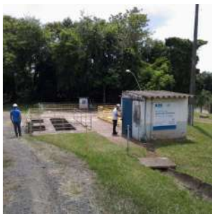
Foto 5 - Elevatória junto ao tratamento preliminar.
