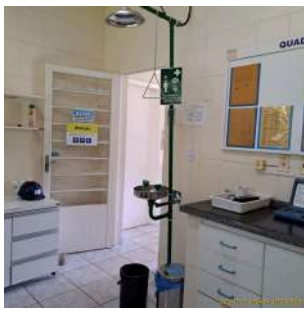
Foto 1 - Chuveiro de emergência no laboratório dentro do prédio operacional da ETE.
