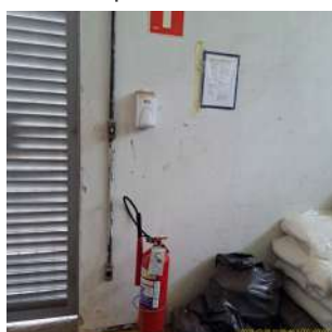
Foto 3 - Extintor de incêndio do abrigo das bombas de recirculação de lodo.
