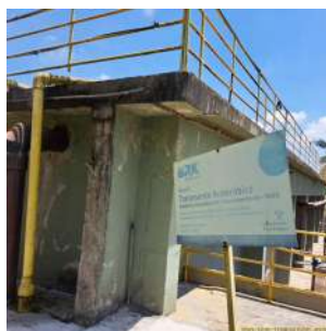
Foto 4 - Placa de identificação da etapa de tratamento do esgoto referente aos reatores UASB.
