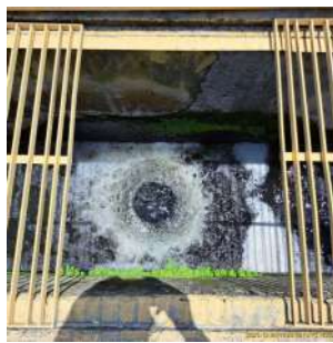
Foto 13 - Saída do efluente tratado.
