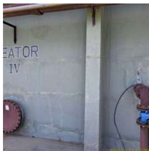
Foto 4 - Identificação da parede lateral com vazamento no Reator UASB IV..
