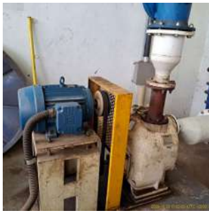
Foto 21 - Segundo conjunto motobomba de recirculação do lodo.
