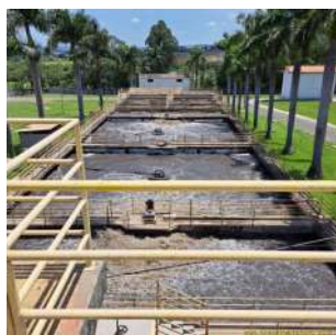
Foto 7 - Vista dos tanques do processo de tratamento por lodos ativados (pós UASB) com aeração mecanizada.
