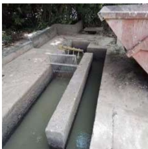
Foto 7 - Vista da chegada - gradeamento grosseiro.
