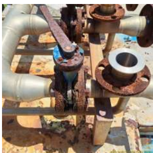
Foto 5 - Oxidação dos registros da tubulação do futuro sistema de coleta e queima de gás dos Reatores UASB.
