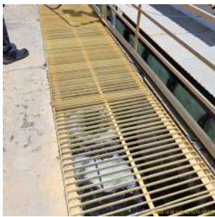
Foto 12 - Saída do efluente tratado.
