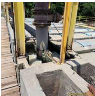
Foto 1 - Oxidação da base da estrutura de sustentação da tubulação de chegada do esgoto bruto.
