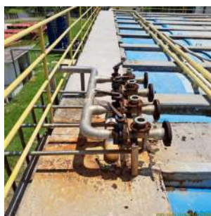
Foto 4 - Oxidação dos registros da tubulação do futuro sistema de coleta e queima de gás dos Reatores UASB.
