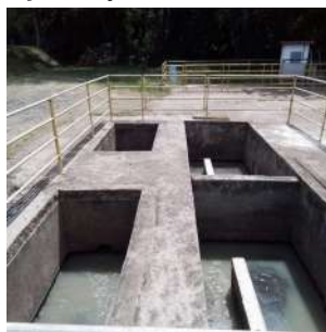
Foto 9 - Poços junto à E.E.E. instalada ao lado da chegada de esgoto bruto.
