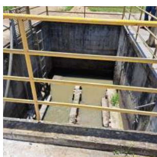
Foto 5 - Chegada do esgoto bruto e caixa desarenadora.
