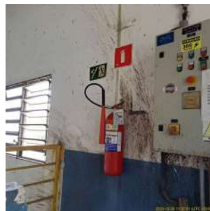
Foto 2 - Extintor de incêndio no prédio das centrífugas de lodo.
