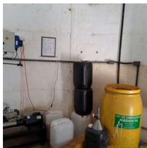
Foto 4 - Bombas dosadoras do produto químico de odorização.
