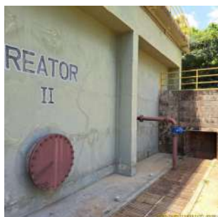
Foto 1 - Identificação da parede lateral com vazamento no Reator UASB II.
