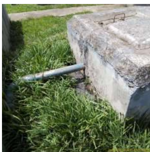
Foto 1 - Indício de vazamento detectado junto à entrada dos reatores UASB.
