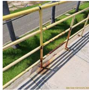
Foto 2 - Detalhe dos guarda-corpos com sinais de oxidação (ferrugem) na base de fixação na cobertura dos reatores UASB.
