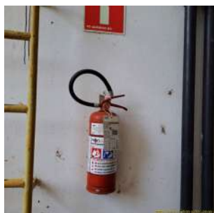
Foto 1 - Extintor de incêndio dentro da casa de bomba da elevatória.
