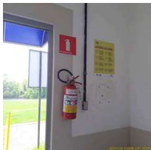
Foto 1 - Extintor de incêndio no prédio operacional.
