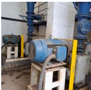
Foto 1 - Conjuntos motobomba da elevatória.
