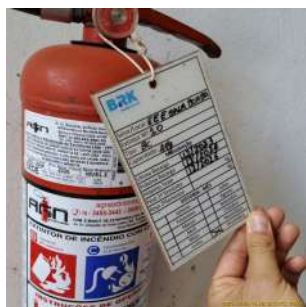
Foto 1 - Validade do extintor vigente.
