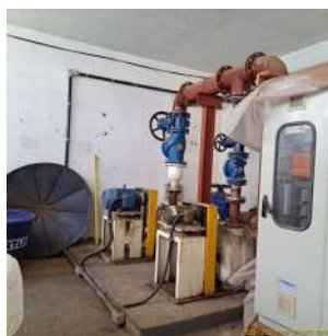
Foto 18 - Conjuntos motobomba de recirculação do lodo.
