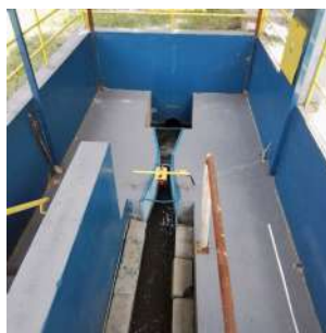
Foto 11 - Saída do efluente tratado.
