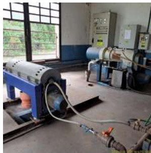
Foto 15 - Bombas centrífugas de lodo.
