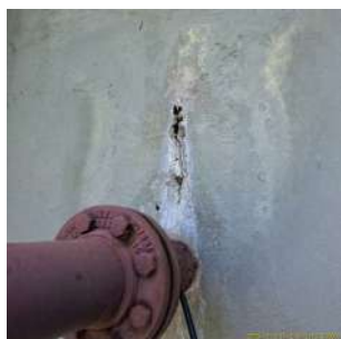
Foto 5 - Vazamento da parede lateral do Reator UASB IV.
