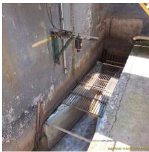
Foto 9 - Calha Parshal e macromedidor da elevatória.
