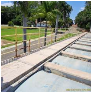
Foto 1 - Guarda-corpos com sinais de oxidação (ferrugem) na base de fixação na cobertura dos reatores UASB.
