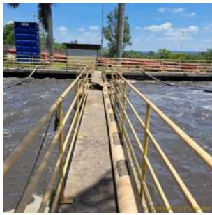
Foto 8 - Passarela sobre os tanques de aeração de lodos (pós UASB), onde há cobertura inadequada de espaço onde antes havia aerador mecânico.
