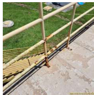
Foto 4 - Guarda-corpos com sinais de oxidação (ferrugem) na base de fixação na cobertura dos reatores UASB.
