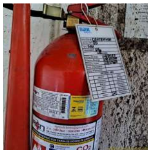
Foto 2 - Validade vigente do extintor de incêndio do prédio das centrífugas de lodo.
