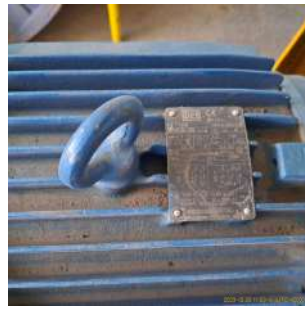
Foto 22 - Placa de especificação técnica do segundo conjunto motobomba de recirculação do lodo.
