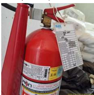
Foto 3 - Validade vigente do extintor de incêndio do abrigo de bombas de recirculação de lodo.
