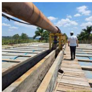
Foto 5 - Tubulação de chegada do esgoto recalcado pela estação elevatória.
