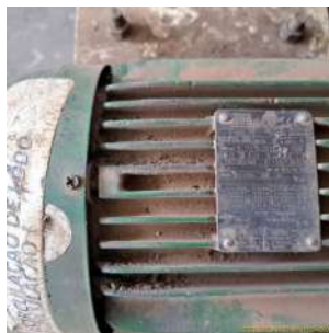
Foto 20 - Placa de especificação técnica do primeiro conjunto motobomba de recirculação do lodo.
