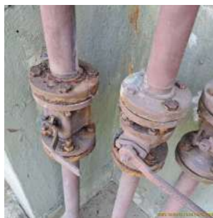
Foto 7 - Oxidação nos registros das tubulações da parede lateral do Reator UASB II.
