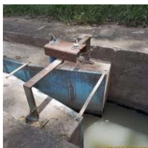
Foto 1 - Detalhe da calha parshall com sensor.
