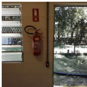
Foto 1 - Extintor de incêndio.
