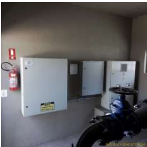
Foto 3 - Vista dos painéis elétricos da EEAT.
