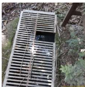
Foto 2 - Poço com acúmulo de esgoto aos fundos da EEEB.
