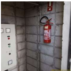
Foto 1 - Extintor de incêndio da EEEB.
