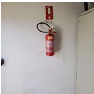
Foto 1 - Extintor de incêndio da EEAT.
