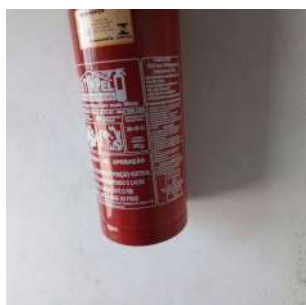
Foto 1 - Validade do extintor de incêndios da EEAT.
