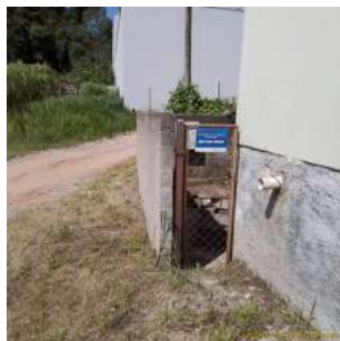
Foto 1 - Vista geral da EEEB.
