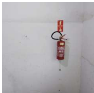
Foto 1 - Extintor de incêndio.
