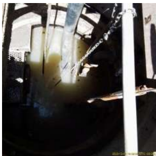
Foto 1 - Poço de sucção com uma bomba.
