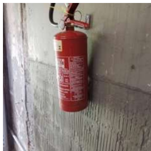
Foto 1 - Validade do extintor da EEAT.
