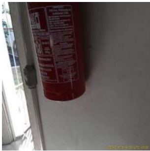
Foto 1 - Validade do extintor de incêndios da EEAT.
