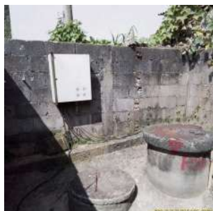
Foto 3 - Vista do painel elétrico da EEEB.
