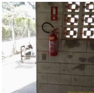
Foto 1 - Extintor de incêndio da EEEB.
