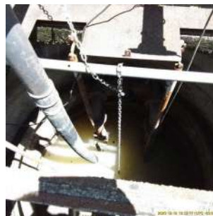
Foto 2 - Poço de sucção com uma bomba.
