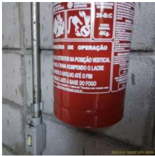
Foto 1 - Validade do extintor de incêndios da EEEB.
