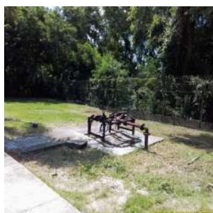
Foto 1 - Cerca da EEEB.
