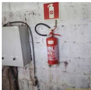
Foto 1 - Extintor de incêndio.
