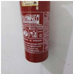
Foto 1 - Validade do extintor da EEAT.
