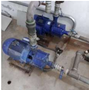
Foto 1 - Bombas com selo mecânico.
