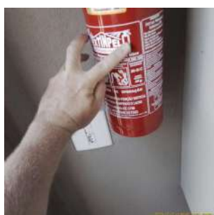
Foto 1 - Validade do extintor da EEAT.
