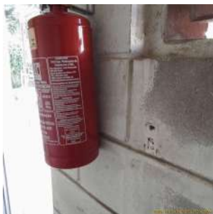
Foto 1 - Validade do extintor de incêndios da EEEB.
