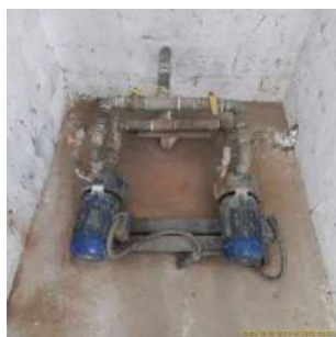
Foto 1 - Conjuntos moto bomba da EEAT.
