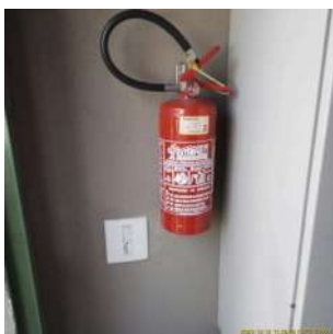
Foto 1 - Extintor de incêndio.
