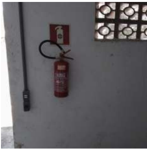
Foto 1 - Extintor de incêndio da EEEB.
