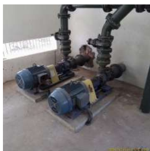
Foto 1 - Conjuntos moto bomba da EEAT.
