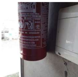
Foto 1 - Validade do extintor da EEAT.
