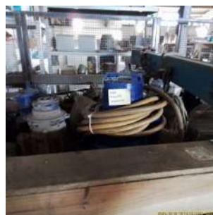
Foto 4 - Bomba reserva guardada no almoxarifado.
