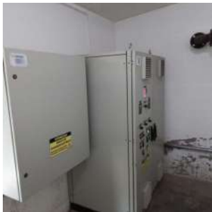
Foto 3 - Vista dos painéis elétricos da EEAT.
