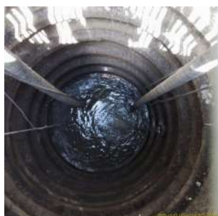
Foto 1 - Poço de sucção com uma bomba.
