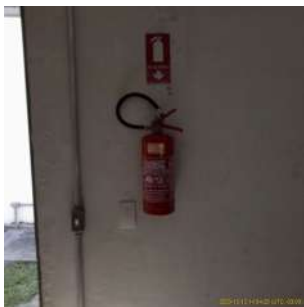
Foto 1 - Extintor de incêndio.
