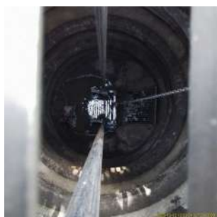
Foto 1 - Cesto da EEEB.
