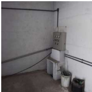
Foto 3 - Vista do painel elétrico da EEB.
