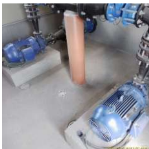
Foto 1 - Conjuntos moto bomba da EEAT.
