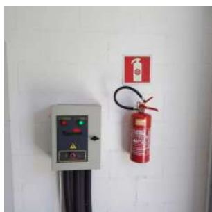
Foto 1 - Extintor de incêndio da EEEB.
