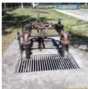
Foto 2 - Poço de sucção com uma bomba.
