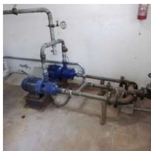
Foto 1 - Conjuntos moto bomba da EEAT.
