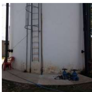
Foto 1 - Mangueira de medição de nível.
