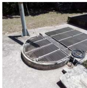
Foto 2 - Poço de sucção com uma bomba.
