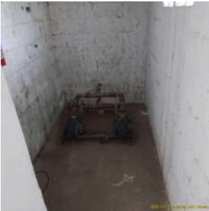
Foto 2 - Vista interna da EEAT.
