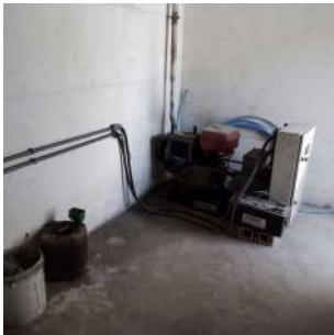
Foto 2 - Vista do gerador de energia elétrica da EEB.
