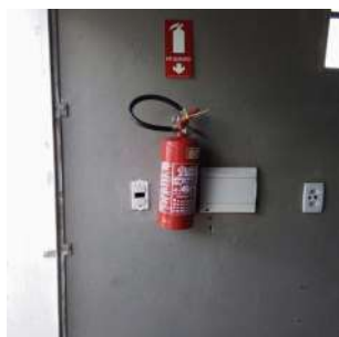
Foto 1 - Extintor de incêndio.
