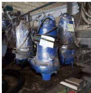
Foto 2 - Bomba reserva guardada no almoxarifado.
