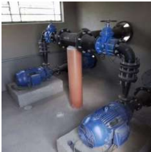
Foto 2 - Vista interna da EEAT.
