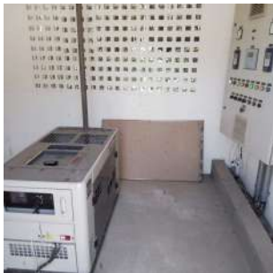
Foto 5 - Vista do gerador elétrico da EEEB.
