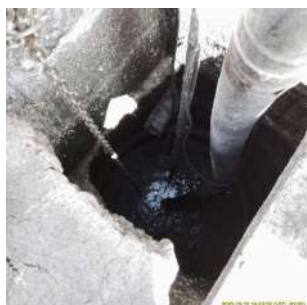
Foto 1 - Poço de sucção com uma bomba.
