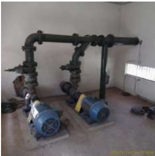
Foto 3 - Vista interna da EEAT.
