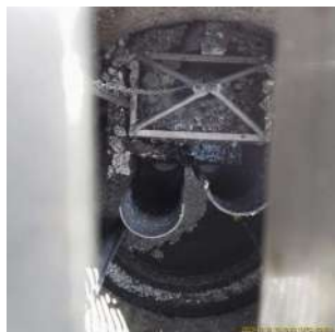
Foto 1 - Cesto da EEEB.
