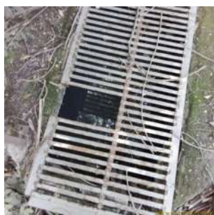
Foto 3 - Poço com acúmulo de esgoto aos fundos da EEEB.
