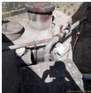
Foto 2 - Vista geral da EEEB.
