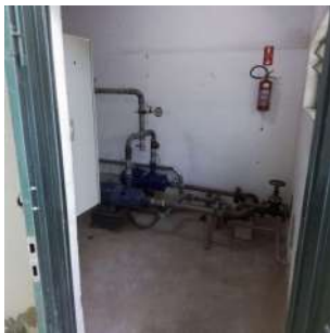
Foto 2 - Vista interna da EEAT.
