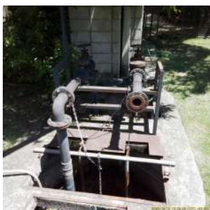
Foto 3 - Poço de sucção com uma bomba.
