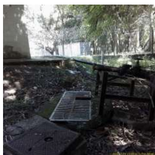
Foto 1 - Poço com acúmulo de esgoto aos fundos da EEEB.
