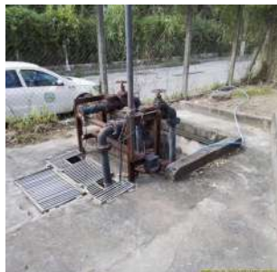
Foto 3 - Vista interna da EEEB.
