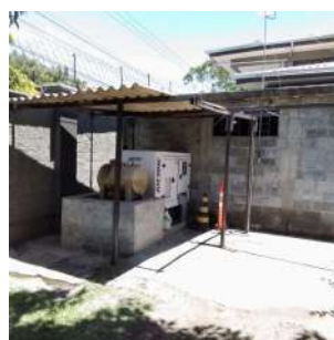
Foto 3 - Vista do gerador da EEAT.
