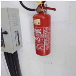
Foto 1 - Validade do extintor de incêndios da EEEB.
