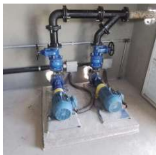
Foto 1 - Conjuntos moto bomba da EEAT.
