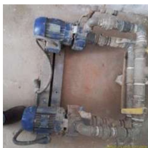
Foto 1 - Bombas com selo mecânico.
