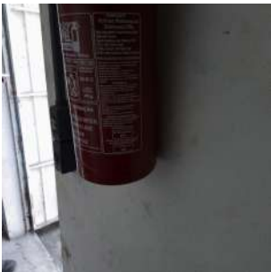
Foto 1 - Validade do extintor de incêndios da EEEB.
