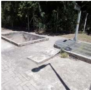
Foto 3 - Vista geral da EEEB.
