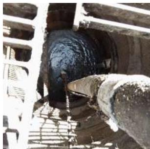
Foto 1 - Poço de sucção com uma bomba.
