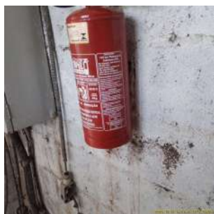
Foto 1 - Validade do extintor de incêndios da EEAT.
