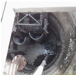
Foto 1 - Cesto com acúmulo de resíduos.
