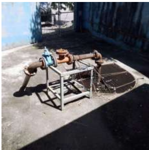
Foto 4 - Vista do sistema de bombeamento da EEB.
