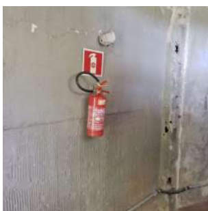
Foto 1 - Extintor de incêndio.
