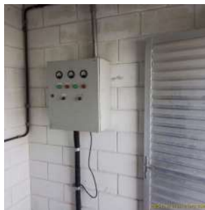
Foto 2 - Vista do painel elétrico da EEEB.
