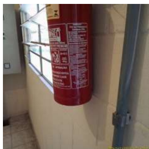
Foto 1 - Validade do extintor de incêndios da EEEB.
