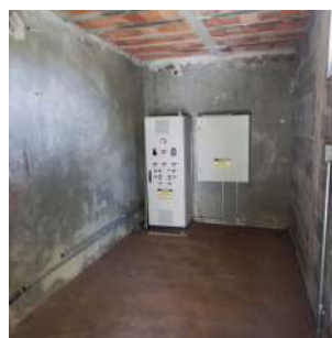
Foto 2 - Painéis elétricos da EEAT.
