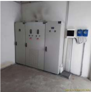
Foto 4 - Vista dos painéis elétricos da EEAT.
