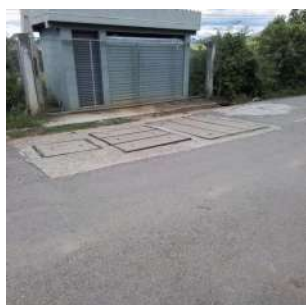
Foto 1 - Tampas de concreto de acesso à EEEB.
