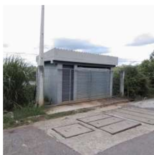
Foto 1 - Cerca no entorno do abrigo da parte elétrica.
