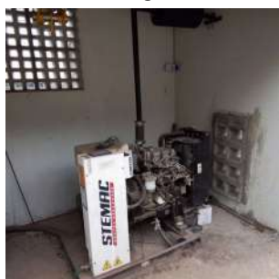
Foto 3 - Vista do gerador de energia elétrica.
