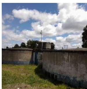
Foto 2 - Tubulação de ventilação sem tela de proteção.
