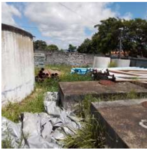
Foto 2 - Mato no interior da área do reservatório.
