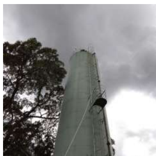
Foto 1 - Guarda-corpo do reservatório.
