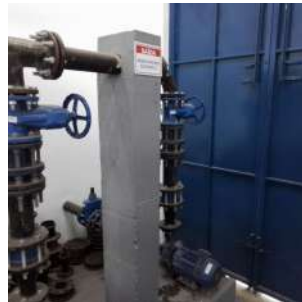
Foto 2 - Vazamento na bomba.
