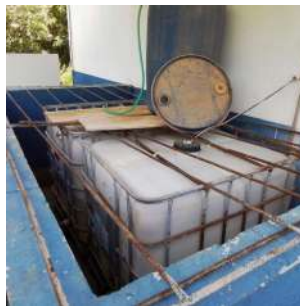
Foto 2 - Armazenamento de produtos químicos.
