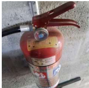
Foto 1 - Selo de validade do extintor.
