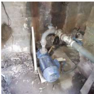
Foto 1 - Conjunto moto bomba da EEAB.
