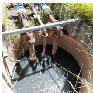
Foto 1 - Poço de sucção com duas bombas instaladas.
