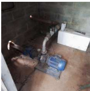
Foto 1 - Conjunto moto bomba da EEA.
