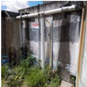
Foto 1 - Medidor de nível do reservatório.
