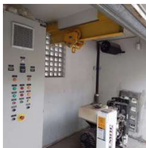
Foto 6 - Painel elétrico da EEEB.
