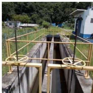
Foto 10 - Caixa de areia do tratamento preliminar.
