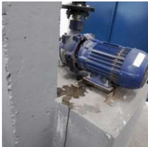
Foto 1 - Vazamento na bomba.
