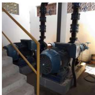
Foto 1 - Conjuntos moto bombas da elevatória nova.
