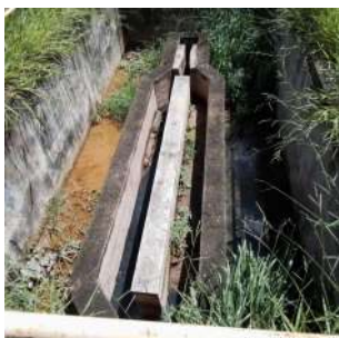
Foto 1 - Caixa de areia com acúmulo de material.
