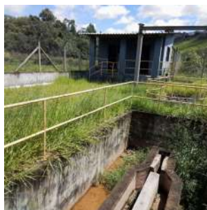
Foto 2 - Mato no interior da EEEB.
