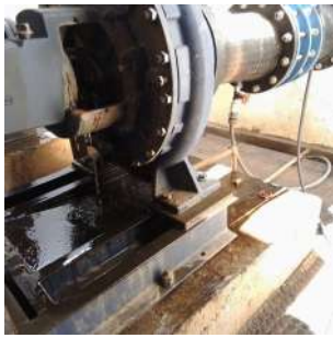
Foto 1 - Drenagem da água de lubrificação de gaxetas.
