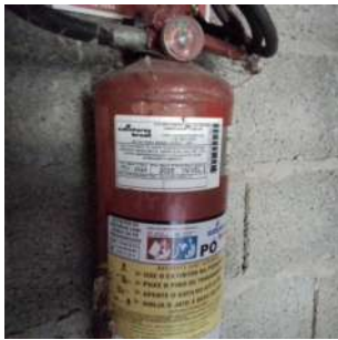
Foto 1 - Validade do extintor de incêndio da EEAB.
