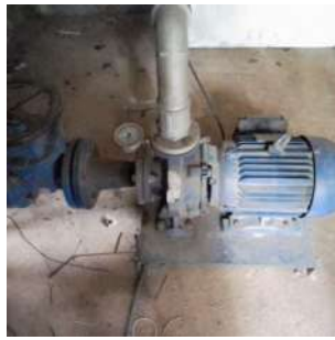
Foto 1 - Bomba com selo mecânico.
