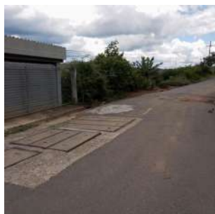
Foto 1 - EEEB embaixo do asfalto.
