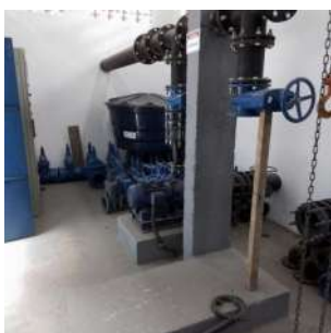
Foto 1 - EEAT Hortênsia sem conjunto moto bomba reserva.
