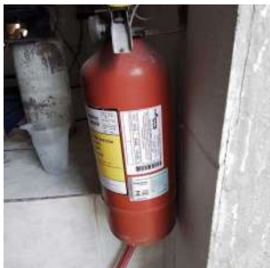
Foto 1 - Validade do extintor da casa de química.
