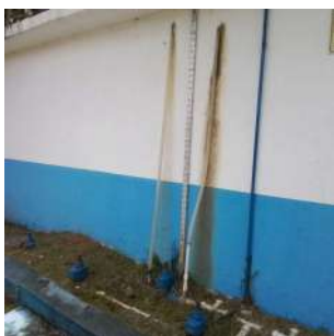
Foto 1 - Medidor de nível do reservatório.
