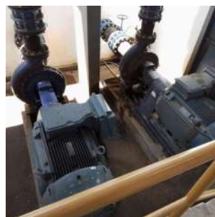
Foto 2 - Conjuntos moto bombas da elevatória nova.
