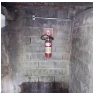
Foto 1 - Extintor de incêndio da EEAB.
