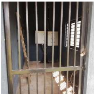
Foto 3 - Vista do painel elétrico da EEEB.
