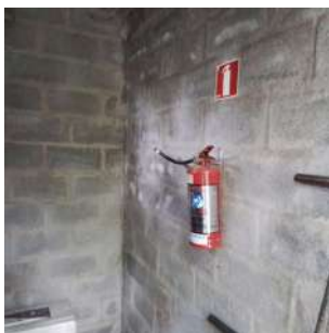
Foto 1 - Extintor de incêndio.
