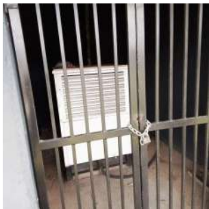
Foto 4 - Vista do gerador elétrico da EEEB.
