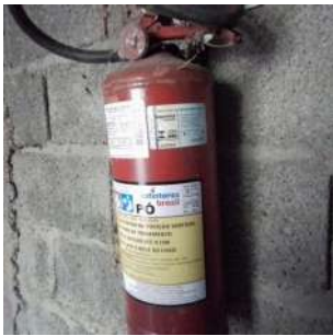
Foto 2 - Validade do extintor de incêndio da EEAB.
