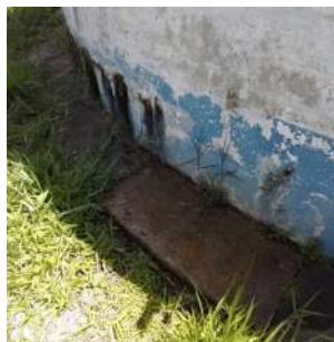
Foto 2 - Vazamento na parede do reservatório. Chão molhado.
