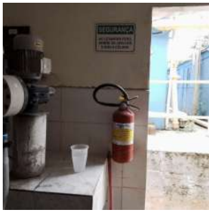
Foto 1 - Extintor de incêndio da casa de química.
