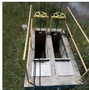
Foto 11 - Gradeamento do tratamento preliminar.
