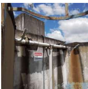
Foto 1 - Extravasor sem tela de proteção.
