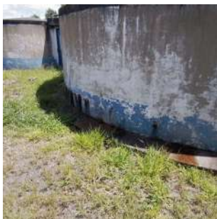
Foto 1 - Vazamento na parede do reservatório, próximo ao chão.
