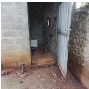
Foto 1 - Acesso à EEA.
