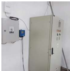
Foto 4 - Pannel elétrico da elevatória nova.
