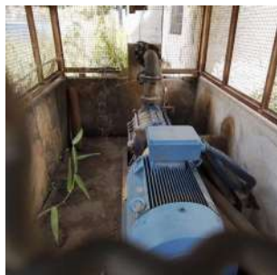
Foto 14 - Bombeamento da EEAB antiga.
