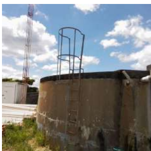
Foto 1 - Guarda-corpo do reservatório.
