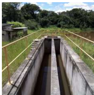
Foto 9 - Caixa de areia do tratamento preliminar.
