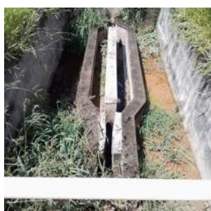
Foto 1 - Vista do tratamento preliminar da EEB.
