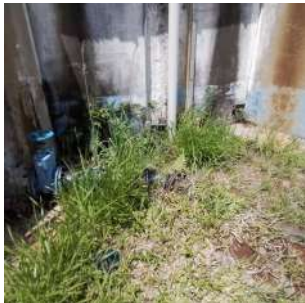
Foto 3 - Mato no interior da área do reservatório.
