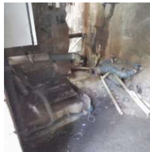
Foto 2 - Local de instalação da moto bomba reserva da EEAB.
