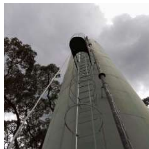
Foto 2 - Mangueira de controle de nível desconectada pelo vento.
