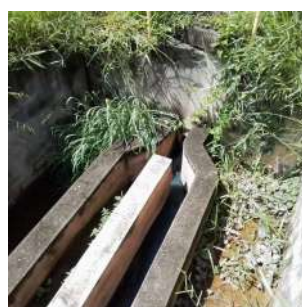
Foto 2 - Vista do tratamento preliminar da EEB.
