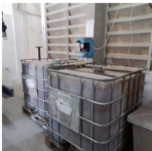
Foto 1 - Dosagem de Flúor da ETA Cerejeiras do Saae Atibaia.
