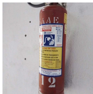
Foto 4 - Extintor de incêndio do booster da ETA Cerejeiras do Saae Atibaia.
