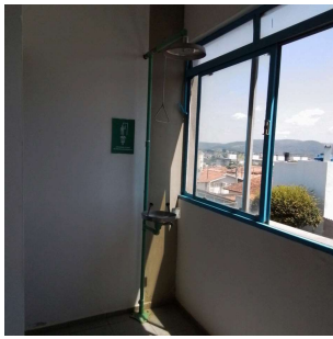
Foto 1 - Chuveiro de emergência da ETA Cerejeiras do Saae Atibaia.
