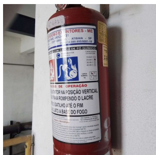
Foto 1 - Extintor de incêndio da elevatória do reservatório da ETA Central do Saae Atibaia.
