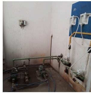
Foto 2 - Cloro gás da ETA Cerejeiras do Saae Atibaia.
