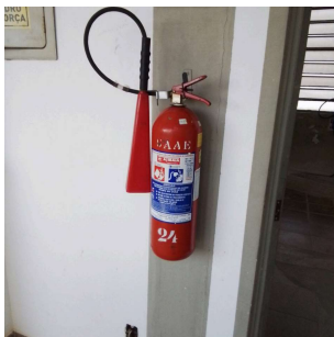
Foto 1 - Extintor de incêndio da ETA Cerejeiras do Saae Atibaia.
