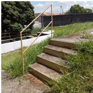
Foto 1 - Guarda-corpo sem fixação adequada da ETA Cerejeiras do Saae Atibaia.
