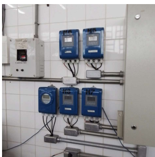
Foto 1 - Macromedidores da ETA Cerejeiras do Saae Atibaia.
