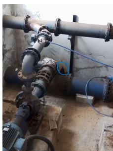
Foto 1 - Drenagem da água de lubrificação de gaxetas das bombas da elevatória do reservatório da ETA Central do Saae Atibaia.
