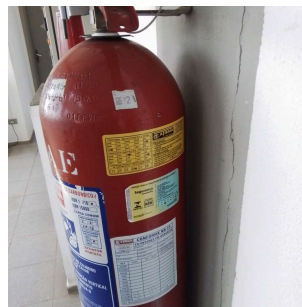
Foto 2 - Extintor de incêndio da ETA Cerejeiras do Saae Atibaia.
