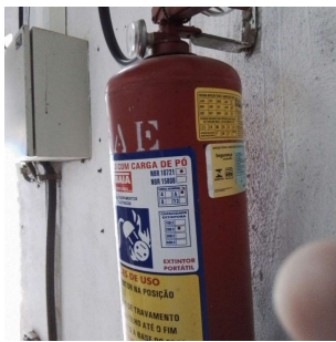
Foto 5 - Extintor de incêndio do booster da ETA Cerejeiras do Saae Atibaia.
