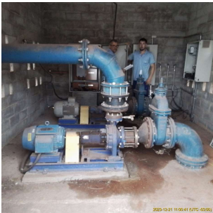
Foto 1 - Vista do booster do Reservatório Alvinópolis do Saae Atibaia.
