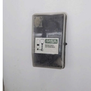
Foto 4 - EPIs do Cloro gás da ETA Cerejeiras do Saae Atibaia.
