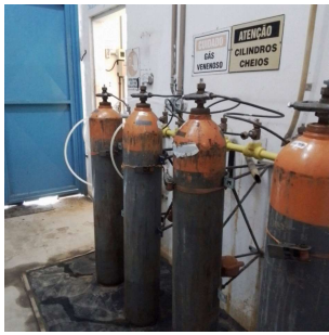
Foto 1 - Cloro gás da ETA Cerejeiras do Saae Atibaia.
