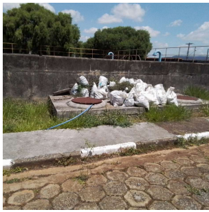
Foto 1 - Materiais estranhos a operação acondicionados externamente do Reservatório apoiado da ETA Cerejeiras do Saae Atibaia.
