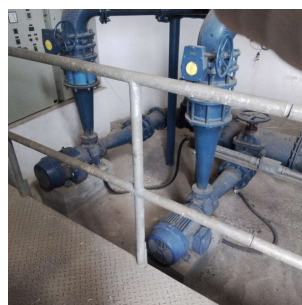
Foto 2 - Vista do booster da ETA Cerejeiras do Saae Atibaia.
