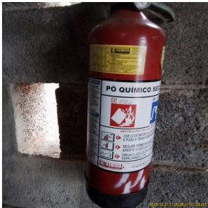
Foto 2 - Extintor de incêndio do do booster do Reservatório Alvinópolis do Saae Atibaia.
