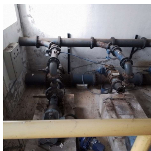
Foto 1 - Vista da elevatória do reservatório da ETA Central do Saae Atibaia.
