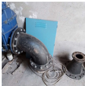
Foto 2 - Materiais estranhos a operação do booster do Reservatório Zona alta do Saae Atibaia.
