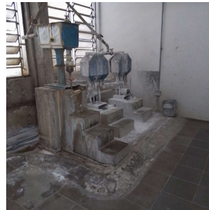
Foto 5 - Dosadoras da ETA Cerejeiras do Saae Atibaia.
