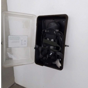
Foto 3 - EPIs do Cloro gás da ETA Cerejeiras do Saae Atibaia.
