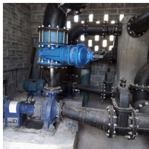
Foto 1 - Vista do booster do Reservatório Zona alta do Saae Atibaia.
