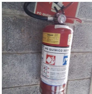
Foto 2 - Extintor de incêndio do booster do Reservatório Zona alta do Saae Atibaia.
