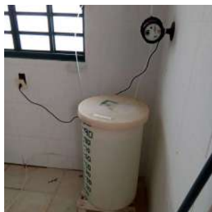
Foto 9 - Tanque de dosagem de Flúor - Poço Juma
