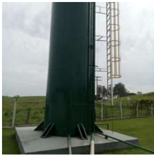
Foto 4 - Reservatório Morada do Sol - nível
