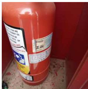
Foto 10 - extintor de incêndio com validade regular
