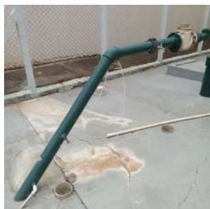
Foto 7 - local de injeção de hipoclorito de sódio e de flúor - Poço Juma
