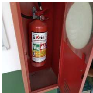
Foto 7 - Extintor de incêndio com validade regular - Poço Campo II
