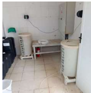
Foto 10 - Soluções de para injeção de flúor e cloro - Poço Baggio
