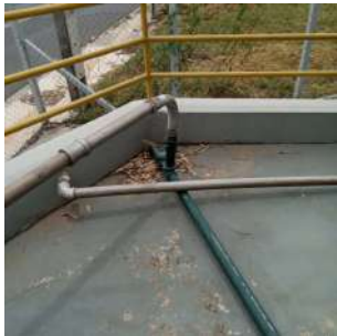
Foto 5 - Registro para amostragem de água da saída do reservatório
