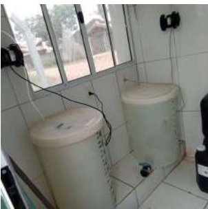
Foto 6 - Dosagem de hipoclorito de sódio e de fluór - casa de química - Poço Villagio Vila Verde
