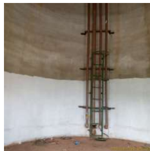
Foto 7 - Tubulações na parte interna - Reservatório Campo
