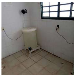
Foto 10 - Tanque de dosagem de hipoclorito de sódio - Poço Juma
