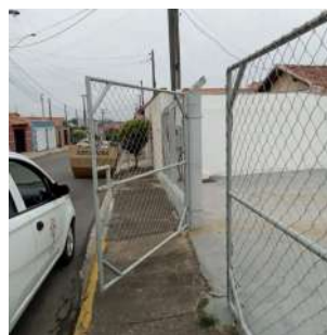
Foto 2 - Portão - Poço Morada do Sol
