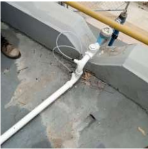
Foto 2 - Local de injeção de hipoclorito de sódio e flúor.
