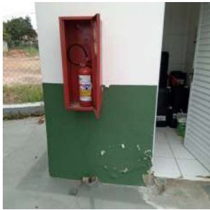
Foto 1 - Localização de extintor de incêndio
