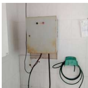
Foto 11 - Pannel de controle do sistema - Poço Juma
