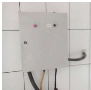
Foto 9 - Painel de comando - Poço Campo II
