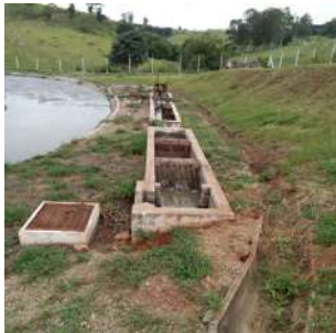
Foto 5 - Chegada do esgoto bruto e peneiramento - ETE Ipiranga
