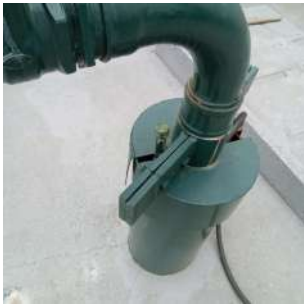
Foto 4 - Tubo de medição de nível - Poço Juma
