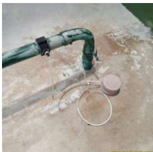
Foto 6 - Injeção de hipoclorito de sódio e de flúor
