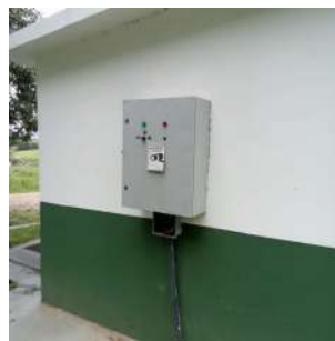
Foto 7 - Painel elétrico do bombeamento da EEEB
