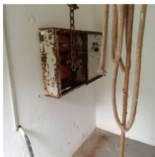
Foto 4 - Painel elétrico desativado EEEB Baggio
