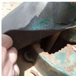
Foto 7 - Evidência de estado avançado de corrosão do metal - Poço Baggio
