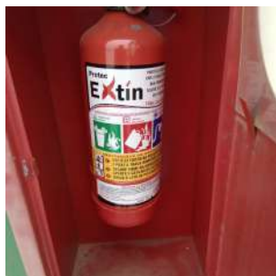
Foto 4 - Extintor de incêndio com validade regular - Poço Morada do Sol
