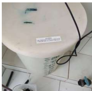
Foto 7 - Tanque com Hipoclorito de Sódio com instruções de mistura
