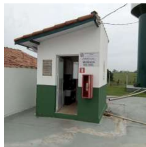
Foto 3 - Casa de Química, localização de extintor, Identificação - Poço Morada do Sol
