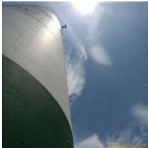
Foto 11 - Nível Mecânico - Reservatório Campo
