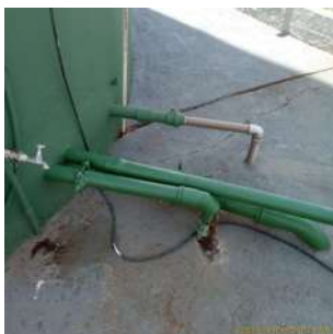
Foto 3 - entrada poço campo 1, poço campo 2 e saída para rede de distribuição
