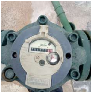
Foto 10 - Macro medidor - Poço Morada do Sol
