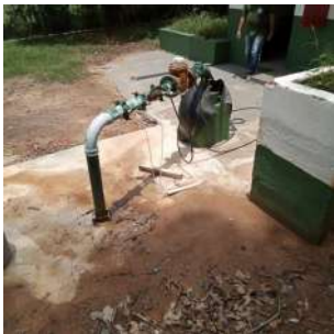
Foto 2 - Local de coleta de água bruta para amostragem, ponto de injeção de produtos químicos e encaminhamento para o reservatório Baggio
