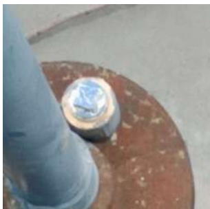
Foto 5 - Tubo de medição de nível
