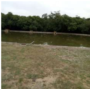
Foto 8 - Lagoa facultativa - entrada e saída ao fundo do esgoto
