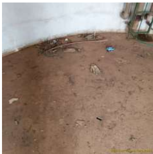
Foto 1 - Vestígios de presença inadequada na instalação - Reservatório Campo
