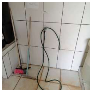
Foto 11 - Ponto de coleta de água tratada para amostragem - Poço Campo II
