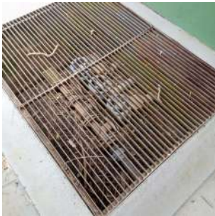
Foto 3 - Tubulação de recalque esgoto EEEB Baggio
