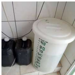
Foto 6 - Detalhe de solução de dosagem de produto químico - Poço Morada do Sol
