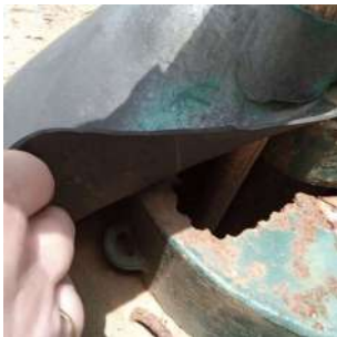
Foto 2 - Revestimento improvisado sobre estrutura de metal corroída (2)
