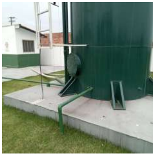
Foto 3 - Reservatório Morada do Sol - saídas de água e entrada
