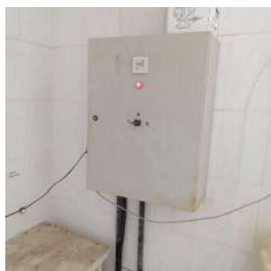
Foto 11 - Painel de controle - Poço Baggio
