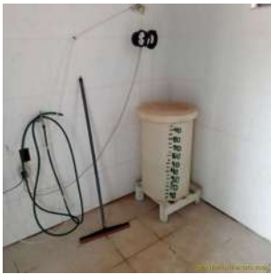
Foto 9 - Tanque de flúor - Poço Campo I
