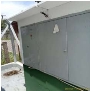
Foto 8 - Quadro de energia
