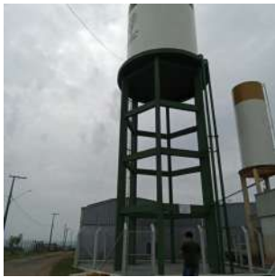
Foto 1 - Reservatório Juma - localização e cercamento
