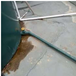
Foto 3 - Chão molhado - pequeno extravasamento
