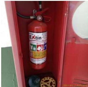
Foto 12 - Extintor de incêndio com validade regular
