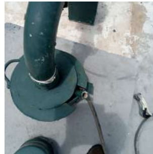
Foto 4 - Tubo de medição de nível - Poço Campo I
