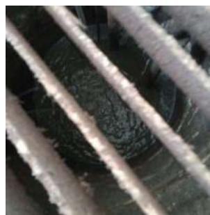
Foto 5 - Chegada de esgoto bruto - ausência de peneiramento
