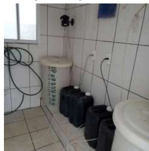
Foto 5 - Produtos químicos - armazenagem e dosagem - Poço Morada do Sol
