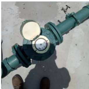
Foto 3 - Macromedidor Poço Campo II
