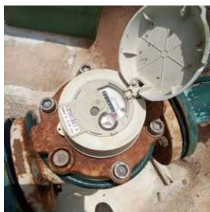
Foto 3 - Macromedidor Poço Baggio
