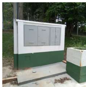
Foto 12 - Quadro de chegada de energia - Poço Baggio
