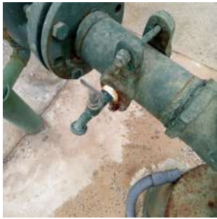
Foto 12 - Ponto de coleta de água bruta para amostragem - Poço Morada do Sol
