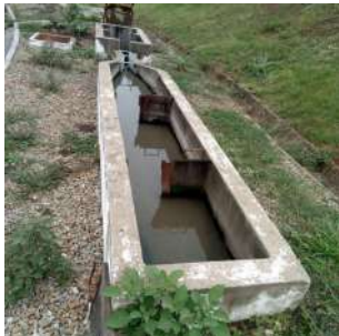
Foto 6 - Desarenador - ETE Ipiranga
