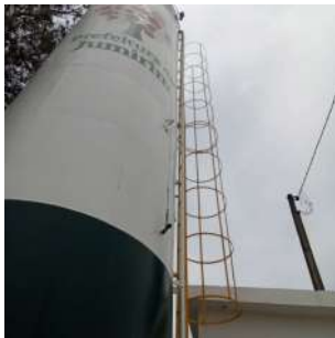
Foto 2 - Escada com guarda corpo e medidor de nível- Reservatório Villagio Verde
