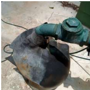
Foto 1 - Revestimento improvisado sobre estrutura de metal corroída
