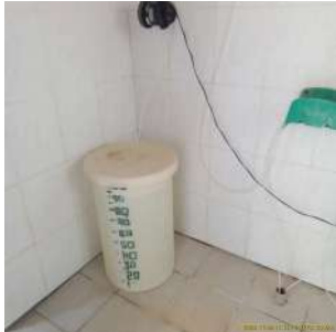
Foto 10 - Tanque de Cloro - Poço Campo I
