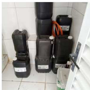
Foto 9 - Acondicionamento de produtos químicos para dosagem na água
