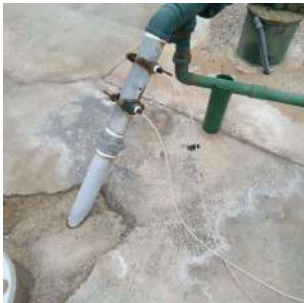
Foto 11 - Ponto de injeção de hipoclorito de sódio e de flúor - Poço Morada do Sol
