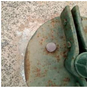
Foto 9 - Tubo medidor de nível - Poço Morada do Sol
