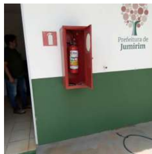
Foto 8 - Extintor de incêndio com validade regular - Poço Baggio
