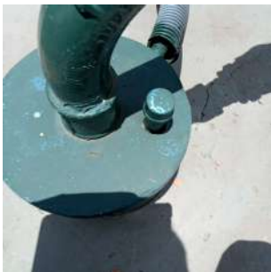
Foto 4 - Tubo de medição de nível - Poço Campo II
