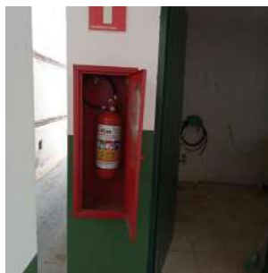
Foto 8 - Extintor de incêndio com validade regular - Poço Juma
