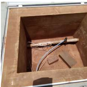
Foto 6 - Local de injeção de hipoclorito de sódio de de flúor - Poço Campo II
