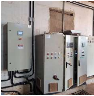
Foto 8 - Painele elétricos e de acionamento da EEAT 1.
