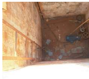
Foto 2 - Ausência de guarda-corpo na escada marinho.
