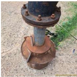
Foto 1 - Tubo medidor de nível sem tampa.
