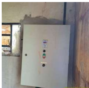
Foto 3 - Painel elétrico da EEAT.
