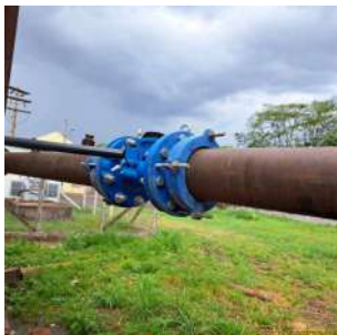
Foto 1 - Macromedidor do poço.
