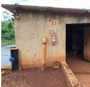
Foto 1 - Localização do extintor de incêndio externo da EEAT.
