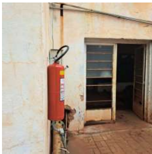
Foto 1 - Extintor de incêndio externo da EEAT.
