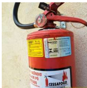
Foto 2 - Validade do extintor vigente.
