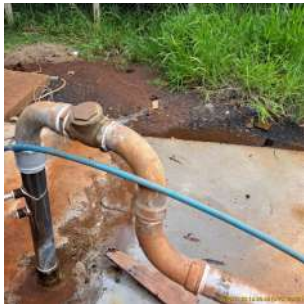
Foto 1 - Vazamento intenso no cavalete do poço.
