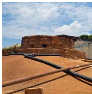
Foto 2 - Ausência de tela de proteção nas aberturas da estrutura de alvenaria da cobertura do reservatório.
