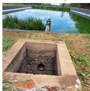
Foto 17 - Caixa inicial de distribuição de vazão do esgoto na lagoa 1 (anaeróbia) da segunda sequência de lagoas. Destaque para ausência de esgoto, indicando que a lagoa não está em operação.
