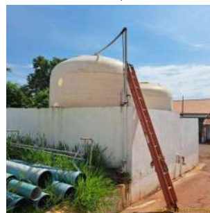
Foto 4 - Ausência de identificação adequada do produto químico nos tanques ao lado do reservatório do sistema de combate a incêndios.
