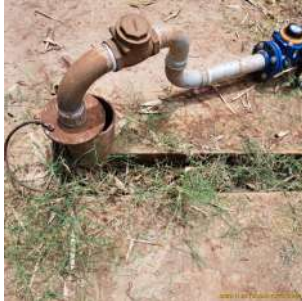
Foto 1 - Valeta na laje de proteção.
