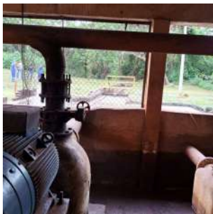
Foto 9 - Vista interna da elevatória.
