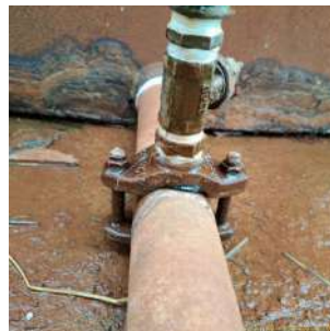
Foto 2 - Vazamento no registro do reservatório.
