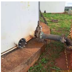
Foto 1 - Vazamento no registro de saída do reservatório.
