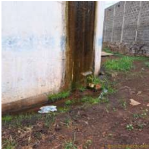
Foto 4 - Vista geral do reservatório apoiado, com detalhe para vazamentos na lateral.
