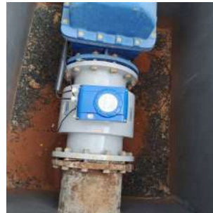
Foto 4 - Vista interna de uma das caixas de macromedição da saída do reservatório para a rede.
