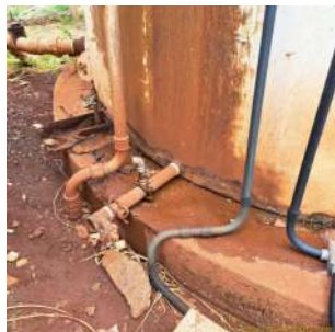
Foto 1 - Detalhe dos vazamentos na base do reservatório.
