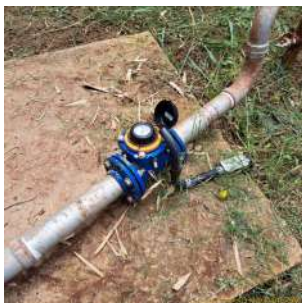
Foto 1 - Macromedidor no cavalete do poço.
