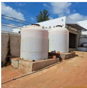
Foto 3 - Ausência de bacia de contenção do tanque de sulfato ferroso. Ausência de identificação adequada do produto químico.
