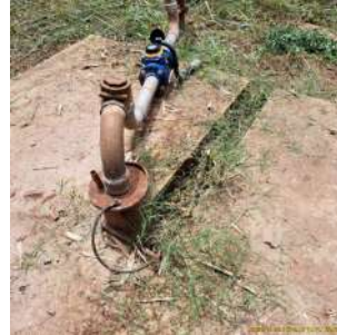
Foto 2 - Valeta na laje de proteção.
