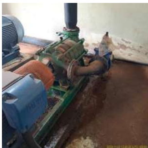
Foto 3 - Piso molhado devido à drenagem inadequada.
