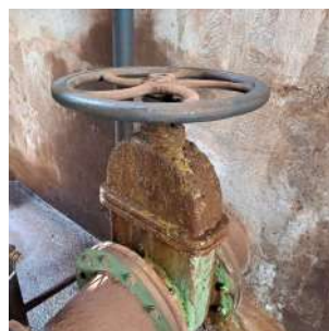
Foto 2 - Detalhe do vazamento no registro de um dos conjuntos motobomba.
