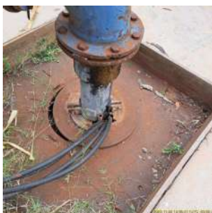
Foto 1 - Tubo medidor de nível sem tampa.
