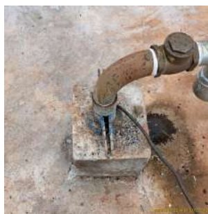
Foto 2 - Ausência de tubo medidor de nível.
