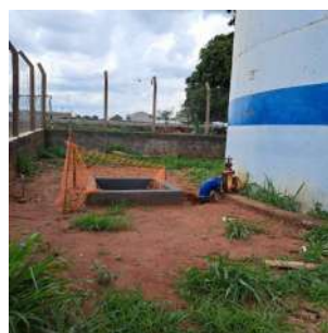
Foto 2 - Vista do poço do macromedidor de saída do reservatório.
