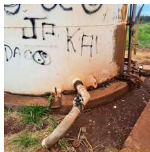
Foto 4 - Base do reservatório com oxidação e corrosão.
