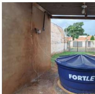
Foto 1 - Tanque de hipoclorito e bomba dosadora.
