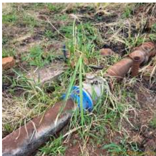
Foto 1 - Local de instalação do macromedidor na tubulação de saída do poço.
