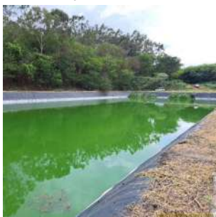
Foto 22 - Vista da lagoa 1 (anaeróbia) da segunda sequência de lagoas, com nível abaixo do operacional.
