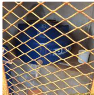
Foto 2 - Ausência de bacia de contenção para o tanque de hipoclorito.
