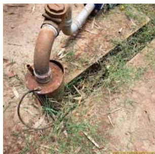
Foto 1 - Tubo medidor de nível sem tampa.
