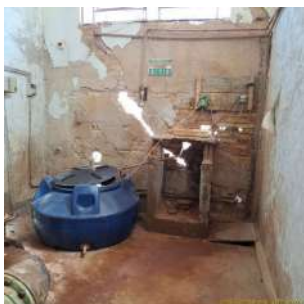
Foto 18 - Tanque de hipoclorito e bomba dosadora.
