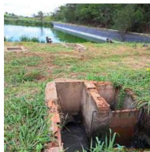
Foto 9 - Ausência de tampa ou proteção antiqueda na caixa de chegada do esgoto bruto oriundo da EEE, onde é direcionado o esgoto para a primeira ou segunda sequência de lagoas.
