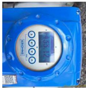
Foto 4 - Macromedidor de saída da EEAB.
