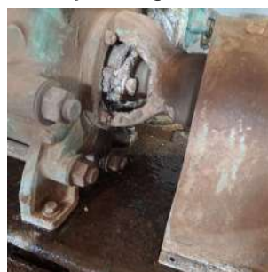
Foto 4 - Detalhe da drenagem inadequada da água de lubrificação das gaxetas do conjunto central.
