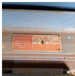
Foto 2 - Placa de especificações técnicas do motor do primeiro conjunto motobomba novo da EEAT 6.
