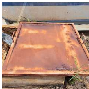
Foto 1 - Esta de oxidação e corrosão em uma das tampas de inspeção na cobertura do reservatório.
