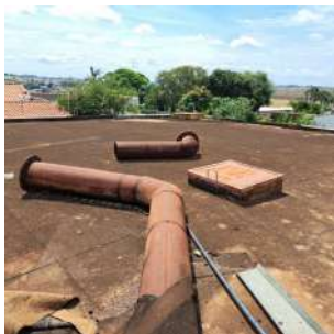
Foto 7 - Vista da cobertura do reservatório, com algumas tubulações espalhadas no local.
