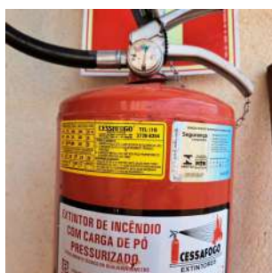
Foto 1 - Validade do extintor de incêndio.
