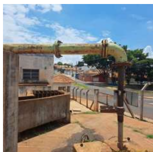
Foto 1 - Ponto de tomada de água bruta.
