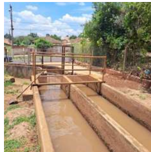
Foto 9 - Caixa desarenadora e gradeamento grosso já na área da EEAB.
