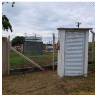
Foto 4 - Vista geral da área do poço P6 e do abrigo do painel elétrico.
