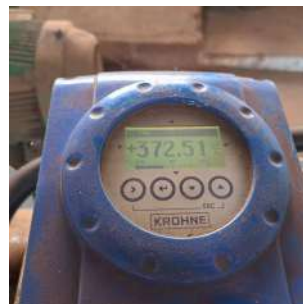
Foto 11 - Macromedidor de saída da EEAT.
