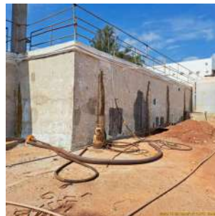
Foto 17 - Vazamentos na lateral de módulos de decantação da ETA. No momento da fiscalização diversos pontos estavam em processo de reforma e reabilitação para adequação dos vazamentos.
