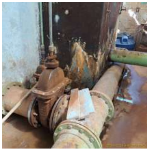
Foto 3 - Piso molhado devido a vazamento em registro próximo ao tanque de hipoclorito.
