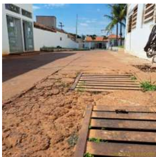
Foto 1 - Local de lançamento do lodo gerado na ETA na rede que destina à rede pública coletora de águas pluviais.
