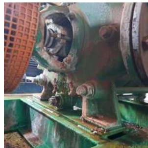
Foto 2 - Detalhe da drenagem inadequada da água de lubrificação de gaxetas.
