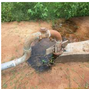
Foto 5 - Detalhe para vazamento no poço.
