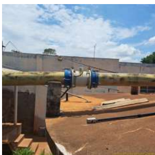
Foto 1 - Macromedidor no cavalete do poço.
