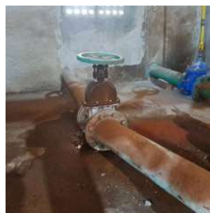
Foto 2 - Detalhe do vazamento em um dos registros da tubulação de entrada da EEAT 1.
