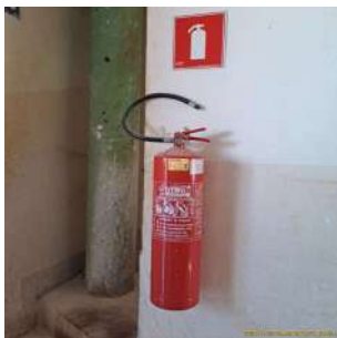
Foto 3 - Extintor de incêndio no interior da ETA.
