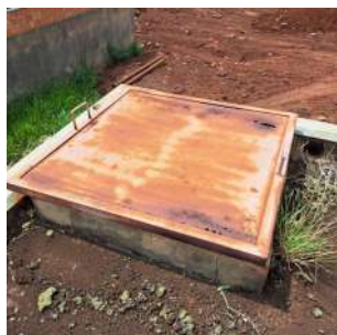
Foto 3 - Esta de oxidação e corrosão em uma das tampas de inspeção na cobertura do reservatório.
