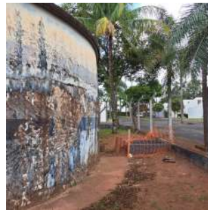
Foto 2 - Ausência de tampa na segunda caixa do macromedidor da tubulação de saída do reservatório.
