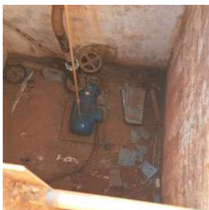
Foto 4 - Vista interna do poço da EEAT 4, com um conjunto motobomba.
