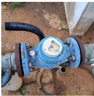
Foto 1 - Macromedidor no cavalete do poço.
