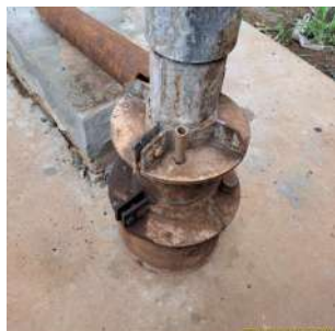
Foto 1 - Tubo medidor de nível sem tampa.
