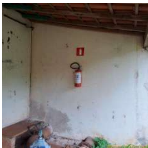
Foto 1 - Extintor de incêndio.
