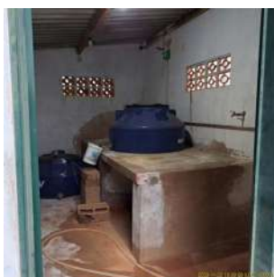
Foto 1 - Ausência de bacia de retenção para produtos químicos (hipoclorito).
