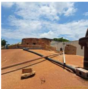
Foto 1 - Ausência de tela de proteção nas aberturas da estrutura de alvenaria da cobertura do reservatório.
