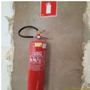
Foto 1 - Extintor de incêndio no interior da ETA.
