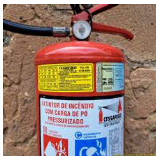
Foto 1 - Validade do extintor vigente.
