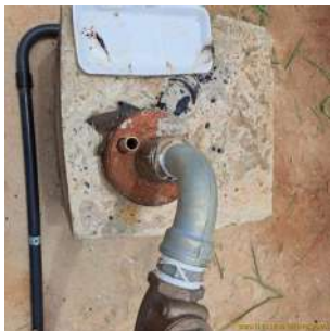
Foto 1 - Tubo medidor de nível sem tampa.
