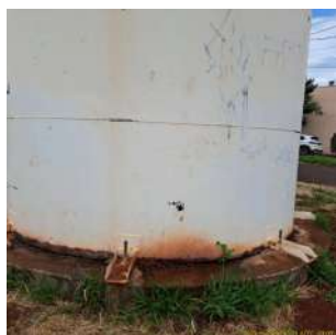
Foto 1 - Base do reservatório com oxidação e corrosão.
