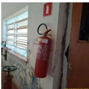
Foto 5 - Extintor de incêndio no interior da ETA.
