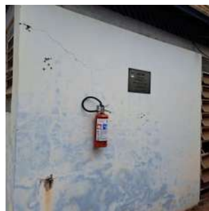
Foto 7 - Extintor de incêndio fora da EEAT 3.
