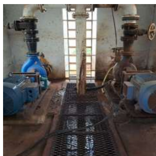
Foto 1 - Conjuntos motobomba da EEAT 3 (1+1R).
