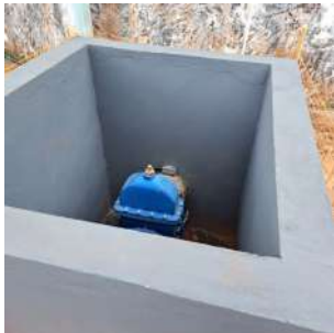
Foto 3 - Vista interna de uma das caixas de macromedição da saída do reservatório para a rede.
