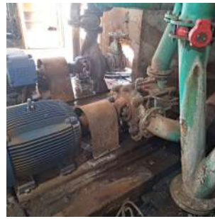
Foto 4 - Vazamento em um dos registros do conjunto motobomba central.
