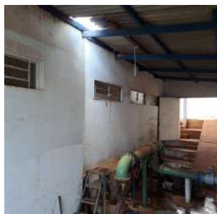
Foto 1 - Telhado da EEAT com abertura.
