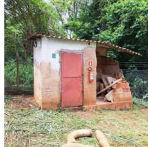
Foto 7 - Abrigo do painel elétrico.
