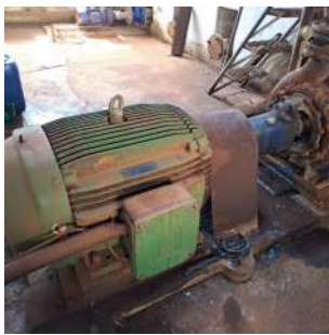
Foto 12 - Segundo conjunto motobomba.
