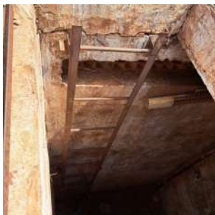
Foto 1 - Ausência de guarda-corpo na escada marinho.
