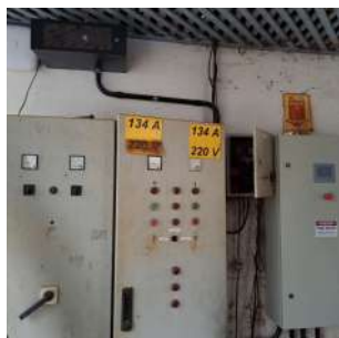
Foto 6 - Pannel elétrico da EEAT 3.
