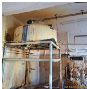
Foto 4 - Sala de preparo de produtos químicos.
