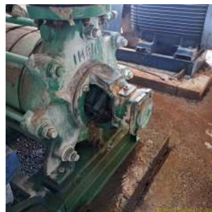
Foto 4 - Detalhe da drenagem inadequada da água de lubrificação de gaxetas na parte posterior co equipamento.
