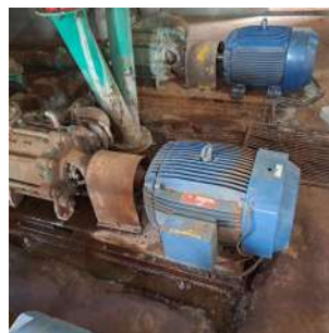
Foto 4 - Conjunto motobomba central (reserva).
