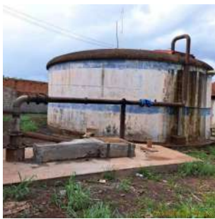
Foto 3 - Vista do poço e do reservatório apoiado R24 ao lado.
