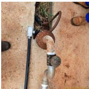
Foto 1 - Ausência de tubo medidor de nível.
