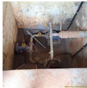
Foto 2 - Ausência de guarda-corpos na EEAT.
