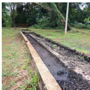
Foto 5 - Caixas desarenadora (tratamento preliminar) da elevatória. Porém não está sendo adequadamente operada.
