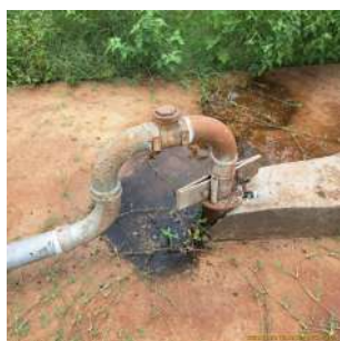
Foto 1 - Detalhe do vazamento na tubulação do poço.
