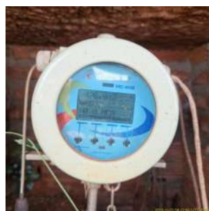
Foto 2 - Macromedidor de saída do tratamento para o CR ETA.
