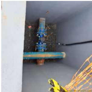
Foto 7 - Macromedidor de saída do reservatório.
