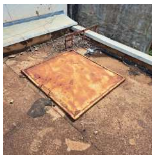
Foto 2 - Esta de oxidação e corrosão em uma das tampas de inspeção na cobertura do reservatório.
