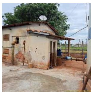
Foto 8 - Antiga EEAT 6, que será desativada.
