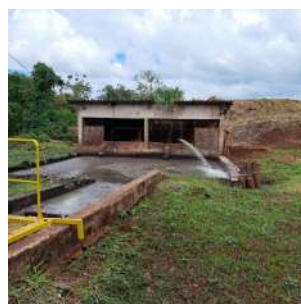
Foto 4 - Chegada do esgoto bruto na elevatória, passando pela caixa desarenadora.
