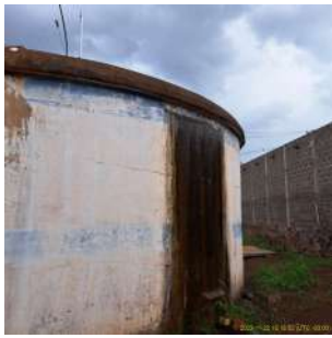
Foto 1 - Vazamentos na lateral do reservatório.
