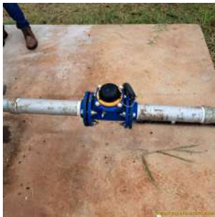
Foto 1 - Macromedidor do poço.
