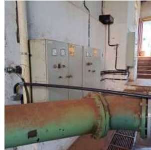
Foto 6 - Painéis elétricos da EEAT.
