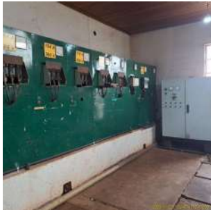
Foto 7 - Painéis elétricos da EEAB.
