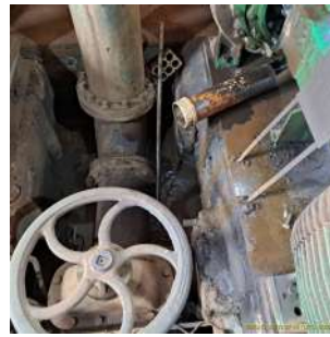
Foto 4 - Drenagem inadequada da água de lubrificação das gaxetas.
