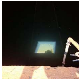
Foto 6 - Vista interna do reservatório, com detalhe para presença de material na água tratada.
