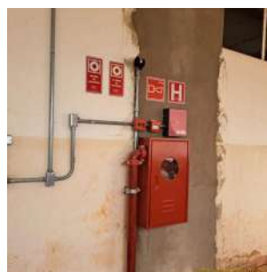
Foto 2 - Alarmes e abrigo de mangueira de incêndio dentro da ETA.
