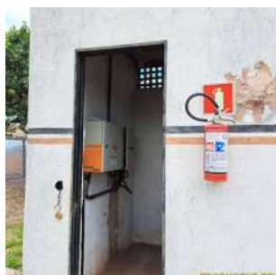
Foto 5 - Painel elétrico e de acionamento da bomba.
