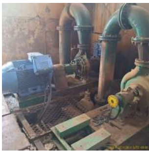
Foto 5 - Segundo conjunto motobomba.
