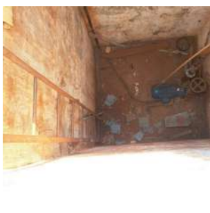
Foto 7 - Vista interna do poço da EEAT 4, com um conjunto motobomba.
