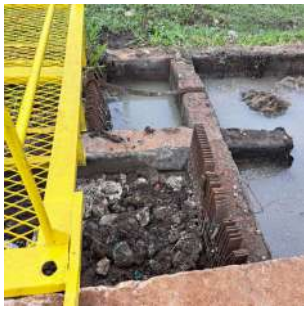
Foto 1 - Acúmulo de material no gradeamento de um dos canais da caixa desarenadora.
