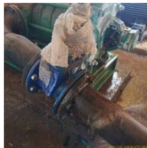
Foto 2 - Detalhe do vazamento no registro da tubulação
