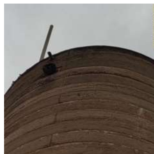
Foto 2 - Detalhe da ausência de tela de proteção.
