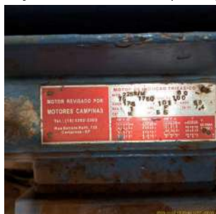
Foto 5 - Placa de identificações técnicas do motor do conjunto motobomba em operação no momento da fiscalização.
