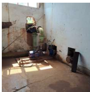
Foto 8 - Conjunto motobomba da EEAT 4 situado na EEAT 5.
