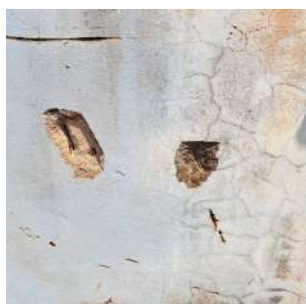
Foto 1 - Exposição da ferragem na lateral do reservatório.
