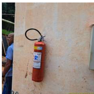
Foto 1 - Extintor de incêndio.
