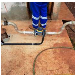
Foto 1 - Macromedidor no cavalete do poço.
