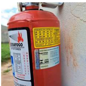
Foto 1 - Validade do extintor de incêndio.
