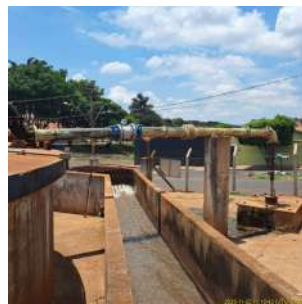
Foto 2 - Poço P1 (direita) e reservatório R23 (esquerda).
