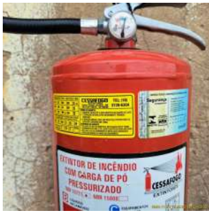
Foto 1 - Validade do extintor de incêndio.
