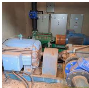
Foto 1 - Vista interna da EEAT 6 e dos conjuntos motobomba principais.
