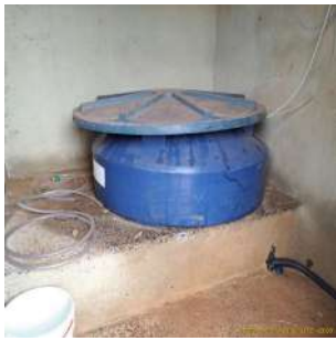
Foto 1 - Ausência de bacia de contenção para o tanque de hipoclorito.
