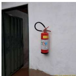
Foto 1 - Extintor de incêndio.
