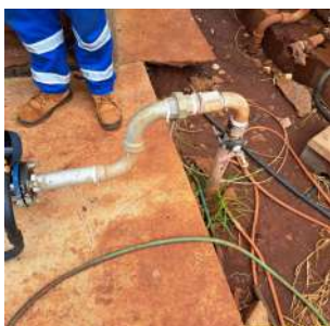
Foto 1 - Ponto de tomada de água bruta.
