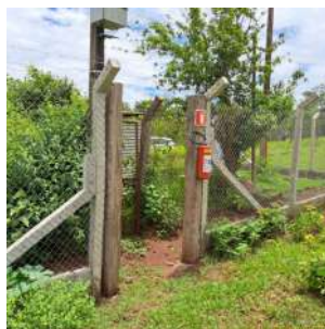
Foto 5 - Vista externa da área do painel elétrico do poço, também sem portão.
