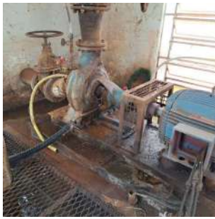
Foto 1 - Detalhe da drenagem inadequada de água de lubrificação de gaxetas.
