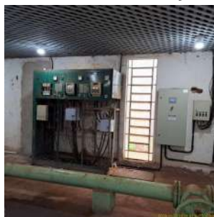
Foto 6 - Vista dos painéis elétricos e de acionamento da EEAT.
