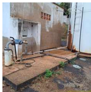
Foto 2 - Vista do poço Timboré e reservatório elevado ao lado.
