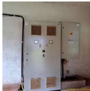
Foto 2 - Painel elétrico do poço.
