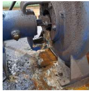
Foto 2 - Detalhe da drenagem inadequada de água de lubrificação de gaxetas
