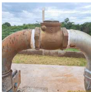
Foto 2 - Detalhe do local do vazamento.
