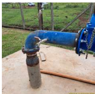
Foto 1 - Ponto de tomada de água bruta.
