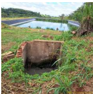
Foto 8 - Ausência de tampa ou proteção antiqueda na caixa de chegada do esgoto bruto oriundo da EEE.
