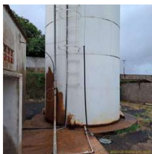
Foto 1 - Marcas de oxidação na base do reservatório.
