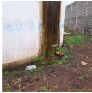
Foto 2 - Vazamentos na lateral do reservatório.
