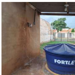
Foto 1 - Tanque de armazenamento do hipoclorito de sódio sem bacia de contenção de vazamentos.
