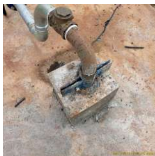
Foto 1 - Ausência de tubo medidor de nível.
