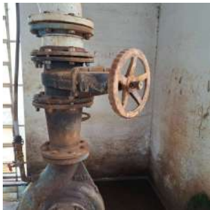
Foto 1 - Vazamento no registro da tubulação do primeiro conjunto motobomba.
