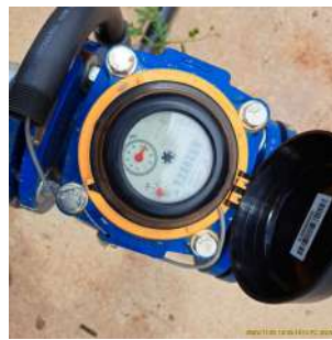
Foto 2 - Macromedidor no cavalete do poço.
