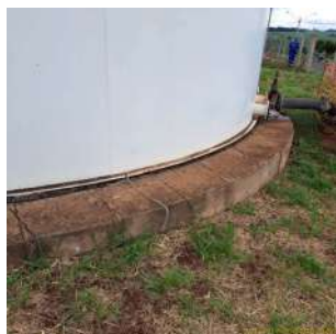
Foto 1 - Aterramento da estrutura metálica do reservatório.
