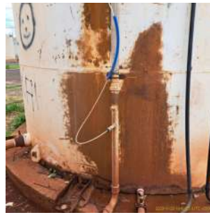
Foto 2 - Pontos de dosagem de hipoclorito na tubulação de subida do reservatório.
