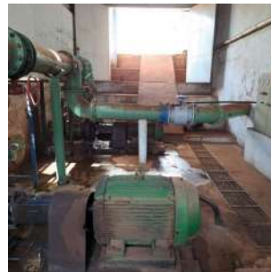
Foto 9 - Vista interna da EEAT.
