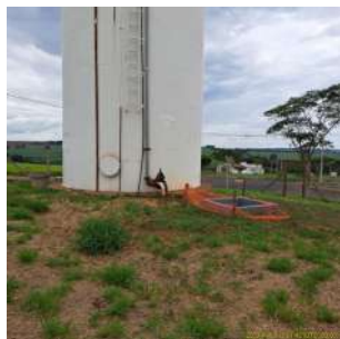
Foto 1 - Ausência de tampa ou proteção antiqueda no poço do macromedidor.
