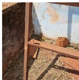
Foto 2 - Detalhe de um dos pontos com corrosão na escada.
