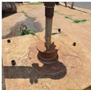
Foto 1 - Tubo medidor de nível sem tampa.
