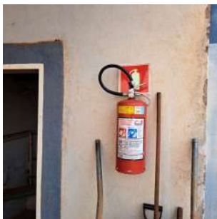
Foto 1 - Extintor de incêndio externo à EEAT.
