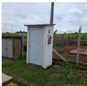
Foto 3 - Abrigo do painel elétrico do poço P11
