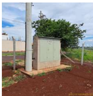
Foto 2 - Abrigo do painel elétrico.
