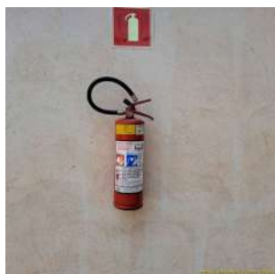
Foto 1 - Extintor de incêndio.
