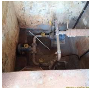
Foto 2 - Vista interna da EEAT 8.
