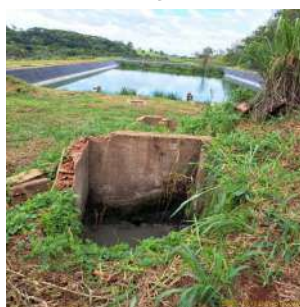
Foto 13 - Caixa de chegada do esgoto bruto oriundo da EEE e, ao fundo, lagoa anaeróbia da primeira sequência.
