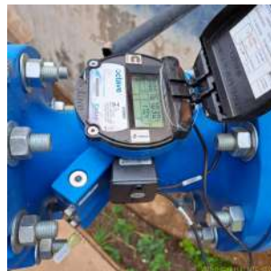
Foto 2 - Macromedidor do poço.
