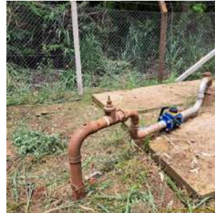
Foto 4 - Cavalete do poço.
