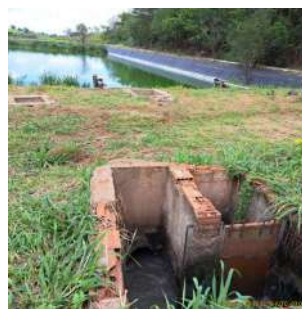
Foto 14 - Caixa de chegada do esgoto bruto oriundo da EEE e, ao fundo, lagoa anaeróbia da segunda sequência de lagoas (com impermeabilização). Na caixa há estrutura para direcionar o esgoto para a primeira ou segunda sequência de lagoas.
