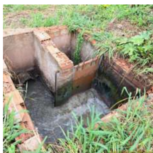
Foto 15 - Caixa de chegada do esgoto bruto oriundo da EEE e, ao fundo, lagoa anaeróbia da segunda sequência de lagoas (com impermeabilização). Na caixa há estrutura para direcionar o esgoto para a primeira ou segunda sequência de lagoas.
