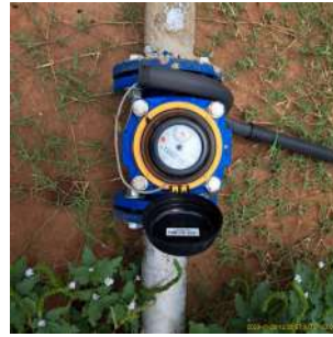
Foto 2 - Macromedidor no cavalete do poço.
