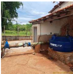
Foto 4 - Tanque de armazenamento de hipoclorito ao lado do reservatório.
