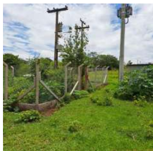
Foto 4 - Vista externa da área do painel elétrico do poço, também sem portão.
