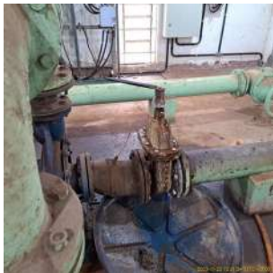
Foto 1 - Há vazamentos no registro da tubulação do conjunto motobomba em operação no momento da fiscalização.
