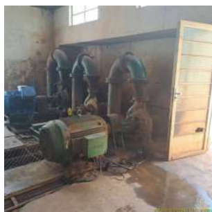
Foto 1 - Conjuntos motobomba da EEAB (1+1R).
