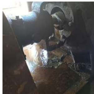
Foto 2 - Detalhe da drenagem inadequada da água de lubrificação das gaxetas do conjunto 1.
