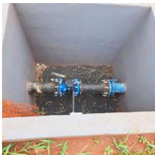
Foto 8 - Macromedidor de saída do reservatório.
