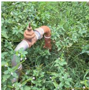
Foto 1 - Ponto de tomada de água bruta.
