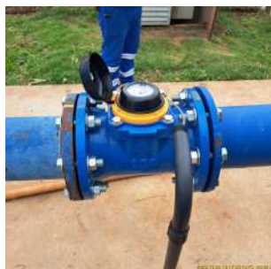
Foto 1 - Macromedidor do poço.
