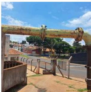
Foto 1 - Vazamento na junção da tubulação de saída do poço para o reservatório.
