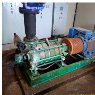
Foto 3 - Segundo conjunto motobomba da EEAT 6 nova.
