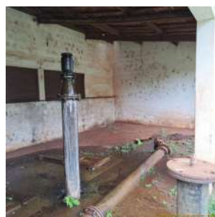
Foto 2 - Vazamento na estrutura vertical ("ventosa") da adutora de recalque para o R6.
