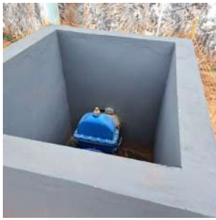
Foto 1 - Ausência de tampa em uma das caixas de macromedicação da tubulação de saída do reservatório.
