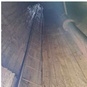
Foto 1 - Ausência de guarda-corpos na escada do reservatório.
