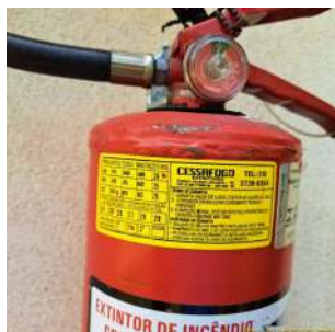
Foto 3 - Validade do extintor vigente.
