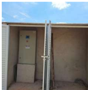
Foto 2 - Abrigo do painel elétrico da EEAT 4.
