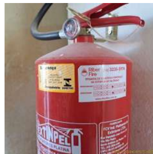
Foto 4 - Validade do extintor de incêndio regular.
