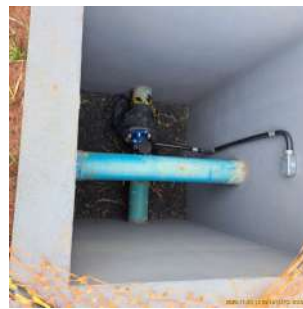
Foto 4 - Macromedidor de saída do reservatório.
