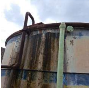
Foto 7 - Vista geral do reservatório apoiado, com detalhe para vazamentos na lateral.
