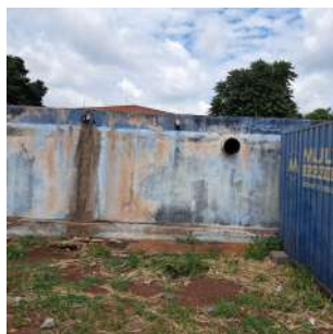
Foto 1 - Ausência de telas nos tubos extravasores.
