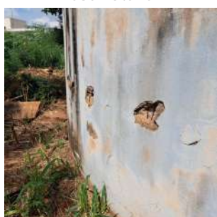
Foto 3 - Exposição da ferragem na lateral do reservatório.
