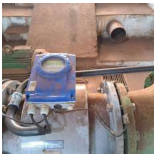
Foto 10 - Macromedidor de saída da EEAT.
