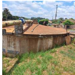
Foto 5 - Tubulação de chegada de água do poço P5.
