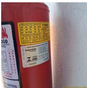
Foto 1 - Validade do extintor de incêndio.
