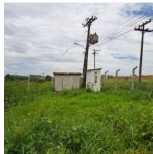
Foto 2 - Vista da instalação elétrica e abrigo do painel.
