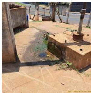
Foto 2 - Piso molhado devido ao vazamento.
