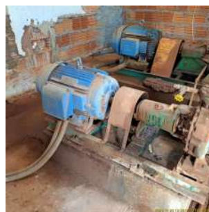
Foto 11 - Conjuntos motobomba antigos.
