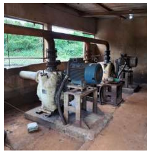
Foto 8 - Vista interna da elevatória, com dois conjuntos (1+1R) motobomba autoescorvantes.
