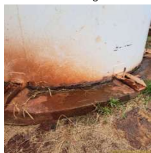
Foto 3 - Detalhe dos vazamentos na base do reservatório.
