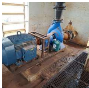
Foto 4 - Segundo conjunto motobomba.
