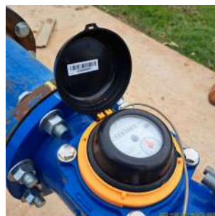
Foto 2 - Macromedidor no cavalete do poço.
