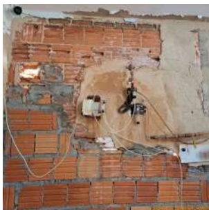
Foto 1 - Bomba dosadora de hipoclorito próxima ao reservatório.
