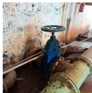
Foto 2 - Detalhe de vazamento em registro pós filtração.
