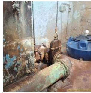
Foto 4 - Detalhe de vazamento em registro próximo ao tanque de hipoclorito.
