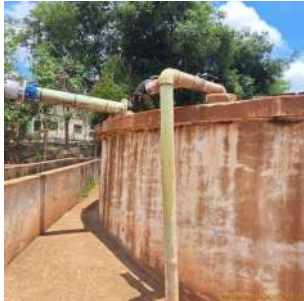
Foto 3 - Tubulações de chegada de água dos poços P1 e da EEAT 4.
