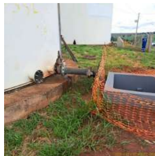
Foto 2 - Vazamento no registro de saída do reservatório.
