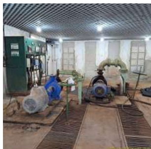
Foto 3 - Vista interna da EEAT, com dois conjuntos motobomba (1+1R).
