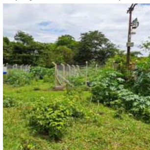
Foto 6 - Área do poço (esquerda) e da instalação elétrica (direita).
