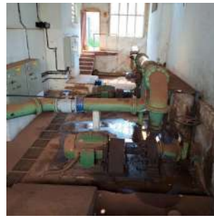
Foto 4 - Vista interna da EEAT.
