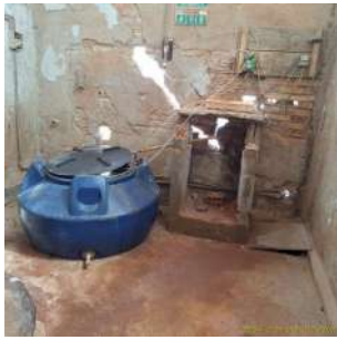
Foto 1 - Ausência de bacia de contenção do tanque de hipoclorito.
