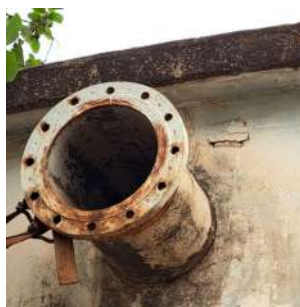
Foto 2 - Ausência de tela de proteção contra entrada de insetos e pequenos animais no tubo extravasor.
