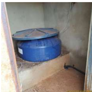
Foto 1 - Tanque de hipoclorito, utilizado para cloração da água bruta.
