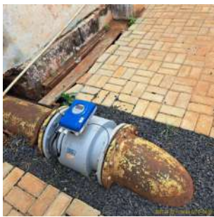
Foto 3 - Macromedidor de saída da EEAB.
