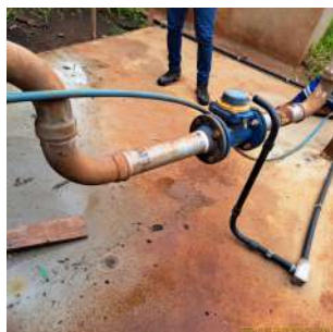
Foto 1 - Macromedidor no cavalete do poço.
