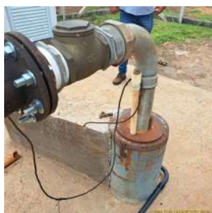
Foto 1 - Tubo medidor de nível com tampa.
