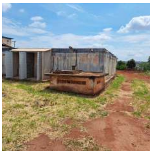
Foto 1 - Vista externa do poço da EEAT ao lado do reservatório R7.
