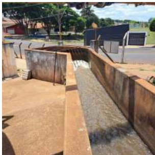
Foto 10 - Canal de direcionamento da água (pós-tratamento preliminar) para tanque de equalização.
