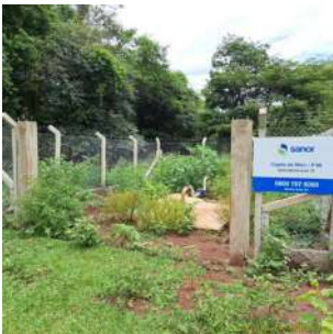
Foto 1 - Identificação da área. Detalhe para ausência de portão, possibilitando o acesso ao
