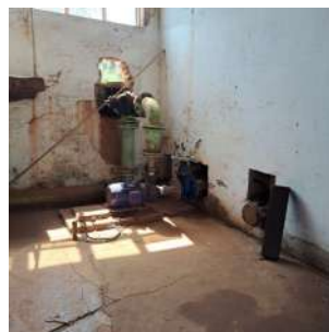
Foto 2 - Abertura na parede lateral da EEAT 5.
