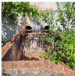
Foto 2 - Ausência de tela de proteção.
