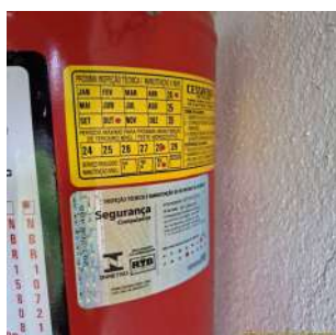
Foto 1 - Validade do extintor vigente.
