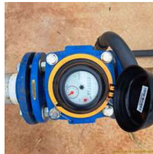
Foto 2 - Macromedidor do poço.
