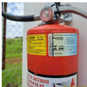
Foto 1 - Validade do extintor de incêndio.
