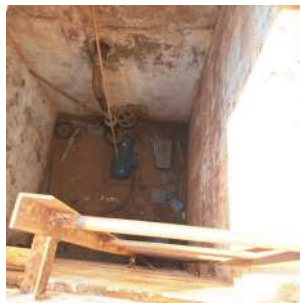
Foto 3 - Vista interna do poço da EEAT 4, com um conjunto motobomba.
