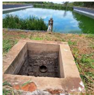
Foto 7 - Ausência de tampa ou proteção antiqueda na caixa de chegada do esgoto bruto oriundo da EEE.
