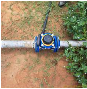
Foto 1 - Macromedidor no cavalete do poço.
