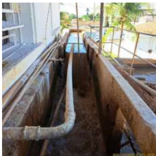
Foto 5 - Chegada de água bruta na ETA.
