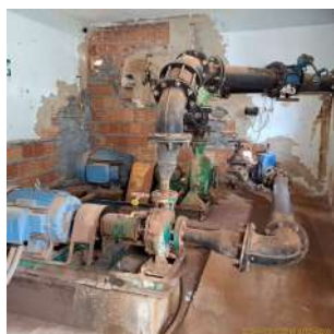
Foto 10 - Conjuntos motobomba antigos.
