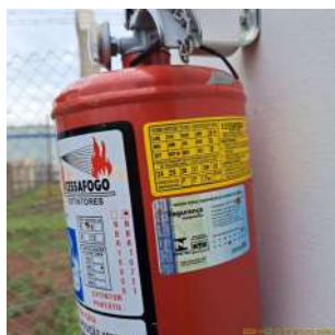
Foto 1 - Validade do extintor vigente.
