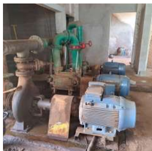
Foto 1 - Vista dos 3 conjuntos motobomba.
