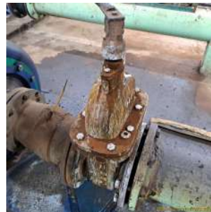
Foto 2 - Detalhe do vazamento no registro da tubulação do conjunto motobomba em operação no momento da fiscalização.
