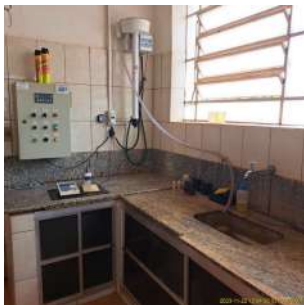
Foto 1 - Situação do laboratório da ETA.
