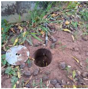
Foto 1 - Aterramento do SPDA.
