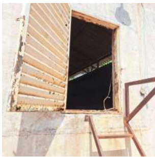
Foto 1 - Tampa de inspeção com sinais de oxidação e corrosão.
