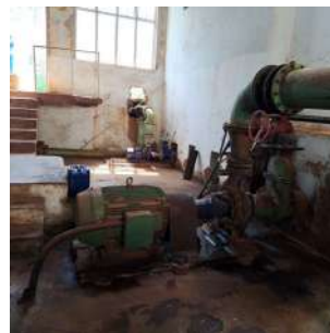
Foto 7 - Segundo conjunto motobomba e, ao fundo, conjunto motobomba da EEAT 4.
