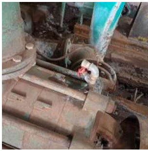
Foto 3 - Vazamento em um dos registros do conjunto motobomba central.
