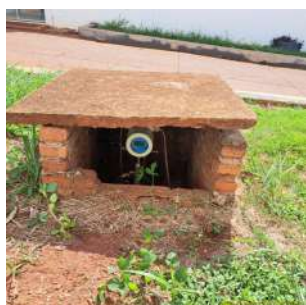
Foto 1 - Macromedidor de saída do tratamento para o CR ETA.
