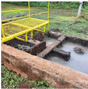
Foto 1 - Local do gradeamento, porém sem estar operando adequadamente.
