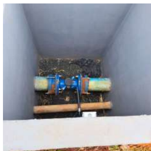
Foto 3 - Macromedidor de saída do reservatório.
