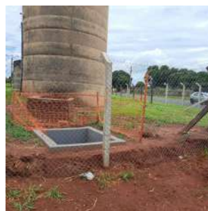
Foto 3 - Vista do reservatório e do poço do macromedidor (sem tampa ou proteção antiqueda)
