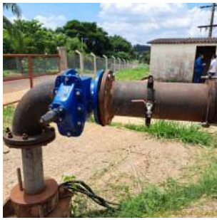
Foto 1 - Tomada de água bruta.
