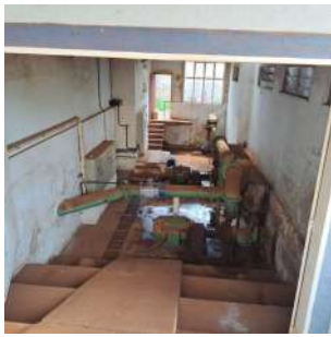
Foto 3 - Vista interna da EEAT.
