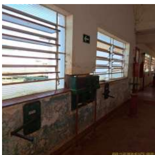
Foto 11 - Controles hidráulicos manuais de operação da ETA.
