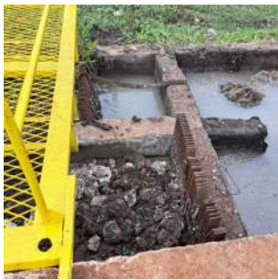
Foto 2 - Material acumulado em uma das caixas desarenadoras.
