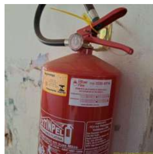
Foto 6 - Validade do extintor de incêndio regular.
