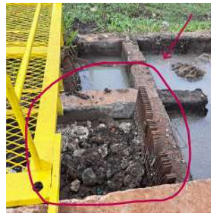
Foto 2 - Destaque do acúmulo de material no gradeamento de um dos canais da caixa desarenadora.
