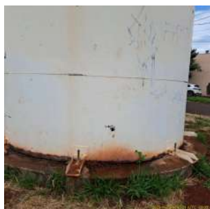
Foto 3 - Base do reservatório com oxidação e corrosão.
