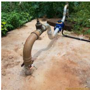
Foto 1 - Ponto de tomada de água bruta.
