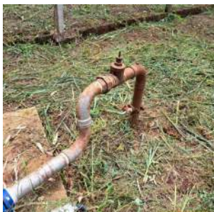
Foto 1 - Ponto para coleta de água bruta.
