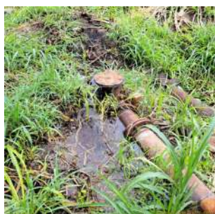
Foto 1 - Vazamento na adutora.
