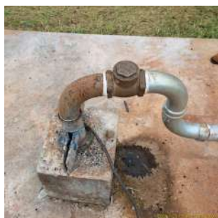
Foto 1 - Vazamento na junção de tubulações no cavalete do poço.
