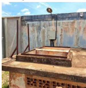
Foto 5 - Tampa do poço da EEAT 4.
