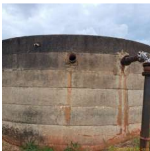
Foto 1 - Ausência de tela de proteção contra entrada de insetos e pequenos animais no tubo extravasor.
