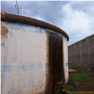
Foto 3 - Vista geral do reservatório apoiado, com detalhe para vazamentos na lateral.
