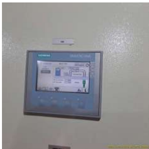
Foto 1 - Painel de visualização do nível do reservatório na EEAT 2.
