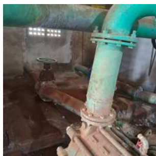
Foto 1 - Vazamento em um dos registros da tubulação de entrada da EEAT 1.
