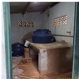
Foto 3 - Vista interna do abrigo do tanque de hipoclorito.
