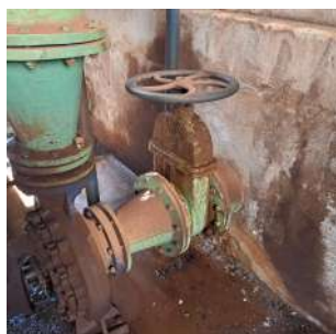
Foto 1 - Vazamento no registro de um dos conjuntos motobomba.
