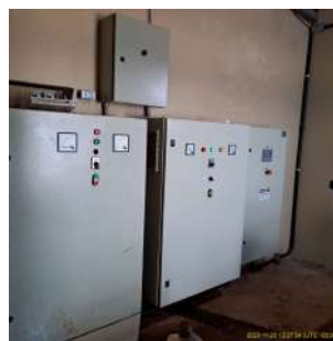
Foto 6 - Vista dos painéis elétricos e de acionamento novos da EEAT.
