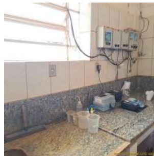
Foto 2 - Situação do laboratório da ETA.
