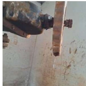
Foto 2 - Detalhe do vazamento no registro da tubulação do primeiro conjunto motobomba.
