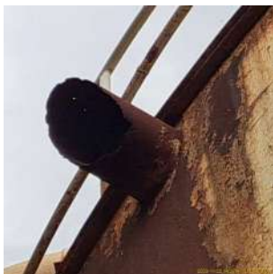
Foto 3 - Detalhe da ausência de tela de proteção contra entrada de insetos e pequenos animais no tubo extravasor.
