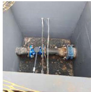
Foto 6 - Vista interna de uma das caixas de macromedição da saída do reservatório para a rede.
