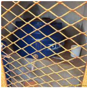
Foto 1 - Tanque de hipoclorito no abrigo ao lado do poço.
