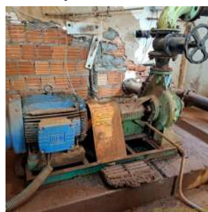
Foto 13 - Segundo conjunto motobomba antigo.
