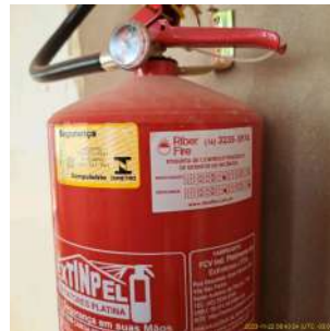
Foto 2 - Validade do extintor de incêndio regular.
