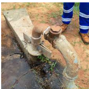
Foto 1 - Tubo medidor de nível sem tampa.
