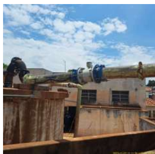
Foto 1 - Macromedidor na tubulação do poço.
