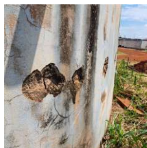
Foto 2 - Exposição da ferragem na lateral do reservatório.
