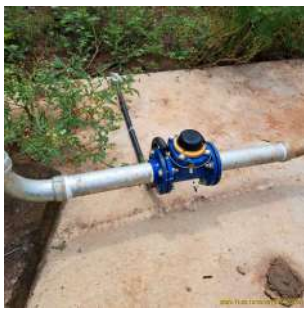
Foto 1 - Macromedidor no cavalete do poço.
