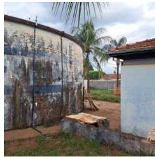
Foto 2 - Escada em situação inadequada, além de não possuir guarda-corpo.
