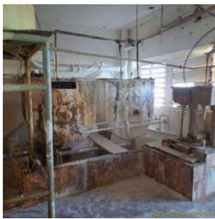
Foto 3 - Sala de preparo de produtos químicos.
