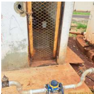
Foto 1 - Porta de acesso ao abrigo em estado avançado de oxidação e corrosão.
