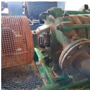
Foto 1 - Detalhe da drenagem inadequada da água de lubrificação de gaxetas.
