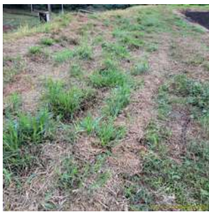
Foto 5 - Margem da lagoa com a chegada das tubulações de esgoto bruto, onde há caixas de tubulação sem tampa.
