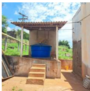
Foto 12 - Tanque de armazenamento do hipoclorito para pré-cloração da água bruta.
