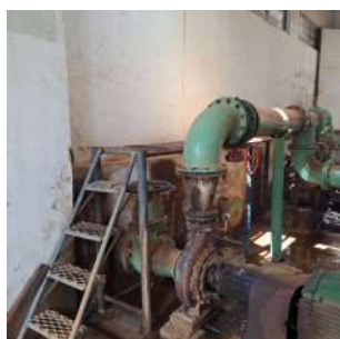
Foto 1 - Vista interna da EEAT 5, com tubulações ao lado do reservatório.
