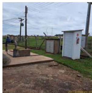
Foto 2 - Vista geral da área do poço P11 e do abrigo do painel elétrico.
