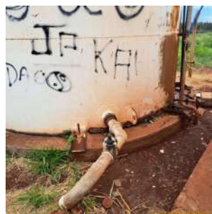
Foto 2 - Base do reservatório com oxidação e corrosão.
