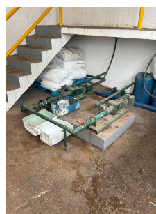
Foto 2 - Vazamento aparente nas bombas
