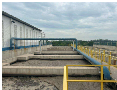
Foto 18 - Tanques de aeração
