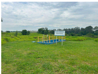
Foto 25 - Saída de efluente
