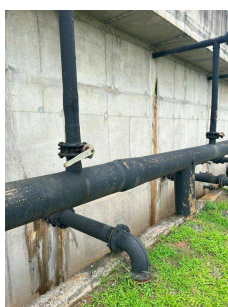
Foto 1 - Sinais de infiltração
