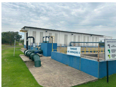
Foto 27 - Tanque de aerção
