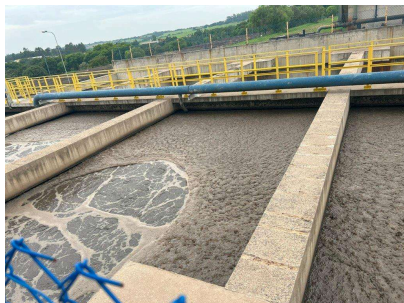
Foto 19 - Tanques de aeração
