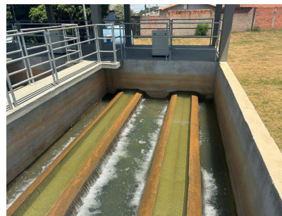
Foto 20 - Unidade de filtração
