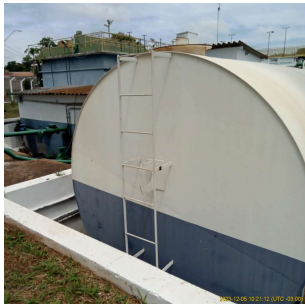
Foto 1 - Ausência de guarda-corpo
