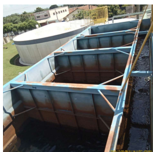
Foto 5 - Vista do sistema de filtração
