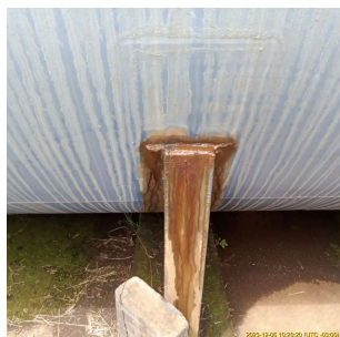
Foto 1 - Evidência de vazamento aparente
