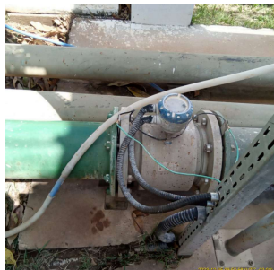
Foto 9 - Medidor de vazão
