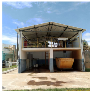
Foto 20 - Desidratação do lodo
