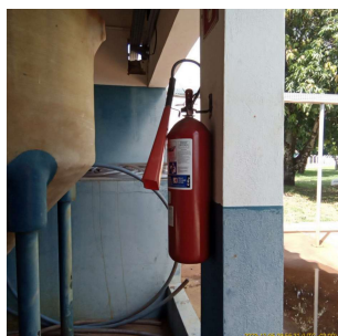
Foto 11 - Extintor de incêndio
