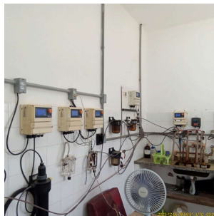
Foto 16 - Medidores on line de pH, Cloro, Flúor, Cor e Turbidez
