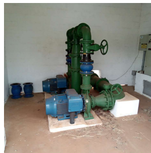
Foto 2 - Conjuntos motor-bomba (potência total 125 CV)
