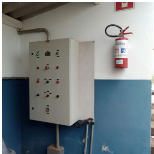
Foto 3 - Painel de comando e acionamento das bombas
