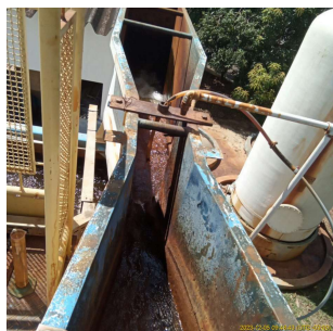
Foto 1 - Chegada da água bruta
