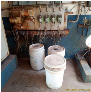
Foto 1 - Ausência de bacia de contenção (Dosagem de Flúor)
