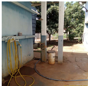
Foto 13 - Chuveiro de emergência
