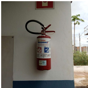
Foto 2 - Extintor de incêndio
