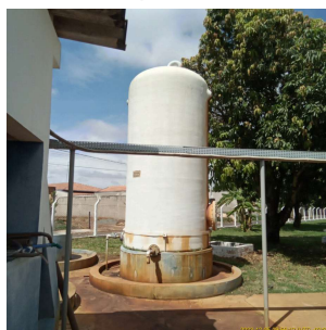
Foto 12 - Armazenamento de cloreto férrico
