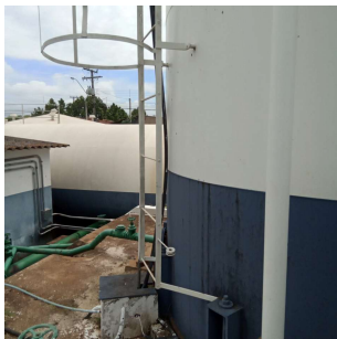
Foto 1 - Ausência de aterramento
