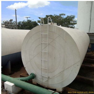
Foto 2 - Ausência de guarda-corpo
