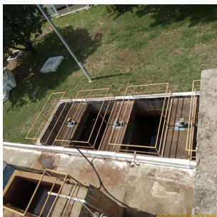
Foto 21 - Tanque de armazenamento de água de lavagem dos filtros e decantadores
