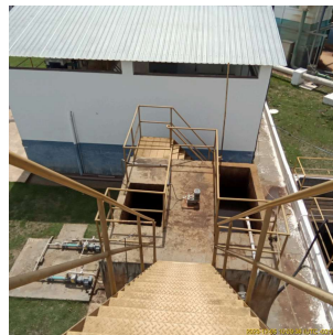
Foto 23 - Tanque de lodo
