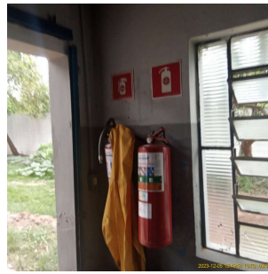
Foto 6 - Extintor de incêndio
