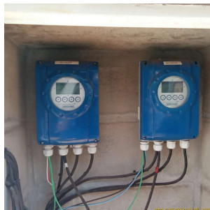
Foto 10 - Display do medidor de vazão
