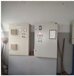
Foto 5 - Painel de comando e controle
