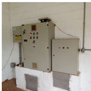
Foto 3 - Painel de comando e acionamento das bombas
