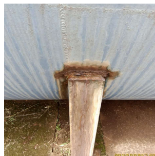
Foto 2 - Evidência de vazamento aparente
