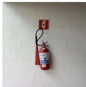
Foto 4 - Extintor de incêndio
