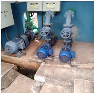
Foto 4 - Recalque para Reservatório Santa Clara
