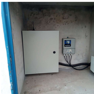
Foto 6 - Painel e medidor de nível
