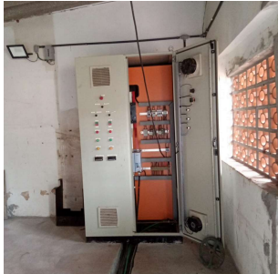
Foto 5 - Painel de comando e controle
