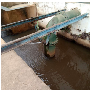
Foto 1 - Evidência de vazamento na flange
