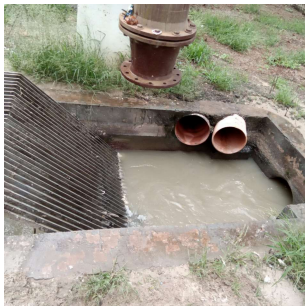
Foto 3 - Chegada do esgoto bruto, com gradeamento
