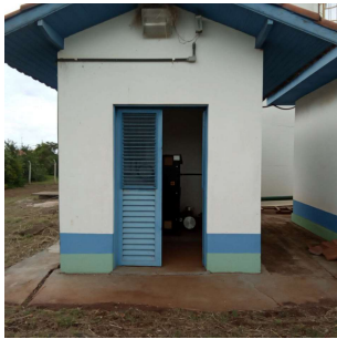
Foto 1 - Vista externa do booster Bela Vista/Lagoinha
