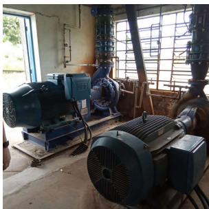
Foto 9 - Conjuntos motor-bombas I
