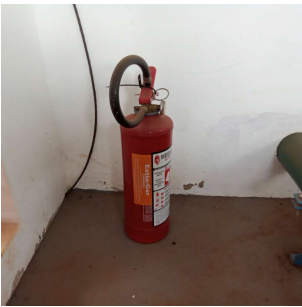
Foto 4 - Extintor de incêndio
