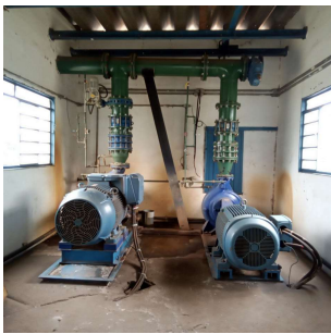
Foto 4 - Conjuntos motor-bombas II
