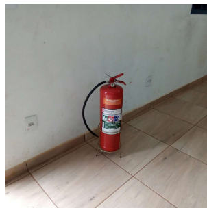
Foto 8 - Extintor de incêndio
