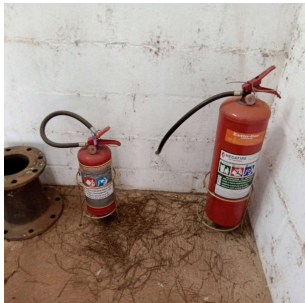
Foto 7 - Extintores de incêndio
