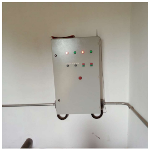
Foto 3 - Painel de comando e acionamento das bombas
