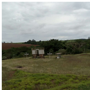
Foto 7 - Sistema de desidratação de lodo
