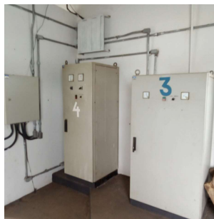
Foto 6 - Painele de comando e controle
