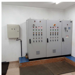
Foto 9 - Painel de comando e controle
