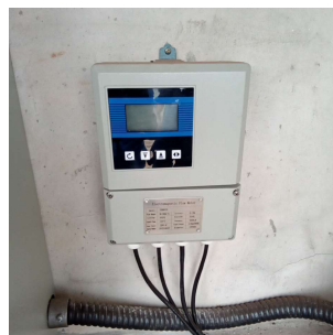
Foto 5 - Display da medição de nível
