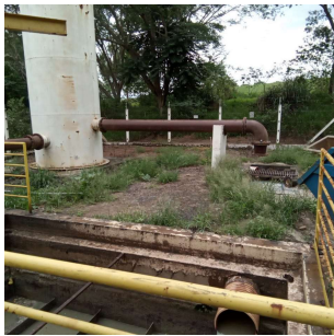
Foto 1 - Ausência de guarda-corpo
