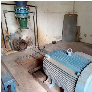
Foto 1 - Ausência de conjunto motor-bomba reserva
