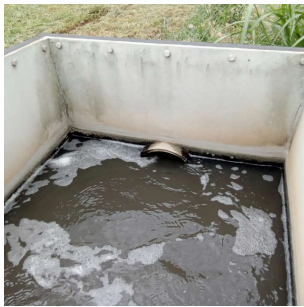
Foto 12 - Saída de esgoto tratado
