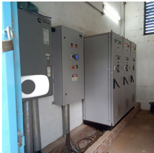
Foto 6 - Painel de comando e controle
