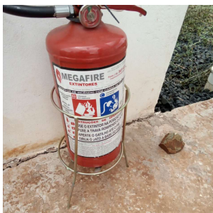
Foto 4 - Extintor de incêndio
