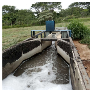
Foto 10 - Vista da saída do esgoto tratado
