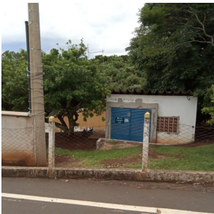
Foto 1 - Vista externa da captação superficial São Valentim
