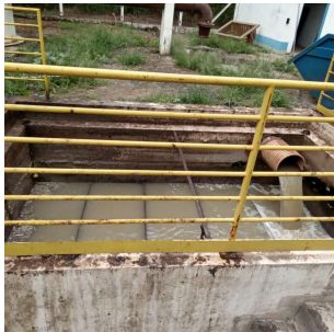
Foto 5 - Poço de sucção
