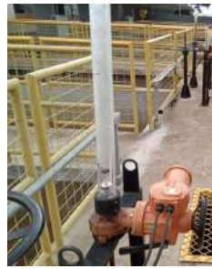
Foto 5 - Válvulas automatizadas na ETA 3.
