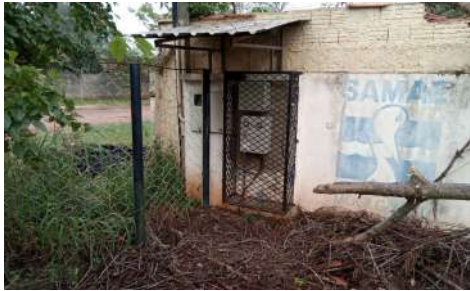
Foto 4 - Painel elétrico do poço.
