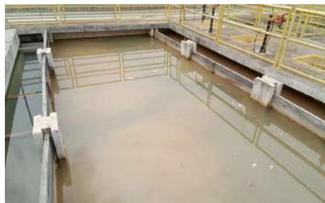
Foto 10 - ETA 3: Entrada do decantador.
