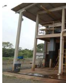
Foto 20 - Sistema de tratamento de lodo da ETE.
