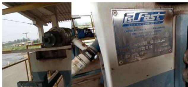
Foto 22 - Centrífuga em manutenção.
