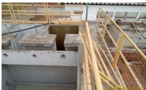
Foto 15 - Vista dos filtros da ETA.
