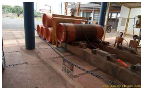
Foto 2 - Cilindros de armazenamento de gás cloro.
