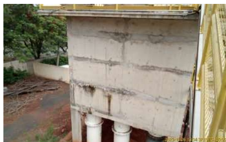
Foto 4 - Vazamentos na parede da caixa de chegada de água bruta.
