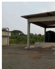
Foto 44 - Vista geral do armazenamento de hipoclorito para desinfecção.
