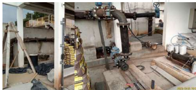
Foto 24 - Abrigo do sistema elétrico e EEAT.
