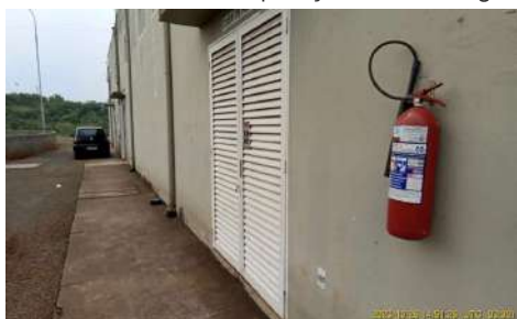
Foto 31 - Extintor da ETE.
