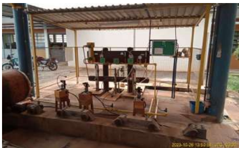
Foto 3 - Sistema de aplicação de gás cloro.
