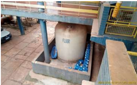
Foto 1 - Armazenamento do fluor da ETA.
