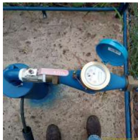
Foto 1 - Macromedidor do poço.
