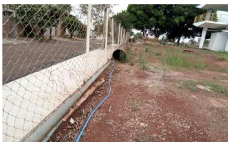
Foto 3 - Abertura no alambrado na lateral da ETA 3.
