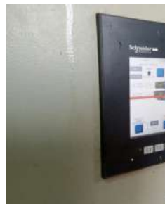
Foto 29 - Pannel de operação da centrífuga.
