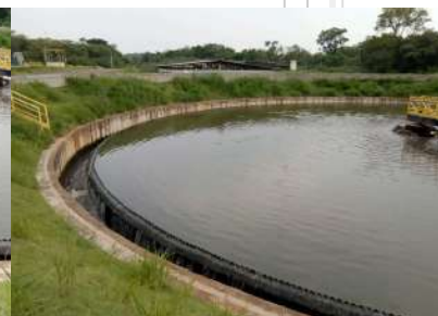
Foto 17 - Segundo decantador secundário da ETE.
