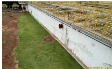
Foto 2 - Vazamentos na parede lateral da ETA 3.
