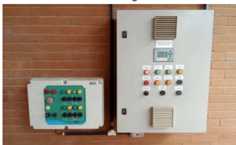
Foto 3 - Sistema de detecção de vazamento de gás cloro.
