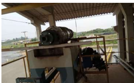
Foto 22 - Centrífuga em manutenção.
