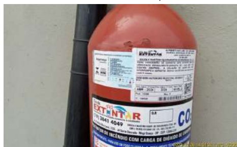
Foto 32 - Validade do extintor da ETE.
