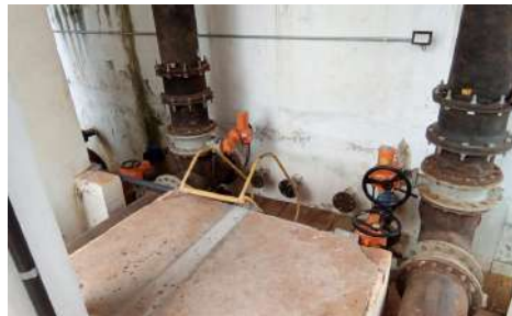
Foto 17 - Válvulas automatizadas na ETA 3.
