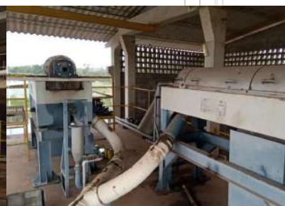
Foto 21 - Centrífugas de desague de lodo da ETE.
