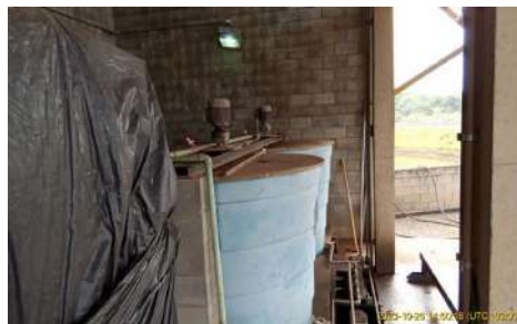
Foto 28 - Vista do sistema de armazenamento de produtos químicos do tratamento de lodo.
