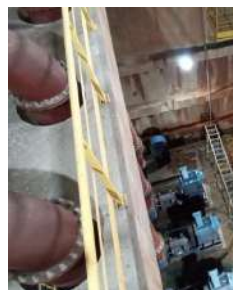
Foto 7 - Infiltração nas paredes do fosso do sistema de bombeamento da ETE.
