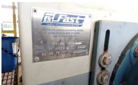
Foto 24 - Identificação da centrífuga em manutenção.
