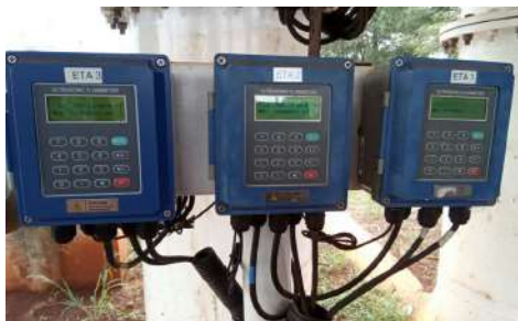
Foto 1 - Medidores de vazão de água bruta para os três módulos da ETA.
