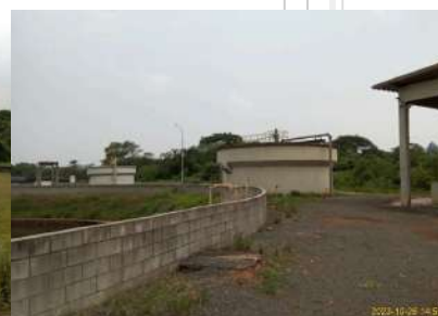
Foto 43 - Primeiro adensador de lodo da ETE.
