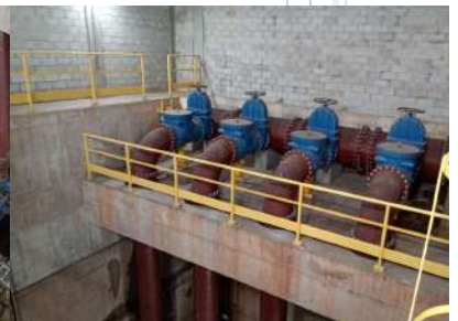
Foto 4 - Vista interna da EEE.
