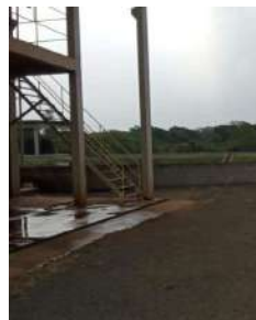
Foto 18 - Vista geral do primeiro decantador secundário da ETE.
