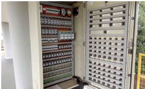
Foto 4 - Painel elétrico de automação.
