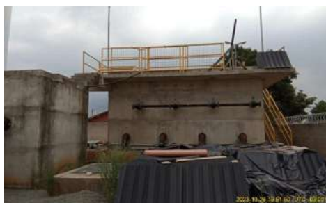
Foto 6 - Vista da ETA.
