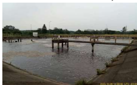
Foto 50 - Primeira lagoa de seis aeradores da ETE.
