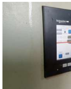
Foto 29 - Painel de operação da centrífuga.
