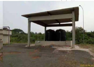
Foto 44 - Vista geral do armazenamento de hipoclorito para desinfecção.
