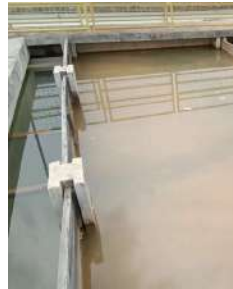
Foto 10 - ETA 3: Entrada do decantador.
