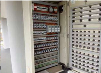
Foto 4 - Painel elétrico de automação.
