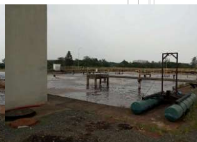
Foto 14 - Primeira lagoa de seis aeradores da ETE.
