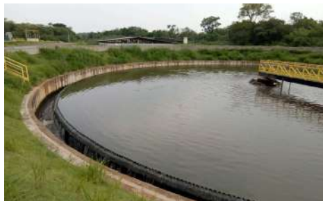
Foto 17 - Segundo decantador secundário da ETE.
