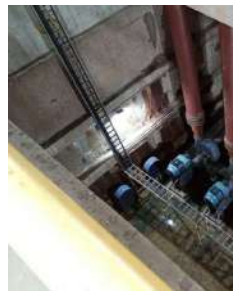
Foto 3 - Vista interna da EEE.
