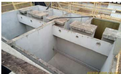
Foto 13 - Vista dos decantadores da ETA.
