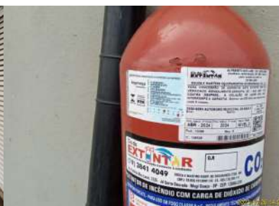
Foto 32 - Validade do extintor da ETE.
