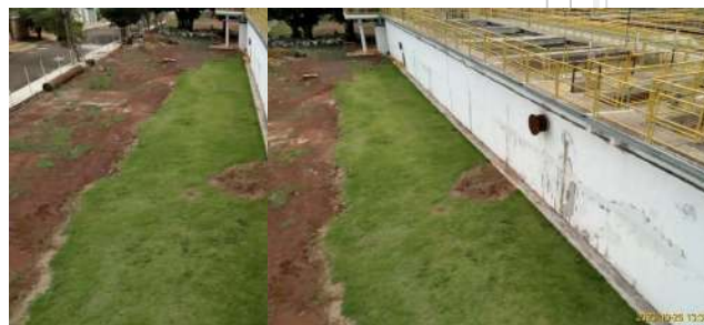
Foto 1 - Vazamentos na parede lateral da ETA 3. Foto 2 - Vazamentos na parede lateral da ETA 3.
