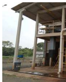
Foto 20 - Sistema de tratamento de lodo da ETE.
