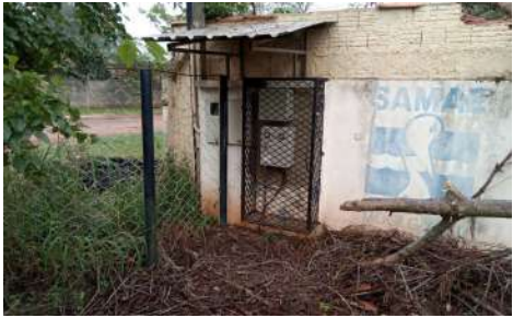
Foto 4 - Pannel elétrico do poço.
