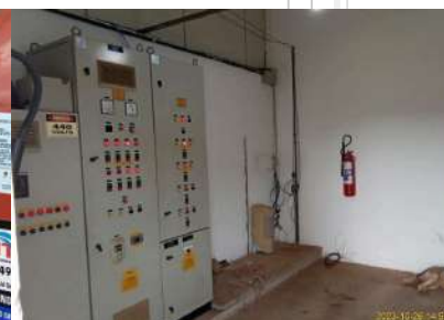
Foto 33 - Painéis elétricos da ETE.
