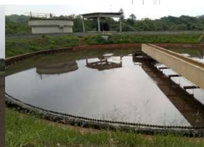
Foto 19 - Primeiro decantador secundário da ETE. Inoperante devido a entupimento da tubulação proveniente da lagoa aerada.
