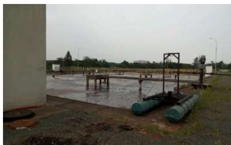
Foto 14 - Primeira lagoa de seis aeradores da ETE.
