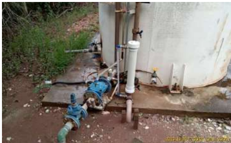
Foto 1 - Sistema de dosagem com pastilhas.
