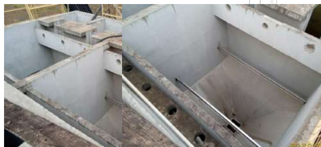
Foto 13 - Vista dos decantadores da ETA.
