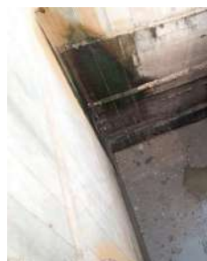
Foto 9 - Poço de chegada de efluente da EEE.
