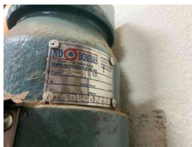
Foto 1 - Conjunto moto bomba reserva.
