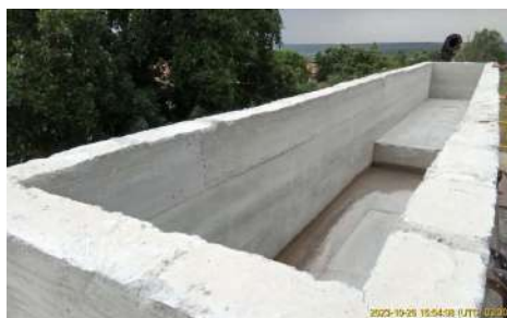
Foto 16 - Caixa de chegada da ETA.
