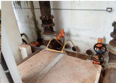
Foto 17 - Válvulas automatizadas na ETA 3.
