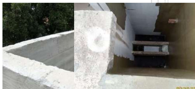
Foto 16 - Caixa de chegada da ETA.
