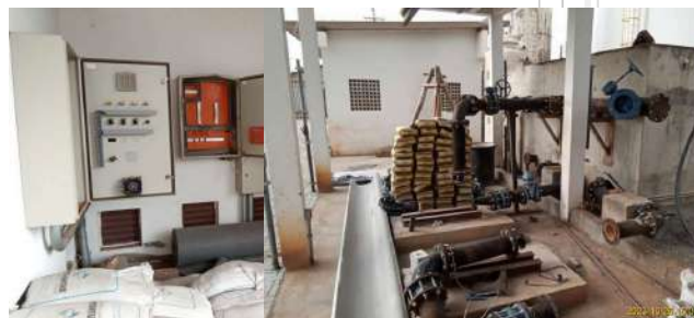
Foto 27 - Painéis elétricos da ETA.
