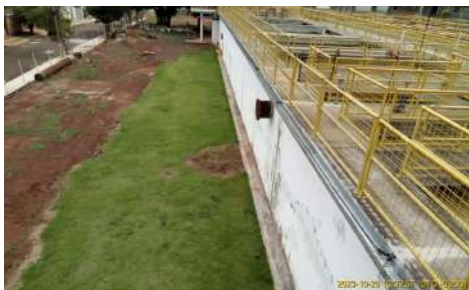
Foto 1 - Vazamentos na parede lateral da ETA 3.
