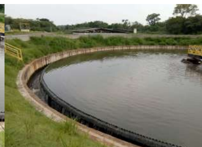
Foto 17 - Segundo decantador secundário da ETE.
