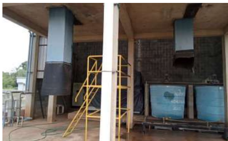
Foto 27 - Vista do sistema de armazenamento de produtos químicos do tratamento de lodo.
