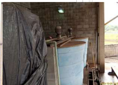
Foto 28 - Vista do sistema de armazenamento de produtos químicos do tratamento de lodo.
