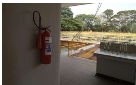
Foto 1 - Extintor na parte superior da ETA.
