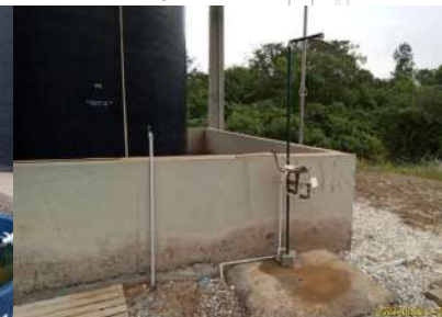
Foto 46 - Chuveiro de emergência.
