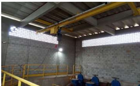
Foto 5 - Vista interna da EEE.
