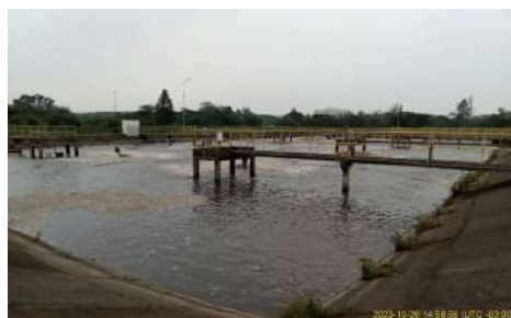
Foto 50 - Primeira lagoa de seis aeradores da ETE.
