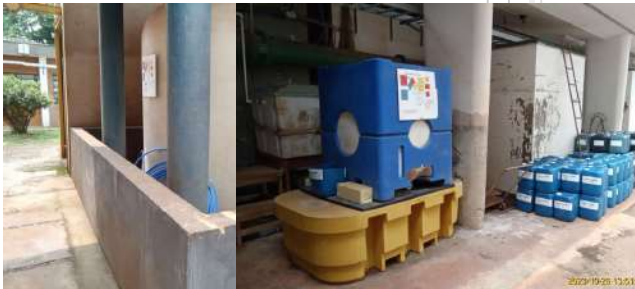
Foto 1 - Estocagem dos produtos químicos. Foto 2 - Estocagem dos produtos químicos.
