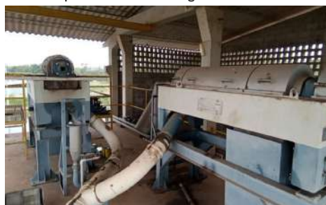
Foto 21 - Centrífugas de desague de lodo da ETE.
