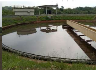
Foto 19 - Primeiro decantador secundário da ETE. Inoperante devido a entupimento da tubulação proveniente da lagoa aerada.
