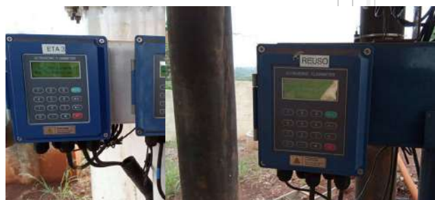
Foto 1 - Medidores de vazão de água bruta para os três módulos da ETA.
