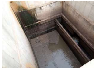
Foto 9 - Poço de chegada de efluente da EEE.
