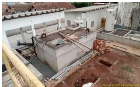
Foto 22 - Sistema de desinfecção da ETA.
