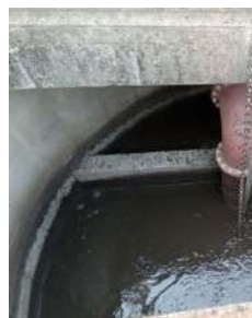
Foto 48 - Poço de lodo para o sistema
