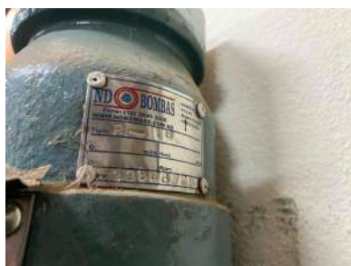
Foto 1 - Conjunto moto bomba reserva.
