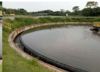
Foto 17 - Segundo decantador secundário da ETE.
