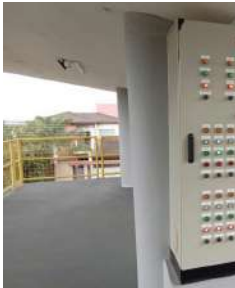
Foto 3 - Painel elétrico de automação.
