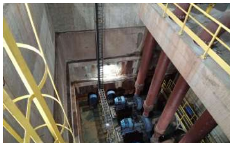
Foto 6 - Infiltração nas paredes do fosso do sistema de bombeamento da EEE.
