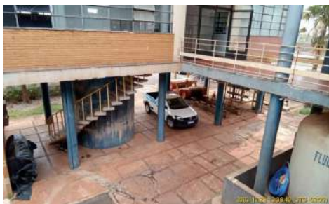
Foto 1 - Cilindros de armazenamento de gás cloro.
