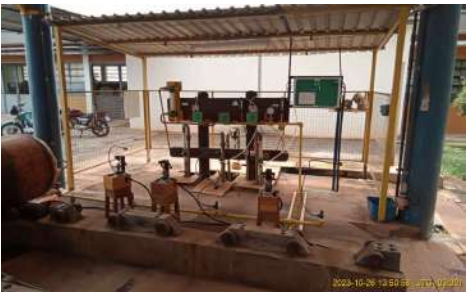
Foto 3 - Sistema de aplicação de gás cloro.
