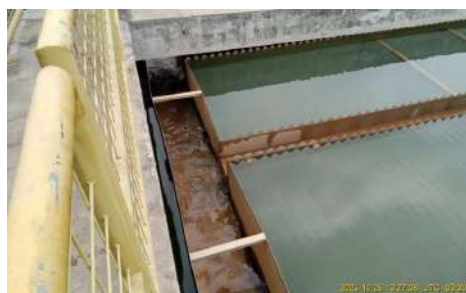
Foto 2 - Furos no fundo da calha lateral dos vertedores.
