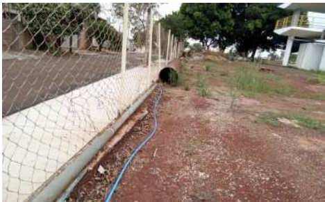
Foto 3 - Abertura no alambrado na lateral da ETA 3.
