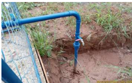
Foto 1 - Tomada de água para coleta de água bruta do poço.
