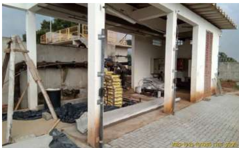
Foto 24 - Abrigo do sistema elétrico e EEAT.
