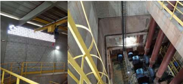
Foto 5 - Vista interna da EEE. Foto 6 - Infiltração nas paredes do fosso do sistema de bombeamento da EEE.
