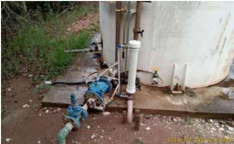
Foto 1 - Sistema de dosagem com pastilhas.
