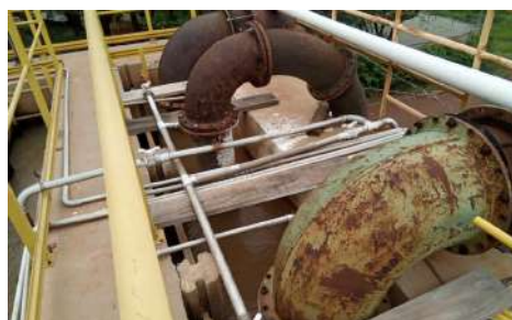
Foto 14 - Adutoras de chegada de água bruta.
