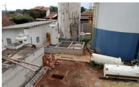
Foto 23 - Baías de contenção de produtos químicos da ETA.
