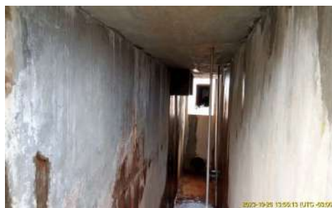
Foto 6 - Vazamentos na parede interna e nas comportas da ETA 3.
