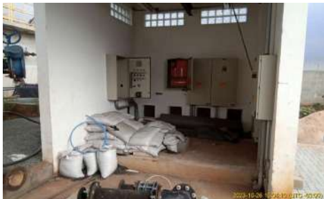
Foto 26 - Painéis elétricos da ETA.
