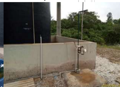
Foto 46 - Chuveiro de emergência.
