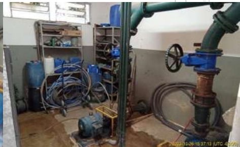
Foto 2 - Sistema de bombeamento atual que será substituído.
