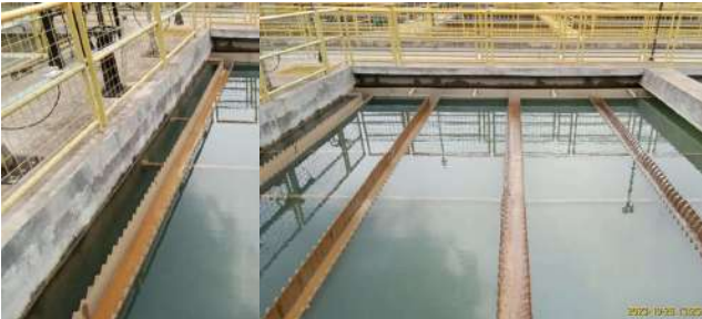
Foto 1 - Vertedores do decantador da ETA 3 desnivelados. Foto 2 - Vertedores do decantador da ETA 3 desnivelados.
