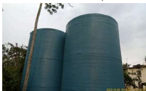
Foto 4 - Dois tanques adquiridos para melhoria do sistema.
