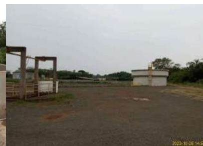
Foto 47 - Segundo adensador de lodo da ETE.
