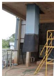
Foto 27 - Vista do sistema de armazenamento de produtos químicos do tratamento de lodo.
