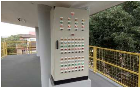
Foto 3 - Painel elétrico de automação.
