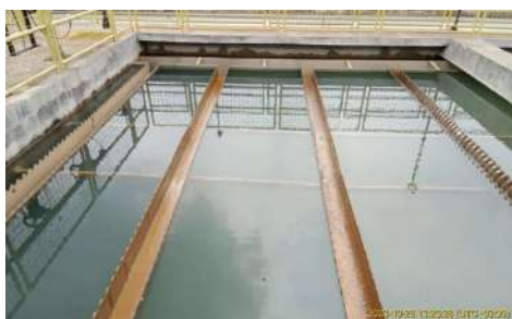
Foto 1 - Furos no fundo da calha dos vertedores.
