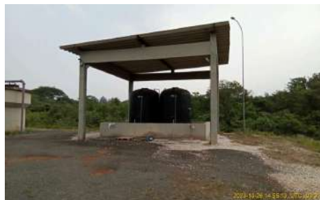
Foto 44 - Vista geral do armazenamento de hipoclorito para desinfecção.
