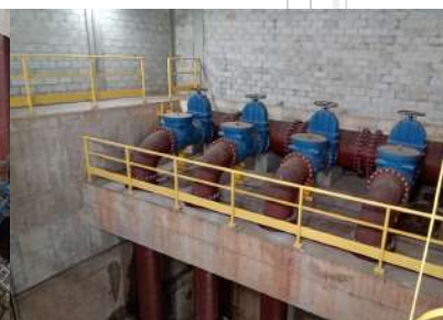
Foto 4 - Vista interna da ETE.
