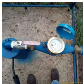
Foto 1 - Macromedidor do poço.
