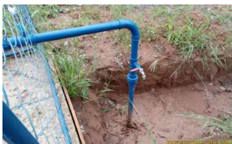
Foto 1 - Tomada de água para coleta de água bruta do poço.
