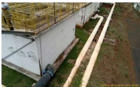
Foto 3 - Vazamentos na parede lateral da ETA 3.
