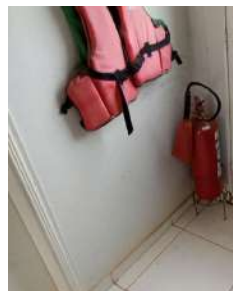
Foto 35 - Colete e extintor da ETE.
