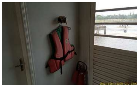
Foto 36 - Colete e extintor da ETE.
