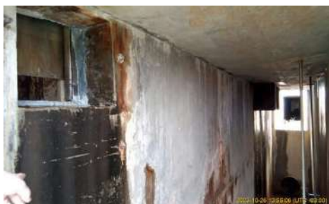
Foto 5 - Vazamentos na parede interna e nas comportas da ETA 3.
