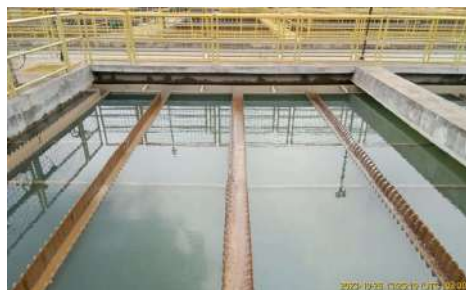
Foto 2 - Vertedores do decantador da ETA 3 desnivelados.
