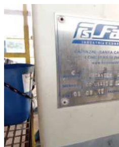
Foto 24 - Identificação da centrífuga em manutenção.
