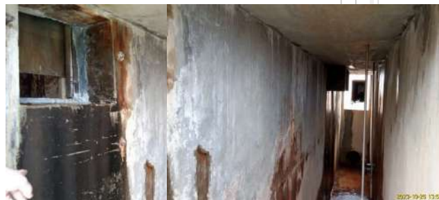
Foto 5 - Vazamentos na parede interna e nas comportas da ETA 3. Foto 6 - Vazamentos na parede interna e nas comportas da ETA 3.
