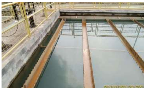
Foto 1 - Vertedores do decantador da ETA 3 desnivelados.
