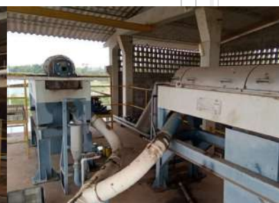
Foto 21 - Centrífugas de desagüe de lodo da ETE.
