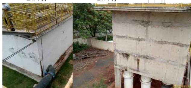
Foto 3 - Vazamentos na parede lateral da ETA 3. Foto 4 - Vazamentos na parede da caixa de chegada de água bruta.
