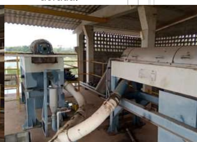
Foto 21 - Centrífugas de desague de lodo da ETE.
