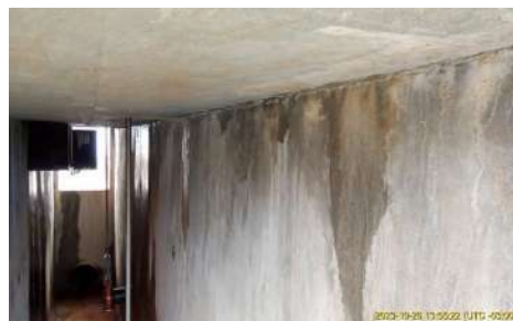
Foto 7 - Vazamentos na parede interna e nas comportas da ETA 3.
