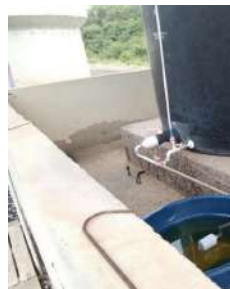
Foto 45 - Detalhes do armazenamento de hipoclorito para desinfecção.
