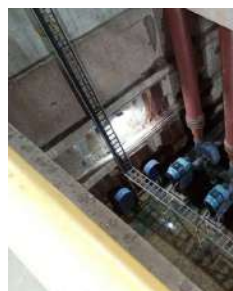
Foto 3 - Vista interna da ETE.
