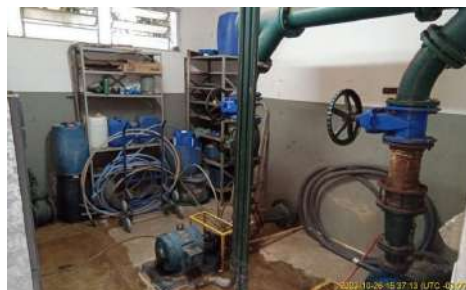
Foto 2 - Sistema de bombeamento atual que será substituído.
