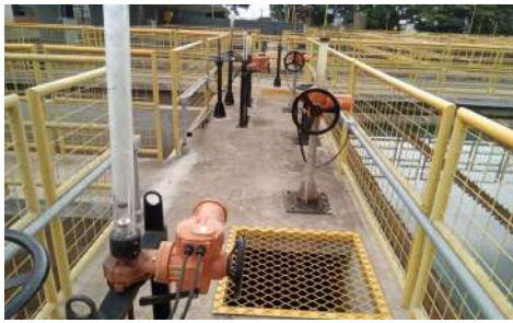
Foto 5 - Válvulas automatizadas na ETA 3.
