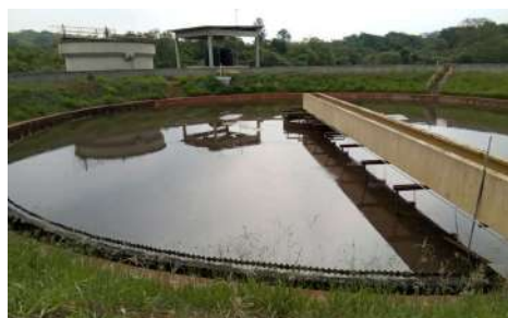
Foto 19 - Primeiro decantador secundário da ETE. Inoperante devido a entupimento da tubulação proveniente da lagoa aerada.
