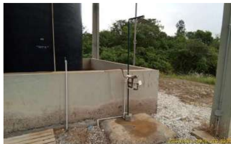
Foto 46 - Chuveiro de emergência.
