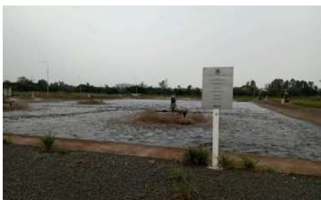
Foto 13 - Segunda lagoa de seis aeradores da ETE. Três aeradores em manutenção.
