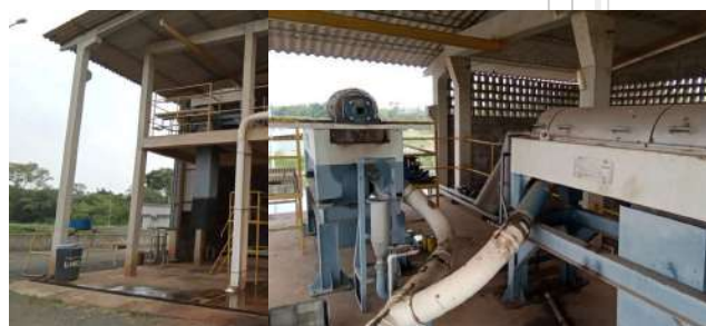
Foto 20 - Sistema de tratamento de lodo da ETE.
