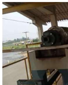
Foto 22 - Centrífuga em manutenção.
