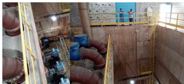
Foto 7 - Infiltração nas paredes do fosso do sistema de bombeamento da EEE.
