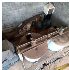
Foto 26 - Vista superior do sistema de armazenamento de produtos químicos do tratamento de lodo.
