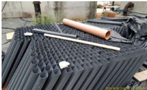
Foto 7 - Perfis laminares do decantador de alta taxa da ETA.
