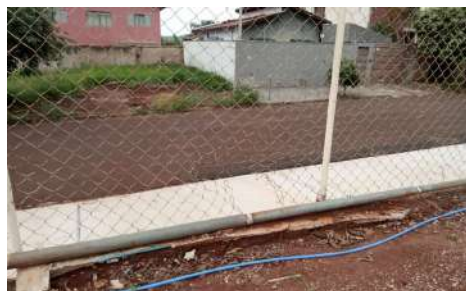
Foto 2 - Abertura no alambrado na lateral da ETA 3.
