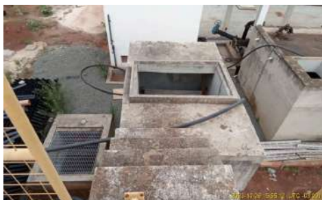
Foto 21 - Caixa de passagem entre filtros e desinfecção.
