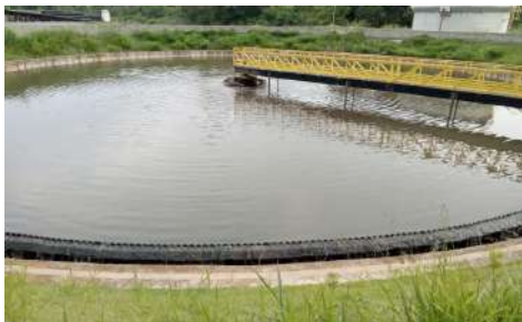
Foto 16 - Segundo decantador secundário da ETE.
