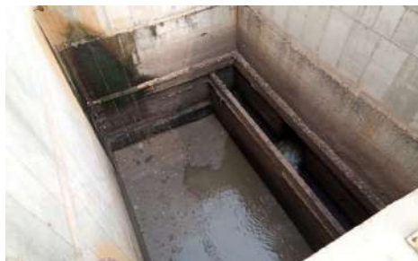
Foto 9 - Poço de chegada de efluente da EEE.
