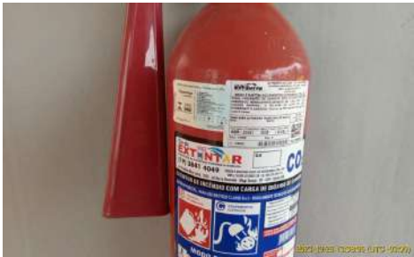
Foto 1 - Validade do extintor.
