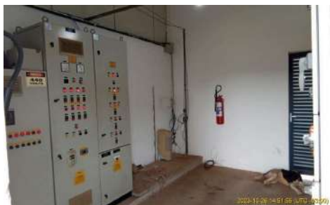
Foto 33 - Painéis elétricos da ETE.
