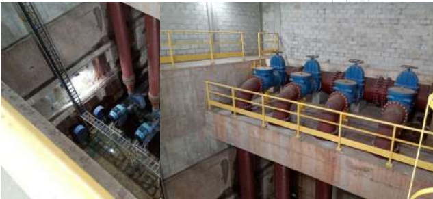
Foto 3 - Vista interna da EEE. Foto 4 - Vista interna da EEE.
