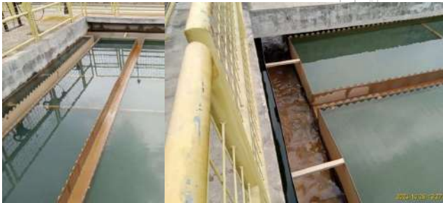
Foto 1 - Furos no fundo da calha dos vertedores. Foto 2 - Furos no fundo da calha lateral dos vertedores.
