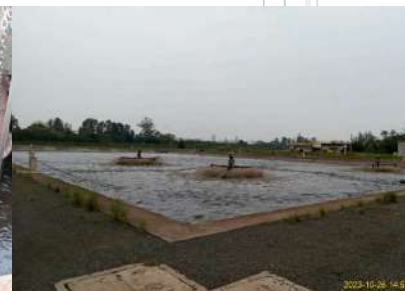
Foto 49 - Segunda lagoa de seis aeradores da ETE. Três aeradores em manutenção.
