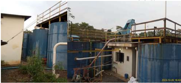
Foto 5 - Vista geral Foto 6 - Vista geral da ETE. da ETE.
