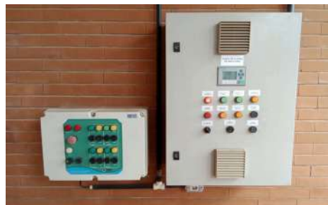
Foto 3 - Sistema de detecção de vazamento de gás cloro.
