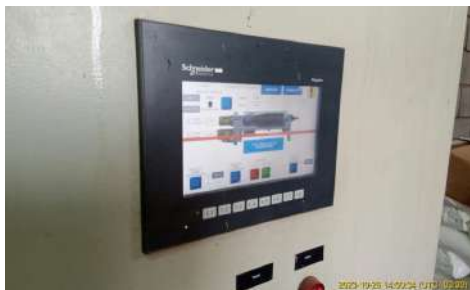
Foto 29 - Painel de operação da centrífuga.
