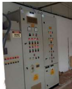
Foto 33 - Painéis elétricos da ETE.
