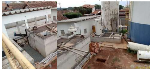
Foto 22 - Sistema de desinfecção da ETA.
