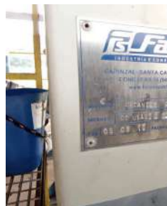
Foto 24 - Identificação da centrífuga em manutenção.
