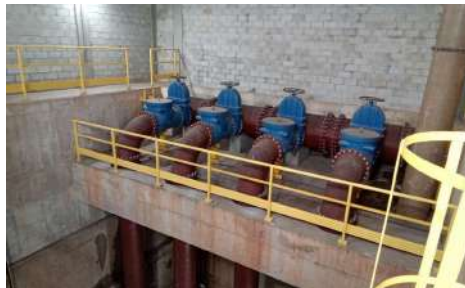
Foto 4 - Vista interna da EEE.
