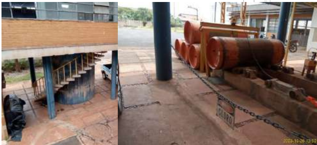
Foto 1 - Cilindros de armazenamento de gás cloro. Foto 2 - Cilindros de armazenamento de gás cloro.
