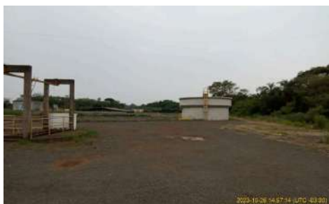
Foto 47 - Segundo adensador de lodo da ETE.
