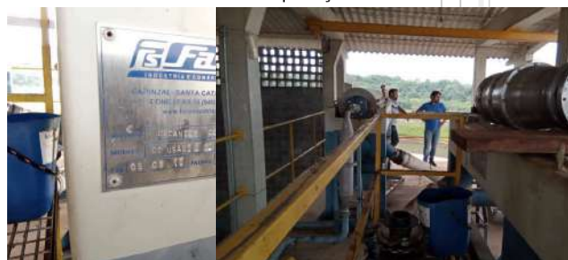
Foto 24 - Identificação da centrífuga em manutenção.
