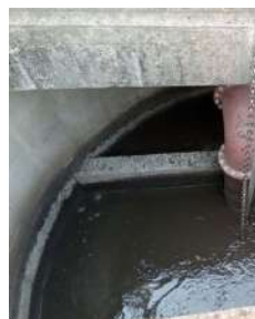
Foto 48 - Poço de lodo para o sistema
