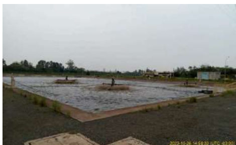
Foto 49 - Segunda lagoa de seis aeradores da ETE. Três aeradores em manutenção.
