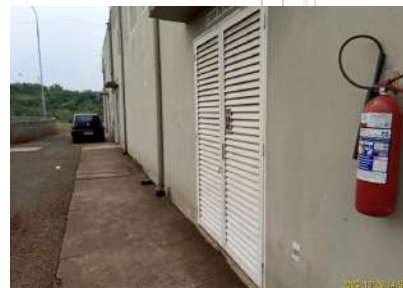
Foto 31 - Extintor da ETE.
