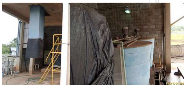
Foto 27 - Vista do sistema de armazenamento de produtos químicos do tratamento de lodo.
