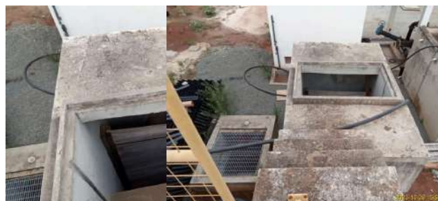
Foto 20 - Caixa de passagem entre filtros e desinfecção.
