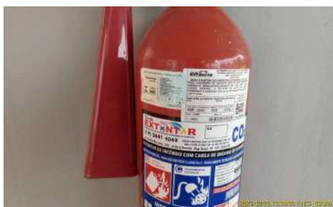
Foto 1 - Validade do extintor.
