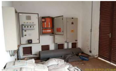
Foto 27 - Painéis elétricos da ETA.
