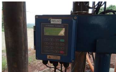
Foto 2 - Medidor de vazão de água de reúso.
