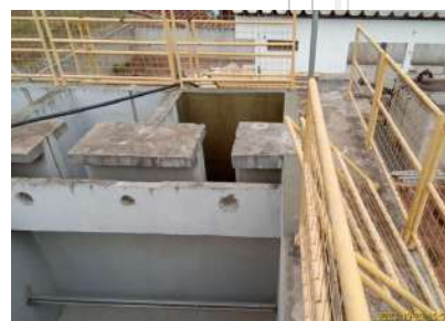
Foto 15 - Vista dos filtros da ETA.
