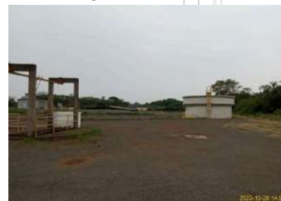
Foto 47 - Segundo adensador de lodo da ETE.
