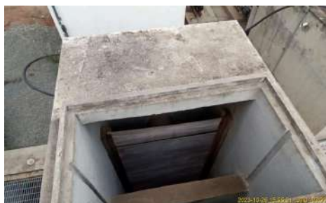
Foto 20 - Caixa de passagem entre filtros e desinfecção.
