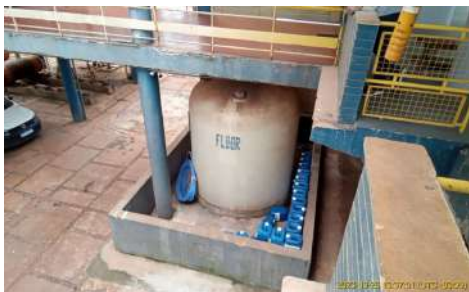
Foto 1 - Armazenamento do fluor da ETA.
