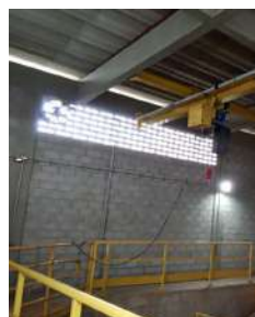
Foto 5 - Vista interna da ETE.
