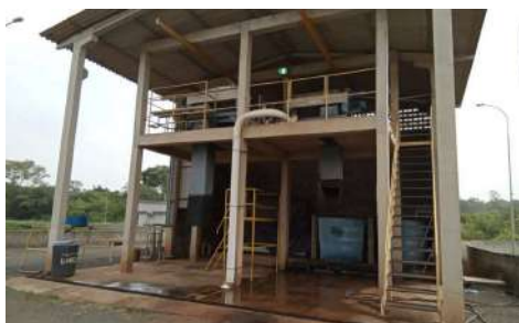
Foto 20 - Sistema de tratamento de lodo da ETE.
