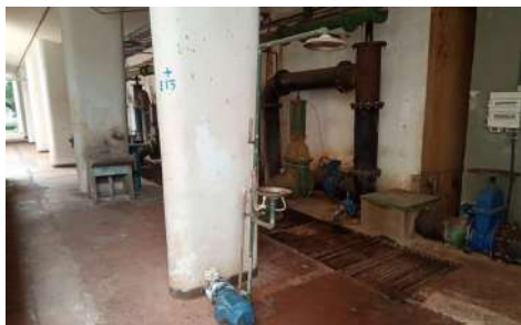
Foto 1 - Chuveiro de emergência.
