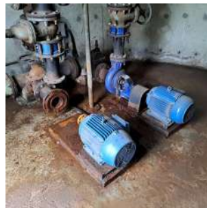
Foto 6 - Conjuntos motobomba (1+1R) da EEAT Tonelli
