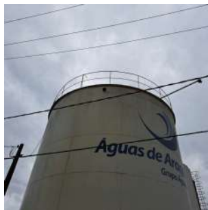
Foto 1 - Tubo extravasor do Reservatório metálico
