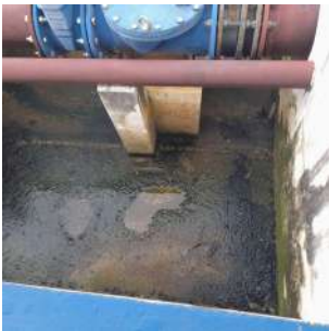
Foto 1 - Detalhe do acúmulo de matéria orgânica.
