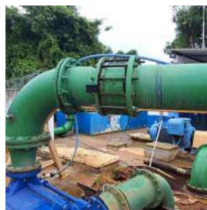
Foto 2 - Vazamento na tubulação de recalque do conjunto motobomba nº 1.
