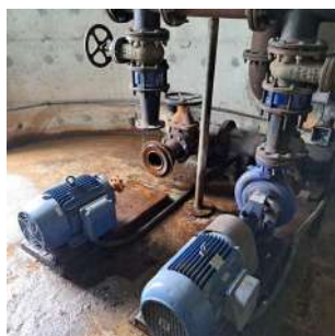
Foto 1 - Vazamento na tubulação (lado esquerdo) onde está ausente a bomba.
