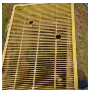
Foto 2 - Local do vazamento.
