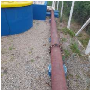
Foto 4 - Tubulação entre bombas e saída da E.E.E.
