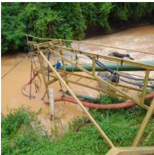
Foto 1 - Vista geral da captação no Rio Pirapora.
