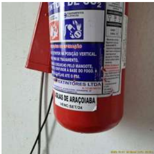
Foto 2 - Validade do extintor da EEAT.
