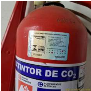
Foto 1 - Validade do extintor da EEAT.
