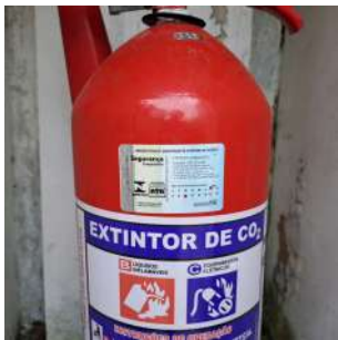
Foto 1 - Validade do extintor de incêndio.
