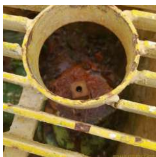
Foto 1 - Detalhe do vazamento.
