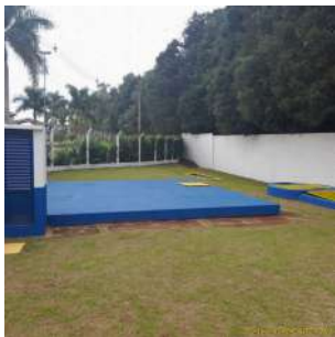
Foto 1 - Vista geral da E.E.E.
