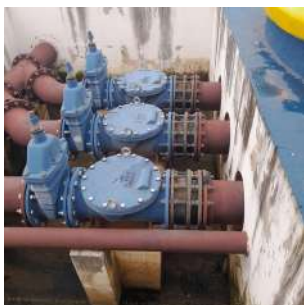
Foto 1 - Detalhe das tubulações das bombas.
