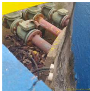
Foto 4 - Válvulas para controle da E.E.E.
