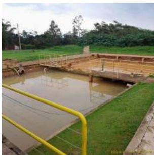
Foto 1 - Vista geral dos tanques no fundo da ETA (água de lavagem dos filtros e decantadores).
