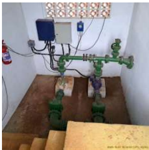
Foto 3 - Vista interna da EEAT Araçoiabinha.
