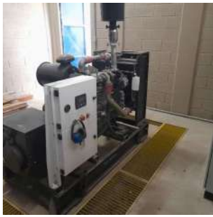
Foto 7 - Gerador a diesel.
