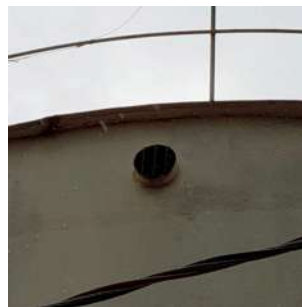
Foto 2 - Detalhe do tubo extravasor sem tela de proteção.
