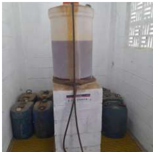
Foto 5 - Tanque de diesel do gerador.
