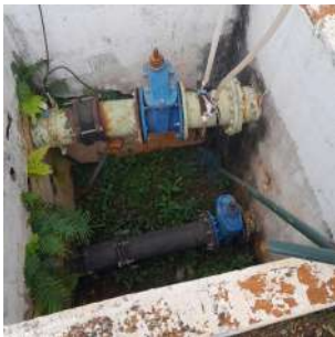
Foto 2 - Detalhe das válvulas junto ao reservatório.
