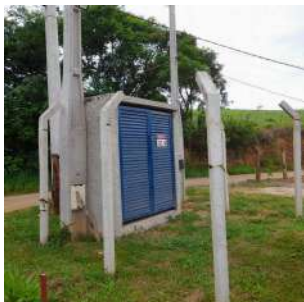
Foto 1 - Pannel elétrico junto à captação. De acordo com o prestador, o pannel foi movido para uma cota superior devido à enchente em anos anteriores.
