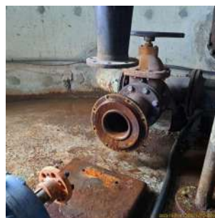
Foto 2 - Vazamento na tubulação (lado esquerdo) onde está ausente a bomba.
