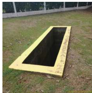
Foto 2 - Chegada de esgoto bruto sem qualquer proteção contra quedas.
