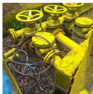
Foto 5 - Detalhe dos registros da E.E.E.
