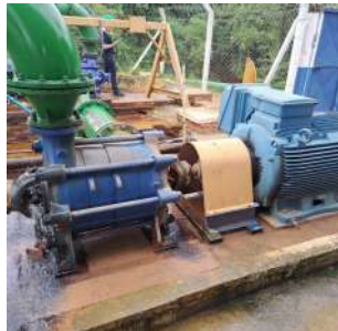
Foto 1 - Ausência de regulagem da água de lubrificação das gaxetas do conjunto motobomba 2.
