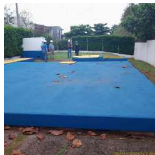
Foto 5 - Vista geral da EEE.
