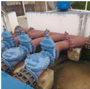
Foto 3 - Saída das bombas.
