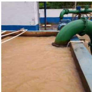
Foto 9 - Chegada da água bruta.
