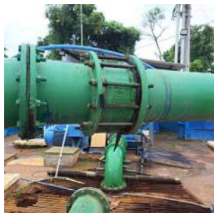
Foto 3 - Detalhe do esguicho de água saindo da tubulação de recalque do conjunto motobomba nº 1.
