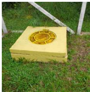
Foto 2 - PV junto à E.E.E.
