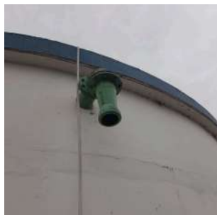
Foto 1 - Detalhe do extravasor sem proteção contra entrada de insetos e pequenos animais.
