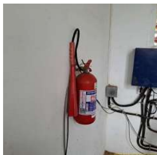
Foto 1 - Extintor de incêndio dentro da EEAT
