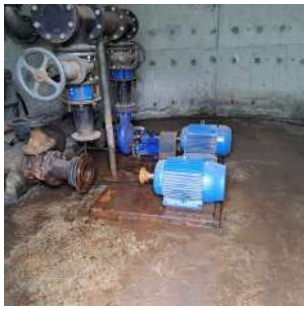
Foto 1 - Ausência de bomba reserva.
