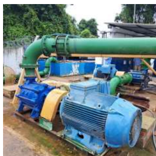
Foto 1 - Vazamento na tubulação de recalque do conjunto motobomba nº 1.
