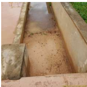
Foto 8 - Detalhe 4 de acúmulo de material, evidenciando transbordamento dos tanques.
