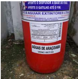
Foto 2 - Detalhe da validade do extintor de incêndio.
