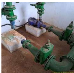
Foto 1 - Ausência de motobomba reserva instalada.
