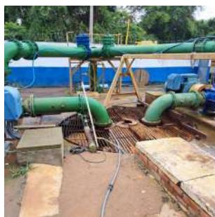
Foto 5 - Poço de sucção da EEAB
