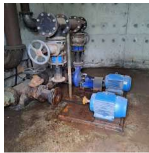
Foto 4 - Vista interna da EEAT Tonelli
