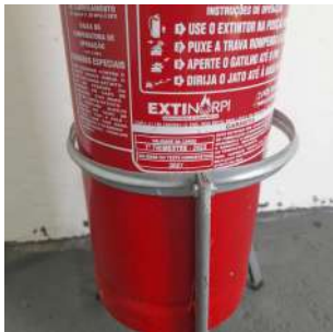
Foto 1 - Detalhe da validade do extintor.
