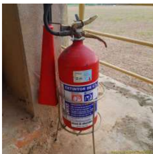
Foto 16 - Extintor de incêndio junto à centrífuga (e dentro da validade).
