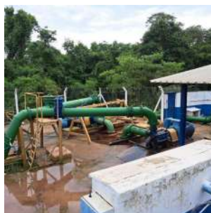
Foto 8 - Vista dos conjuntos motobomba da EEAB e da área interna da Captação do Piraporão.
