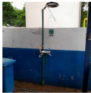
Foto 6 - Chuveiro de emergência junto ao local de aplicação de produtos químicos.
