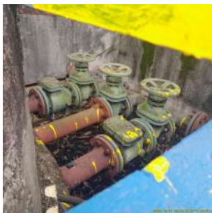
Foto 3 - Válvulas para controle da E.E.E.
