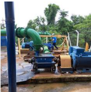
Foto 1 - Vista dos conjuntos motobomba (1+1R) da EEAB.
