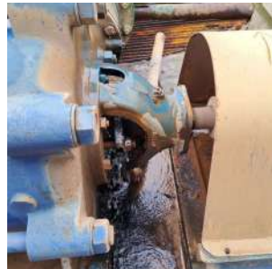
Foto 2 - Ausência de regulagem da água de lubrificação das gaxetas do conjunto motobomba 2.
