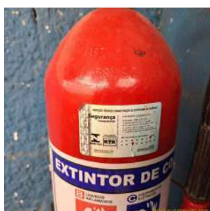
Foto 1 - Validade do extintor de incêndio.
