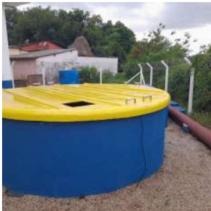
Foto 2 - Poço da E.E.E.
