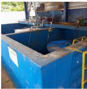
Foto 5 - Detalhe do tanque de armazenamento de produto químico.
