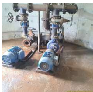
Foto 3 - Vazamento na tubulação (lado esquerdo) onde está ausente a bomba.
