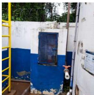
Foto 1 - Vista do abrigo de proteção do extintor de incêndio.
