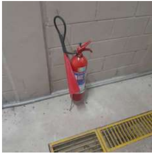
Foto 1 - Extintor dentro do abrigo.
