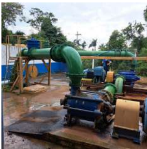
Foto 2 - Vista dos conjuntos motobomba (1+1R) da EEAB.
