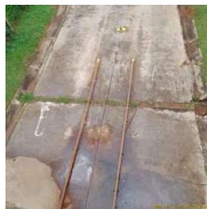
Foto 17 - Detalhe dos trilhos para deslocamento das caçambas.
