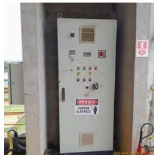
Foto 15 - Painelelétrico da centrífuga.
