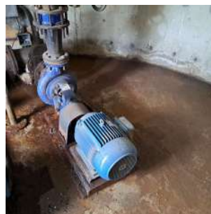
Foto 8 - Segundo conjunto motobomba da EEAT Tonelli
