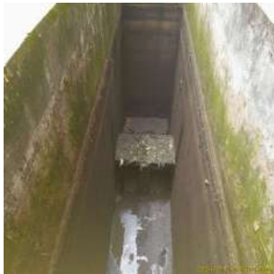
Foto 1 - Detalhe da chegada de esgoto bruto sem qualquer gradeamento.
