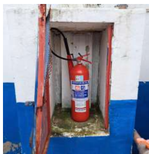
Foto 2 - Extintor de incêndio na EEAB e Captação Piraporão.
