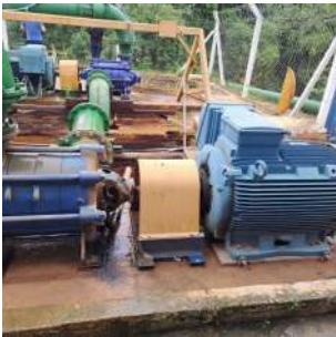
Foto 3 - Vista dos conjuntos motobomba (1+1R) da EEAB.
