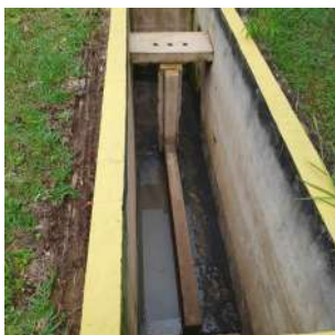
Foto 1 - Detalhe da chegada do esgoto bruto sem gradeamento.
