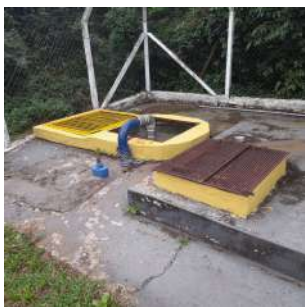
Foto 3 - Vista do poço da E.E.E.
