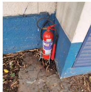
Foto 2 - Extintor de incêndio na EEAT.
