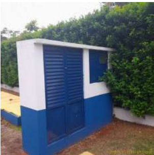
Foto 2 - Abrigo do painel elétrico.
