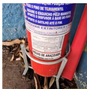
Foto 2 - Validade do extintor de incêndio.
