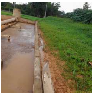
Foto 6 - Detalhe 3 de acúmulo de material, evidenciando transbordamento dos tanques.
