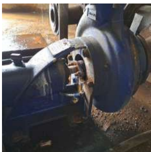
Foto 1 - Ausência de condução adequada da água de lubrificação de gaxeta.
