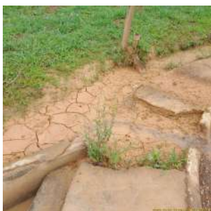
Foto 4 - Detalhe 1 de acúmulo de material, evidenciando transbordamento dos tanques.
