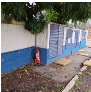
Foto 1 - Extintor de incêndio na EEAT.
