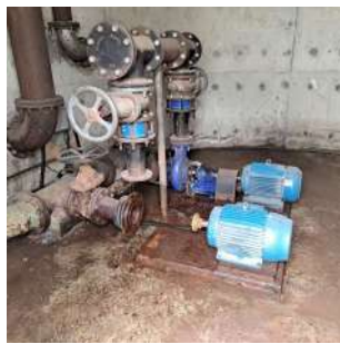
Foto 3 - Vista interna da EEAT Tonelli
