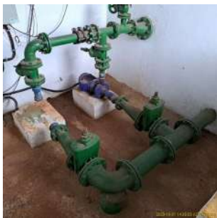
Foto 4 - Conjuntos motobomba (1+1R) da EEAT Araçoiabinha
