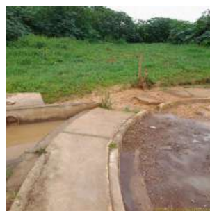
Foto 5 - Detalhe 2 de acúmulo de material, evidenciando transbordamento dos tanques.
