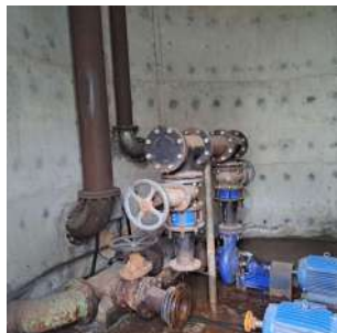
Foto 5 - Tubulações e registros da EEAT Tonelli
