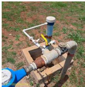
Foto 8 - Torneira para tomada de água bruta.
