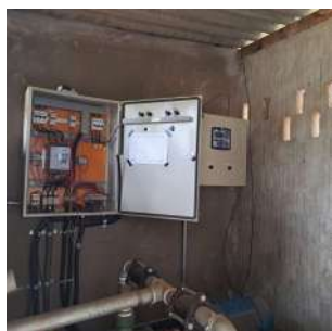
Foto 4 - Painel de comando e sistema supervisorio.
