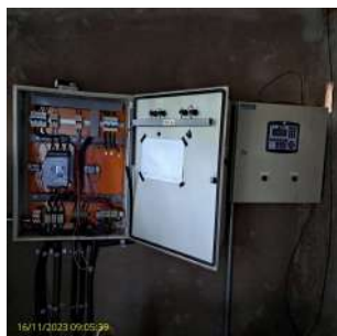
Foto 8 - Painel de comando e sistema supervisorio.
