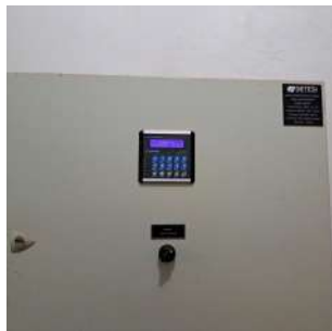
Foto 16 - Painel elétrico e de comando da estação elevatória.
