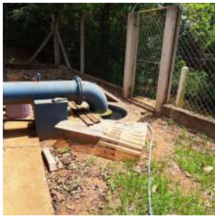
Foto 1 - Detalhe dos materiais improvisados como tampa no poço de sucção.
