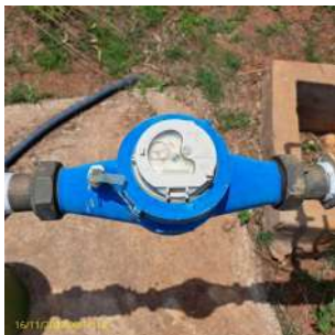
Foto 7 - Macromedidor no cavalete do poço.
