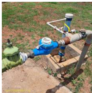
Foto 6 - Macromedidor no cavalete do poço.
