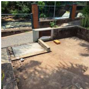
Foto 1 - Detalhe para a placa de identificação do local deteriorada.
