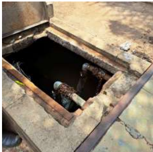
Foto 3 - Vista interna da EEEB, com as bombas submersas (1+1R).
