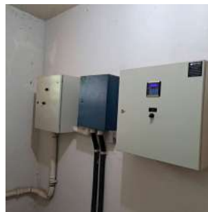
Foto 15 - Painel elétrico e de comando da estação elevatória.
