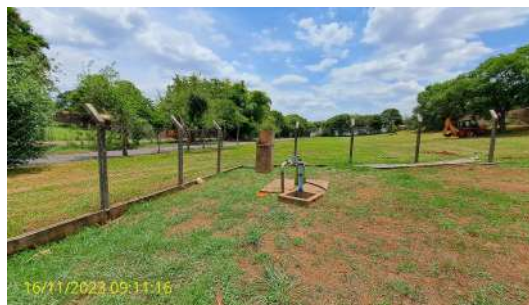
Foto 4 - Trecho do alambrado tombado.
