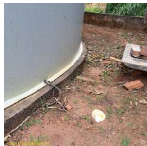
Foto 5 - Aterramento da estrutura do reservatório.
