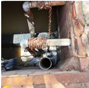
Foto 4 - Vista interna da EEEB, com as bombas submersas (1+1R).
