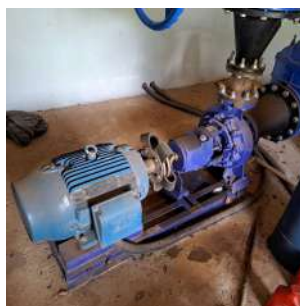
Foto 12 - Segundo conjunto motobomba.
