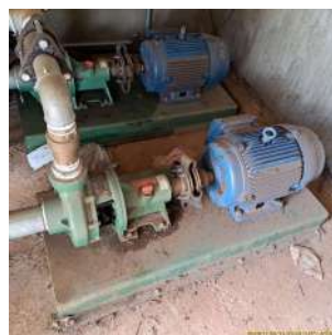
Foto 5 - Primeiro conjunto motobomba da EEAT.
