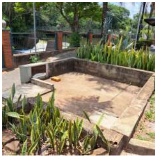
Foto 2 - Vista geral da EEEB.
