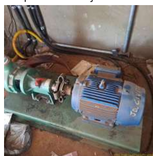
Foto 8 - Segundo conjunto motobomba da EEAT.
