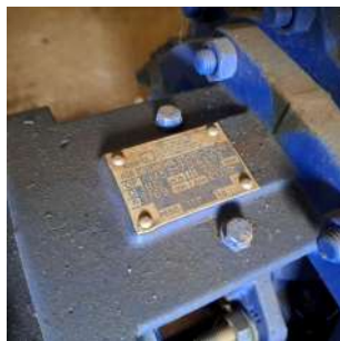
Foto 14 - Placa de especificações técnicas da bomba do segundo conjunto motobomba.
