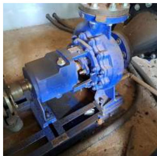
Foto 1 - Detalhe para o vazamento próximo à gaxeta do equipamento.
