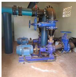
Foto 8 - Vista interna da estação elevatória, com dois conjuntos motobomba (1+1R).
