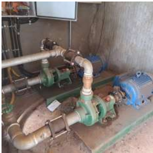
Foto 3 - Vista dos conjuntos motobomba (1+1R) da EEAT.
