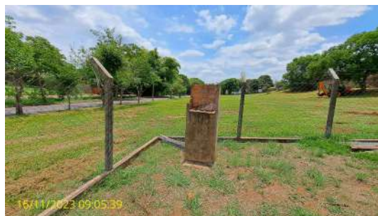
Foto 10 - Trecho do alambrado tombado.
