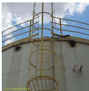
Foto 7 - Telas de proteção no tubo extravasor do reservatório.
