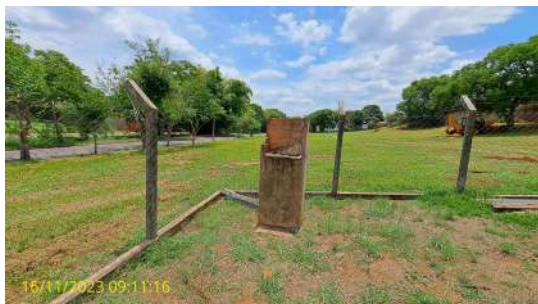
Foto 5 - Trecho do alambrado tombado.
