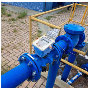
Foto 1 - Macromedidor no cavalete do poço.
