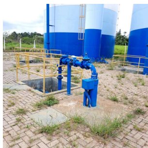
Foto 3 - Poço Jardim do Sol.
