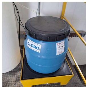
Foto 2 - Abrigo dos produtos químicos dentro da EEAT Jardim do Sol ao lado.
