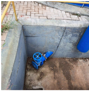
Foto 1 - Medidor de pressão do Sistema de telemetria.
