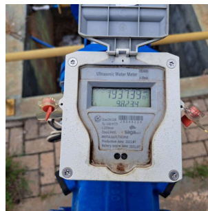
Foto 2 - Macromedidor no cavalete do poço.
