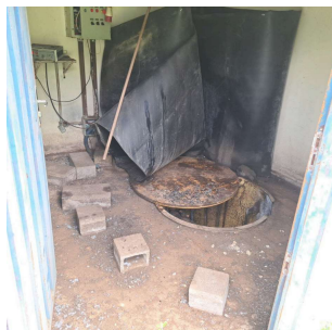
Foto 5 - Vista interna da EEEB, com detalhe para o painel elétrico e o poço onde está a bomba de recalque.
