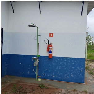
Foto 1 - Extintor de incêndio ao lado do chuveiro de emergência.
