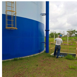
Foto 7 - Guarda-corpo da escada marinheiro e tubulação de chegada de água vinda do res. pulmão. Ao lado está o poço com registros para manobra.vatório maiores.
