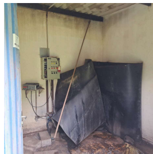
Foto 6 - Vista interna da EEEB, com detalhe para o painel elétrico.
