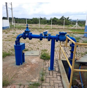
Foto 4 - Poço Jardim do Sol.
