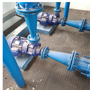
Foto 6 - Segundo conjunto motobomba (situado no meio)
