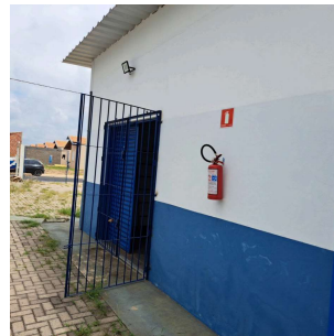
Foto 2 - Extintor de incêndio próximo à entrada da EEAT.
