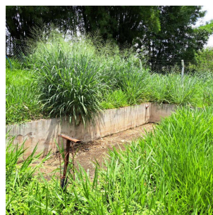
Foto 4 - Tanque pulmão da EEEB.
