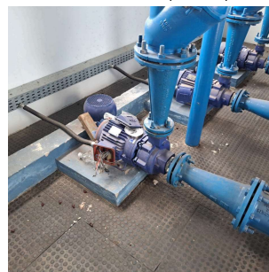
Foto 4 - Primeiro conjunto motobomba (próximo ao painel elétrico)
