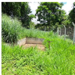
Foto 3 - Tanque pulmão da EEEB.
