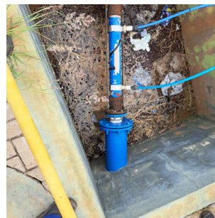
Foto 2 - Vazamento existente na tubulação do poço (detalhe para o local cheio de água)>
