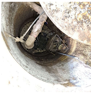
Foto 7 - Vista interna do poço de chegada do esgoto e da bomba de recalque.
