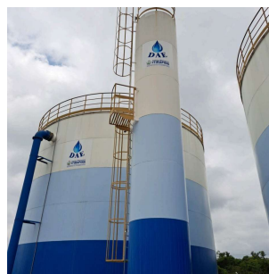
Foto 2 - Vista do reservatório pulmão (menor volume) e um dos de maior volume.
