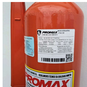
Foto 2 - Validade do extintor de incêndio vigente.
