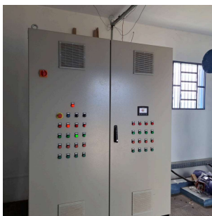
Foto 3 - Painel elétrico da EEAT.
