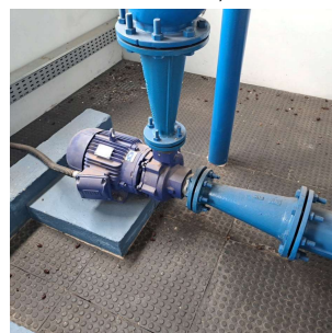
Foto 8 - Terceiro conjunto motobomba (o mais distante do painel elétrico)
