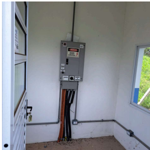
Foto 5 - Vista interna e do painel elétrico da EEB.
