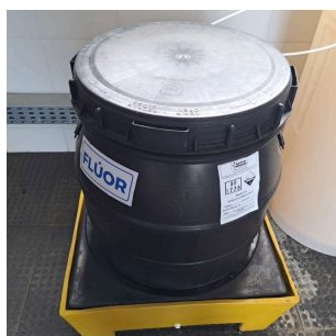
Foto 3 - Abrigo dos produtos químicos dentro da EEAT Jardim do Sol ao lado.
