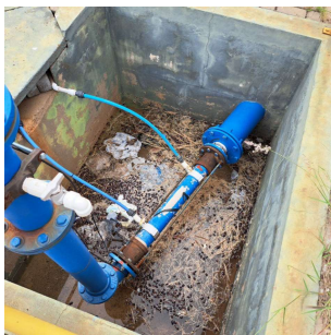
Foto 1 - Vazamento existente na tubulação do poço (detalhe para o local cheio de água)>
