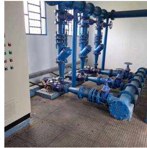
Foto 2 - Vista interna da EEAT, com 3 conjuntos motobomba (2+1R).
