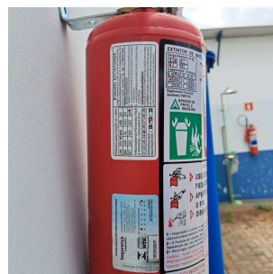
Foto 2 - Validade do extintor da entrada da EEAT.
