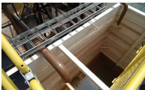
Foto 9 - Dosagem dos produtos químicos.
