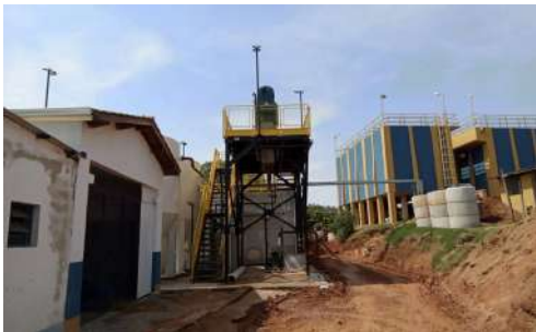
Foto 1 - Vista geral do sistema de tratamento de lodo.
