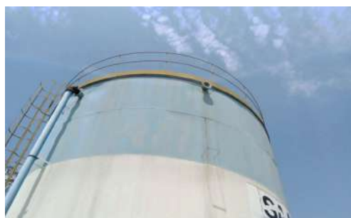
Foto 1 - Extravasador sem tela de proteção.
