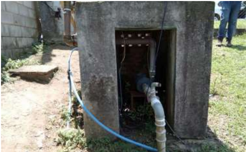
Foto 2 - Booster que substitui o reservatório.
