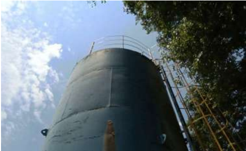
Foto 4 - Guarda-corpo do reservatório.
