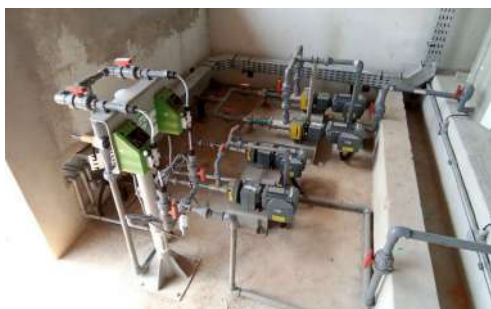
Foto 13 - Casa de química: sistema dosador.
