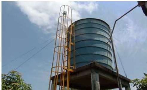
Foto 3 - Guarda-corpo do reservatório.
