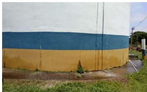
Foto 6 - Outros pontos de vazamento no reservatório (manchas).
