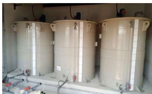
Foto 12 - Casa de química: tanques para polímero e adensador (sulfato).
