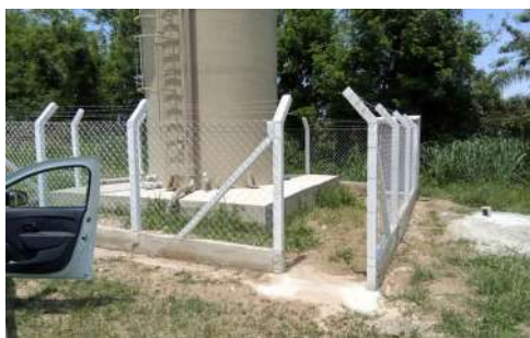
Foto 2 - Ausência de portão de acesso.
