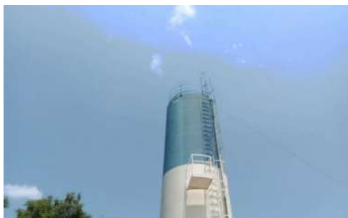
Foto 1 - Tubo extravasor do reservatório.
