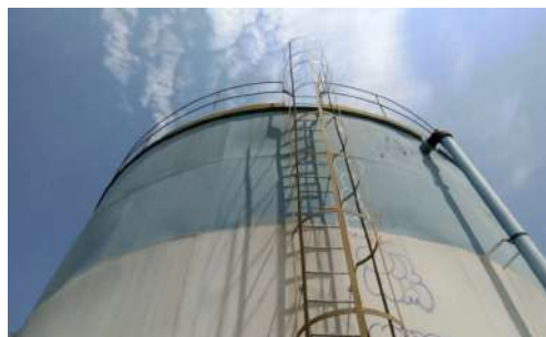
Foto 1 - Guarda-corpo do reservatório.
