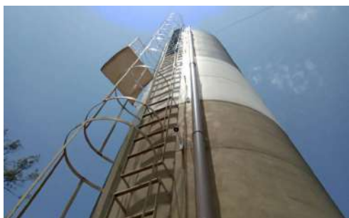
Foto 1 - Ausência de cabeamento para SPDA.
