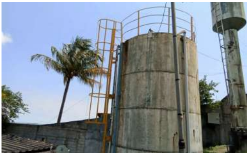
Foto 3 - Guarda-corpo do reservatório.
