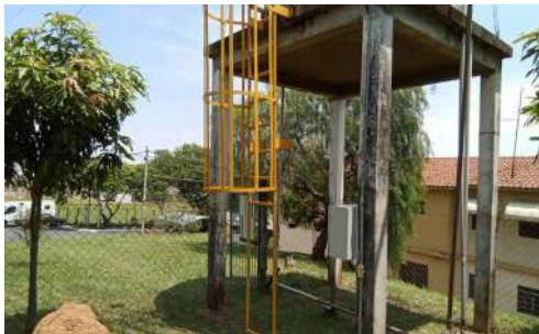
Foto 4 - Guarda-corpo do reservatório.
