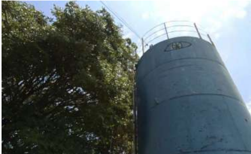
Foto 3 - Guarda-corpo do reservatório.
