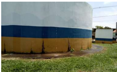
Foto 5 - Outros pontos de vazamento no reservatório (manchas).
