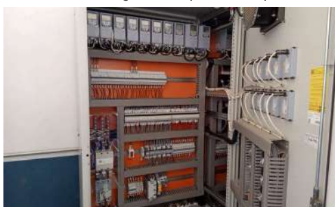
Foto 11 - Detalhe do paineleletrico.
