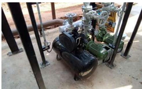
Foto 19 - Detalhe do compressor e sistema de bombeamento.
