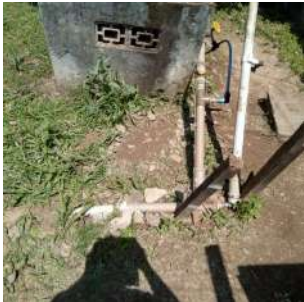
Foto 1 - Linha de recalque do booster.
