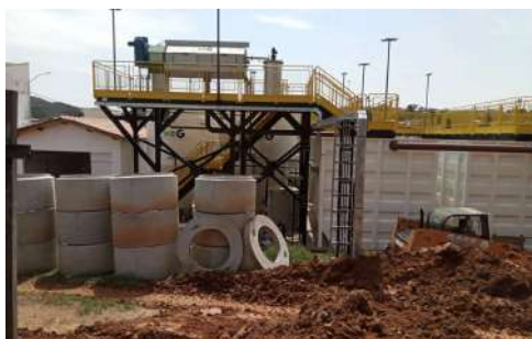
Foto 14 - Vista geral do sistema de tratamento de lodo.
