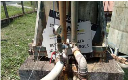
Foto 4 - Placas de identificação do local não afixadas.
