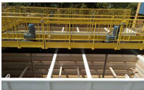
Foto 7 - Tanques de equalização.
