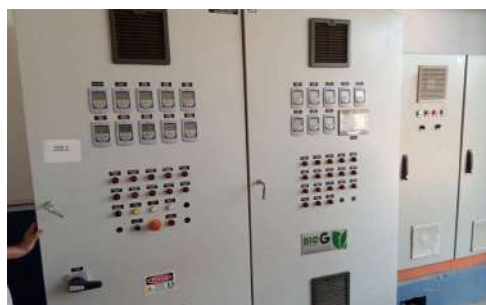
Foto 10 - Paineleletrico do sistema.
