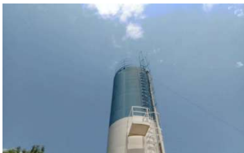
Foto 1 - Entravador sem tela de proteção.
