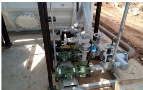
Foto 18 - Detalhe do compressor e sistema de bombeamento.
