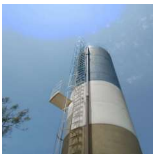
Foto 1 - Guarda-corpo do reservatório.
