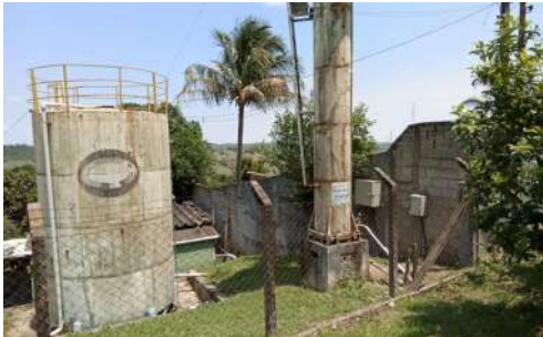
Foto 5 - Vista geral do sistema de reservação.
