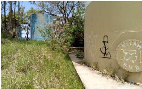
Foto 3 - Mato no entorno do reservatório.
