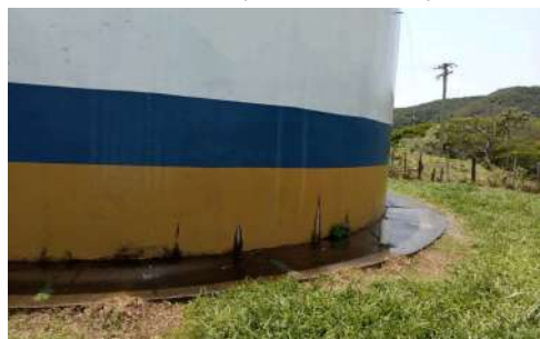
Foto 4 - Outros pontos de vazamento no reservatório (manchas).
