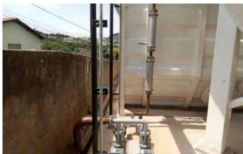
Foto 16 - Sistema de bombeamento do lodo equalizado.
