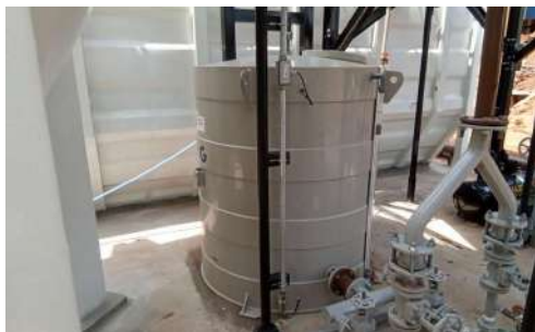
Foto 17 - Detalhe do sistema de tratamento.
