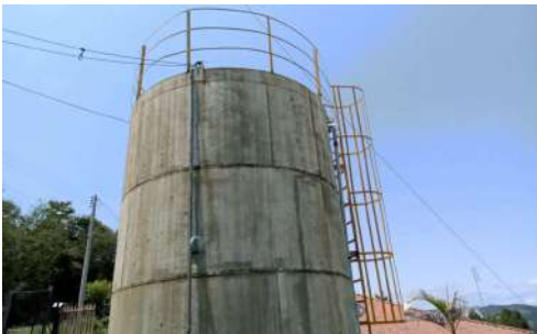
Foto 4 - Guarda-corpo do reservatório.
