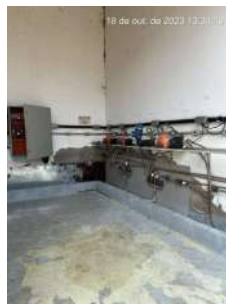
Foto 4 - Bombas de produtos
