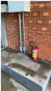
Foto 7 - Extintor de incêndio
