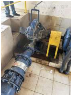
Foto 1 - Drenagem da gaxeta inadequada
