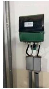
Foto 20 - Medidor de vazão saída
