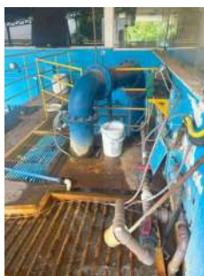
Foto 3 - Entrada de água bruta
