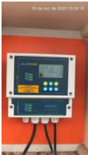
Foto 22 - Medidor de vazão de saída
