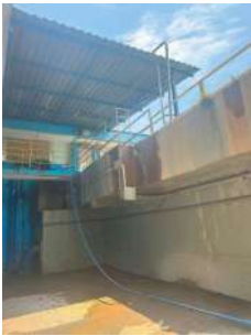
Foto 1 - Detalhe do vazamento
