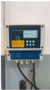
Foto 29 - Medidor de vazão
