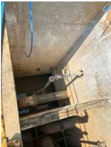
Foto 7 - Entrada de água
