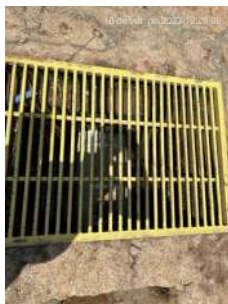
Foto 5 - Entrada de água bruta
