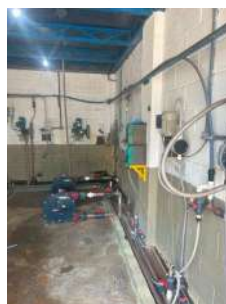
Foto 28 - bombeamento de poduto
