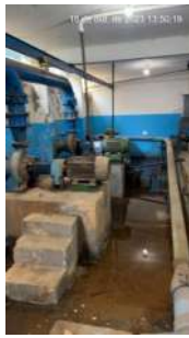
Foto 19 - Elevatória de água
