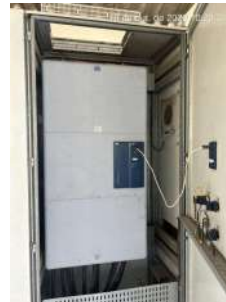
Foto 18 - Painele captação principal
