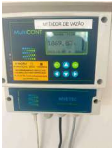
Foto 2 - Medidor de vazão de entrada
