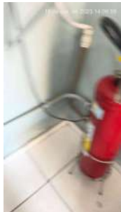
Foto 25 - Extintor de incêndio
