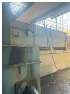
Foto 32 - Canaleta de entrada de água bruta
