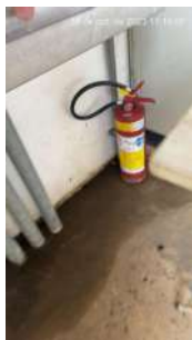
Foto 13 - Extintor de incêndio
