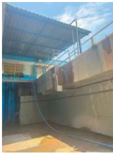
Foto 33 - Vista lateral do transbordamento
