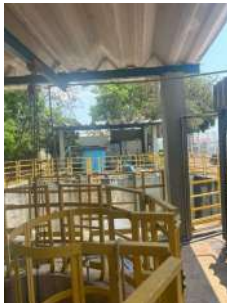
Foto 37 - Tanque de lodo
