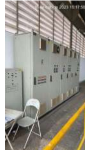
Foto 12 - Painéis da EEEB
