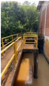
Foto 3 - Caixa da tomada d'água
