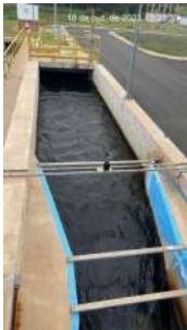
Foto 21 - Saída de esgoto tratado
