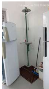
Foto 2 - chuveiro de emergência
