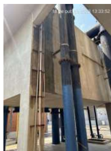
Foto 2 - Entrada de água bruta
