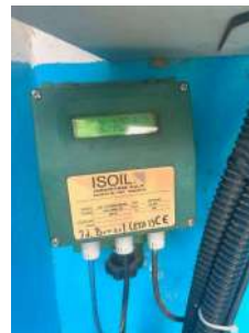
Foto 42 - medidor de vazão saída
