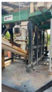
Foto 23 - Desidratação do lodo (inoperante)
