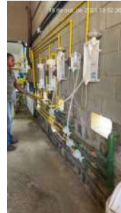
Foto 22 - Bombas de cloro
