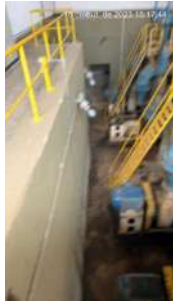
Foto 11 - Elevatória de esgoto bruto
