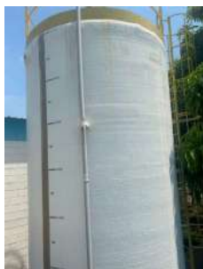
Foto 25 - Tanque de soda
