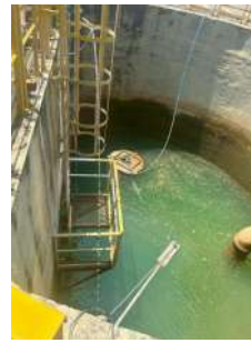
Foto 34 - Tanque de lodo
