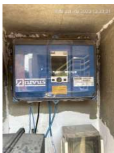
Foto 1 - Macromedidor de vazão
