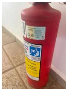
Foto 24 - Extintor de incêndio
