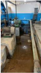
Foto 1 - Sala de bombas inundada
