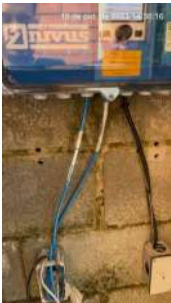
Foto 6 - Medidor de vazão
