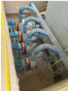
Foto 3 - Barrilete e bombas
