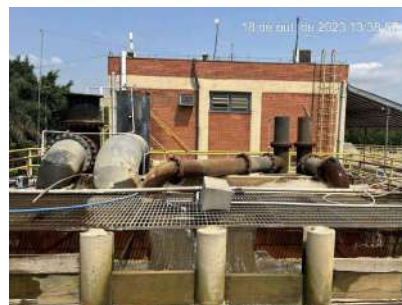
Foto 8 - Vista geral da entrada de água bruta
