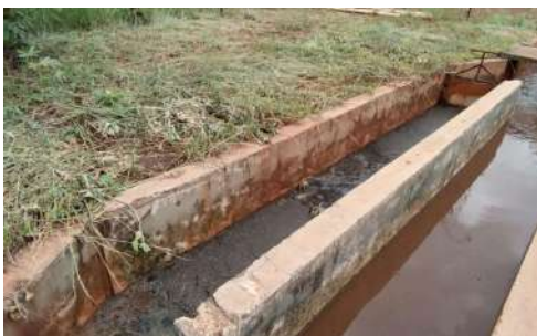
Foto 4 - Desarenadores do tratamento preliminar.
