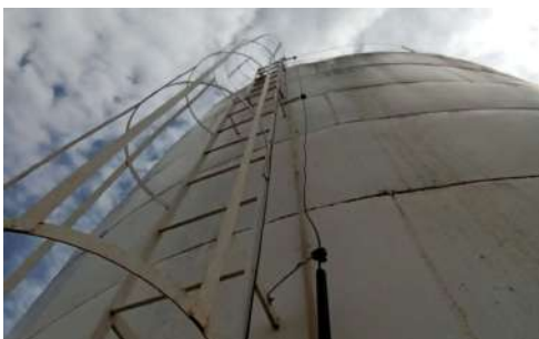
Foto 2 - Mangueira de medição de nível.
