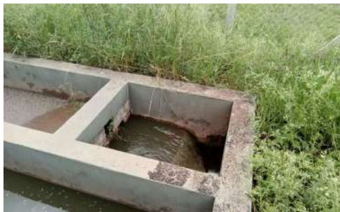
Foto 13 - Saída do tanque de contato.
