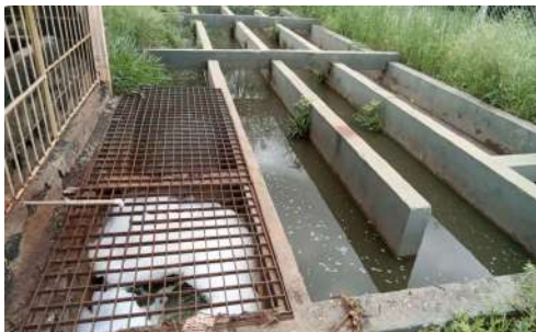
Foto 12 - Entrada do tanque de contato.
