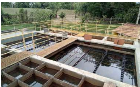
Foto 11 - Sistema de decantação.
