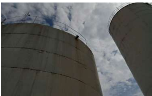
Foto 2 - Tela de proteção no extravasor.
