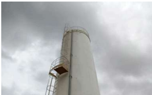
Foto 1 - Tubo extravasor do reservatório.
