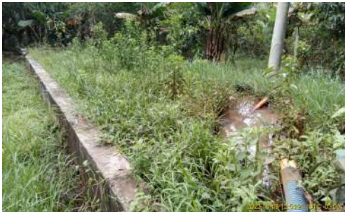
Foto 20 - Sistema de secagem de lodo parado.
