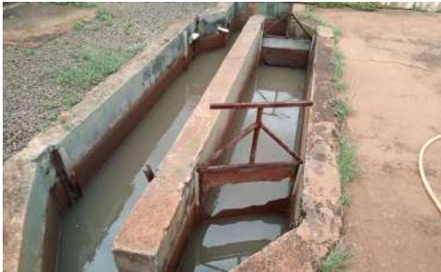
Foto 2 - Comportas do sistema de desarenação corroídas.
