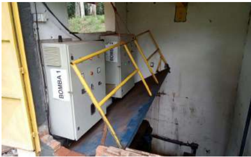
Foto 2 - Passarela solta e com risco de acidente.
