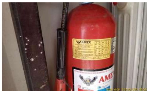
Foto 1 - Validade da manutenção.
