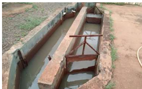
Foto 4 - Caixa de areia.
