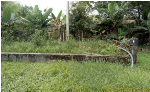
Foto 19 - Sistema de secagem de lodo parado.
