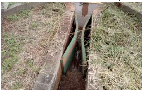
Foto 6 - Calha Parshall para medição de vazão.
