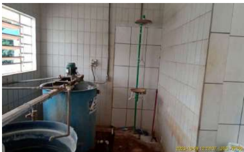
Foto 1 - Chuveiro de emergência.
