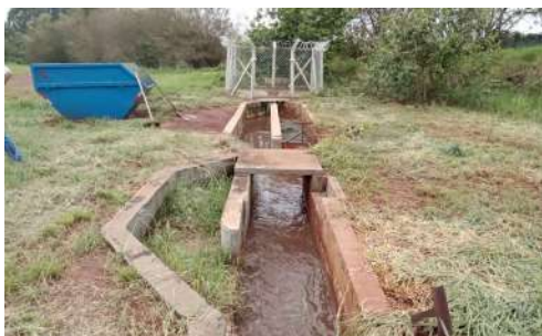
Foto 3 - Vista geral do tratamento preliminar.
