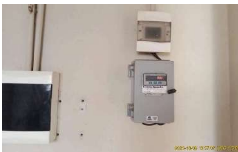
Foto 2 - Pannel de identificação da vazão.
