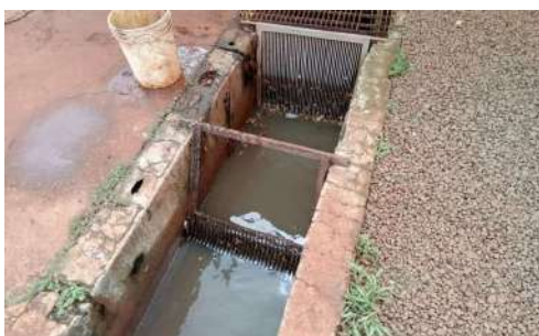
Foto 1 - Sistema de gradeamento.
