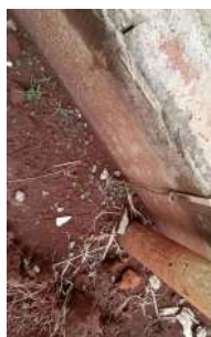
Foto 1 - Aterramento do SPDA.
