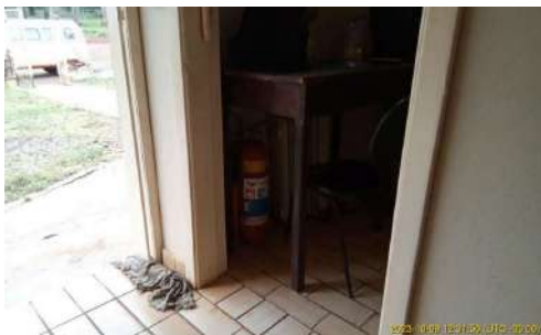
Foto 1 - Extintor da ETA e EEAT.
