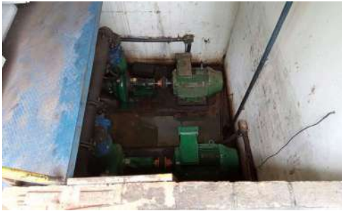
Foto 2 - Vista interna da EEAT.
