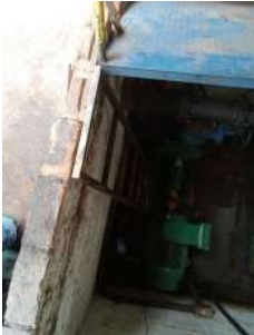
Foto 3 - Escada sem guarda-corpo.
