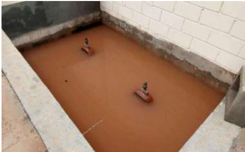
Foto 1 - Válvulas do sistema de recalque afogadas pela água pluvial.
