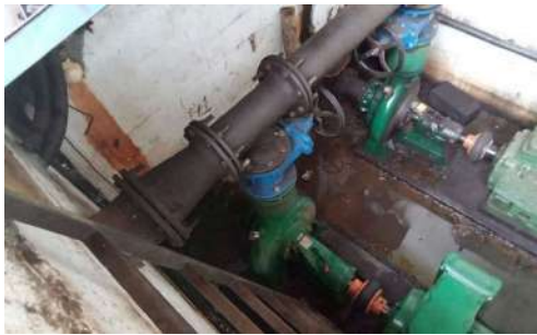
Foto 1 - Conduite preto à esquerda contendo infiltração de água de chuva.
