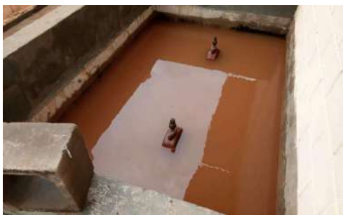
Foto 5 - Válvulas do sistema de recalque afogadas.
