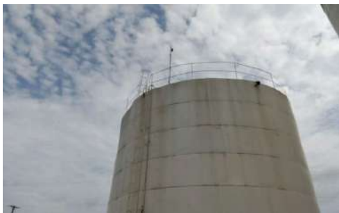
Foto 1 - Captor Franklin do reservatório.
