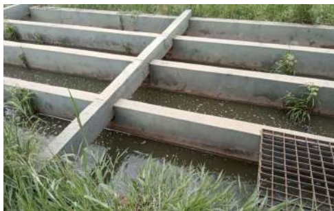
Foto 11 - Tanque de contato.
