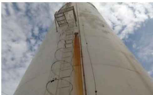
Foto 1 - Vazamento no corpo do reservatório.
