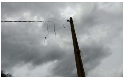
Foto 9 - Cabeamento elétrico das dosadoras de hipoclorito furtado.
