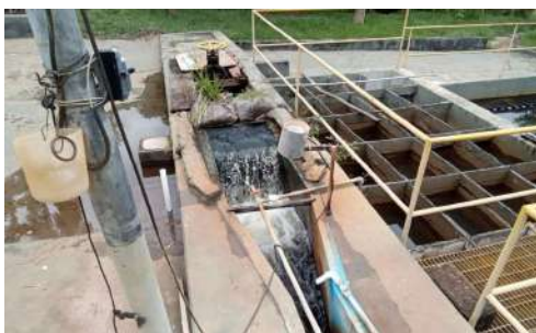
Foto 9 - Chegada da água bruta.
