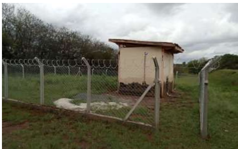
Foto 10 - Sistema de desinfecção.
