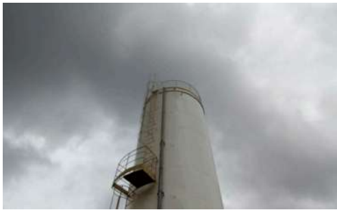
Foto 1 - Tela de proteção no extravasor.
