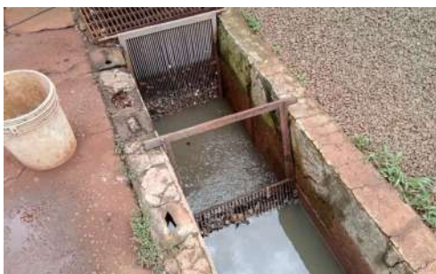
Foto 3 - Sistema de gradeamento.
