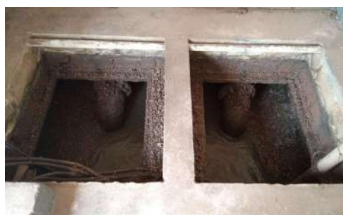
Foto 7 - Poço de sucção.
