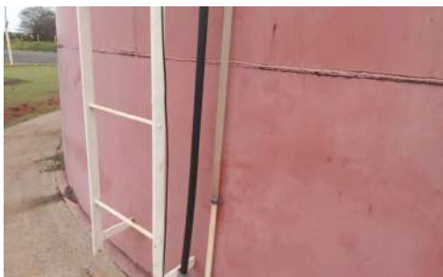
Foto 1 - Mangueira de medição de nível.
