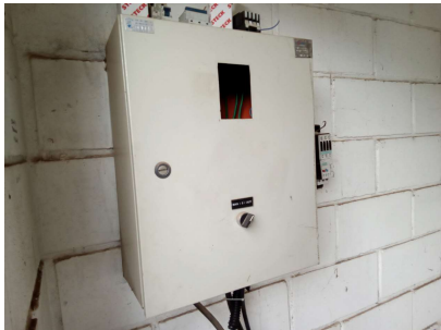
Foto 5 - Painele de comando e controle
