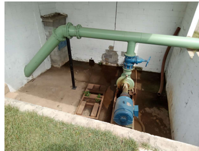
Foto 2 - Conjunto motor-bomba e barrilete
