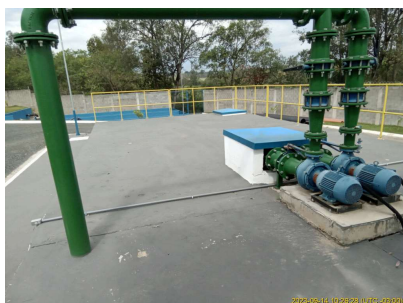
Foto 9 - Caixa de reúso
