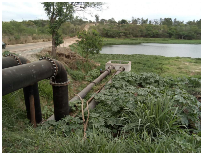
Foto 3 - Tomada de água bruta
