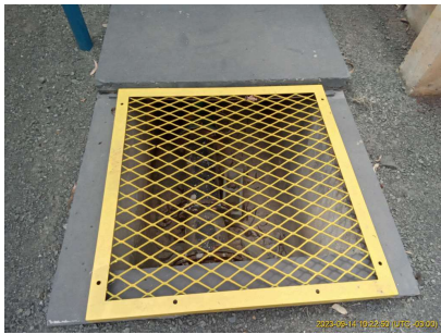
Foto 1 - Caixa do macromedidor
