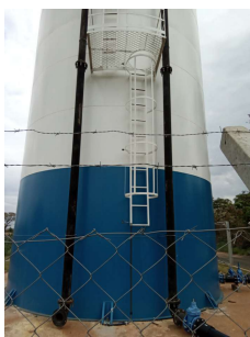
Foto 1 - Inexistência de para-raios
