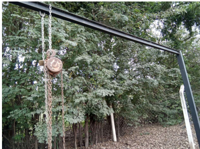
Foto 6 - Sistema de içamento da bomba submerssível
