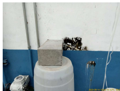
Foto 2 - Infiltrações na parede externa da ETA
