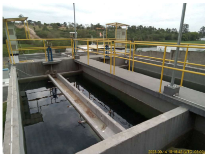
Foto 5 - Vista geral dos decantadores
