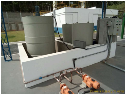
Foto 1 - Dosagem de produtos químicos
