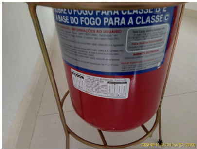
Foto 1 - Extintor de incêndio dentro do validade
