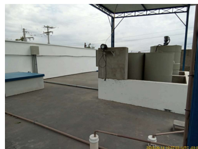
Foto 10 - Tanque de contato
