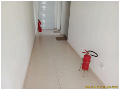
Foto 1 - Extintor de incêndio
