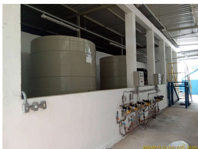
Foto 1 - Vista do armazenamento de produtos químicos, com bacia de contenção
