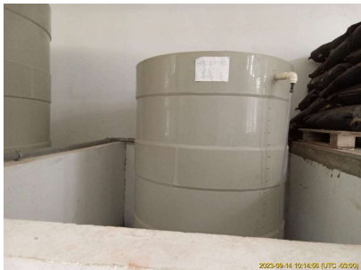
Foto 1 - Armazenamento do hipoclorito de sódio
