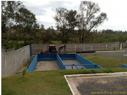
Foto 1 - Leitos de secagem de lodo
