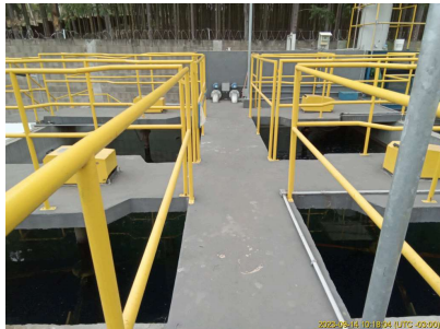
Foto 3 - Vista geral dos floculadores
