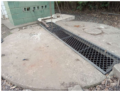
Foto 4 - Poço de sucção
