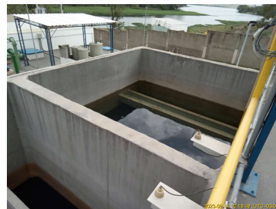
Foto 6 - Vista geral dos filtros
