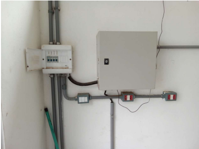
Foto 4 - Painel de comando e controle
