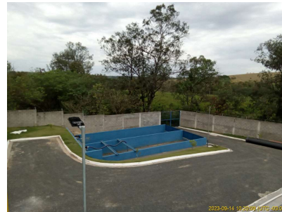
Foto 8 - Vista superior dos leitos de secagem de lodo
