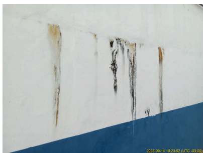
Foto 1 - Infiltrações na parede externa da ETA
