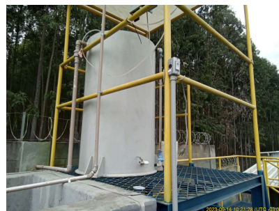
Foto 3 - Armazenamento e dosagem de PAC
