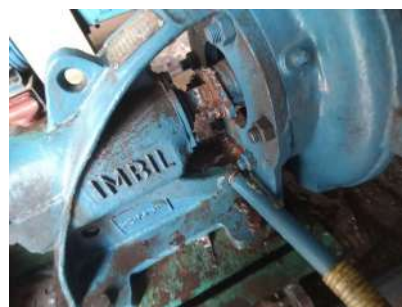
Foto 2 - Drenagem da bomba 1.
