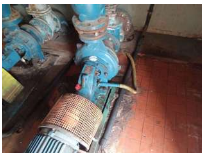
Foto 1 - Drenagem da bomba 1.
