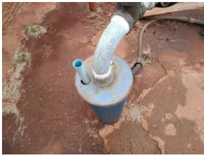
Foto 1 - Tubo de nível do poço.
