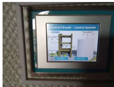
Foto 2 - Medidor local de nível.
