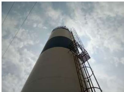
Foto 1 - Guarda-corpo do reservatório.
