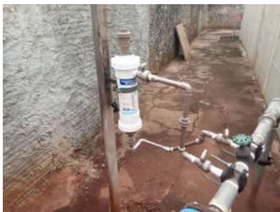
Foto 1 - Sistema de dosagem química.
