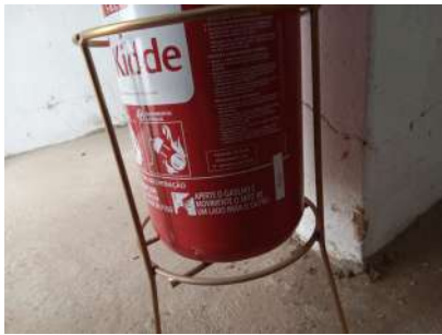
Foto 1 - Extintor na validade.
