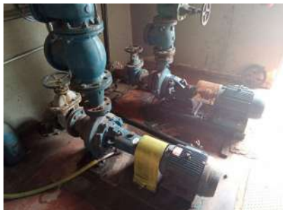
Foto 3 - Sistema de bombeamento da EEAT.
