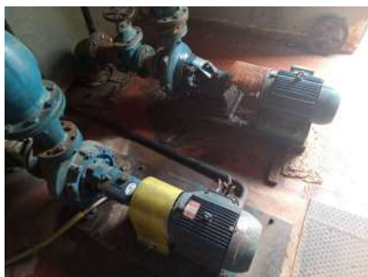
Foto 1 - Dois conjuntos moto bomba fucionando alternadamente.
