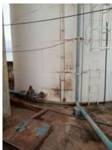
Foto 1 - Medidor físico de nível.
