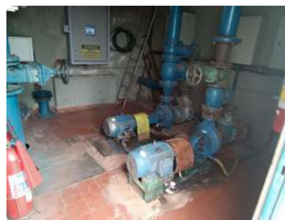
Foto 2 - Sistema de bombeamento da EEAT.
