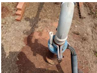
Foto 1 - Tubo de nível do poço.
