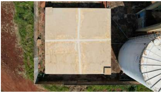
Foto 1 - Ausência de tubulação de ventilação. Imagem retirada com o drone em 14/10/2022.
