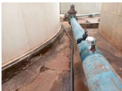
Foto 1 - Vazamento na torneira da tubulação de distribuição.
