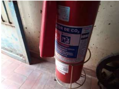
Foto 3 - Extintor de CO2.
