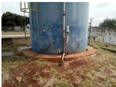
Foto 1 - Sistema de dosagem química na entrada do reservatório.
