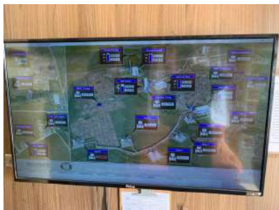
Foto 1 - Painel geral do CCO.
