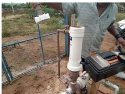
Foto 1 - Sistema de dosagem química.
