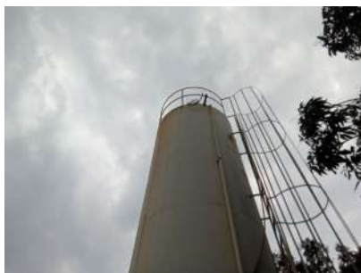
Foto 1 - Extravasor sem tela de proteção.
