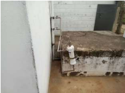
Foto 4 - Sistema de cloração e fluoretação do poço Sete Fogões.
