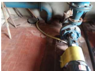
Foto 3 - Drenagem da bomba 2.
