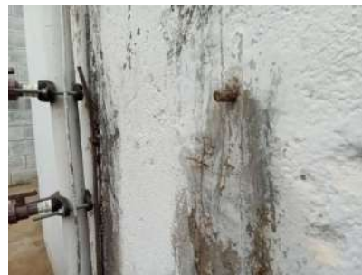
Foto 2 - Vazamento em furo na parede.
