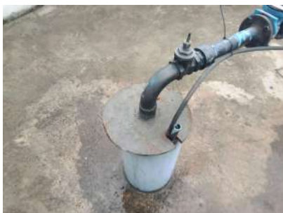
Foto 1 - Tubo de nível do poço.
