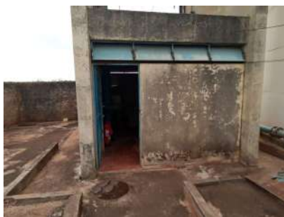
Foto 1 - Vista externa da EEAT.
