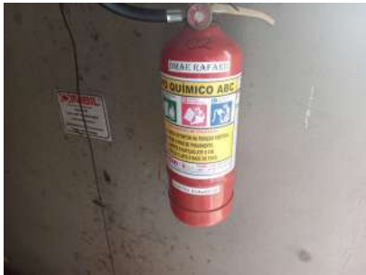
Foto 2 - Extintor de pó químico.
