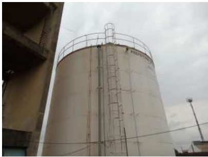
Foto 1 - Tubulação escura: extravasor do reservatório.
