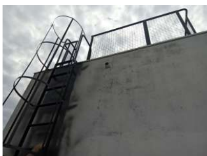
Foto 1 - Extravasor sem tela de proteção.
