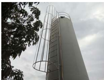
Foto 1 - Guarda-corpo do reservatório.
