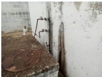
Foto 1 - Vazamento em furo na parede.
