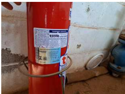
Foto 1 - Validade do extintor.
