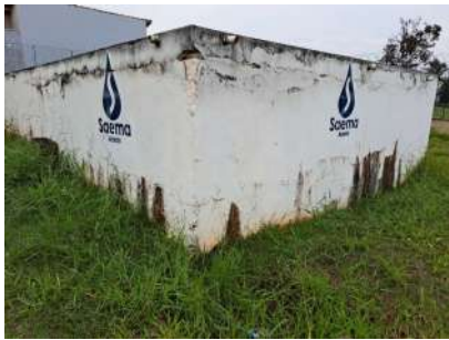
Foto 1 - Vazamentos nas laterais do reservatório.
