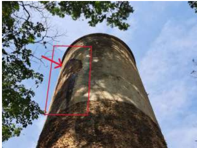
Foto 3 - Detalhe para o local de vazamento na lateral do reservatório.
