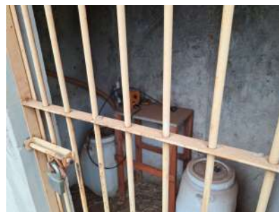
Foto 4 - Vista interna do abrigo de produtos químicos e bombas dosadoras.
