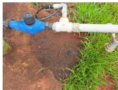
Foto 2 - Laje de proteção molhada pelo vazamento.
