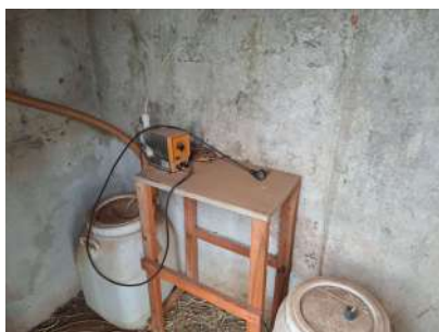
Foto 1 - Bomba dosadora desligada.
