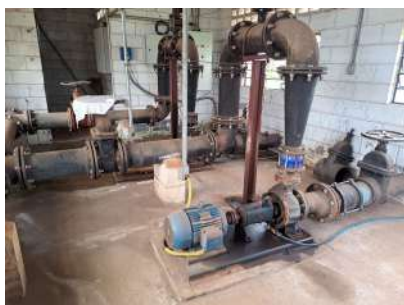
Foto 4 - Vista geral dos conjuntos motobomba da EEAT.
