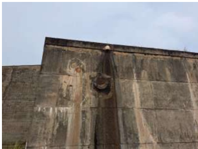
Foto 1 - Saída do tubo extravasor com tela de abertura grande.
