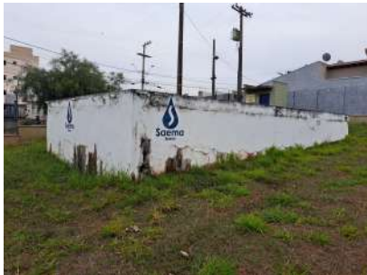
Foto 4 - Vazamentos nas laterais do reservatório.
