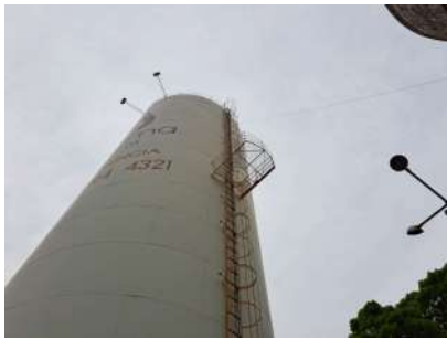
Foto 1 - Fio condutor de descida cortado.
