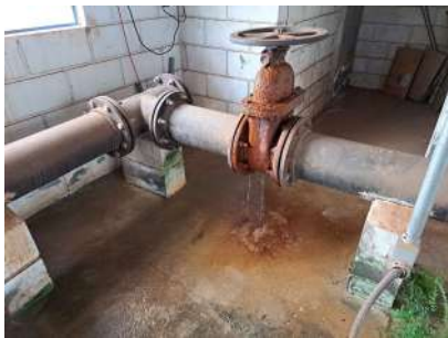
Foto 2 - Vazamento no registro da tubulação do segundo conjunto motobomba.
