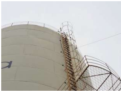
Foto 2 - Fio condutor de descida cortado.
