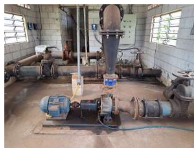
Foto 3 - Vista geral dos conjuntos motobomba da EEAT.
