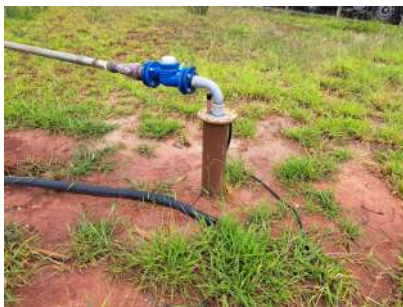
Foto 1 - Ausência de laje de proteção.
