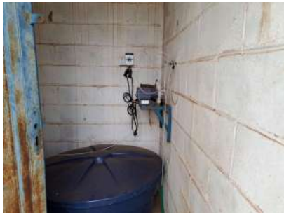
Foto 2 - Bombas dosadoras de cloro e flúor.
