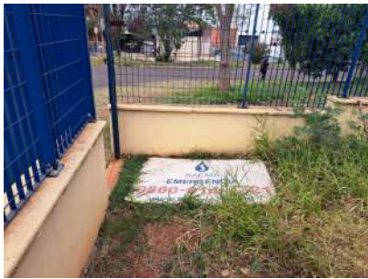
Foto 1 - Placa de identificação caída.
