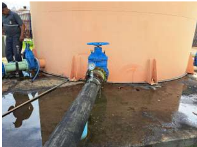
Foto 1 - Manômetro instalado na tubulação de saída do reservatório.
