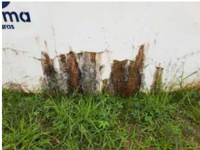
Foto 3 - Vazamentos nas laterais do reservatório.
