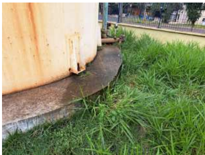
Foto 2 - Local onde a água dos vazamentos cai na base do reservatório.
