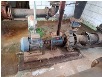
Foto 8 - Segundo conjunto motobomba da EAT.
