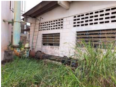
Foto 9 - Tubulação de saída da EAT.
