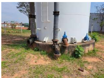
Foto 5 - Tubulações e registros do reservatório elevado.
