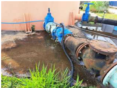
Foto 1 - Vazamento na mangueira do registro do reservatório.
