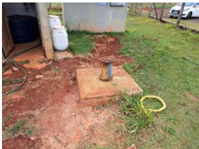
Foto 3 - Antigo Poço do Distrito Industrial V que foi desativado.
