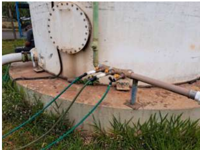
Foto 1 - Mangueiras do sistema de cloração e fluoretação.
