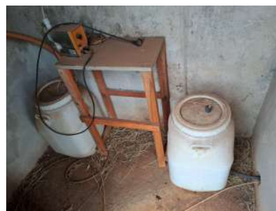
Foto 2 - Bomba dosadora desligada e um dos tanques não acoplado.
