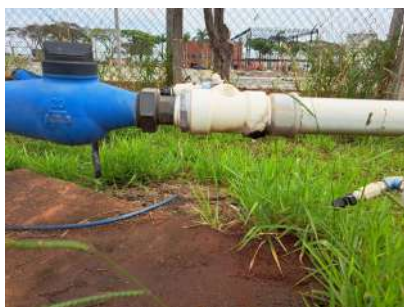
Foto 1 - Detalhe do vazamento.
