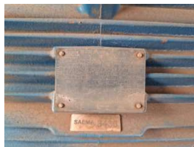
Foto 6 - Placa de especificações técnicas do motor do primeiro conjunto motobomba.
