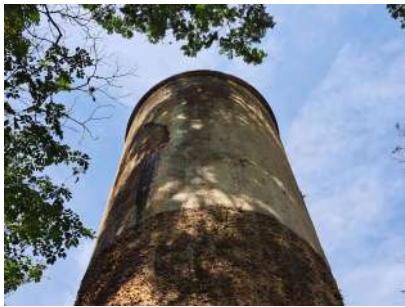
Foto 2 - Sinal de vazamento na lateral do reservatório.
