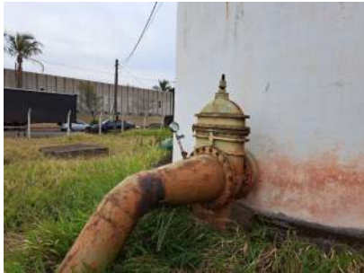
Foto 4 - Manômetro na tubulação de saída do reservatório.
