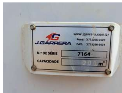
Foto 6 - Placa de especificações técnicas do reservatório elevado.
