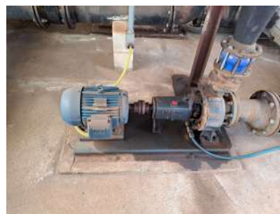
Foto 5 - Primeiro conjunto motobomba da EEAT.
