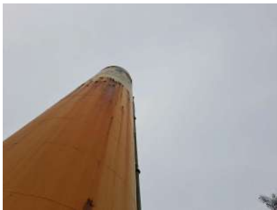
Foto 1 - Pontos com vazamentos no reservatório elevado.
