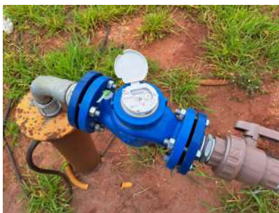
Foto 1 - Macromedidor no cavalete do poço.
