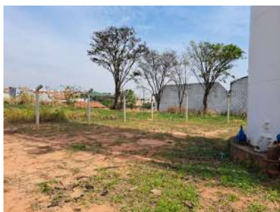
Foto 1 - Ausência de cercamento do local.
