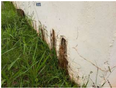
Foto 2 - Vazamentos nas laterais do reservatório.
