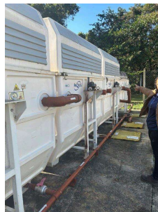
Foto 4 - 4 módulos RBC e 1 decantador
