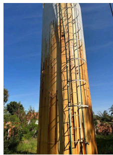
Foto 2 - Reservatório em péssimo estado de conservação
