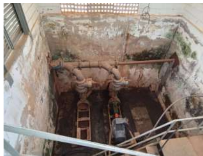
Foto 2 - Vista do sistema de bombeamento.
