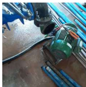
Foto 2 - Vazamento junto ao bocal.
