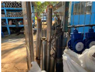
Foto 1 - Bombas reservas dos poços.
