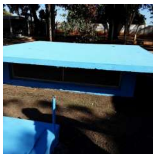
Foto 1 - Sistema de ventilação do reservatório.
