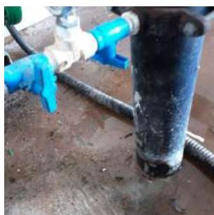
Foto 1 - Vazamento junto ao registro da coleta de água bruta do poço.
