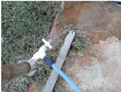
Foto 1 - Tomada de água para coleta de água bruta do poço.
