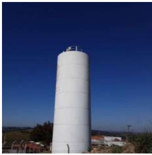
Foto 1 - Inexistência de SPDA.
