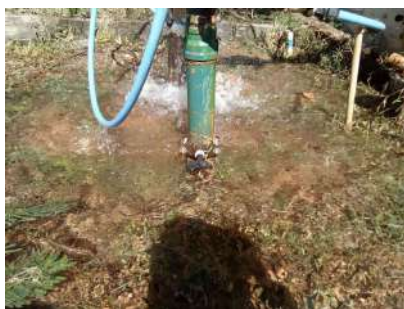
Foto 1 - Tomada de água para coleta de água bruta do poço.
