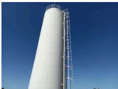
Foto 1 - Descida do tubo extravasor.
