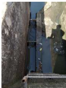
Foto 1 - Gradeamento grosso parcialmente obstruído.
