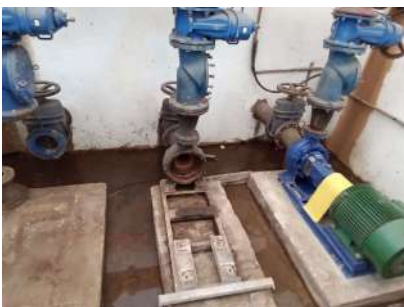
Foto 6 - Vista do sistema de bombeamento da EEEB.
