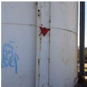
Foto 1 - Medidor de nível do reservatório.
