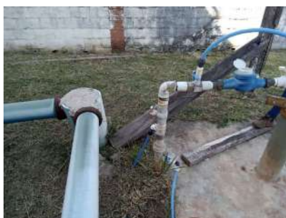
Foto 1 - Sistema de dosagem em linha.
