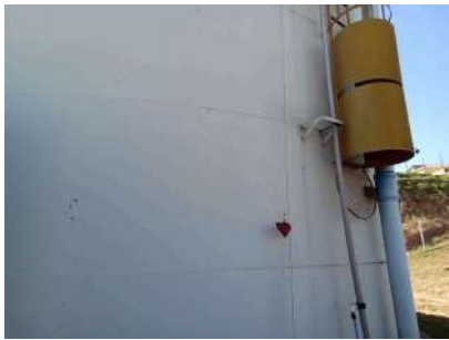
Foto 1 - Medidor de nível do reservatório.
