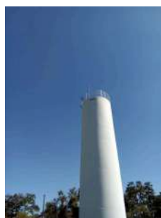
Foto 2 - Captador tipo Franklin.
