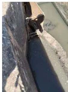
Foto 2 - Gradeamento fino parcialmente obstruído.
