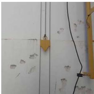
Foto 1 - Medidor de nível do reservatório.
