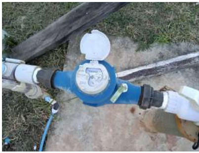
Foto 1 - Macromedidor do poço.
