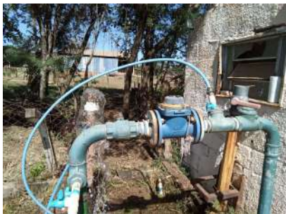
Foto 1 - Macromedidor do poço.
