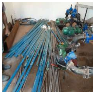
Foto 1 - Material depositado no interior da EEA.
