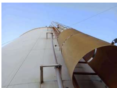
Foto 1 - Falta de cabeamento de SPDA.
