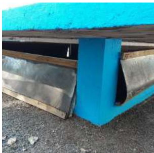
Foto 1 - Tela de proteção desencaixada.
