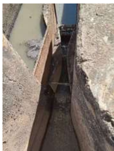
Foto 3 - Gradeamento fino parcialmente obstruído.
