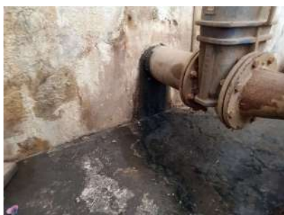
Foto 1 - Vazamento entre a tubulação de sucção e a parede do poço.
