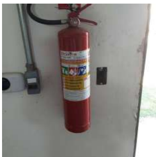
Foto 1 - Extintor da EEA.
