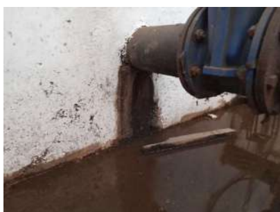
Foto 1 - Vazamento entre a tubulação de sucção e a parede do poço.
