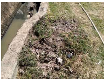
Foto 1 - Realizar a disposição adequada de resíduos sólidos removidos do sistema de gradeamento.
