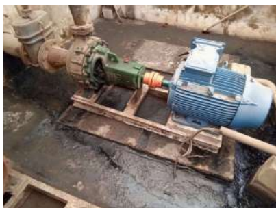
Foto 3 - Vista da bomba de EEEB.
