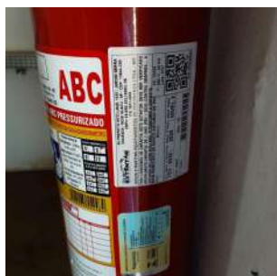
Foto 1 - Validade do extintor da EEA.
