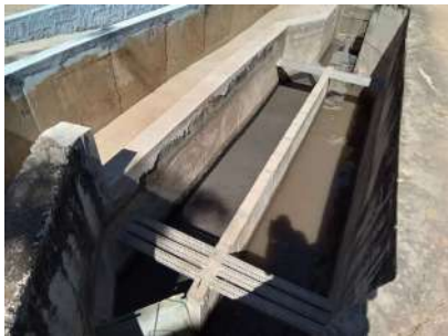
Foto 1 - Realizar a limpeza da caixa de areia com disposição adequada dos resíduos.
