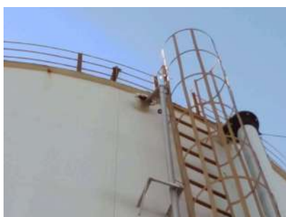
Foto 1 - Abertura sem tela de proteção.
