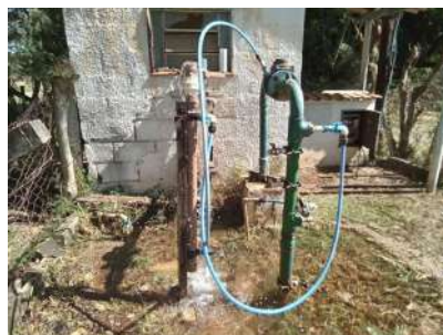
Foto 2 - Sistema de dosagem química.
