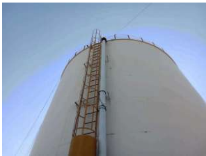
Foto 1 - Descida do tubo extravasor.
