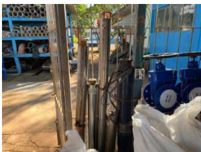
Foto 1 - Bombas reservas dos poços.
