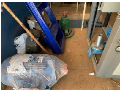
Foto 1 - Motor e bomba reserva à esquerda.
