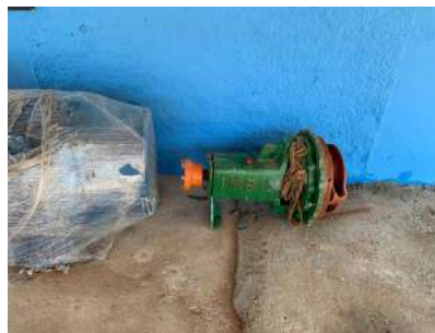
Foto 2 - Bomba reserva da EEEB.
