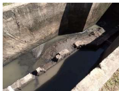
Foto 2 - Realizar a limpeza da caixa de areia com disposição adequada dos resíduos.
