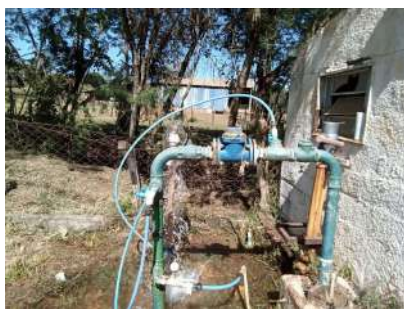
Foto 1 - Vazamento no sistema de cloração.
