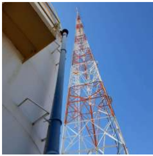
Foto 1 - Antena com SPDA ao lado do reservatório.
