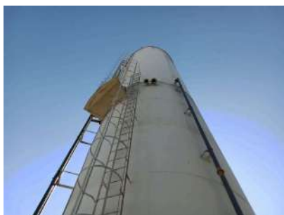
Foto 1 - Aberturas sem tela de proteção.
