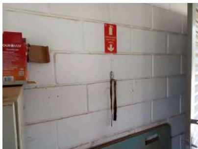
Foto 1 - Local sem extintor.
