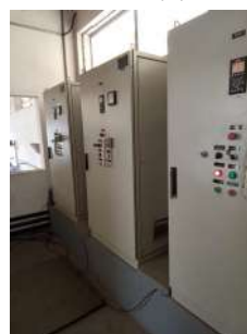
Foto 16 - Painéis de controle Captação Barragem das Figueiras
