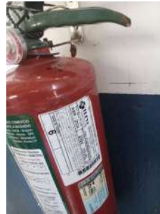
Foto 12 - Extintor de incêndio com validade regular
