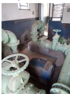
Foto 5 - Conjuntos motobomba - reserva instalada
