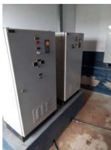
Foto 4 - Painéis elétricos da EEA Palmares
