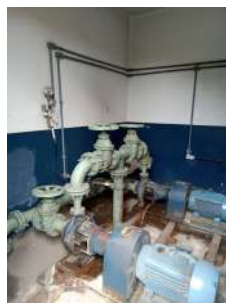
Foto 4 - Conjuntos Motobomba - reserva instalada - EEA Invernada
