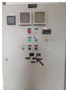
Foto 8 - Painel elétrico de controle do sistema
