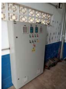
Foto 7 - Painéis de elétricos de controle EE VIVENDA DOS PÁSSAROS
