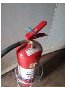
Foto 5 - Extintor de incêndio - Reservatório Sans Souci
