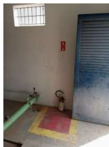
Foto 6 - Local de instalação do extintor de incêndio
