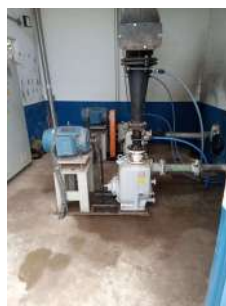
Foto 6 - Conjuntos motobomba com reserva instalada EE VIVENDA DOS PÁSSAROS
