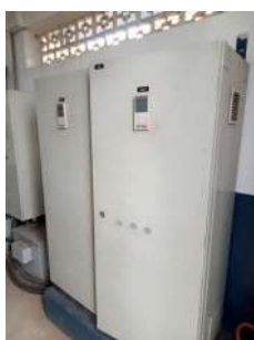
Foto 5 - Painéis elétricos - EEA Invernada
