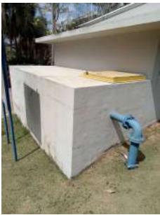
Foto 2 - Visão geral - Reservatório San Marino
