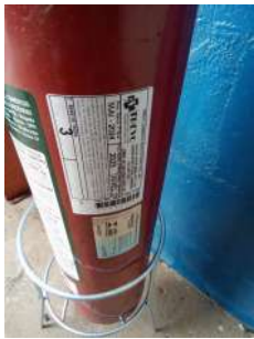
Foto 9 - Validade regular do extintor de incêndio EE VIVENDA DOS PÁSSAROS
