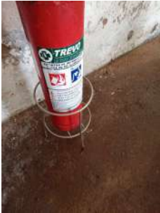
Foto 5 - Extintor de Incêndio - San Marino
