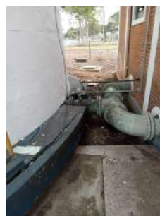
Foto 4 - Manômetro Reservatório e tubulação dos conjuntos motobomba
