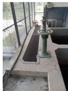
Foto 10 - Captação Captação Barragem das Figueiras (2)
