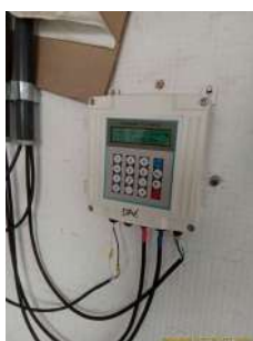
Foto 5 - Medidor de vazão - saída para distribuição - RESERVATÓRIO ETA 1 SEMIENTERRADO (R4)
