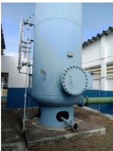
Foto 4 - Vaso de pressão Captação Barragem das Figueiras
