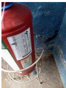
Foto 6 - Extintor de incêndio - validade regular - EEA Palmares
