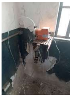
Foto 9 - Bomba injetora de hipoclorito de sódio
