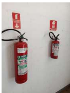
Foto 17 - Localização de extintores internos Captação Barragem das Figueiras
