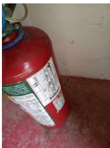
Foto 7 - Validade regular do extintor de incêndio
