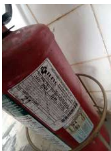
Foto 1 - Validade regular do extintor de incêndio
