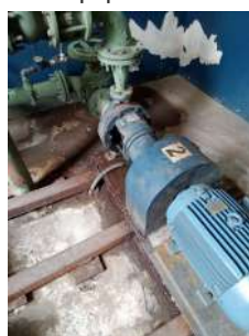
Foto 4 - Evidência de vazamento Bomba 2
