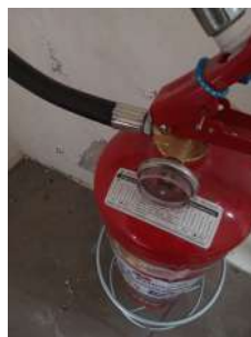
Foto 5 - Validade regular - extintor de incêndio - EA IPÊ DOURADO
