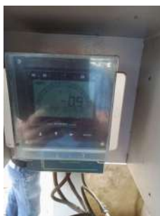
Foto 15 - Leitor do medidor de vazão
