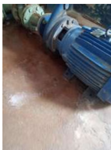
Foto 1 - Vazamento a partir do conjunto motobomba - EEA Palmares
