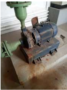
Foto 2 - Evidência de corrosão da base da bomba
