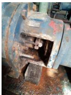
Foto 1 - Detalhe do acúmulo de água e estado de conservação
