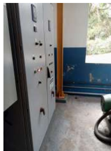
Foto 4 - Pannel elétrico EA Colina dos Pinheiros
