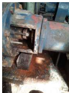
Foto 2 - Acúmulo de água na base do equipamento
