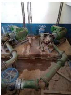
Foto 1 - Chão molhado sob conjuntos motobomba
