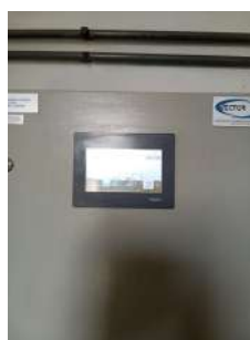
Foto 6 - Pannel de telemetria - EEA Invernada
