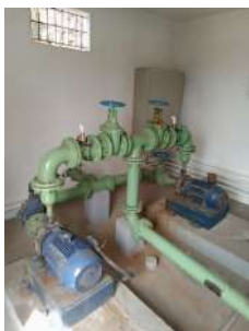
Foto 5 - Conjuntos motobomba - reserva instalada
