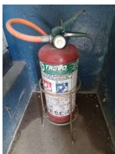
Foto 7 - Extintor de incêndio - EEA Invernada
