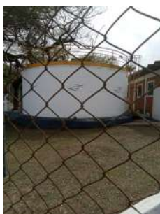
Foto 3 - Visão externa - Reservatório junto à EA Poços Profundos
