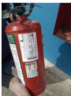
Foto 15 - Validade regular extintor de incêndio Captação Barragem das Figueiras
