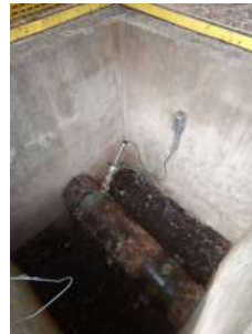
Foto 14 - Medidor de vazão inserção eletromagnético
