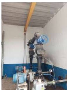
Foto 5 - Acesso para manutenção de bombas EE VIVENDA DOS PÁSSAROS
