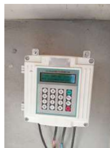
Foto 12 - Medidor de vazão na Captação Barragem das Figueiras
