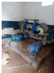
Foto 7 - Conjuntos motobomba - reserva instalada - EEA Palmares
