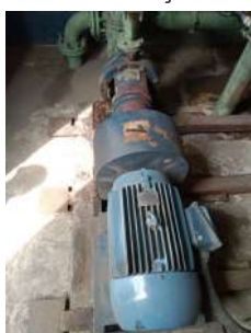
Foto 3 - Indícios de vazamento Bomba 1
