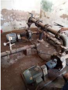
Foto 4 - Conjuntos motobomba - reserva instalada - San Marino
