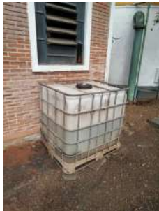
Foto 13 - Tanque de hipoclorito de sódio para dosagem no reservatório
