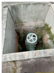
Foto 2 - Válvula - entrada - RESERVATÓRIO ETA 1 SEMIENTERRADO (R4)
