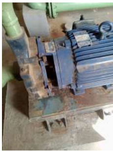
Foto 1 - Presença de umidade e corrosão da base.
