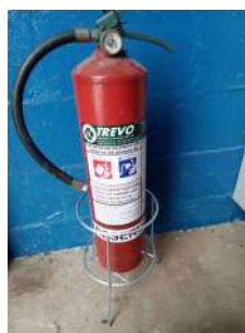
Foto 8 - Extintor de incêndio EE VIVENDA DOS PÁSSAROS
