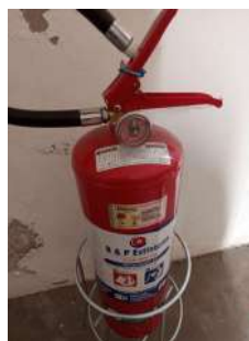
Foto 4 - Extintor de incêndio - EA IPÊ DOURADO
