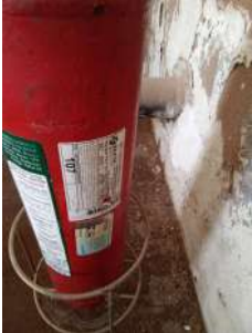
Foto 6 - Extintor de incêndio - validade regular - San Marino
