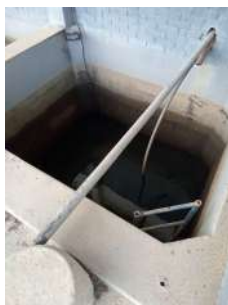
Foto 9 - Captação Captação Barragem das Figueiras
