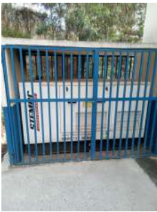
Foto 10 - Gerador de energia EE VIVENDA DOS PÁSSAROS
