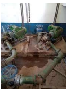
Foto 19 - Conjuntos motobomba instalados
