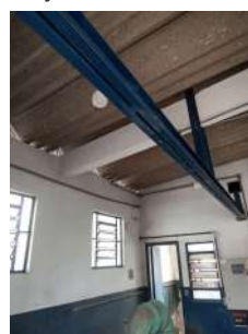
Foto 6 - Acesso para retirada dos conjunto motobomba para manutenção
