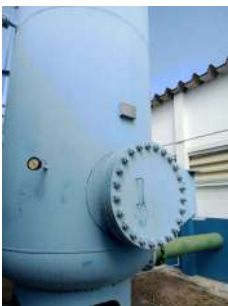
Foto 5 - Vaso de pressão e manômetro Captação Barragem das Figueiras
