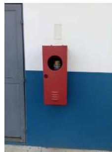
Foto 8 - Extintor de incêndio Captação Barragem das Figueiras - segundo ponto
