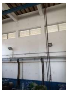
Foto 20 - Acesso para retirada dos conjuntos motobomba para manutenção Captação Barragem das Figueiras
