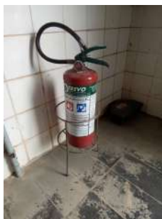
Foto 1 - Extintor de incêndio - EA Colina dos Pinheiros
