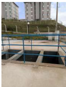
Foto 3 - Guarda-corpos na chega do esgoto EE VIVENDA DOS PÁSSAROS
