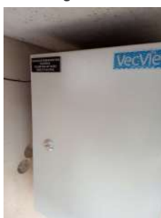
Foto 13 - Sistema de telemetria de vazão ao DAEE
