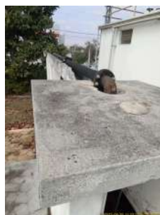
Foto 4 - Tubulação para abastecimento de caminhão pipa RESERVATÓRIO ETA 1 SEMIENTERRADO (R4)
