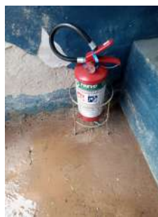
Foto 5 - Extintor de incêndio - EEA Palmares
