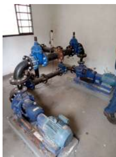
Foto 3 - Conjuntos motobomba - reserva instalada - EA IPÊ DOURADO
