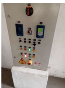
Foto 6 - Painelelétrico - EA IPÊ DOURADO
