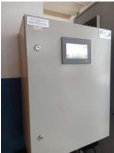
Foto 2 - Painel elétrico EA Colina dos Pinheiros
