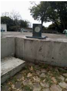
Foto 2 - Manômetro Reservatório ETA 1 R7
