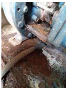
Foto 5 - Detalhe de acúmulo de água na base do equipamento, apesar da existência de um dreno.
