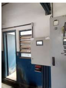
Foto 7 - painel elétrico e de telemetria
