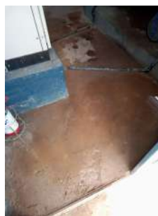
Foto 2 - Chão alagado devido ao vazamento - EEA Palmares
