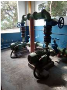
Foto 1 - Conjunto motobomba - reserva instalada - EA Colina dos Pinheiros
