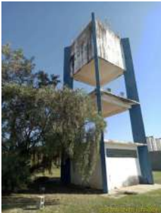
Foto 1 - Marcas de vazamento no RES - CRD - SÃO RAFAEL - RESERV. ELEVADO
