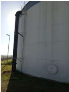
Foto 4 - Medidor de nível mecânico e extravasor RES - CRD - FEAC - RESERV. APOIADO
