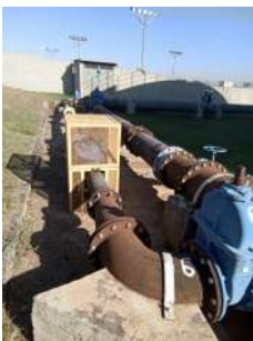
Foto 2 - Tubulação adutora RES - CRD - FEAC - RESERV. APOIADO
