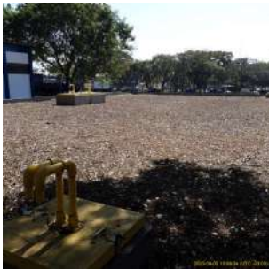
Foto 2 - Ventilação Reservatório Anchieta Enterrado A
