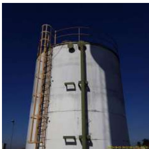
Foto 1 - Tubo extravasor no Reservatório
