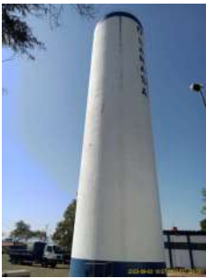
Foto 4 - Visão geral e Marcas de pequenos vazamentos no RES - CRD - PADRE ANCHIETA - RESERV. ELEVADO
