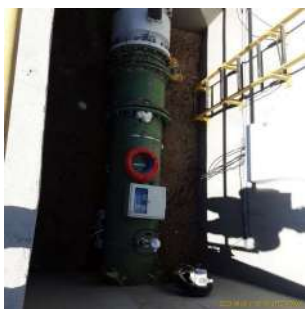
Foto 5 - Adutora chegada RES - CRD - PADRE ANCHIETA - RESERV. APOIADO B
