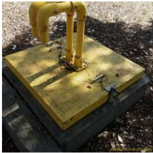
Foto 1 - Tampas de inspeção
