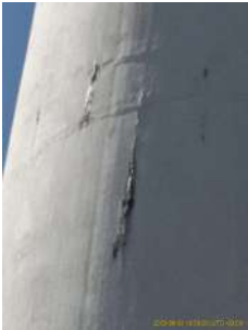
Foto 5 - Marcas de pequenos vazamentos no RES - CRD - PADRE ANCHIETA - RESERV. ELEVADO
