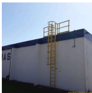
Foto 2 - Guarda-corpos instalados RES - CRD - PADRE ANCHIETA - RESERV. APOIADO B (2)
