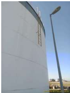
Foto 1 - Reservatório sem acesso a parte superior. Escada sem guarda-corpos
