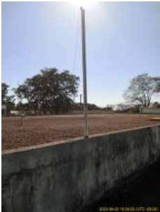
Foto 5 - Medidor de nível mecânico RES - CRD - PUCC - RESERV. SEMIENTERRADO
