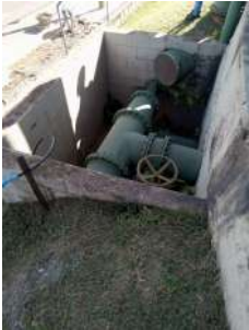
Foto 3 - Tubulação de saída para rede de distribuição e ponto de amostragem de água
