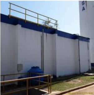
Foto 2 - Medidor mecânico de nível - RES - CRD - PADRE ANCHIETA - RESERV. APOIADO B
