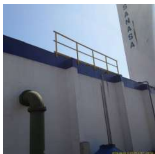
Foto 1 - Guarda-corpos instalados RES - CRD - PADRE ANCHIETA - RESERV. APOIADO B
