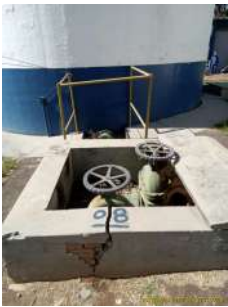
Foto 3 - Detalhe de alvenaria trincada no RES - CRD - PADRE ANCHIETA - RESERV. ELEVADO
