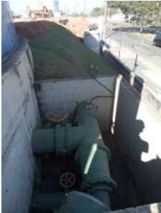
Foto 4 - Tubulação de saída para rede de distribuição e ponto de amostragem de água (2)
