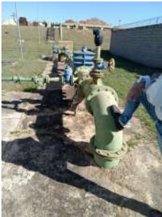
Foto 1 - Tubulação adutora RES - CRD - SÃO RAFAEL - RESERV. ELEVADO
