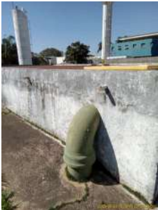
Foto 4 - ventilação RES - CRD - PUCC - RESERV. SEMIENTERRADO
