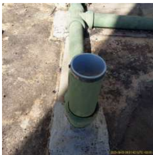
Foto 1 - Detalhe de tela de proteção contra entrada de insetos e pequenos animais nas tubulações de ventilação
