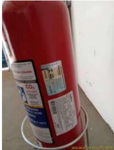
Foto 3 - Extintor de incêndio com validade regular - EEBB TIC LOG
