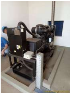
Foto 2 - Gerador de energia - EEBB TIC LOG
