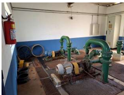
Foto 1 - Vista interna da EEAT, com 3 conjuntos motobomba: 1+1R que abastece o reservatório elevado e 01 (em parceria com motobomba externa) que recalca para o CR14.
