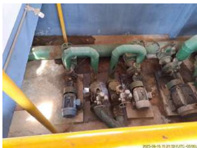
Foto 1 - Conjuntos (1 e 2) que recalcam para o Reservatório elevado.
