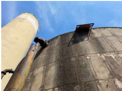
Foto 2 - Tubo danificado (corrosão).
