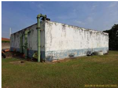
Foto 3 - Reservatório apoiado São Vito.
