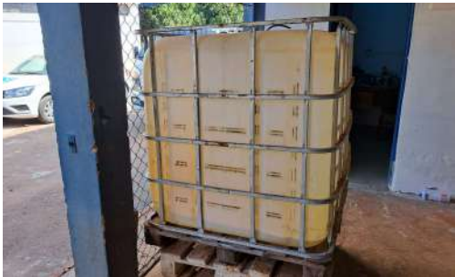
Foto 2 - Tanque de armazenamento do hipoclorito de sódio no depósito da ETA.
