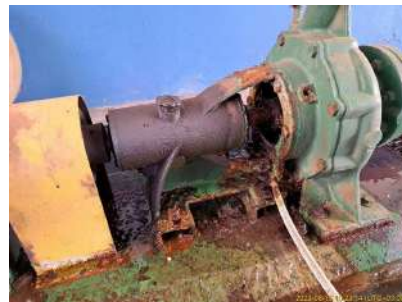
Foto 2 - Drenagem inadequada de água de lubrificação de gaxetas do segundo conjunto motobomba.
