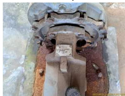
Foto 6 - Placa de especificações técnicas da bomba do primeiro conjunto motobomba.
