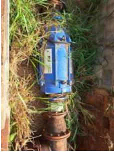
Foto 5 - Detalhe da motobomba em linha na saída da tubulação do Reservatório.
