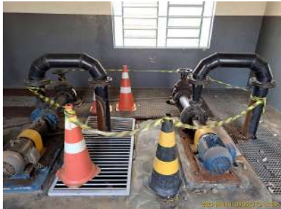
Foto 1 - Situação do piso próximo aos conjuntos motobomba.
