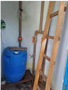
Foto 6 - Vista interna da base do reservatório, onde ficam a bomba dosadora de hipoclorito e o painel elétrico do poço.
