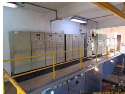
Foto 5 - Painéis elétricos da EEAT
