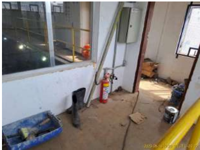
Foto 1 - Extintor de incêndio.
