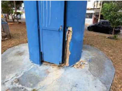
Foto 2 - Detalhe das avarias na estrutura e portão da base do reservatório.
