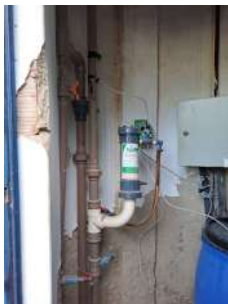
Foto 3 - Vista interna da base do Reservatório do Poço Carioba, com sistema de cloração e torneira para tomada de água bruta.
