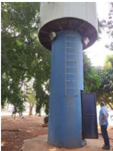
Foto 1 - Reservatório do Poço Carioba.
