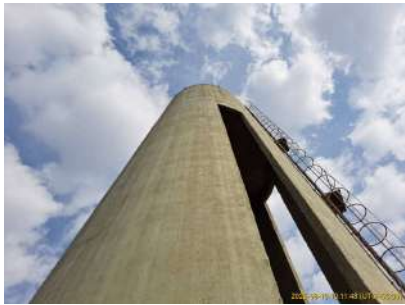
Foto 2 - Ausência de condutores de descida do Reservatório elevado.
