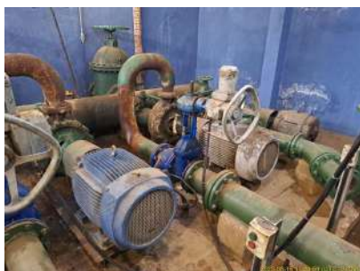
Foto 3 - Conjuntos motobomba 5 (esquerda) e 6 (centro).
