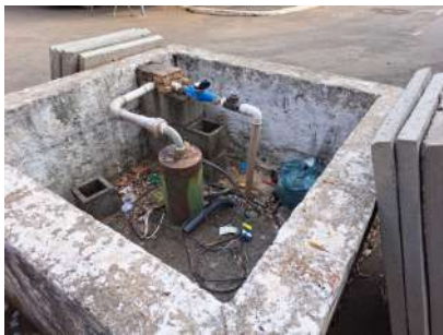
Foto 2 - Ausência de limpeza na área interna do poço.
