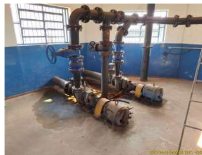
Foto 2 - Conjuntos motobomba (1+1R) da EEAT.
