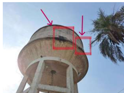
Foto 2 - Indicação das marcas de vazamentos na lateral do reservatório.
