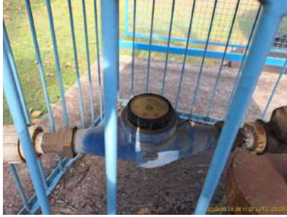
Foto 1 - Macromedidor do Poço Campo Verde.
