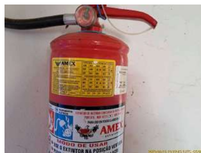
Foto 2 - Detalhe da validade do extintor de incêndio.
