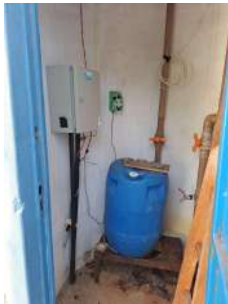
Foto 5 - Vista interna da base do reservatório, onde ficam a bomba dosadora de hipoclorito e o painel elétrico do poço.
