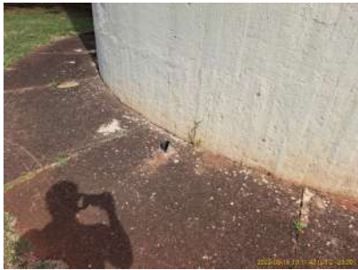
Foto 1 - Ausência de condutores de descida e aterramento do Reservatório elevado.
