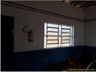
Foto 1 - Localização do extintor de incêndio dentro da EEAT.
