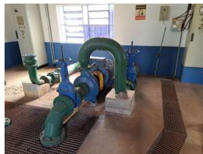
Foto 3 - Conjunto motobomba de recalque para o CR14 Praia Azul.
