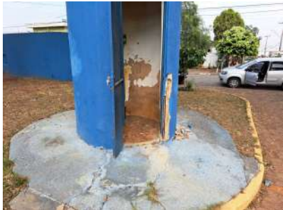
Foto 1 - Detalhe das avarias na estrutura e portão da base do reservatório.
