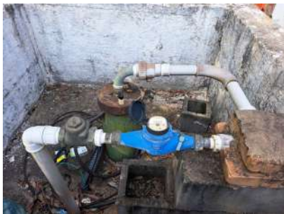
Foto 1 - Macromedidor do Poço São Vito.
