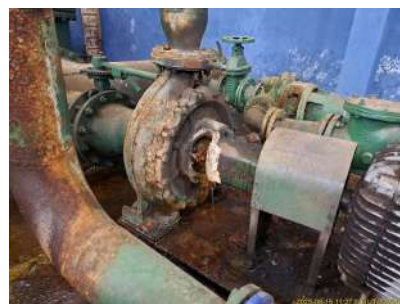
Foto 4 - Detalhe da drenagem inadequada da gaixeta da bomba 6.
