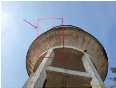
Foto 3 - Detalhe para o fio condutor cortado.
