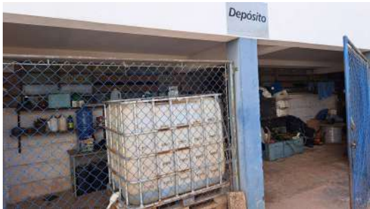
Foto 1 - Tanque de armazenamento do hipoclorito de sódio no depósito da ETA.
