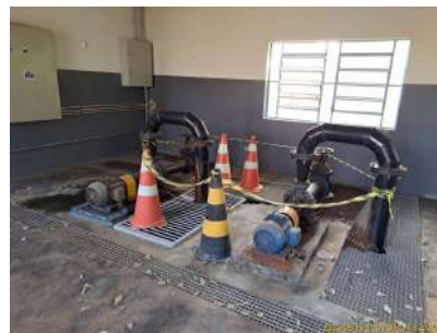
Foto 2 - Conjuntos motobomba (1+1R) da EEAT
