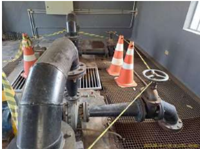
Foto 2 - Situação do piso próximo aos conjuntos motobomba.
