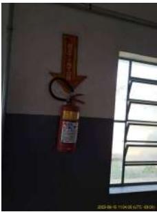
Foto 1 - Extintor de incêndio da EEAT.
