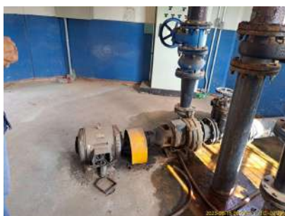
Foto 3 - Conjunto motobomba da EEAT
