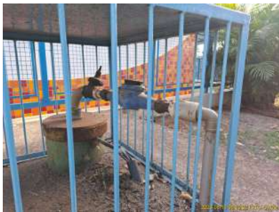
Foto 1 - Ausência de tomada de água bruta no cavalete do poço.
