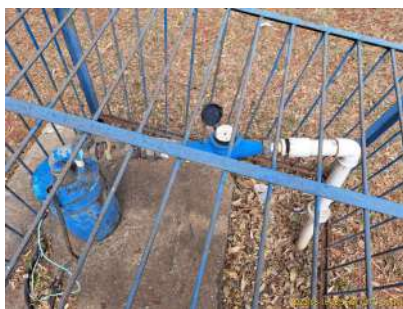
Foto 1 - Macromedidor no cavalete do Poço.
