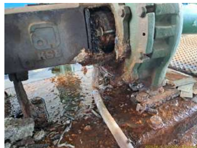
Foto 4 - Drenagem inadequada de água de lubrificação de gaxetas do primeiro conjunto motobomba.
