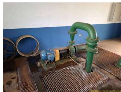
Foto 9 - Segundo conjunto motobomba de recalque para o Reservatório elevado.
