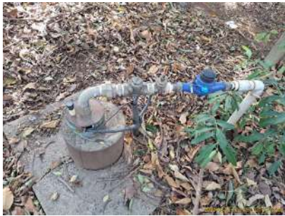
Foto 1 - Tubo de medição de nível do poço.
