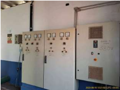
Foto 13 - Vista geral dos painéis elétricos.
