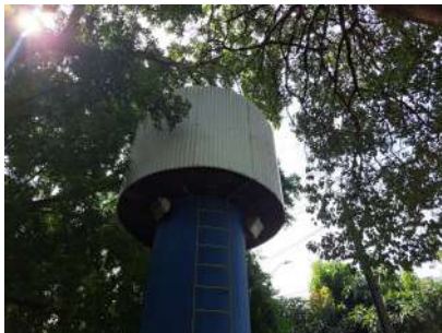
Foto 2 - Reservatório do Poço Carioba.
