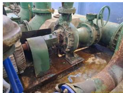
Foto 6 - Detalhe da drenagem inadequada da gaixeta da bomba 4 (piso molhado).
