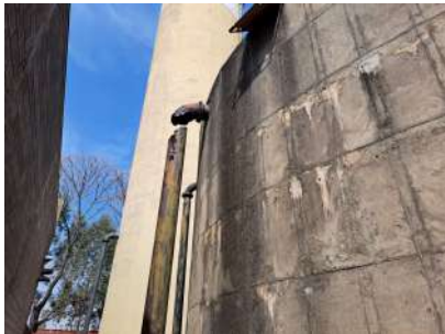
Foto 1 - Tubo danificado (corrosão).
