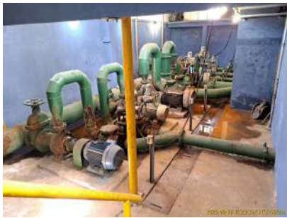
Foto 6 - Conjuntos motobomba da EEAT
