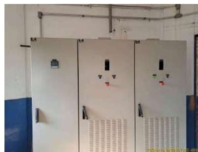
Foto 6 - Painéis elétricos da EEAT.
