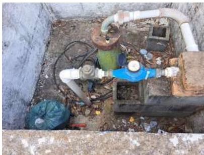
Foto 1 - Ausência de limpeza na área interna do poço.
