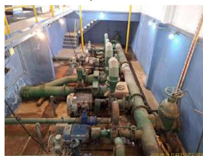
Foto 4 - Vista dos conjuntos motobomba da EEAT
