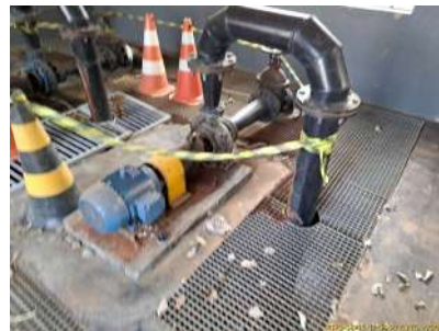
Foto 4 - Primeiro conjunto motobomba.
