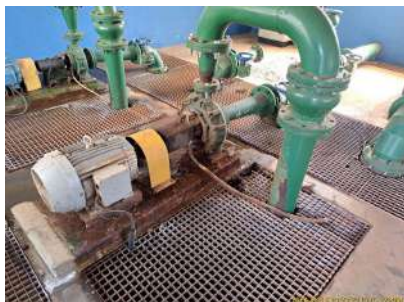
Foto 3 - Drenagem inadequada de água de lubrificação de gaxetas do primeiro conjunto motobomba.
