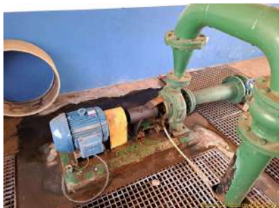
Foto 1 - Drenagem inadequada de água de lubrificação de gaxetas do segundo conjunto motobomba.
