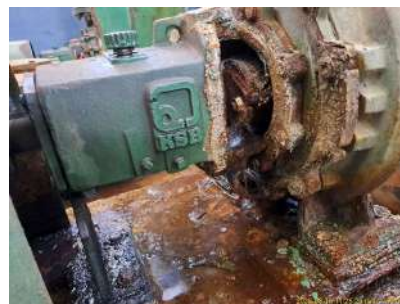
Foto 2 - Drenagem inadequada na gaixeta da bomba 2.
