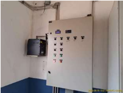
Foto 12 - Vista geral dos painéis elétricos.
