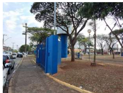
Foto 2 - Bebedouro público, Poço Belvedere e Reservatório ao lado
