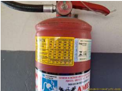
Foto 1 - Validade do extintor expirada.
