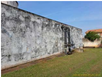
Foto 4 - Reservatório apoiado São Vito.
