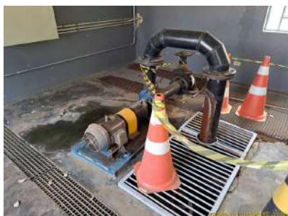
Foto 7 - Segundo conjunto motobomba.
