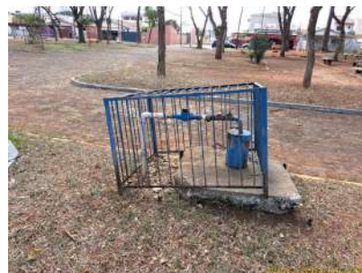
Foto 2 - Grade de proteção do Poço.
