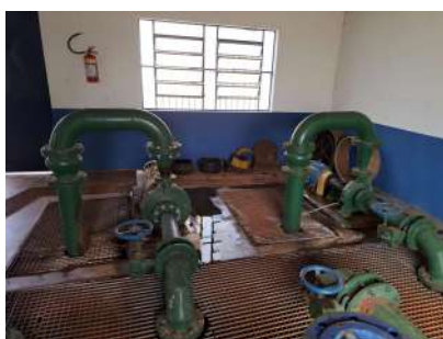
Foto 6 - Conjuntos motobomba de recalque para o Reservatório elevado.
