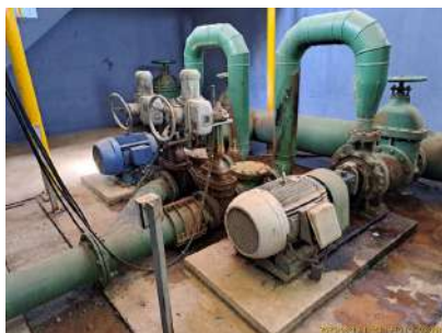
Foto 1 - Conjuntos motobomba 1 e 2. Detalhe do piso molhado próximo ao conjunto 2.
