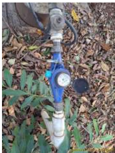
Foto 1 - Macromedidor no cavalete do poço.
