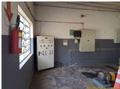
Foto 3 - Painéis elétricos da EEAT
