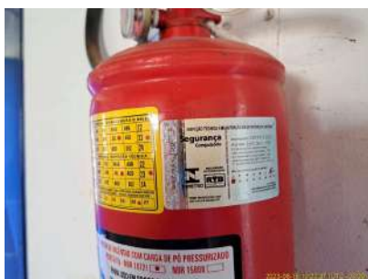
Foto 1 - Detalhe da validade do extintor de incêndio.
