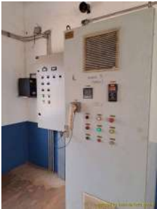
Foto 11 - Vista geral dos painéis elétricos.
