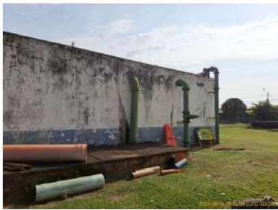
Foto 2 - Reservatório apoiado São Vito.
