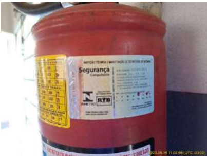
Foto 2 - Validade do extintor expirada.
