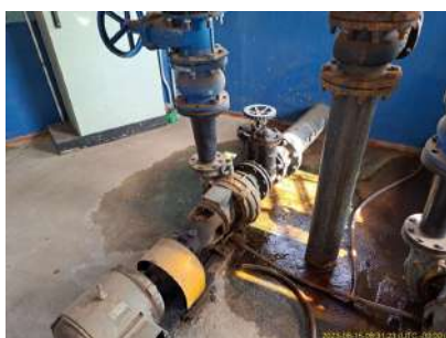
Foto 1 - Vazamento no registro da tubulação de um dos conjuntos motobomba.
