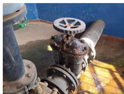
Foto 2 - Vazamento no registro da tubulação de um dos conjuntos motobomba.
