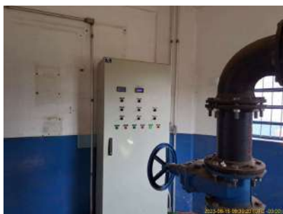
Foto 5 - Um dos painéis elétricos da EEAT.
