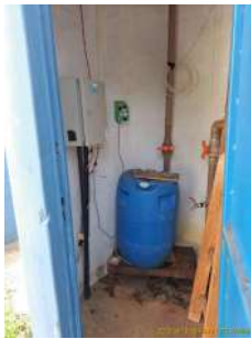
Foto 7 - Vista interna da base do Reservatório do Poço São Vito, com bomba dosadora de hipoclorito e tanque de armazenamento.
